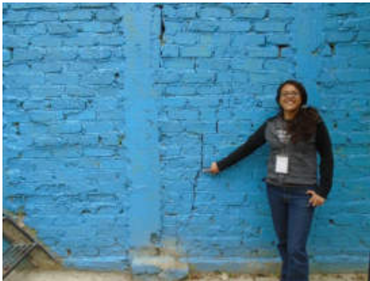
Figura 5.180. Imagen B del polígono de vulnerabilidad Golondrinas. Fotografía que muestra un muro fracturado. La fractura tiene una dirección vertical. Este tipo de daños se encuentran asociados a hundimiento (19.3778° N, 99.2160° W. Calle: Quetzal).
