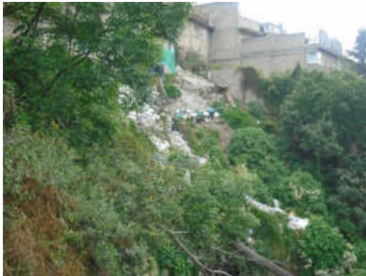
Figura 5.68. Fotografía A de la sección tres (6.3) del polígono de peligro Río Becerra. Muro de contención elaborado con costales apilados rellenos de materiales poco resistentes. Este es un uso muy común en las zonas que presentan inestabilidad, sin embargo, con el paso del tiempo no cumplen con su función (19.3789° N, 99.2261° W. Calle: Del Pipila).
