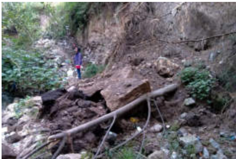
Figura 5.48. Fotografía B de la sección cuatro (4.4) del polígono de peligro Guadalupe. Se observa un derrumbe de grandes dimensiones, en el cual se distingue la caída de bloques de material poco compacto. Los derrumbes afectan a los habitantes de esta barranca a lo largo de su cauce (19.3450° N, 99.2274° W. Calle: sin nombre oficial).
