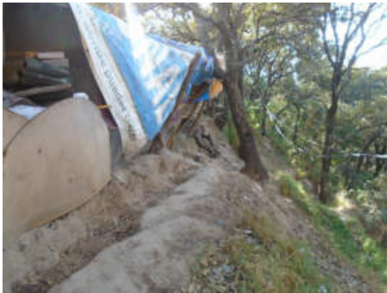
Figura 5.88. Fotografía B del polígono de peligro Tierra Nueva. Construcción precaria con una severa inclinación con dirección hacia la pendiente, la cual está recargada en el árbol; dicho árbol tiene sus raíces expuestas a causa de la remoción del material (19.3545° N, 99.2500° W. Calle: Madre Selva).
