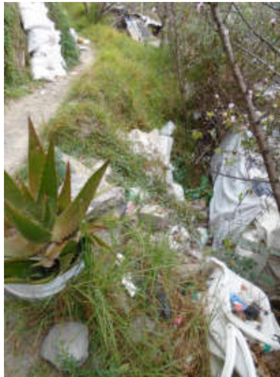
Figura 5.119. Fotografía C de la sección dos (13.2) del polígono de peligro Tacubaya. Se observan algunos costales rellenos de materiales in situ, los cuales fueron colocados para intentar detener la remoción de los materiales que componen al talud (19.3852° N, 99.2293° W. Calle: Estrella Brillante).
