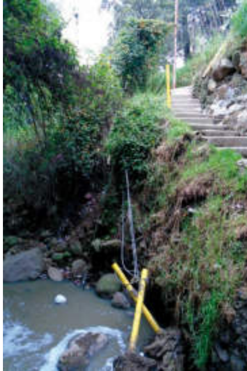
Figura 5.23. Fotografía B de la sección dos (2.2) del polígono de peligro Texcalatlaco. En la fotografía se observan los materiales derrumbados de la pared de la barranca sobre la que se encuentra un camino con escaleras para el paso peatonal (19.3272° N, 99.2513° W. Calle: 10 de Mayo).
