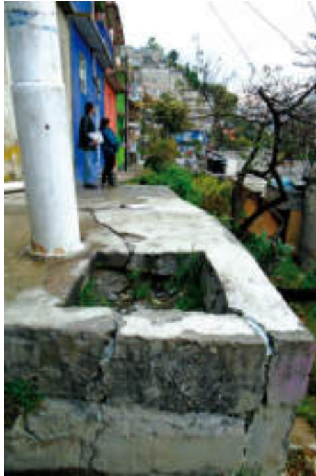
Figura 5.141. Fotografía A del polígono de vulnerabilidad La Cañada. Presencia de fracturas en una de las banquetas causadas por el movimiento del material sobre el que se encuentran. Las juntas van debilitando la estructura, hasta que esta caiga en dirección hacia la pendiente (19.3809° N, 99.2261° W. Calle: Vista Alegre).
