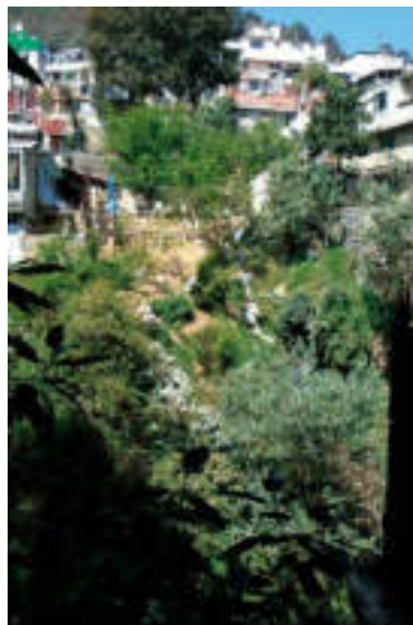
Figura 5.36. Fotografía A de la sección uno (4.1) del polígono de peligro Guadalupe. Al centro se distingue un derrumbe, a lo largo del cual hay varios costales caídos. Los costales apilados sirven como un método de contención en laderas compuestas de material deleznable; sin embargo no es suficiente para contrarrestar el movimiento de los materiales (19.3132° N, 99.2698° W. Calle: Manzano).
