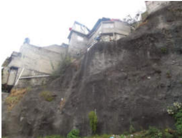
Figura 5.142. Fotografía B del polígono de vulnerabilidad La Cañada. Construcciones desplantadas a la orilla de un talud que tiene un lanzado de concreto. Se observa que el concreto está siendo invadido por vegetación. La irregularidad que presenta el concreto lanzado evidencia los eventos de derrumbes, asimismo no cuenta con malla para reforzar la estructura (19.3835° N, 99.2217° W. Calle: Jorge Vera).
