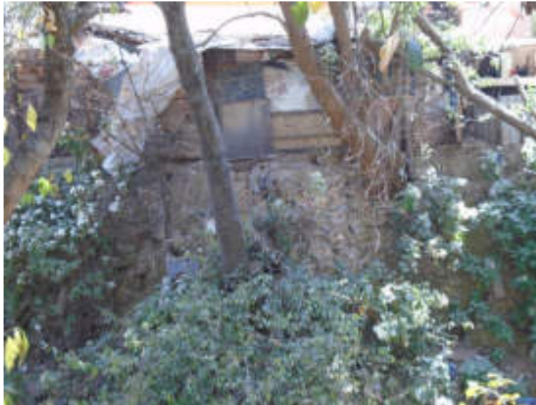
Figura 5.28. Fotografía B de la sección uno (3.1) del polígono de peligro Malinche. Construcción precaria asentada sobre un talud inestable. El tipo de materiales aumenta exponencialmente la vulnerabilidad de este tipo de inmuebles al no tener ningún soporte o una estructura resistente (19.3333° N, 99.2495° W. Calle: Prolongación Magnolia).
