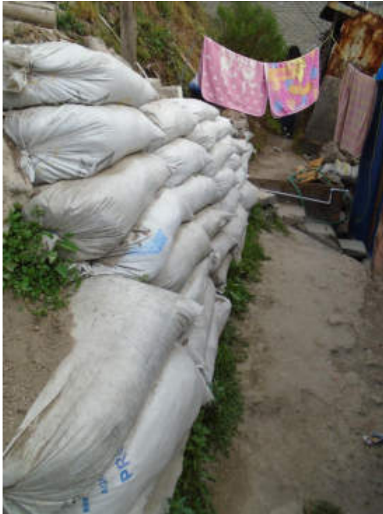
Figura 5.123. Fotografía C de la sección 13.3 del polígono de peligro Tacubaya. Costales rellenos colocados sobre un talud con el fin de mitigar el movimiento de los materiales inestables que lo componen. En la esquina superior derecha se observa una construcción precaria que es vulnerable ante un posible derrumbe (19.3911° N, 99.2154° W. Calle: Polacos).
