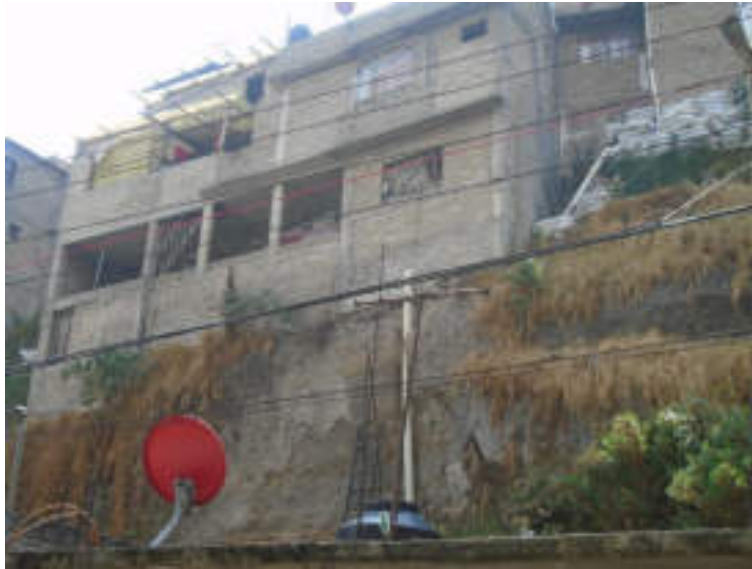
Figura 5.64. Fotografía A de la sección dos (6.2) del polígono de peligro Río Becerra. Construcción asentada a las orillas de un talud compuesto por material poco estable que presenta erosión. Se observa que sólo está sostenida por pilares delgados y poco resistentes (19.3732° N, 99.2306° W. Calle: Puerto Tecanatitla).
