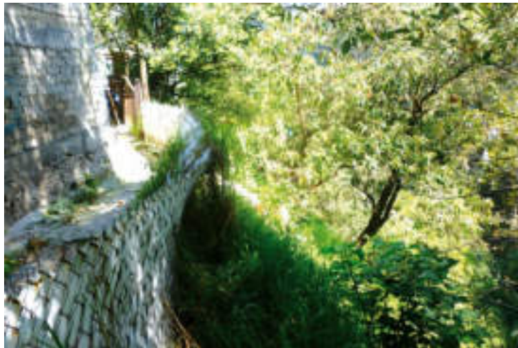
Figura 5.6. Fotografía A de la sección uno (1.1) del polígono de peligro Río San Borja. Se observa una vivienda en la orilla de un talud inestable, el árbol inclinado es la evidencia de la inestabilidad del talud (19.3695° N, 99.2283° W. Calle: Puerto Loreto).
