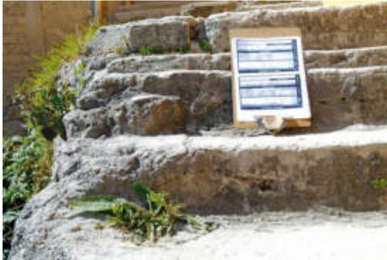
Figura 5.128. Fotografía A del polígono de vulnerabilidad Santa Lucía. Escalera de cemento de baja calidad desplantada a las orillas de una ladera; presenta fracturas y una ligera inclinación en dirección a la pendiente, debido a la pérdida de materiales en el basamento por la continua remoción (19.3567° N, 99.2526° W. Calle: sin nombre oficial).
