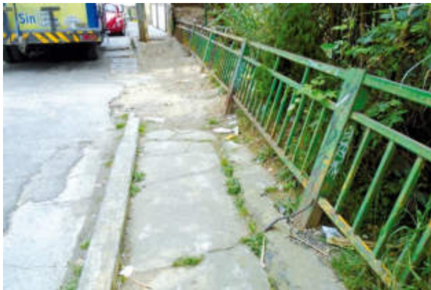
Figura 5.22. Fotografía A de la sección dos (2.2) del polígono de peligro Texcalatlaco, donde se muestra una banqueta fracturada asentada sobre material inestable; el barandal presenta una inclinación favorable al talud de la barranca (19.3272° N, 99.2522° W. Calle: Rosal).
