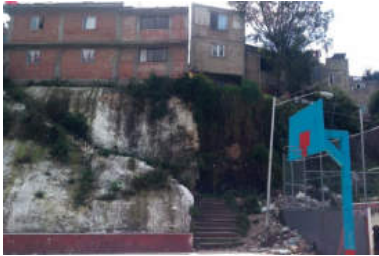
Figura 5.11. Fotografía B de la sección dos (1.2) del polígono de peligro Río San Borja. La fotografía muestra viviendas ubicadas en la parte alta del talud, las cuales presentan una separación desigual en la junta constructiva debido a una ligera inclinación hacia la barranca. También se aprecia que el concreto lanzado ha colapsado debido a la humedad y al deslizamiento del material no consolidado (19.3766° N, 99.2141° W. Calle: Telégrafo de Guadalajara).
