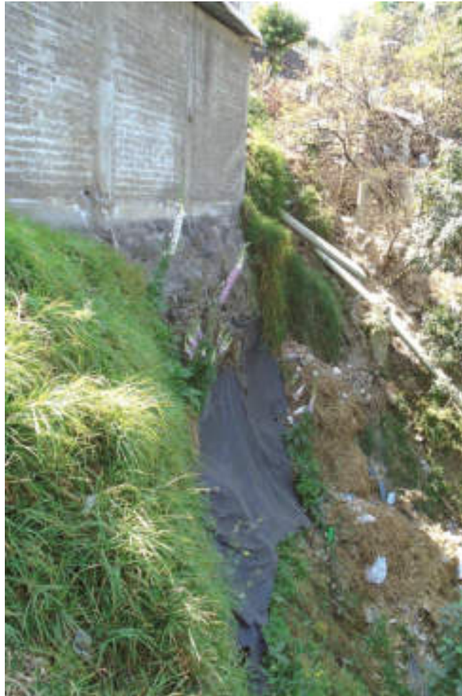
Figura 5.37. Fotografía B de la sección uno (4.1) del polígono de peligro Guadalupe. Se aprecia un talud cubierto por una lona deteriorada. Las lonas son medidas de mitigación de poca vida útil, debido a los agentes erosivos a los que están expuestas. La construcción que se distingue en la fotografía presenta una ligera inclinación hacia la pendiente (19.3173° N, 99.2660° W. Calle: Jacarandas).
