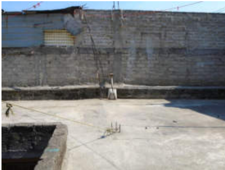
Figura 5.176. Fotografía B del polígono de peligro Las Golondrinas. Fotografía que muestra el desnivel del muro de una vivienda. Se puede observar que el lado derecho está descendiendo respecto al izquierdo (19.3778° N, 99.2151° W. Calle: Gorriones).
