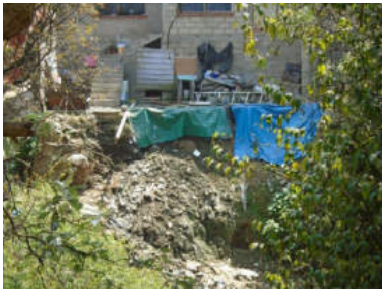
Figura 5.29. Fotografía C de la sección uno (3.1) del polígono de peligro Malinche. En la fotografía se distingue el uso de lonas para mitigar el continuo movimiento del material deleznable que compone al talud sobre el que se asienta una vivienda (19.3335° N, 99.2494° W. Calle: Prolongación Magnolia).
