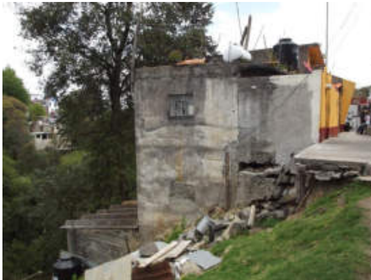
Figura 5.162. Fotografía C de la sección uno (19.1) del polígono de peligro Atzoyapan. Vivienda desplantada a la orilla de uno de los flancos de la barranca; en uno de los muros de carga, se observa la presencia de una fractura vertical, asociada a la pérdida de basamento por procesos de remoción en masa; también puede apreciarse que la banqueteta presenta un volado (19.3273° N, 99.2793° W. Calle: Camino Real a Mixcoac).
