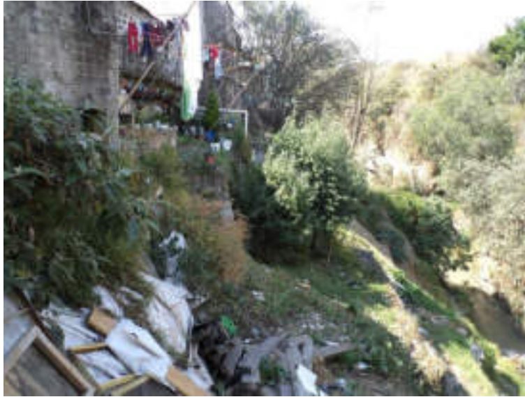
Figura 5.73. Fotografía B de la sección uno (7.1) del polígono de peligro Tarango. Se observa que el muro aladoño a la ladera presenta una ligera inclinación en dirección a la pendiente. También puede apreciarse la pérdida paulatina del basamento de las viviendas, provocado por la poca compactación de los materiales que componen la ladera (19.3541° N, 99.2181° W. Calle: 4.ª Cerrada).
