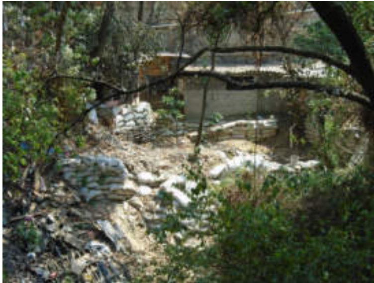
Figura 5.30. Fotografía D de la sección uno (3.1) del polígono de peligro Malinche, en donde se aprecia el uso de costales rellenos de arena y cascajo, como una manera de contener los deslizamientos del material que compone a la barranca (19.3325° N, 99.2505° W. Calle: Nardo).
