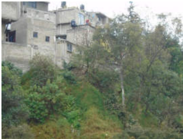
Figura 5.153. Fotografía A de la sección dos (18.2) del polígono de peligro Tlalpizahuaya. Se observan algunas viviendas desplantadas sobre uno de los flancos de la barranca; al centro de la fotografía se distingue que el material que compone a la ladera no tienen consolidación; los árboles presentan una ligera inclinación con dirección a la pendiente (19.3784° N, 99.2336° W. Calle: sin nombre oficial).
