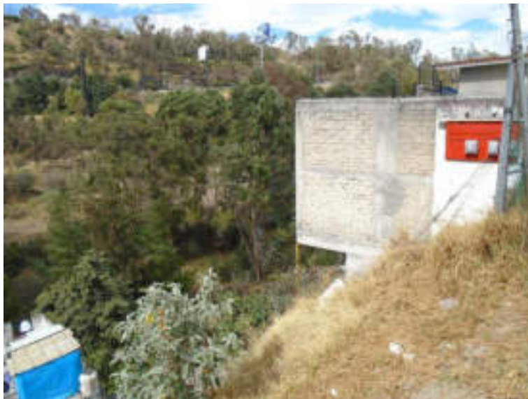
Figura 5.115. Fotografía C de la sección uno (13.1) del polígono de peligro Tacubaya. Se muestra una vivienda construida sobre la orilla de uno de los flancos de la barranca, la cual presenta un volado sin ningún tipo de soporte (19.3820°N, 99.2457° W. Barranca Morena).
