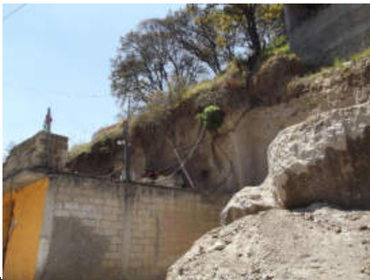
Figura 5.165. Fotografía A de la sección dos (19.2) del polígono de peligro Atzoyapan. Construcción precaria desplantada al pie de un talud; debido a la pendiente y a la composición del corte en la ladera, la vivienda está en peligro de sufrir daños por el colapso del material (19.3553° N, 99.2469° W. Calle: Encino).
