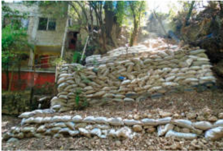
Figura 5.40. Fotografía A de la sección dos (4.2) del polígono de peligro Guadalupe en la que se observan varios costales rellenos apilados que intentan detener el material deleznable. Asimismo, se distingue la formación de terrazas por los costales apilados (19.3205° N, 99.2643° W. Calle: Emiliano Zapata).
