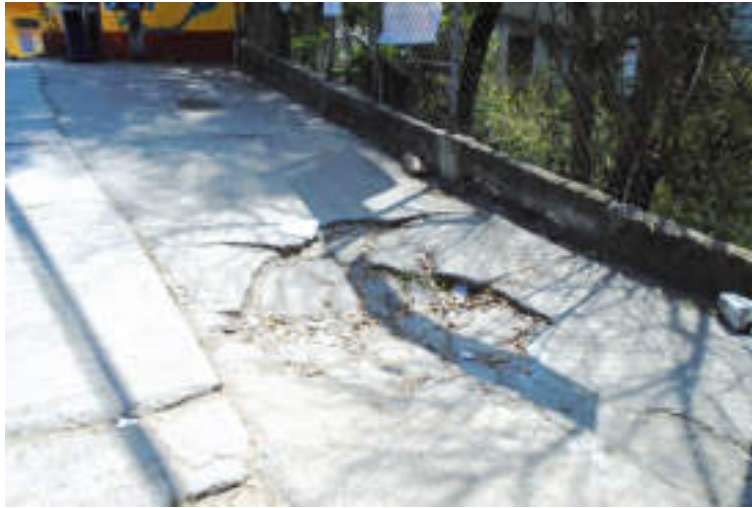
Figura 5.44. Fotografía A de la sección tres (4.3) del polígono de peligro Guadalupe. La fotografía muestra el fracturamiento de la plancha de concreto de la banqueta originando una deformación provocada por la falta de material en su basamento. La banqueta muestra una ligera inclinación con dirección a la pendiente (19.3239° N, 99.2639° W. Calle: Del Rosal).
