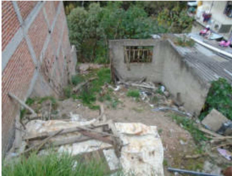
Figura 5.118. Fotografía B de la sección dos (13.2) del polígono de peligro Tacubaya. Obra negra desplantada a las orillas de un talud compuesto de material sin consolidar. Se puede apreciar en el muro de la construcción la presencia de fracturas por falta de confinamiento y por la remoción del basamento sobre el que se encuentra asentada (19.3855° N, 99.2296° W. Calle: Estrella de Belén).
