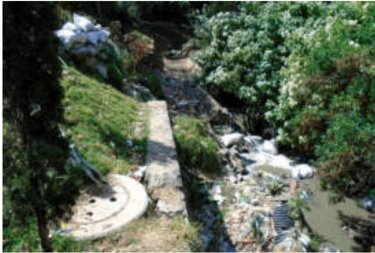
Figura 5.42. Fotografía C de la sección dos (4.2) del polígono de peligro Guadalupe. En la fotografía se distingue un muro de contención cuyo objetivo es encauzar el río. Parte del muro colapsó debido a la remoción del material del talud adyacente. Se observan costales rellenos apilados sobre el derrumbe (19.3206° N, 99.2642° W. Calle: Emiliano Zapata).
