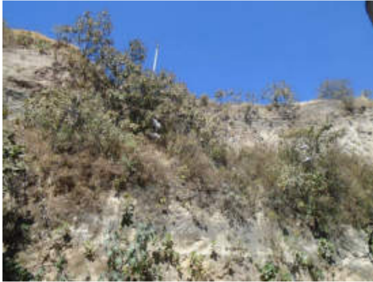
Figura 5.93. Fotografía A del polígono de peligro Lomas de Tarango. Porción de un talud compuesta de material sin consolidar; en la parte superior, la ladera presenta una cicatriz de derrumbe (19.3604° N, 99.2206° W. Calle: Paseo de los Olmos).
