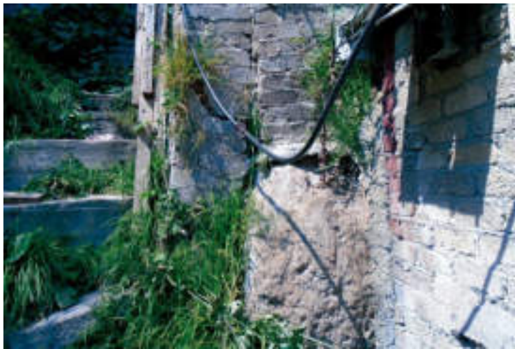
Figura 5.105. Fotografía B de la sección dos (11.2) del polígono de peligro Río Mixcoac. En la fotografía se observa un fragmento del muro de carga de una vivienda, el cual presenta una fractura a causa de la remoción de los materiales sobre los que se asienta. Al centro de la fotografía se observan los depósitos volcánicos sobre los que fue construida la vivienda, los cuales no están consolidados (19.3610° N, 99.2326° W. Calle: Abubillas).
