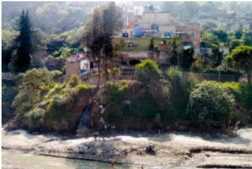
Figura 5.47. Fotografía A de la sección cuatro (4.4) del polígono de peligro Guadalupe. Se aprecian las inmediaciones de la Presa Tequilasco; el talud sobre el que se asientan varias viviendas se encuentra afectado por derrumbes, además de estar invadido por vegetación (19.3444° N, 99.2307° W Calle: Río Guadalupe).
