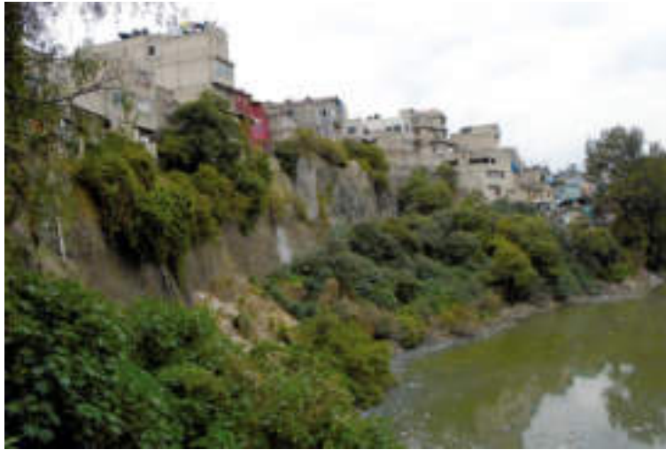
Figura 5.15. Fotografía B de la sección tres (1.3) del polígono de peligro Río San Borja. Inmuebles sobre un talud vertical de casi 15 m de altura, localizados a un costado del vaso regulador. La vegetación ha invadido varias partes del concreto lanzado, lo cual ha comenzado a provocar fracturas y colapsos que se observan en la parte baja del talud (19.3800° N, 99.2064° W. Avenida: Benito Juárez).
