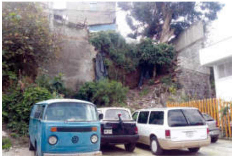
Figura 5.12. Fotografía C de la sección dos (1.2) del polígono de peligro Río San Borja. En ésta se observan diversas construcciones ubicadas en la parte superior de la ladera, las cuales están siendo afectadas por la remoción del material. Al centro se aprecia un derrumbe que ocasionó que parte del muro de contención y el concreto lanzado colapsaran (19.3770° N, 99.2138° W. Calle: Río San Borja).
