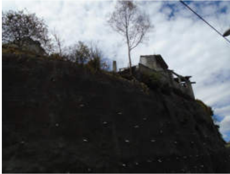
Figura 5.132. Fotografía B del polígono de peligro Corpus Christy. Talud cubierto de concreto lanzado con el fin de evitar la erosión que causa la remoción de los materiales. Esto puede traer como consecuencia que las viviendas asentadas sobre el talud, al perder material en su basamento, colapsen hacia la pendiente (19.3622° N, 99.2458° W. Calle: San Isidro Alto Lerma).
