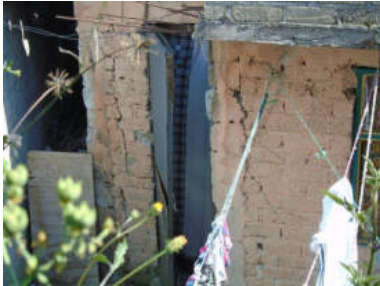
Figura 5.177. Fotografía B del polígono de peligro Las Golondrinas. Fotografía que muestra fracturas en el muro de una vivienda ocasionadas por la posible presencia de una mina en el subsuelo (19.3778° N, 99.2151° W. Calle: Gorriones).
