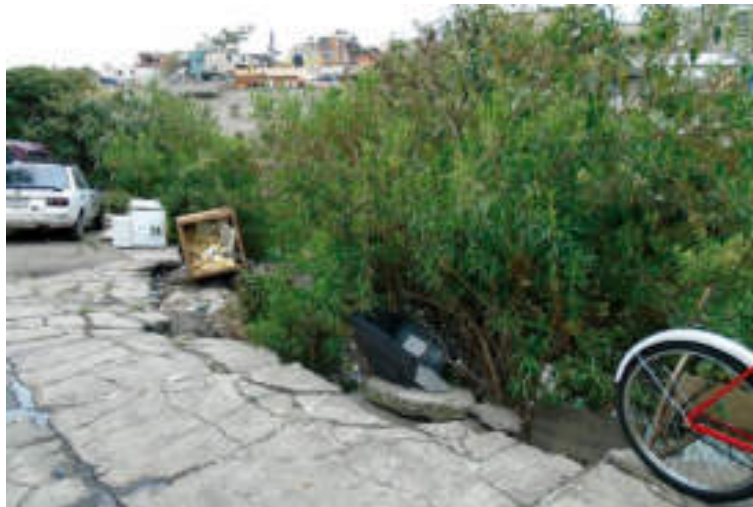
Figura 5.14. Fotografía A de la sección tres (1.3) del polígono de peligro Río San Borja. La fotografía muestra una banqueta fracturada que presenta colapso parcial e inclinación hacia la barranca, ubicada a un costado del vaso regulador. El desplazamiento vertical indica la actividad del fenómeno de remoción en masa (19.3811° N, 99.2058° W. Calle: Andador Circuito Mineros).
