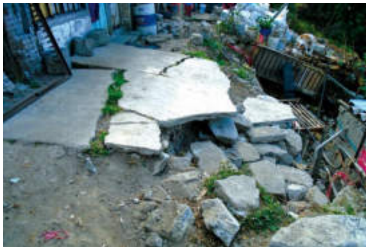
Figura 5.58. Fotografía C del polígono de vulnerabilidad de Loma Nueva. Plancha de concreto que al estar construida sobre material inestable, presenta ruptura y colapso de su estructura; el patio de la vivienda presenta una inclinación pronunciada con dirección a la pendiente (19.3660° N, 99.2167° W. Calle: sin nombre oficial).
