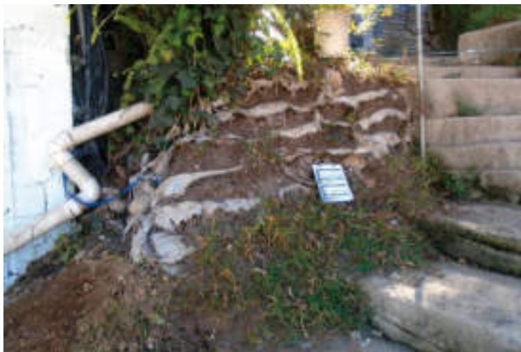
Figura 5.54. Fotografía C del polígono de peligro de Loma Nueva. Se observan varios costales apilados rellenos de tierra que han sido invadidos por vegetación y que están deteriorados. Este tipo de medidas de contención son una costumbre muy frecuente en las personas que habitan en zona de laderas, pero no es efectiva (19.3669° N, 99.2157° W. Calle: Roble).
