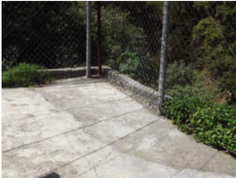
Figura 5.171. Fotografía C de la sección uno (20.1) del polígono de peligro Parque La Loma. Se distinguen algunas fracturas que afectan al pavimento debido al movimiento de los materiales que componen la ladera; se observa inclinación de la plancha de concreto hacia la pendiente (19.3305° N, 99.2421° W. Calle: Violetas).
