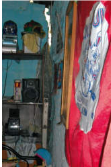
Figura 5.57. Fotografía B del polígono de vulnerabilidad de Loma Nueva. Vista al interior de una vivienda que presenta una separación considerable entre los elementos estructurales (19.3658° N, 99.2172° W. Calle: Loma Nueva).
