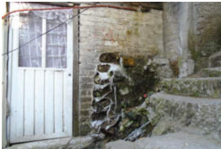
Figura 5.56. Fotografía A del polígono de vulnerabilidad en Loma Nueva. Construcción de mampostería sin confinamiento desplantada sobre el terreno natural de la ladera. Se utilizaron mampostería y costales apilados para la construcción y relleno del muro frontal de la obra; los costales apilados presentan un deterioro avanzado por encontrarse a la intemperie; la losa bajo la puerta muestra una fractura (19.3660° N, 99.2175° W. Calle: Andador 1).
