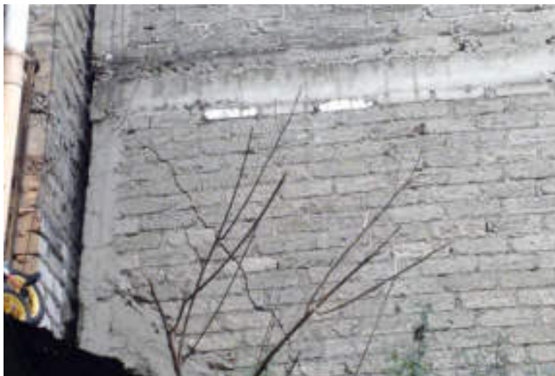
Figura 5.184. Fotografía B del polígono de peligro Barrio Norte. Fractura diagonal en el muro de carga de una vivienda, la cual parte totalmente a los ladrillos. La calle donde fue tomada esta fotografía fue reparada a causa de la presencia de una mina (19.3796° N, 99.2077° W. Calle: Minas de Platino).
