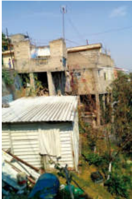
Figura 5.104. Fotografía A de la sección dos (11.2) del polígono de peligro Río Mixcoac. Construcciones precarias desplantadas a las orillas de uno de los flancos. La vivienda que se observa al fondo de la fotografía solamente está sostenida por columnas muy delgadas y poco resistentes ante los movimientos de remoción, e incluso uno de ellos se distingue doblado. La construcción del centro presenta una ligera inclinación hacia la pendiente (19.3592° N, 99.2353° W. Calle: Marabú).
