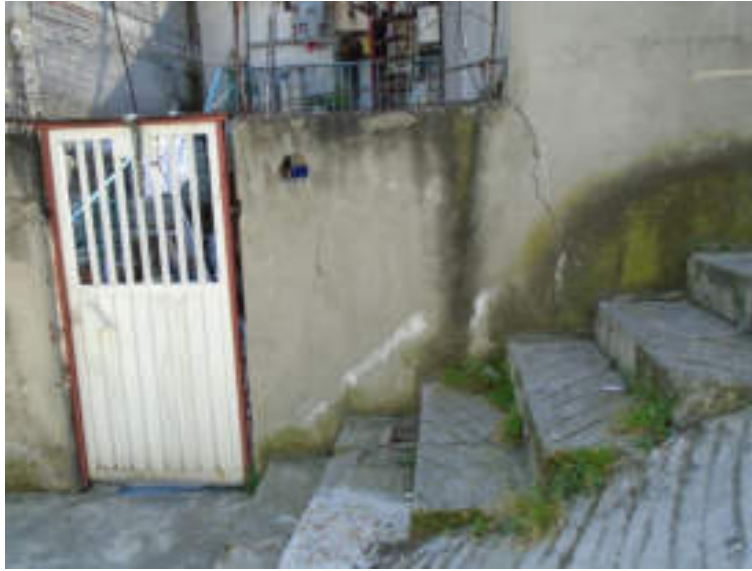
Figura 5.179. Imagen A del polígono de vulnerabilidad Golondrinas. Se muestra el muro exterior de una vivienda, del lado derecho del muro se observan dos fracturas verticales que tienen una separación aproximada de 1.5 cm, el muro y los escalones (los cuales también se encuentran fracturados) presentan un alto grado de humedad lo cual, aunado a encontrarse en una antigua zona de mina, acelera la presencia de fracturas (19.3777° N, 99.2159° W. Calle: Gaviotas).
