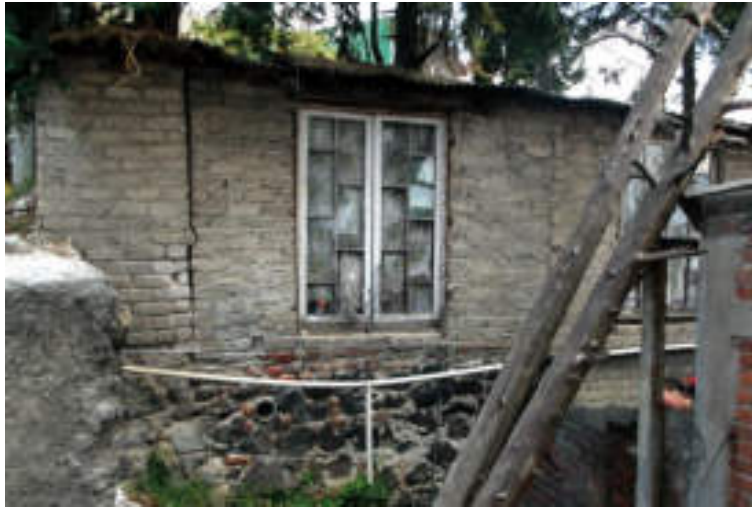
Figura 5.80. Fotografía B de la sección uno (8.1) del polígono de peligro Puerta Grande. En la fotografía se aprecia una vivienda de mampostería no confinada desplantada sobre un talud, que presenta una fractura de varios milímetros de ancho; parte de la construcción está ligeramente inclinada en dirección a la pendiente (19.3526° N, 99.2415° W. Calle: Cerrada Tecolcotla).
