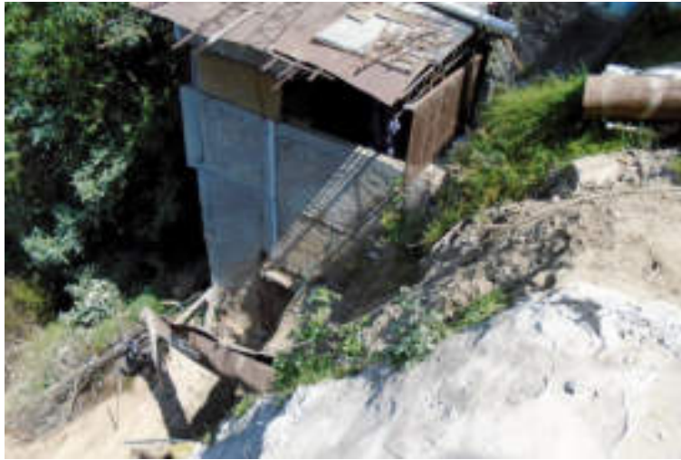
Figura 5.38. Fotografía C de la sección uno (4.1) del polígono de peligro Guadalupe. Construcción asentada en una ladera, la cual es afectada directamente por un derrumbe ocurrido recientemente en época de lluvias. Se observa concreto lanzado de baja calidad para mitigar la remoción de los materiales del flanco de la barranca (19.3175° N, 99.2655° W. Calle: Azalea).
