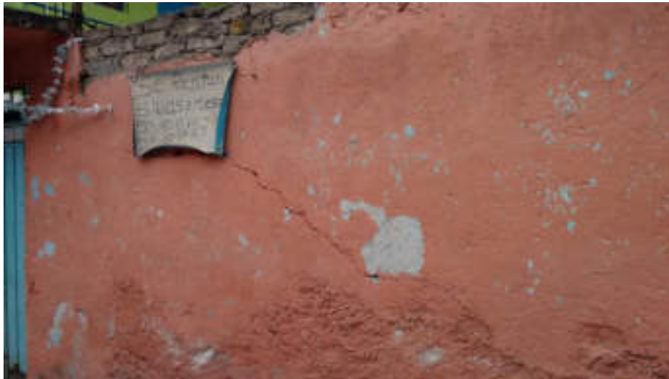
Figura 5.183. Fotografía A del polígono de peligro Barrio Norte. Muro perimetral que presenta una fractura diagonal; esta fractura apareció en el muro después de un sismo (19.3777° N, 99.2085° W. Calle: Díaz Ordaz).
