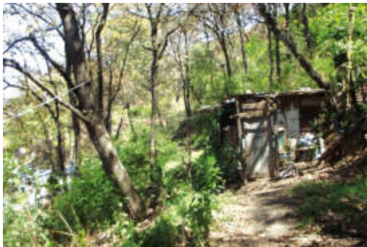
Figura 5.90. Fotografía A del polígono de vulnerabilidad Tierra Nueva. Construcción precaria desplantada a la orilla de la ladera, la cual presenta una ligera inclinación con dirección hacia la pendiente. En la parte superior derecha se observa que un árbol tiene una severa inclinación, el cual se encuentra sobre la vivienda. La inclinación que presentan los árboles es una evidencia de la actividad de los fenómenos de remoción en masa que afectan Tierra Nueva (19.3551° N, 99.2501° W. Calle: sin nombre oficial).
