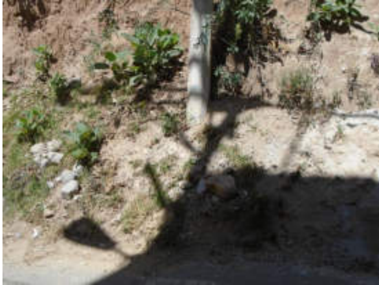
Figura 5.97. Fotografía B del polígono de vulnerabilidad Lomas de Tarango. Fotografía que muestra depósitos de material no consolidado al pie del talud que han cubierto parte del poste de luz y fragmentos líticos que han caído hacia la vía de comunicación (19.3607° N, 99.2200° W. Calle: Paseo de los Olmos).
