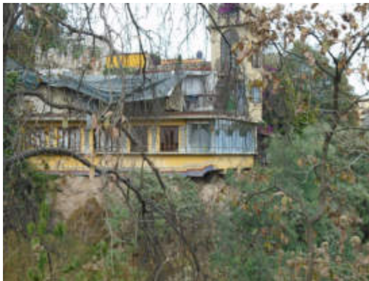
Figura 5.33. Fotografía A de la sección dos (3.2) del polígono de peligro Malinche. La fotografía muestra una vivienda asentada sobre un talud inestable; la remoción de los materiales sobre los que fue construida ha provocado que el inmueble presente un volado (19.3327° N, 99.2346° W. Calle: Licenciado Fernando González Piña).
