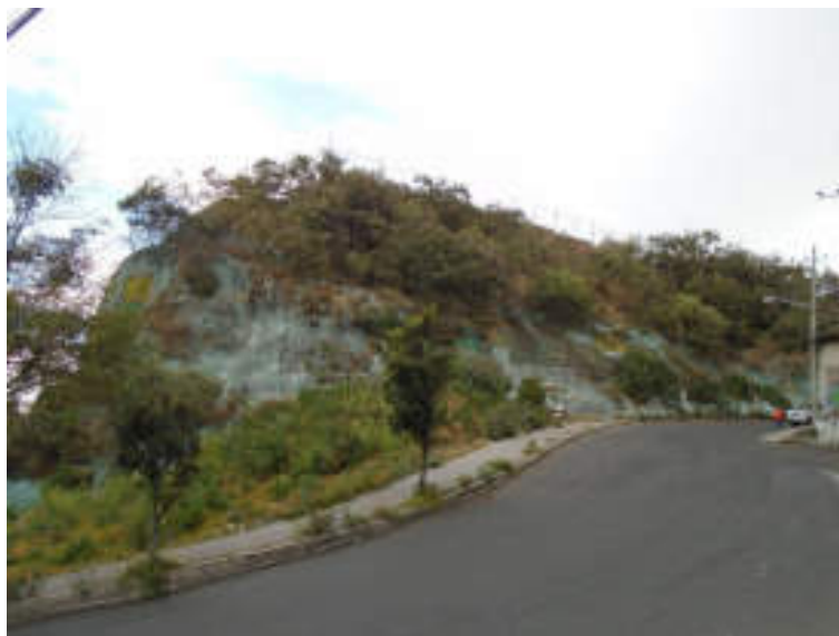
Figura 5.146. Fotografía A del polígono de vulnerabilidad Lomas de Capula. En la parte superior de la ladera se aprecia la barda de la cementera. También se observa en la parte superior izquierda de la imagen que el refuerzo de concreto lanzado no es completo sobre el talud (19.3797° N, 99.2167° W. Calle: Marco Polo).
