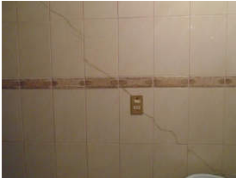
Figura 5.181. Imagen C del polígono de vulnerabilidad Golondrinas. Fotografía que muestra una fractura diagonal asociada a hundimiento por minas. La fractura abarca casi todo el muro (19.3776° N, 99.2151° W. Calle: Pingüinos).
