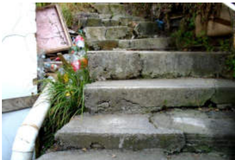
Figura 5.52. Fotografía A del polígono de peligro de Loma Nueva. Escalera fracturada, debido a la inestabilidad del terreno sobre el cual fue construida; la escalera presenta una ligera inclinación hacia la pendiente ( 19.3663^{\circ} N, 99.2176^{\circ} W. Calle: Andador 1).
