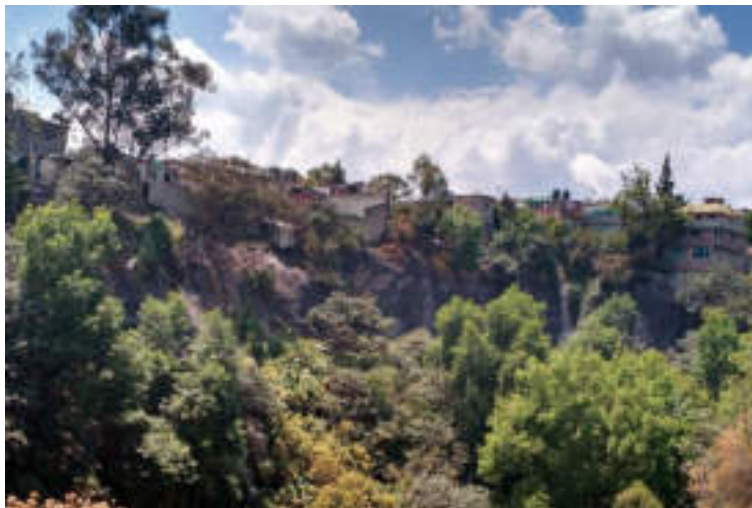
Figura 5.85. Fotografía C de la sección dos (8.2) del polígono de peligro Puerta Grande. Se aprecia un talud compuesto de material inestable cubierto por concreto lanzado, el cual está invadido en varias porciones por vegetación. En las orillas se encuentran varias viviendas asentadas, las cuales no cuentan con una estructura resistente a los movimientos de ladera (19.3534° N, 99.2388° W. Calle: sin nombre oficial).
