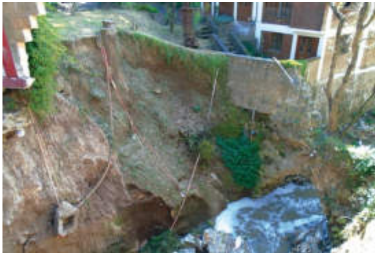
Figura 5.45. Fotografía B de la sección tres (4.3) del polígono de peligro Guadalupe. En esta fotografía se puede apreciar un derrumbe que derribó la mayor parte del muro hacia la corriente; se distinguen restos de la estructura en el cauce del río (19.3370° N, 99.2530° W. Calle: Aviñón y Lafayette).
