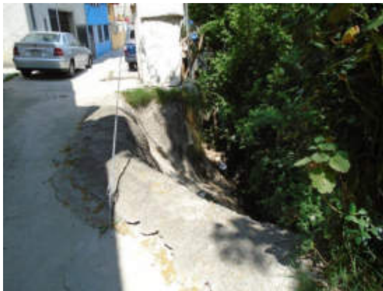
Figura 5.27. Fotografía A de la sección uno (3.1) del polígono de peligro Malinche, en la que se observa un talud con pendiente abrupta cubierta con concreto lanzado. Se distingue también la presencia de vegetación, que con el paso del tiempo ha debilitado la estructura del concreto (19.3327° N, 99.2504° W. Calle: Canadá).
