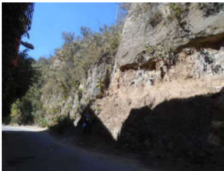
Figura 5.96. Fotografía A del polígono de vulnerabilidad Lomas de Tarango. Se puede observar una discontinuidad de los materiales en el talud. Al pie de la discontinuidad hay un depósito de material que se removió (19.3604° N, 99.2204° W. Calle: Paseo de los Olmos).
