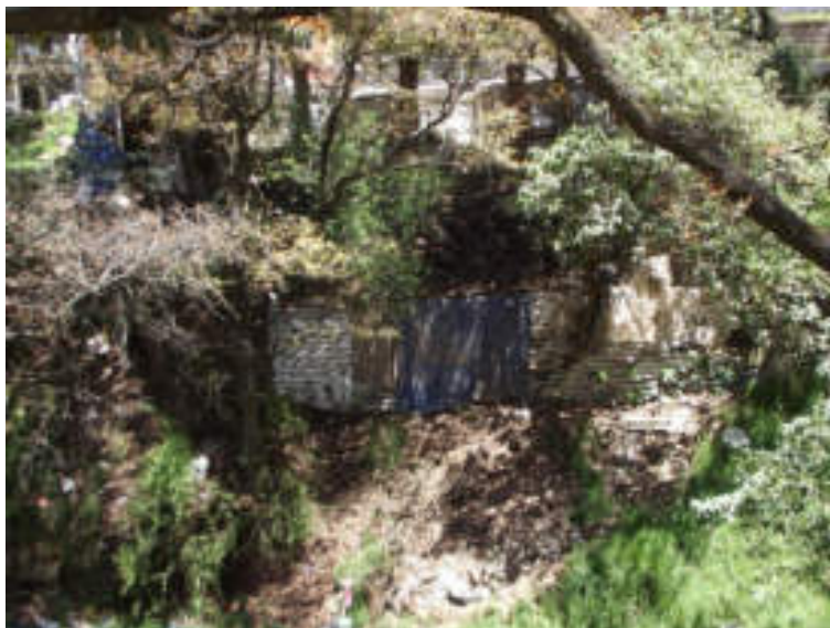
Figura 5.166. Fotografía B de la sección dos (19.2) del polígono de peligro Atzoyapan. Muro de contención elaborado con costales rellenos apilados y llantas; este tipo de estructuras son un uso muy común en zonas de laderas inestables, y son utilizadas para retener a los materiales que se encuentran en movimiento en la ladera (19.3557° N, 99.2466° W. Calle: Arrabales).
