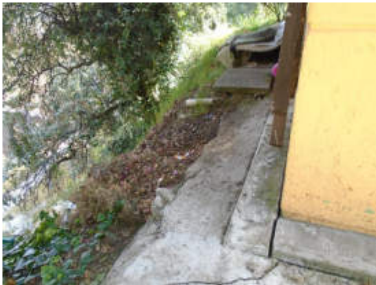
Figura 5.76. Fotografía B de la sección dos (7.2) del polígono de peligro Tarango. Se aprecia una construcción ubicada a un costado de una ladera compuesta de material inestable. Parte de la losa presenta fracturamiento (19.3594° N, 99.2127° W. Calle: Tarango).
