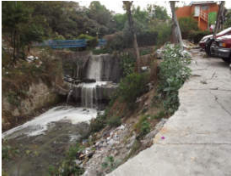
Figura 5.69. Fotografía B de la sección tres (6.3) del polígono de peligro Río Becerra. En esta fotografía se observa que debido a un derrumbe reciente en uno de los flancos de la barranca, la banquetta se encuentra fracturada y presenta colapso parcial; asimismo, los árboles presentan una ligera inclinación por la remoción del material (19.3826° N, 99.2219° W. Calle: Jalalpa).
