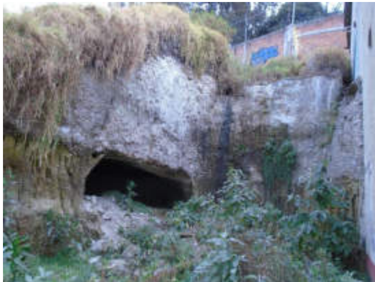
Figura 117. Fotografía A de la sección dos (13.2) del polígono de peligro Tacubaya. Cavidad bajo un talud que está compuesto de material no consolidado. Al centro de la fotografía se distingue acumulación del material que ha sido removido por la erosión y la pendiente del talud (19.3854° N, 99.2299° W. Calle: Estrella de Belén).
