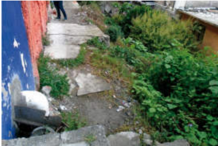
Figura 5.137. Fotografía A del polígono de peligro La Cañada. En la fotografía se puede observar que la banqueta adyacente a la pendiente presenta colapsos y fracturas, debido a la pérdida de basamento por la caída del material hacia la pendiente (19.3807° N, 99.2263° W. Calle: Vista Alegre).
