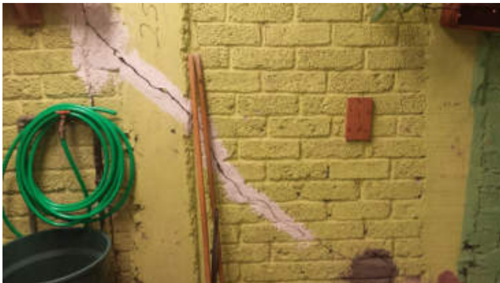
Figura 5.72. Fotografía A de la sección uno (7.1) del polígono de peligro Tarango. Construcción de mampostería que presenta una fractura diagonal con más de 3 mm de apertura, la cual cruza por completo el muro de carga y el castillo, debido a la pérdida de material en el basamento por remoción. También puede observarse que fue colocado un testigo para monitorear la fractura, el cual ya muestra separación (19.3522° N, 99.2221° W. Calle: Primera Cerrada de Tarango).
