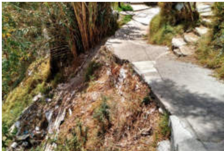
Figura 5.83. Fotografía A de la sección dos (8.2) del polígono de peligro Puerta Grande. Se observa un talud de materiales no consolidados parcialmente cubierto de vegetación, del cual se desprendió una porción, causando el colapso parcial de la vía pública (19.3517° N, 99.2373° W. Calle: 1.ª Cerrada).
