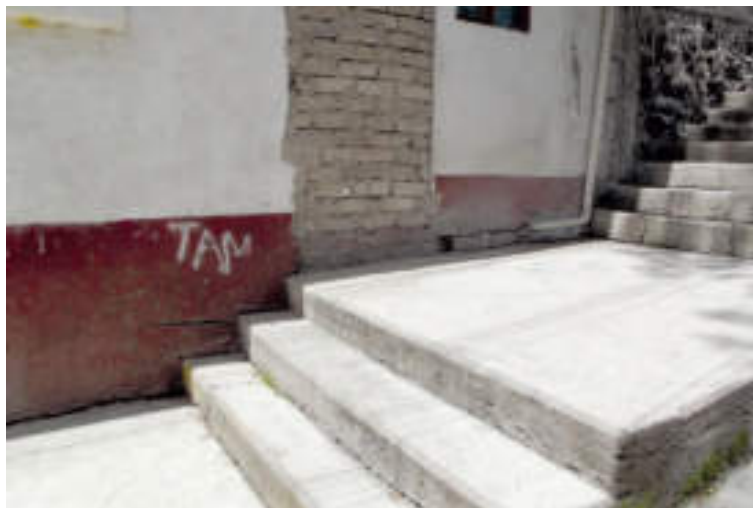
Figura 5.79. Fotografía A de la sección uno (8.1) del polígono de peligro Puerta Grande. Construcción desplantada en el flanco de uno de los afluentes de la barranca. Se distingue una fractura con apertura considerable, lo que indica que la escalera está separándose del muro frontal de las viviendas en dirección de la pendiente (19.3518° N, 99.2414° W. Calle: Cerrada Tecolcotla).
