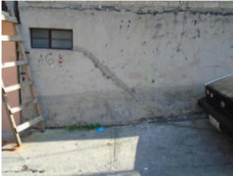
Figura 5.175. Fotografía A del polígono de peligro Las Golondrinas. Fotografía que muestra una fractura que atraviesa diagonalmente un muro; se puede observar que la fractura continua por la calle. También se puede distinguir una separación entre la parte baja de la vivienda y la calle, lo cual indica que existe un hundimiento relacionado a estructuras de mina (19.3771° N, 99.2157° W. Calle: Grullas).
