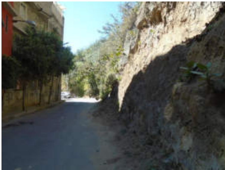
Figura 5.94. Fotografía B del polígono de peligro Lomas de Tarango. Se observa un talud con una pendiente casi vertical, que por su composición presenta derrumbes constantemente. Al pie del talud, se distingue la acumulación del material que ha caído (19.3605° N, 99.2203° W. Calle: Paseo de los Olmos).
