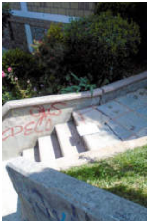
Figura 5.41. Fotografía B de la sección dos (4.2) del polígono de peligro Guadalupe. Se puede apreciar las escaleras de la entrada de una vivienda, las cuales se encuentran fracturadas a causa de la continua remoción del material (19.3206° N, 99.2641° W. Calle: Emiliano Zapata).
