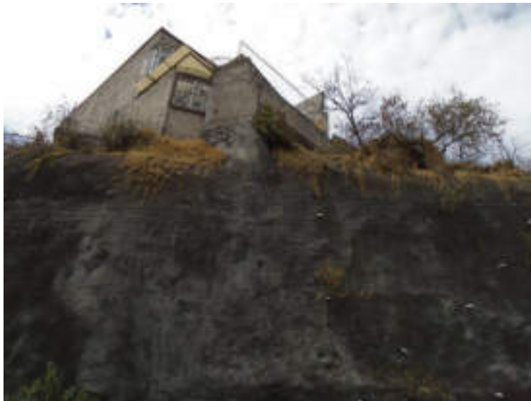
Figura 5.135. Fotografía B del polígono de vulnerabilidad Corpus Christy. Vivienda desplantada a orillas de un talud, el cual está cubierto de concreto lanzado. La vivienda asentada sobre el talud presenta un colapso parcial en su estructura, de lo cual solo alcanza a preservar una parte de los cimientos y del muro. (19.3618° N, 99.2456° W. Calle: San Isidro Alto Lerma).
