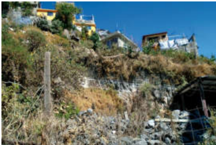
Figura 5.126. Fotografía B del polígono de peligro Santa Lucía. Construcciones desplantadas en la orilla de una ladera, la cual se encuentra invadida por vegetación (19.3570° N, 99.2511° W. Calle: sin nombre oficial).
