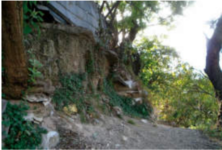
Figura 5.53. Fotografía B del polígono de peligro de Loma Nueva. Se aprecia un pequeño talud vertical a un costado de un camino de terracería, sobre el cual hay una construcción; en el talud se han colocado costales rellenos apilados para impedir el desplazamiento del terreno. Del lado izquierdo de la fotografía se observa la erosión del material (19.3664° N, 99.2174° W. Calle: Andador 1).
