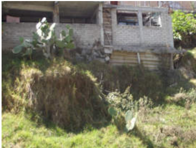
Figura 5.102. Fotografía C de la sección uno (11.1) del polígono de peligro Río Mixcoac. Se observan un par de viviendas en construcción desplantadas sobre un talud inestable. La vivienda del lado derecho presenta problemas de erosión en su basamento, lo cual ha provocado un volado; la viga inferior se encuentra trozada y desplazada, la cual es sostenida solamente por polines (19.3579° N, 99.2466° W. Calle: Babieca 2).
