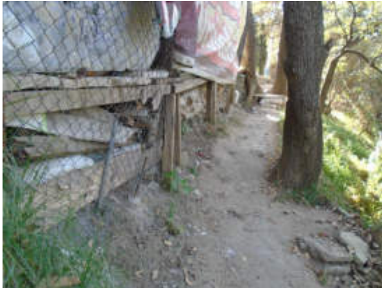
Figura 5.91. Fotografía B del polígono de vulnerabilidad Tierra Nueva. Se puede observar una construcción hecha de materiales precarios desplantada a la orilla de un talud, la cual está cimentada únicamente con polines de madera y costales rellenos apilados, lo que la pone en riesgo de sufrir daños ante los derrumbes y deslizamientos; en la esquina superior derecha de la fotografía, se distingue un árbol que presenta inclinación en dirección a la pendiente (19.3545° N, 99.2499° W. Calle: sin nombre oficial)
