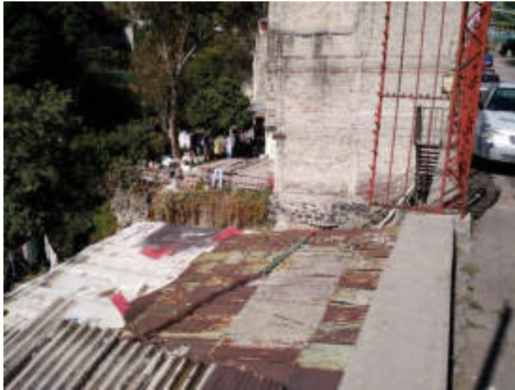
Figura 5.109. Fotografía B de la sección uno (12.1) del polígono de peligro El Moral. En la fotografía se encuentran algunas viviendas asentadas sobre la ladera; se puede observar al centro que los cimientos de una de las viviendas son los materiales que componen a la ladera, los cuales ya presentan erosión a causa de la vegetación y otros agentes ambientales (19.3428° N, 99.2131° W. Calle: 4).
