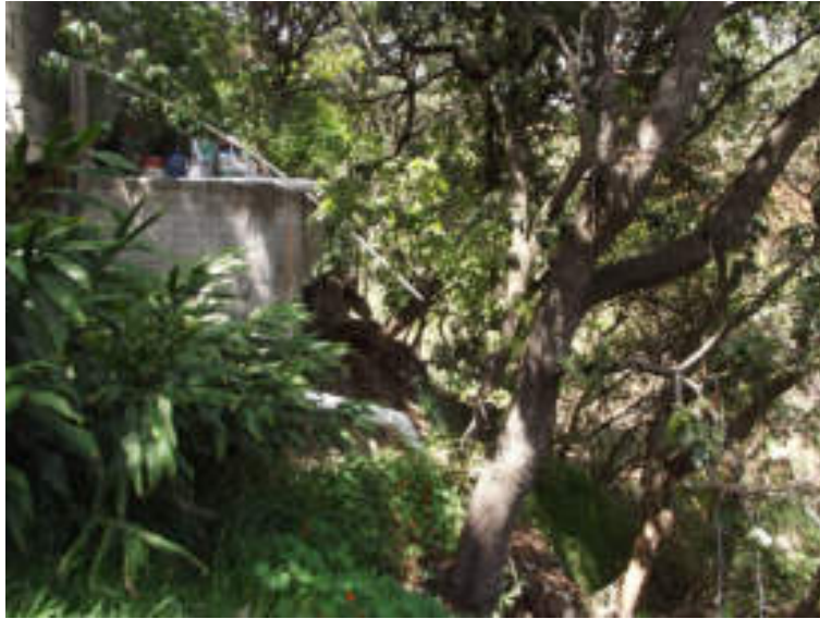
Figura 5.170. Fotografía B de la sección uno (20.1) del polígono de peligro Parque La Loma. Se observa que los árboles del talud presentan una inclinación con dirección hacia la pendiente debido a la inestabilidad del material; esto afecta a la construcción que se distingue a la izquierda de la fotografía por la pérdida de basamento, haciéndola vulnerable ante los procesos de remoción en masa (19.3314° N, 99.2431° W. Calle: sin nombre oficial).
