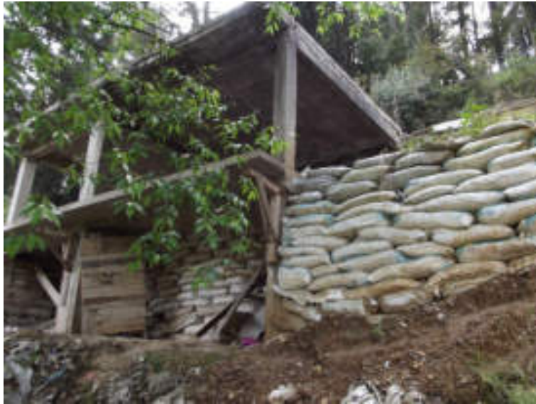
Figura 5.161. Fotografía B de la sección uno (19.1) del polígono de peligro Atzoyapan. Costales rellenos de material in situ apilados con el fin de detener los materiales inestables en uno de los flancos de la barranca; asimismo, los costales funcionan como cimientos de la construcción desplantada en la orilla de la ladera (19.3255° N, 99.2821° W. Calle: sin nombre oficial).
