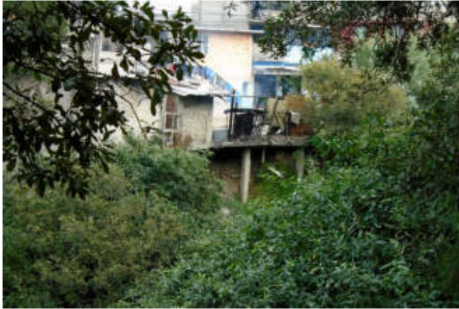
Figura 5.24. Fotografía C de la sección dos (2.1) del polígono de peligro Texcalatlaco. Vivienda en el flanco de la barranca, construida sobre costales rellenos apilados y sobre castillos como pilares que sostienen el piso, al centro se puede observar la erosión y pérdida del material del basamento, así como la inclinación del piso de cemento (19.3274° N, 99.2494° W. Calle: Heliotropos).
