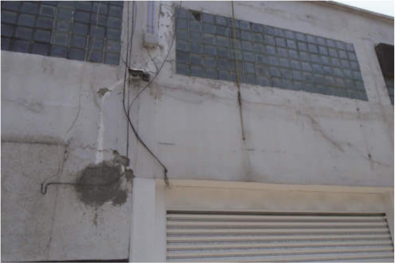
Figura 5.43 Fotografía E (Imagen 6), que muestra una estructura semiconfinada de mampostería con acabado dañado, se aprecia una fractura horizontal debajo de la ventana y en la parte superior de la cortina (19.4987125359° N, 99.1563782502° W. Calle: Poniente 146).
