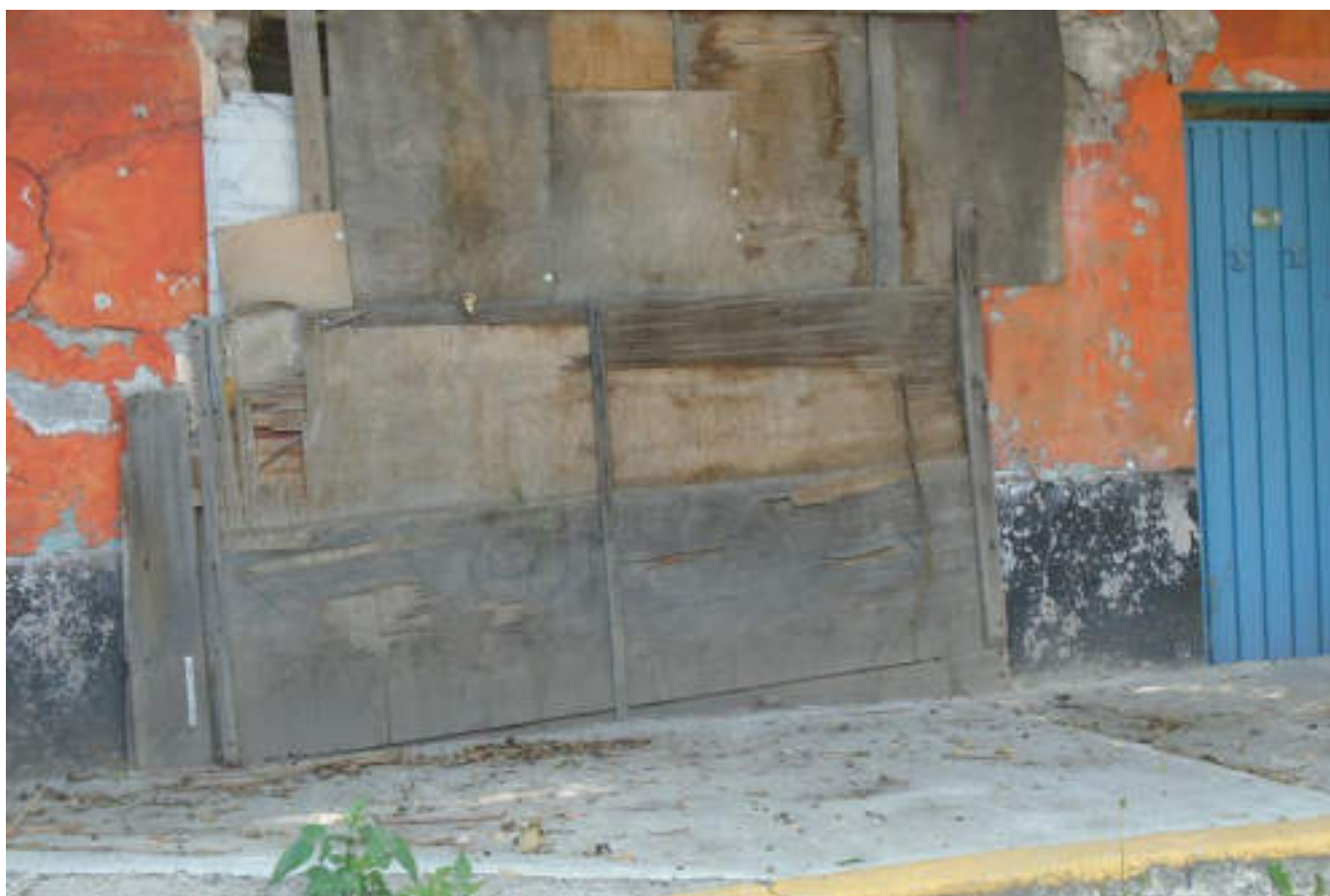
Figura 5.281. Fotografía A (Imagen 49), en ella se muestra una edificación de mampostería sin confinar con desprendimientos parciales de acabados, el muro fue demolido de forma incorrecta, provocando fracturamiento a ambos lados de la demolición (19.4690694574° N, 99.1583081853° W. Calle: Antonio Valeriano).
