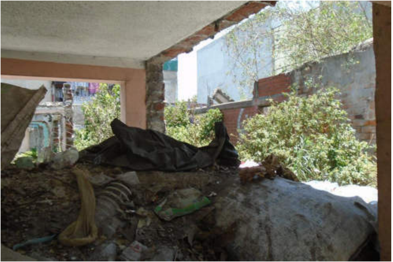
Figura 5.33. Fotografía B (Imagen 5), en la que se observa la demolición de muro de mampostería, lo que debilita la estructura siendo propensa a un colapso (19.5060° N, 99.1759° W. Calle: Lázaro Cárdenas).
