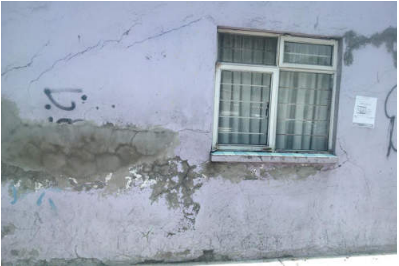
Figura 5.116. Fotografía F (Imagen 17), se muestra un muro de mampostería no confinado que presenta fracturas diagonales en las esquinas de las ventanas, así como repellado sobre una fractura en la parte inferior de la ventana y en la parte izquierda del muro (19.4906824638° N, 99.1760576337° W. Calle: 4 Norte (Calzada Azcapotzalco-La Villa)).
