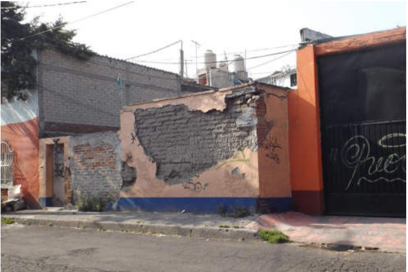
Figura 5.251. Fotografía B (Imagen 42), construcción de mampostería no confinada con desprendimiento del aplanado de concreto, tiene una fractura horizontal en la parte superior de los muros y desprendimiento de tabiques en la esquina superior izquierda de la estructura (19.4802° N, 99.1918° W. Calle: San Francisco).
