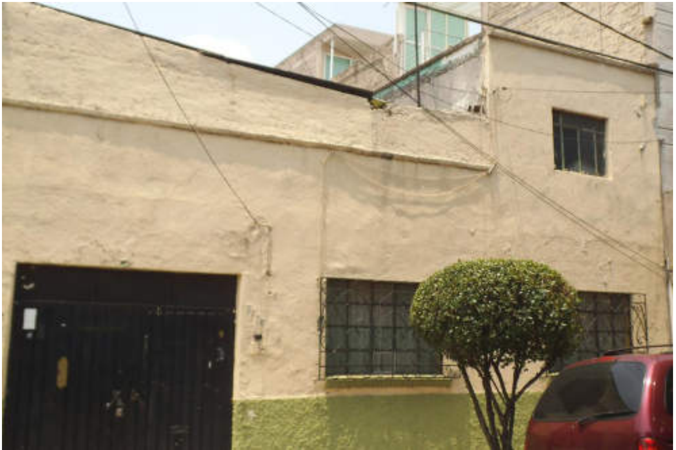
Figura 5.283. Fotografía C (Imagen 49), se muestra una construcción de mampostería, la que presenta un deterioro en el aplanado de concreto, en la parte superior se aprecia el desprendimiento del material que conforma el pretil (19.4715930858° N, 99.1585184483° W. Calle: 5).
