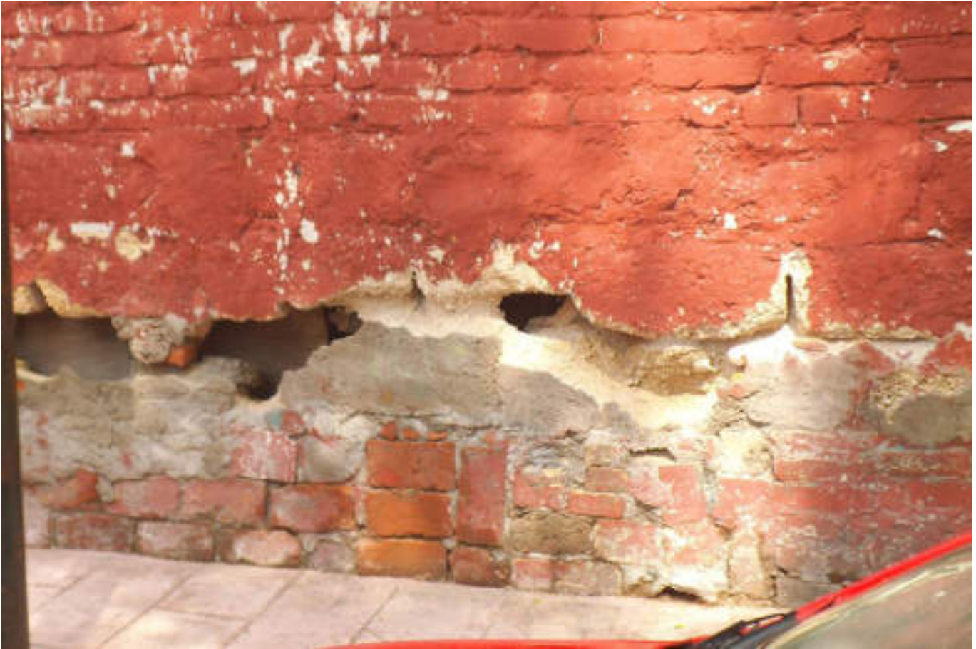
Figura 5.262. Fotografía B (Imagen 44), se muestra el muro exterior de predio, el cual está constituido por ladrillos rojos recocidos y piezas de adobe, estas últimas se desprendieron y presentan deterioro (19.4718° N, 99.1866° W. Calle: Plaza San Lucas).
