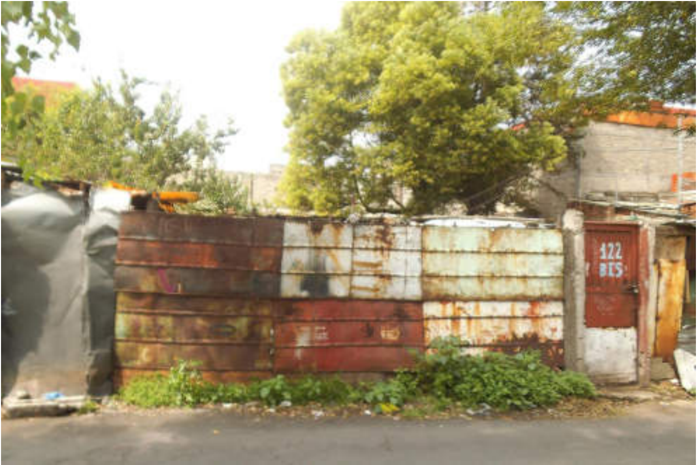
Figura 5.265. Fotografía E (Imagen 44), vivienda precaria, la construcción es a base de láminas que no presentan soporte de alguna (19.4713° N, 99.1828° W. Calle: San Lucas).
