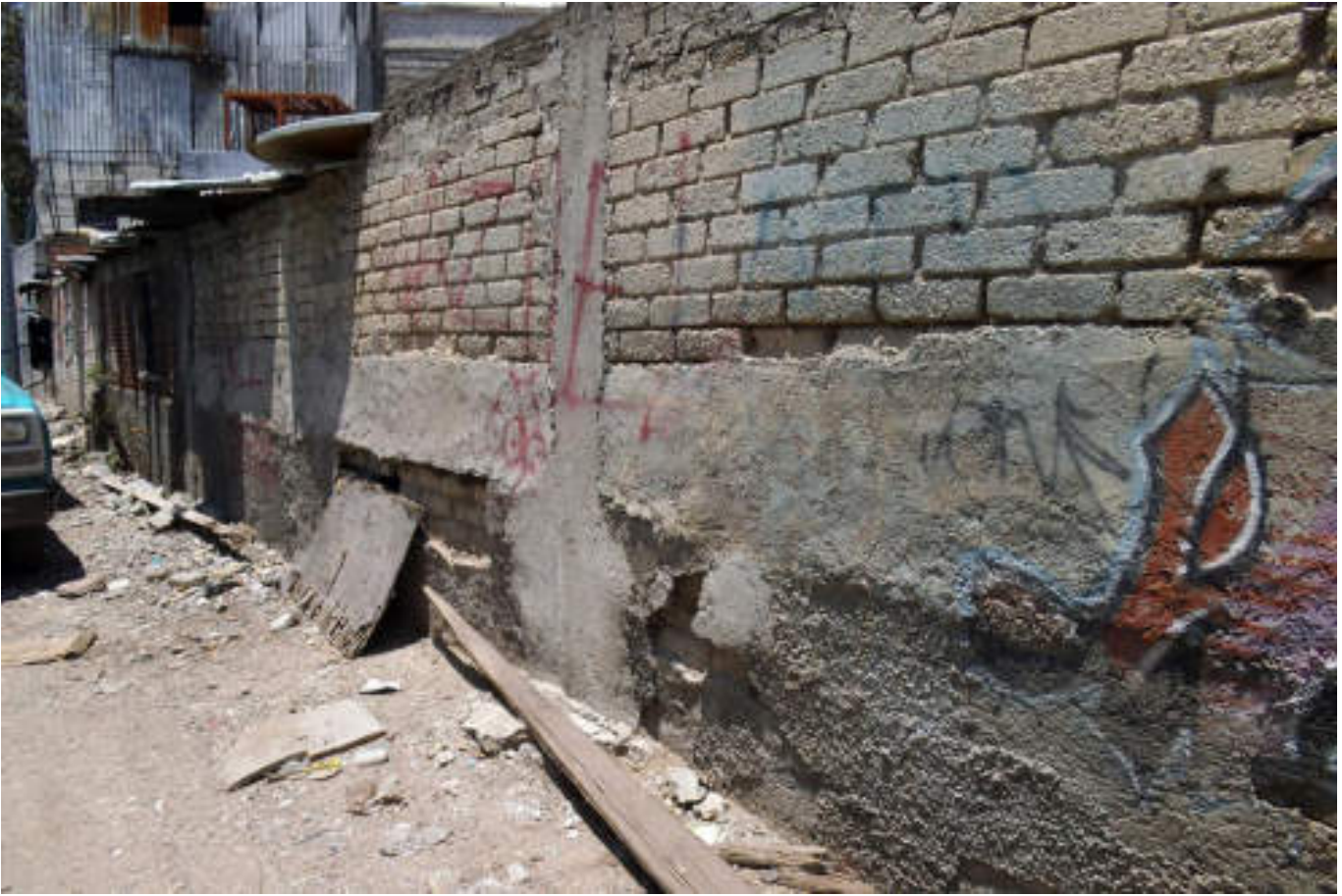
Figura 5.178. Fotografía E (Imagen 28a), Fotografía en la que se observa el muro exterior de una vivienda, el cual presenta desprendimiento de material de construcción (19.4888° N; 99.1655° W. Calle: Maíz).
