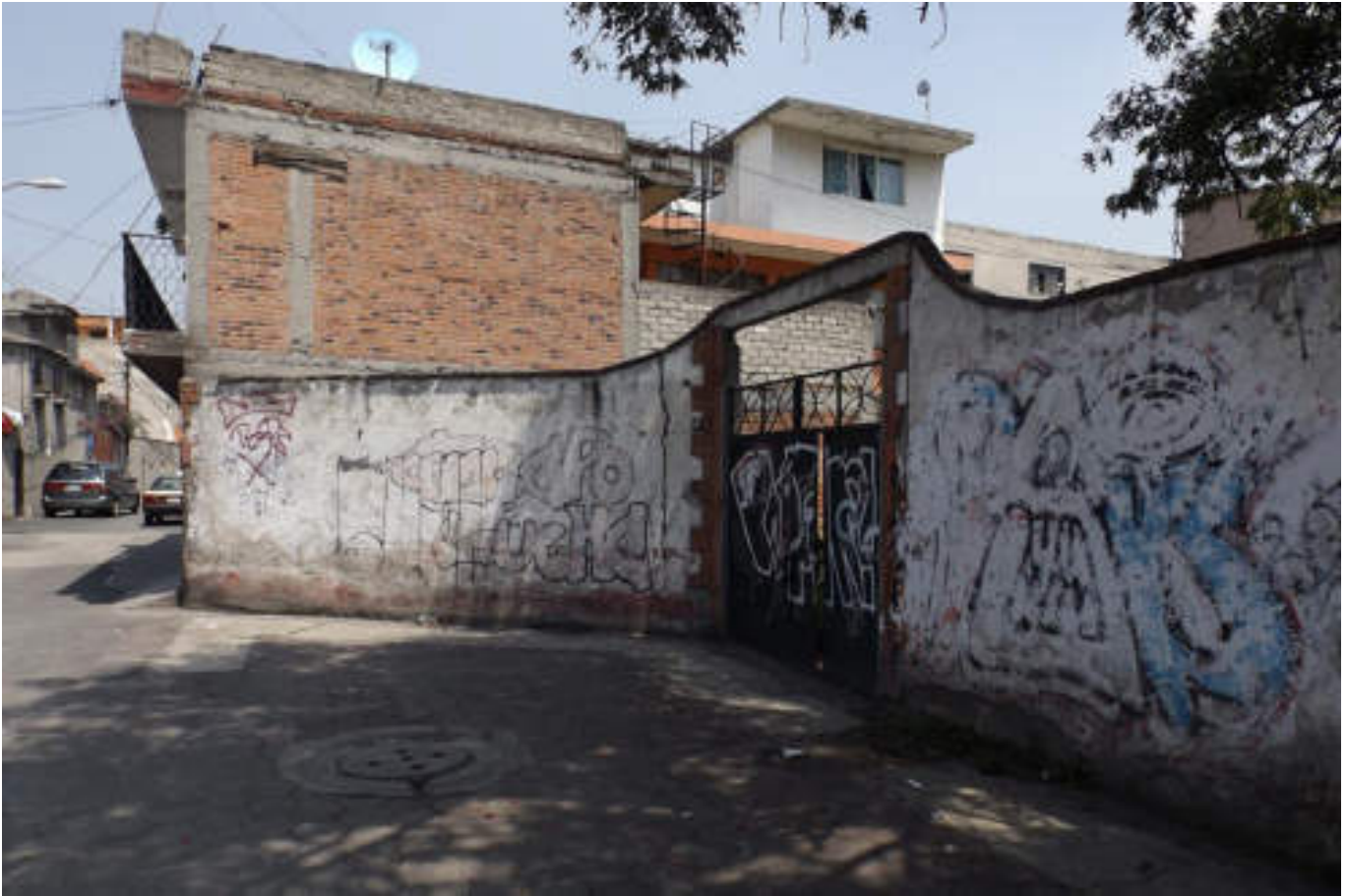
Figura 5.86. Fotografía D (Imagen 13), en ella se muestra una estructura de mampostería sin confinar que presenta múltiples fracturas verticales las cuales provocan la separación del elemento estructural que a su vez dejan vulnerable la estructura (19.4981° N, 99.1869° W. Calle: Andador Nueva Galicia).
