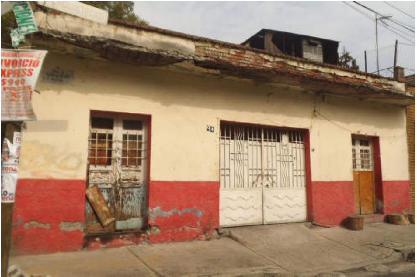
Figura 5.368. Fotografía C (Imagen 64), que muestra desprendimiento del acabado dejando al descubierto el material con que fue construido el inmueble, la parte más deteriorada es el pretil en donde ya son visibles los elementos de mampostería(19.4670° N, 99.1490° W. Calle: 12).
