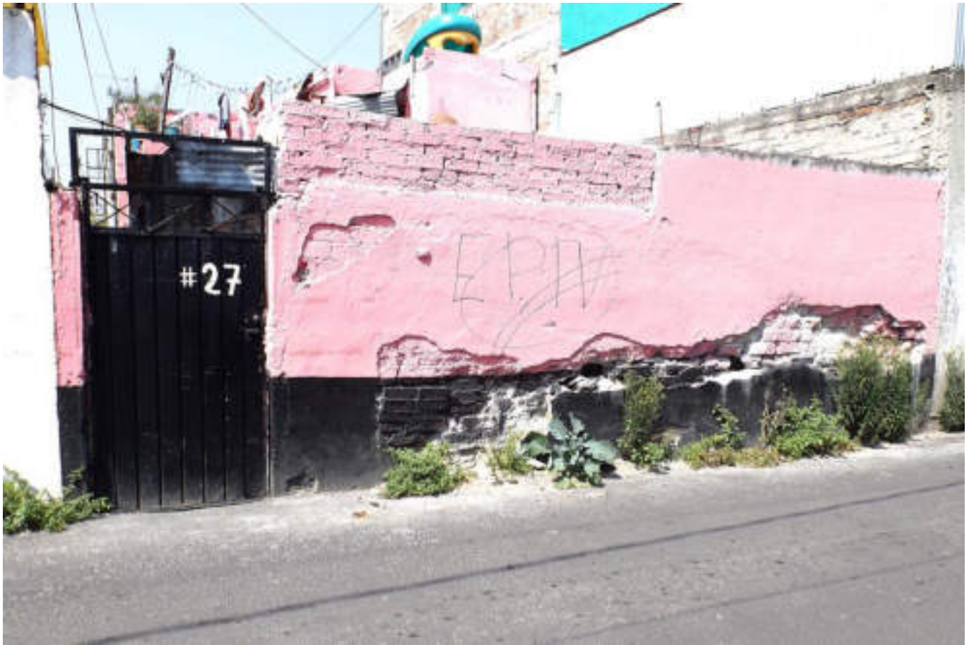
Figura 5.101. Fotografía E (Imagen 15), barda de mampostería no confinada con desprendimiento parcial del aplanado de concreto, el material constructivo se encuentra deteriorado y existe el desprendimiento de piezas (19.4912° N, 99.1860° W. Calle: Reynosa Tamaulipas).
