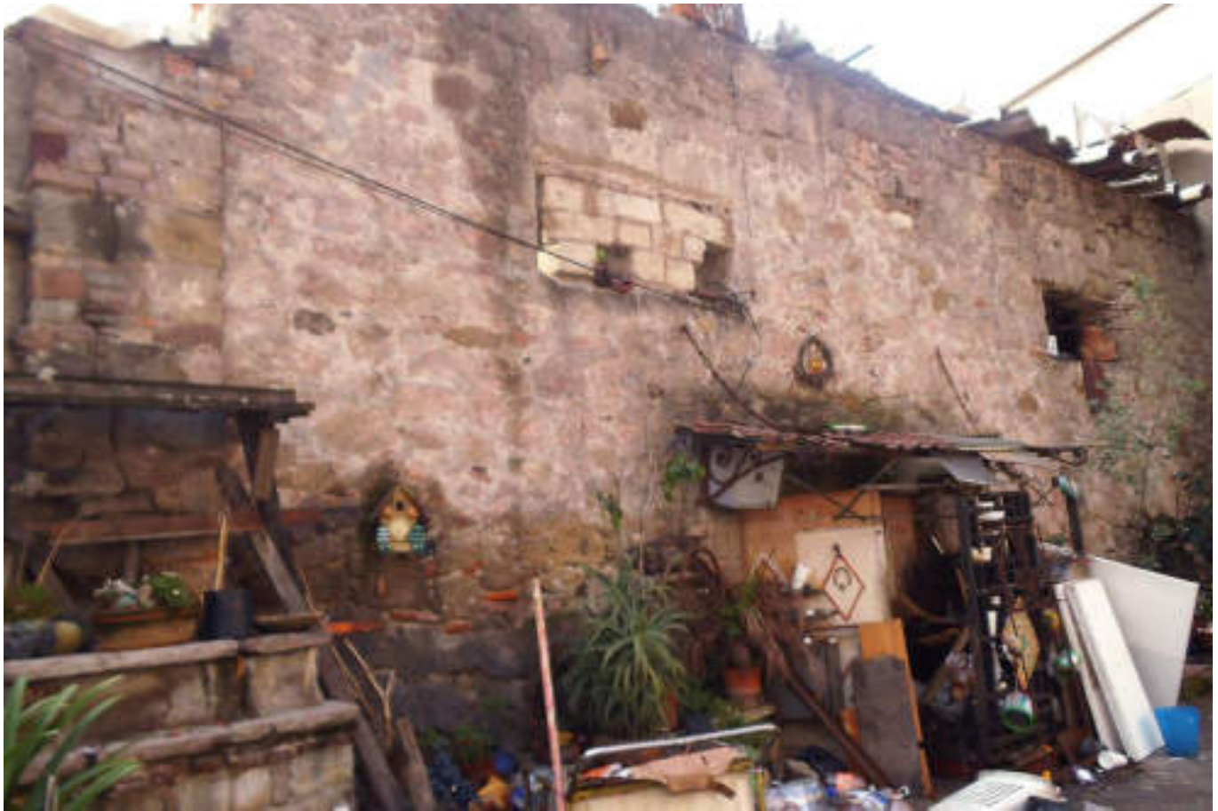
Figura 5.257. Fotografía B (Imagen 43), se muestra el muro de vivienda compuesto por distinto materiales entre ellos: ladrillo rojo recocido, tabicones y en su mayoría piedra braza con junteo de concreto simple; presenta fracturamiento en la zona del castillo formado por los mismos materiales (19.4775° N, 99.1875° W. Calle: Segunda La Concepción).
