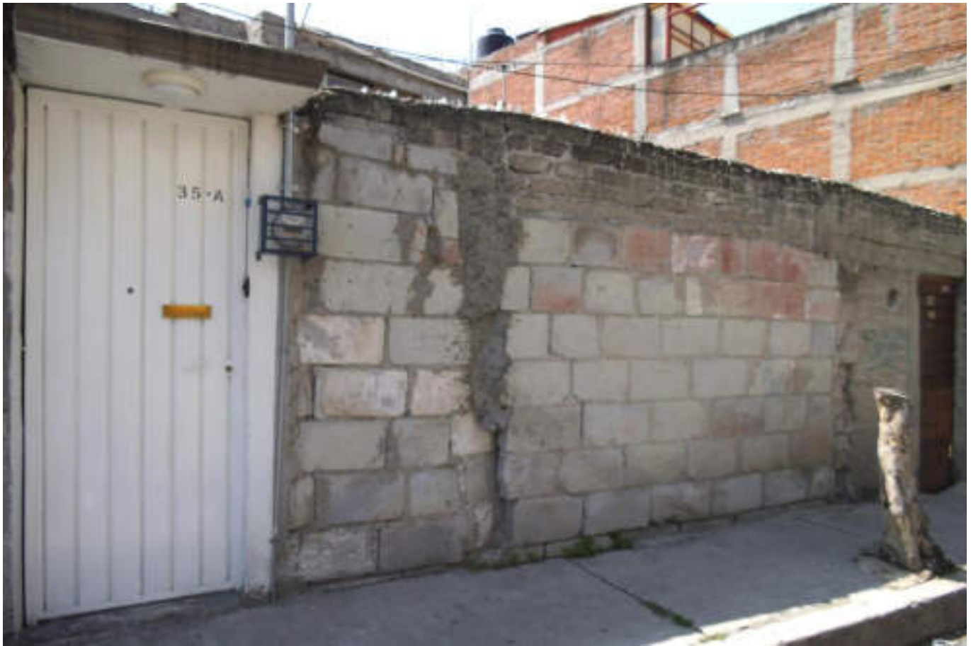
Figura 5.135. Fotografía C (Imagen 21), muro perimetral de una vivienda que no cuenta con la homogeneidad adecuada debido a la presencia de distintos materiales en su composición como: tabiques, existe un desplazamiento y por ende una ruptura en el muro el cual fue recubierto con un lanzado de concreto sin refuerzo (19.4890º N, 99.1972º W. Calle: Chalcas).
