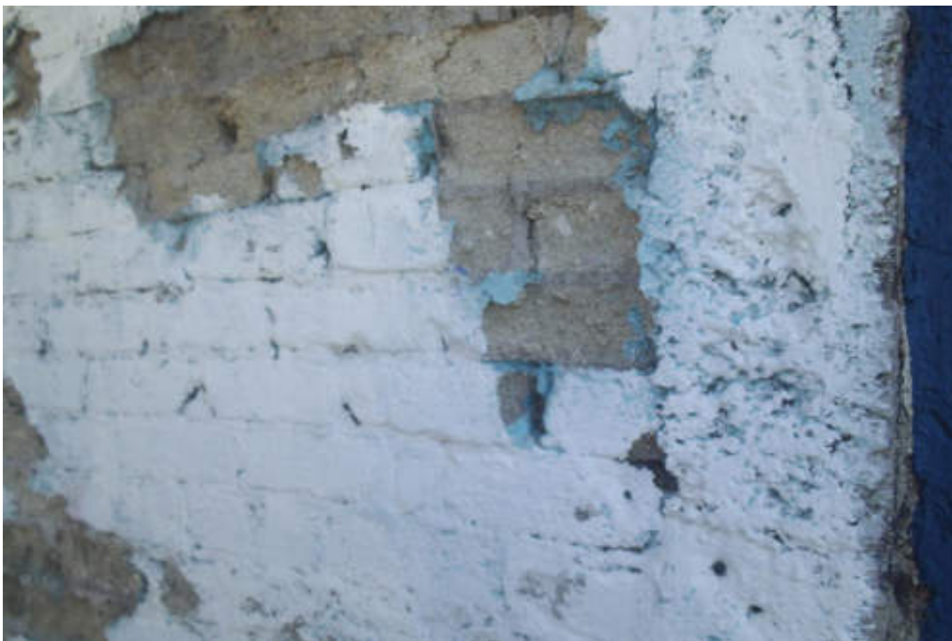
Figura 5.120. Fotografía A (Imagen 19), que muestra el desprendimiento de material constructivo provocando deterioro en el muro externo de la vivienda (19.4935° N; 99.2070° W. Calle: Lauro Villar).
