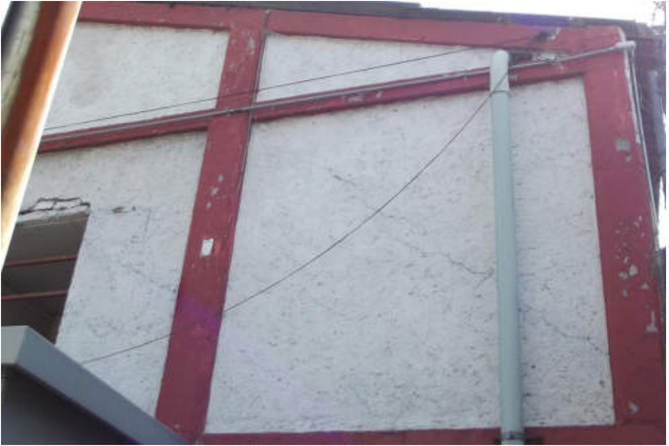
Figura 5.161. Fotografía B (Imagen 26), en la que se muestra una estructura de mampostería confinada, que presenta múltiples fracturas en diagonal y colapsos parciales en la parte superior del acceso que presenta la figura (19.4876° N, 99.1730° W. Calle: Cerrada Avenida de las Granjas).
