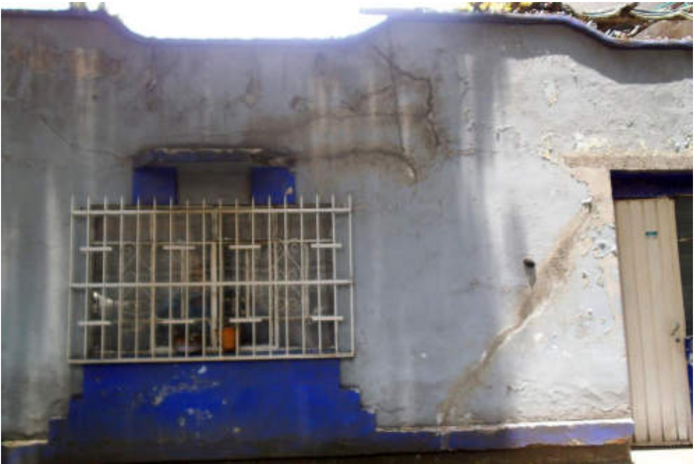
Figura 5.345. Fotografía B (Imagen 60), se muestra la fachada de una edificación que presenta una fractura diagonal, la cual ha sido reparada. En la parte superior de la ventana el muro presenta fracturas diagonales, horizontales y verticales, las cuales inciden en las esquinas de la marquesina. En lo general se observa deterioro en el acabado y presenta leve desprendimiento (19.4669° N, 99.1852° W. Calle: Pirámides).
