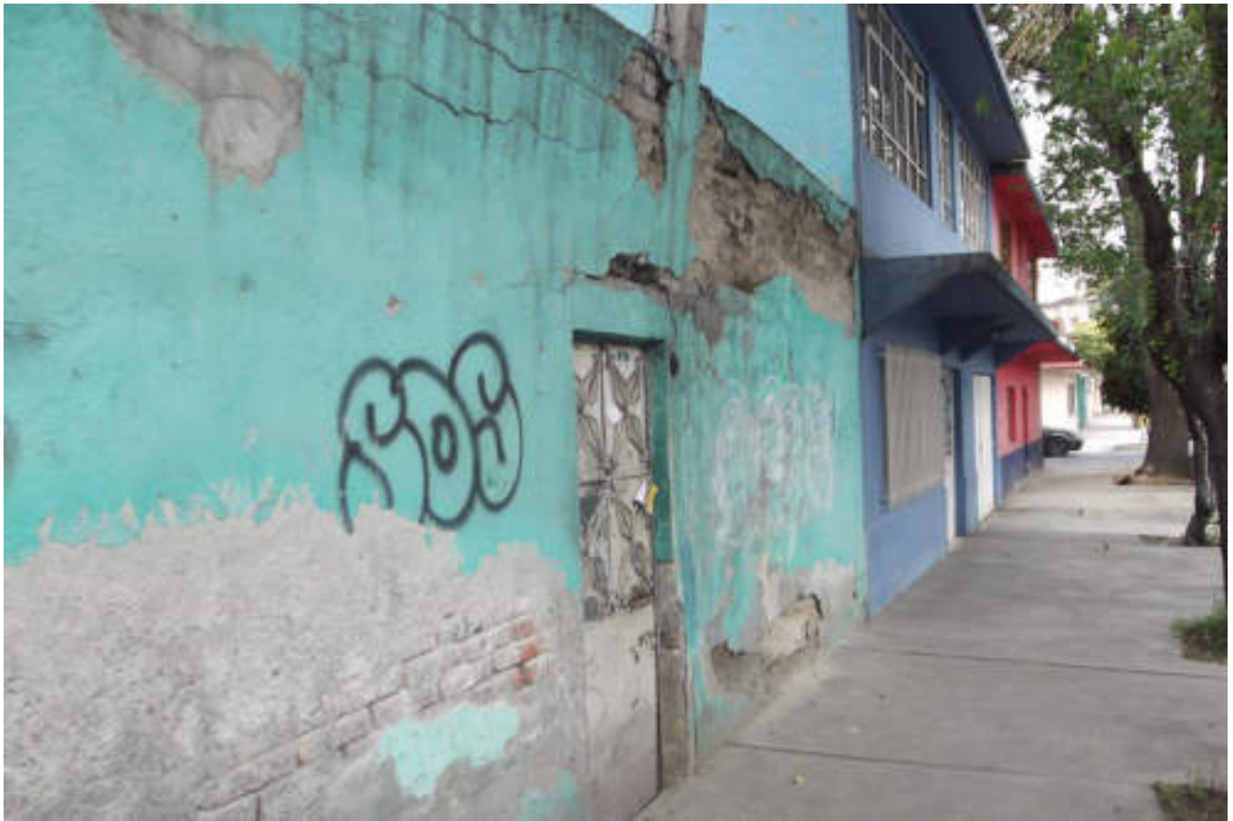
Figura 5.227. Fotografía B (Imagen 37), que muestra la fachada de una vivienda con presencia de fracturas y desprendimiento de material dejando al descubierto su estructura (19.4761° N, 99.1613° W. Calle: 15).
