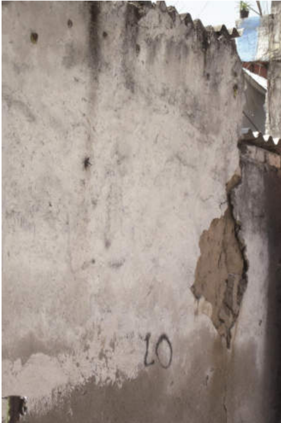
Figura 5.80. Fotografía C (Imagen 12), en la que se observan fracturas que ocasiona el desprendimiento del aplanado en el muro externo de la vivienda. Dicho muro está hecho a base de bloques de adobe (19.4941° N, 99.1907° W. Calle: Durazno).
