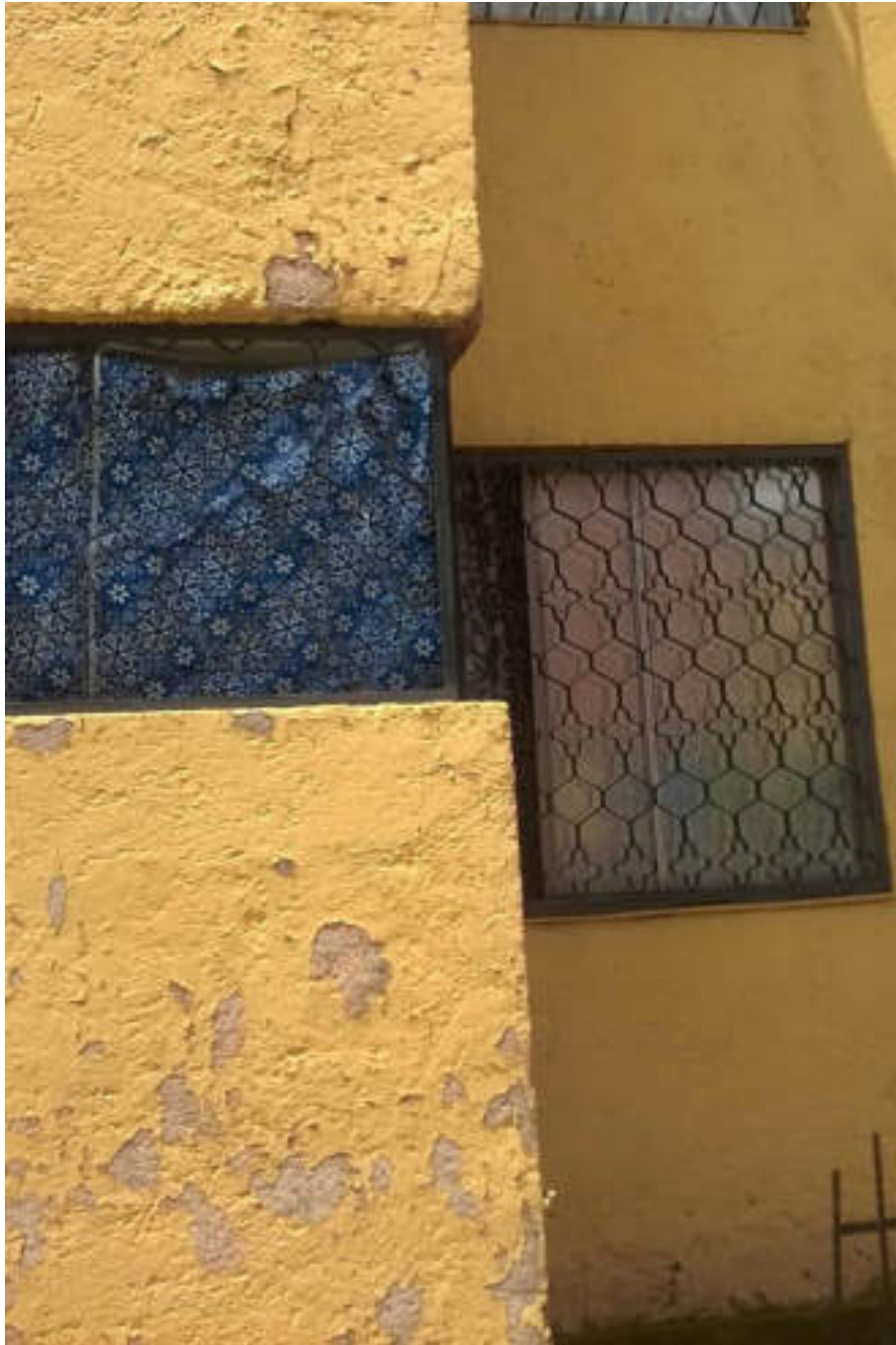
Figura 5.60. Fotografía F (Imagen 8), se muestra el fracturamiento en aplanado y muro de edificación, la fractura parte de la esquina superior derecha del marco de la ventana (19.4999° N, 99.1853° W. Calle: San Pablo Xalpa).
