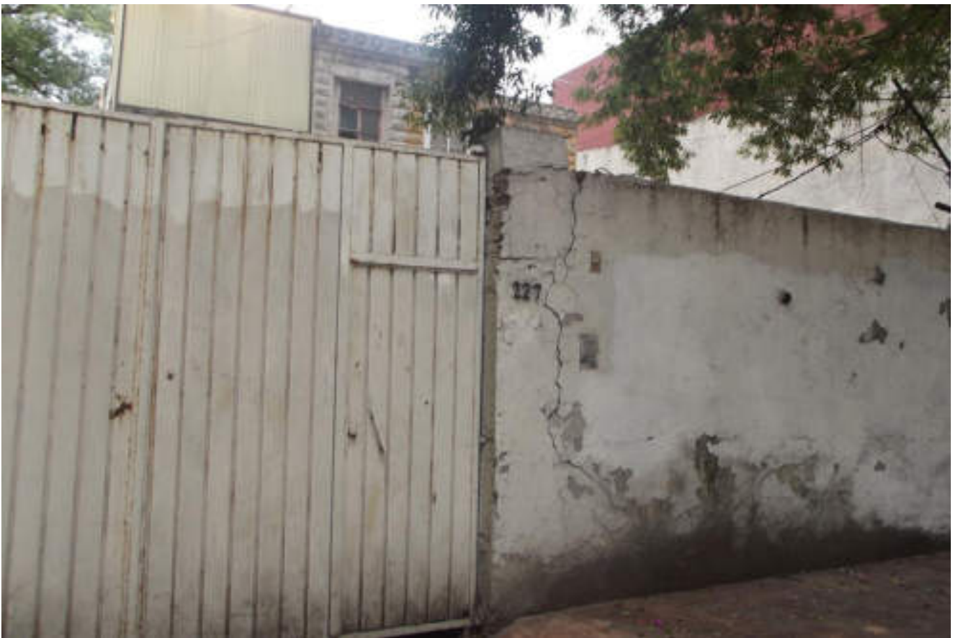
Figura 5.344. Fotografía A (Imagen 60), barda perimetral que presenta una fractura vertical entre el muro y la columna que sostiene la puerta (19.4672° N, 99.1873° W. Calle: Azcapotzalco).
