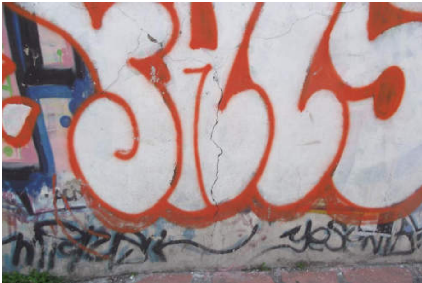
Figura 5.243. Fotografía A (Imagen 40), vivienda de mampostería semiconfinada con una fractura en el aplanado de concreto, la fractura inicia verticalmente en la parte inferior del muro y se ramifica hacia la parte superior del muro (19.4710° N, 99.1468° W. Calle: 9).
