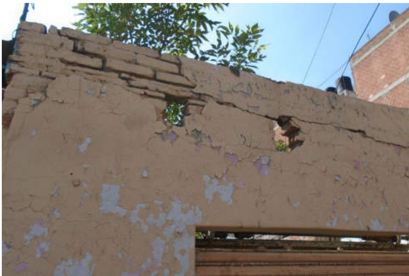
Figura 5.330. Fotografía A (Imagen 58), que muestra un inmueble con muros de mampostería sin confinamiento, el cual presenta una fractura horizontal que corta a los elementos que conforman al muro, observamos desprendimientos de piezas de mampostería y de acabado (19.4747° N, 99.1933° W. Calle: Santa Cruz Acayucan).
