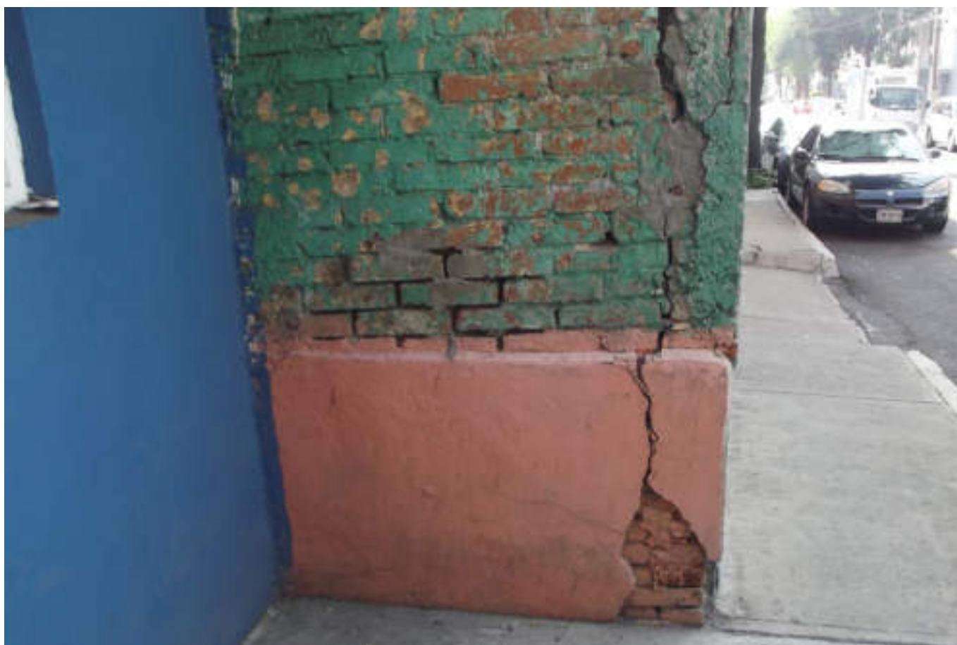
Figura 5.380. Fotografía A (Imagen 66), se muestra una fractura en forma vertical que va a lo largo del muro de mampostería, en algunas partes se observa que la junta constructiva de mortero se va disolviendo lo cual repercute en la rigidez del muro (19.4599° N, 99.1724° W. Calle: Poniente 44).
