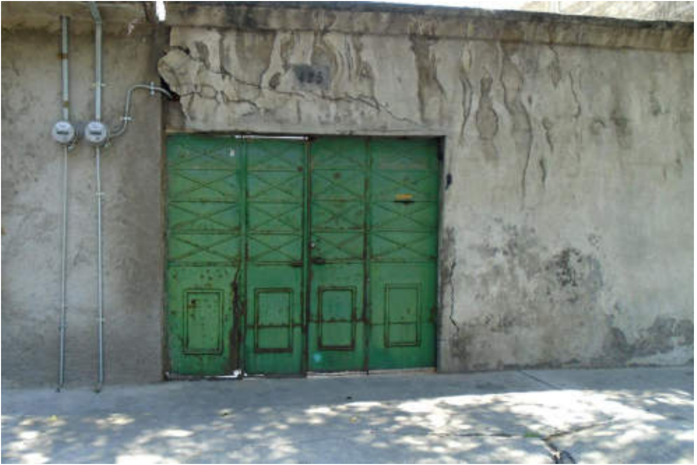
Figura 5.386. Fotografía D (Imagen 67), se aprecia una vivienda con fracturas en forma diagonal, horizontal y vertical en gran parte del muro, así como desprendimiento de los acabados (19.4569° N, 99.1657° W. Calle: Almendros).
