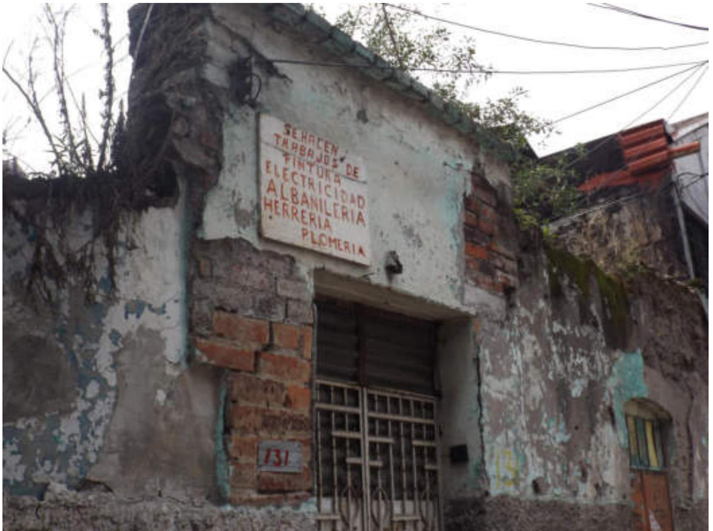
Figura 5.204. Fotografía F (Imagen 33), muro exterior de vivienda con un ancho prominente, compuesto por distintos materiales como ladrillos, tabiques y algunas piezas de adobe, el cual por falta de mantenimiento ha sido afectado y deteriorado por el intemperismo al que se encuentra expuesto (19.4792° N, 99.1848° W. Calle: Belisario Domínguez).
