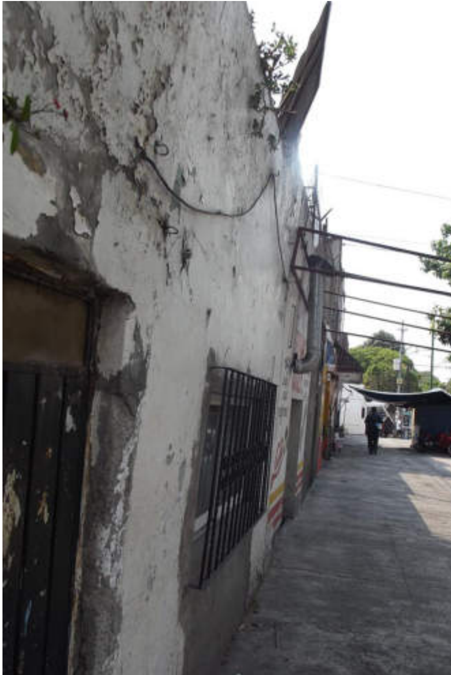
Figura 5.231 Fotografía F (Imagen 37), vivienda de mampostería semiconfinada que presenta desprendimiento de material en los límites con la puerta, además de una modificación para la instalación de una ventana (19.4752° N, 99.1624° W. Calle: Ceylán).
