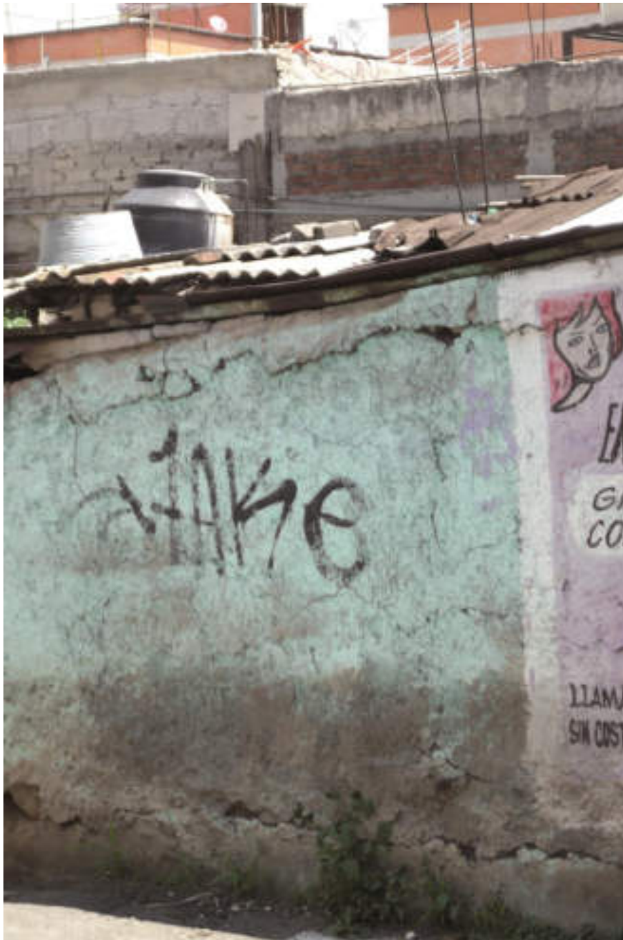
Figura 5.78. Fotografía A (Imagen 12), donde se observa una construcción rudimentaria, no confinada con fracturas que recorren toda su longitud. El aplonado tiene presencia de fracturas (19.4962° N, 99.1897° W. Calle: Amores).
