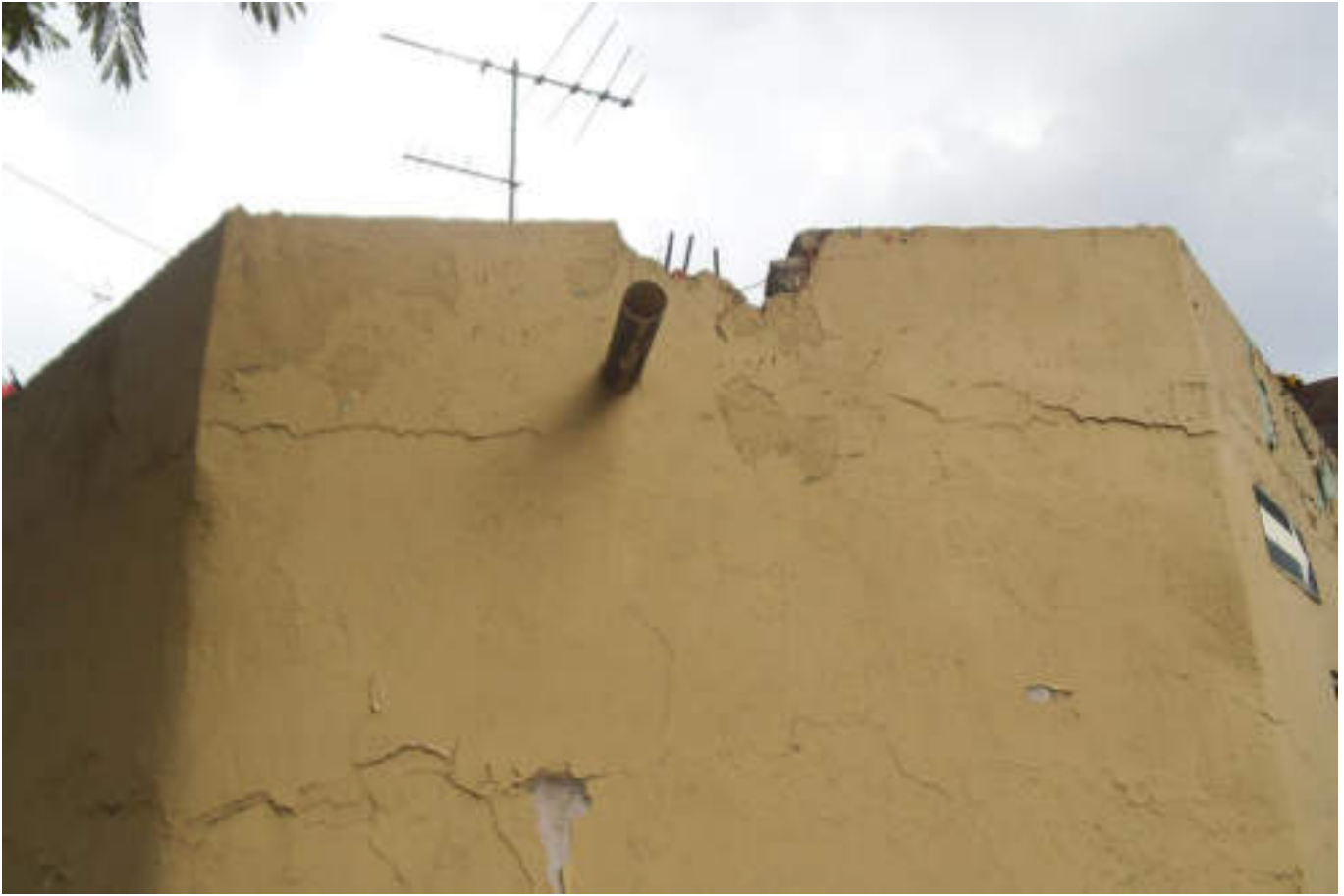
Figura 5.221. Fotografía B (Imagen 36), muro exterior de una vivienda con presencia de fracturas y desprendimiento de material constructivo en el pretil ubicado en la azotea (19.4767° N, 99.1756° W. Calle: Salomón).
