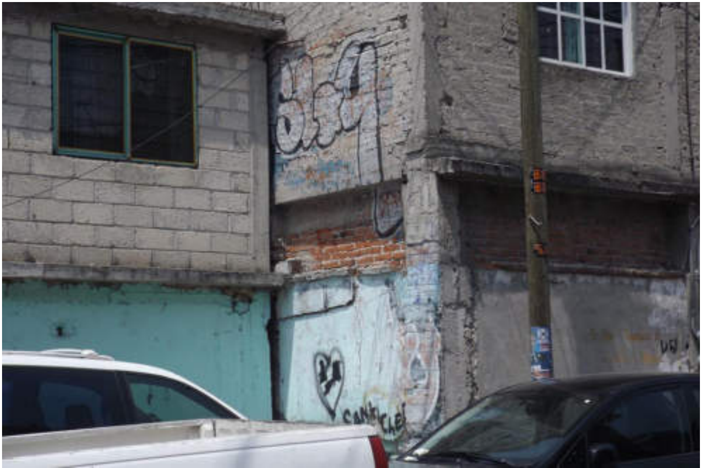
Figura 5.85. Fotografía C (Imagen 13), que muestra una estructura de mampostería sin confinar que fue construida con un mal proceso constructivo. Se en la vivienda del lado derecho que la columna del segundo nivel es más esbelta que la columna en la que está apoyada que a su vez, la vivienda tiene una fractura horizontal en el muro lateral de la estructura que provoca la separación del elemento estructural (19.4981° N, 99.1881° W. Andador: Nueva Galicia).
