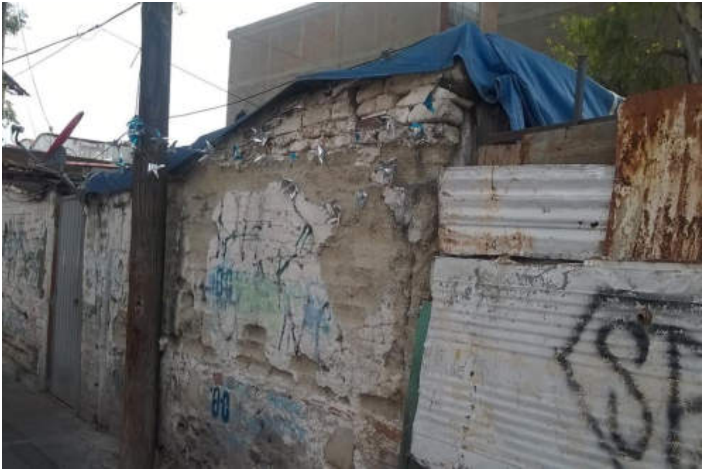
Figura 5.218. Fotografía C (Imagen 35), inmueble no confinado, se presenta un alto deterioro en los tabiques, ya que no hay recubrimiento o aplanado en la construcción. Los materiales y procesos constructivos no son los adecuados lo que ocasiona que la vivienda tenga mayores daños (19.4754° N, 99.1814° W. Calle: Segunda Tula).
