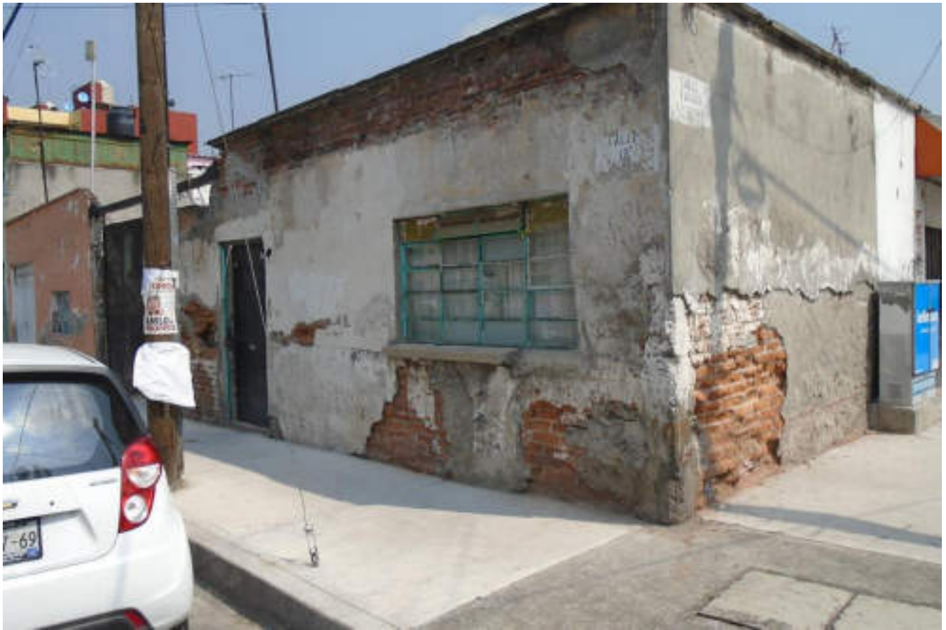
Figura 5.367. Fotografía B (Imagen 65), en ella se muestra una construcción de mampostería sin confinar que presenta desprendimientos parciales de acabados, erosión y de degradación del elemento estructural, a su vez se aprecia la falta de la dala de cerramiento que fue sustituida por un perfil de acero en la entrada principal (19.4672371114° N, 99.1483597325° W. Calle: Yaquis).
