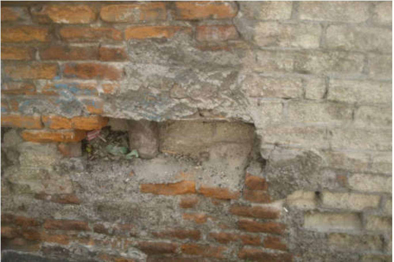
Figura 5.113. Fotografía C (Imagen 17), se muestra un muro de mampostería que presenta diferentes procesos constructivos. La parte izquierda el muro está hecho con ladrillos rojos deteriorados debido a la corrosión, el extremo derecho está conformado por tabique de concreto de baja calidad lo que contribuye a la erosión del mismo, los materiales de la estructura presentan mala adherencia entre estos, originando orificios en el muro (19.4936178853° N, 99.1773680345° W. Calle: Tepetlapa).
