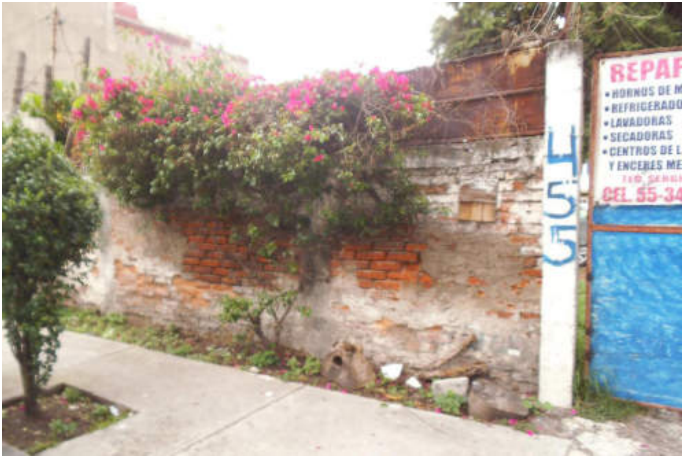
Figura 5.222. Fotografía C (Imagen 36), se muestra un muro perimetral confinado a base de ladrillo rojo recocido, el cual presenta desprendimiento de aplanado, es visible un mal proceso constructivo y la baja calidad de los materiales (19.4750° N, 99.1769° W. Calle: Norte 81-A).
