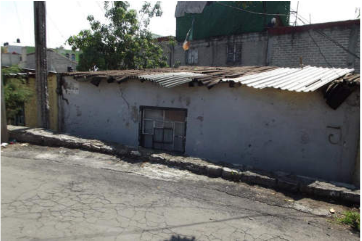
Figura 5.92. Fotografía C (Imagen 14), construcción semiconfinada la cual presenta fracturamiento en la parte superior de la vivienda hasta el marco de la ventana, cabe señalar que la vivienda se encuentra bajo el nivel de la calle (19.4946° N, 99.1890° W. Calle: Antiguo Camino Real de San Martín).
