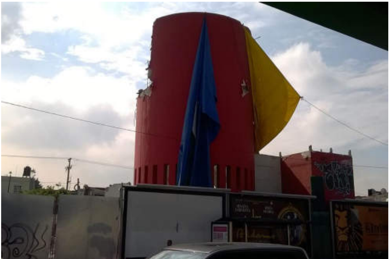
Figura 5.256. Fotografía A (Imagen 43), torre cilíndrica de concreto armado con presencia de demolición en la zona superior ( 19.4781^{\circ} N, 99.1883^{\circ} W. Calle: Centenario).
