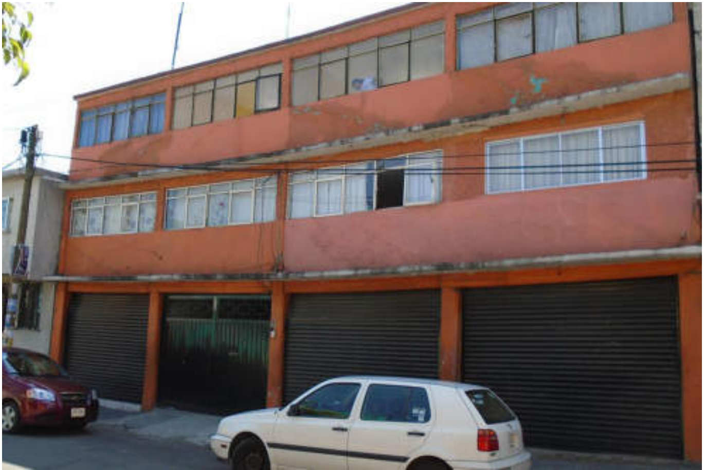
Figura 5.303. Fotografía C (Imagen 52), se observa una vivienda que presenta fracturas diagonales en toda la parte inferior de las ventanas del segundo nivel, de igual manera en el tercer nivel se observan fracturas diagonales sólo que estas van acompañadas de humedad, se puede apreciar un pandeo general de todo el inmueble (19.4752° N, 99.2194° W. Calle: Leopoldo Blackaller).
