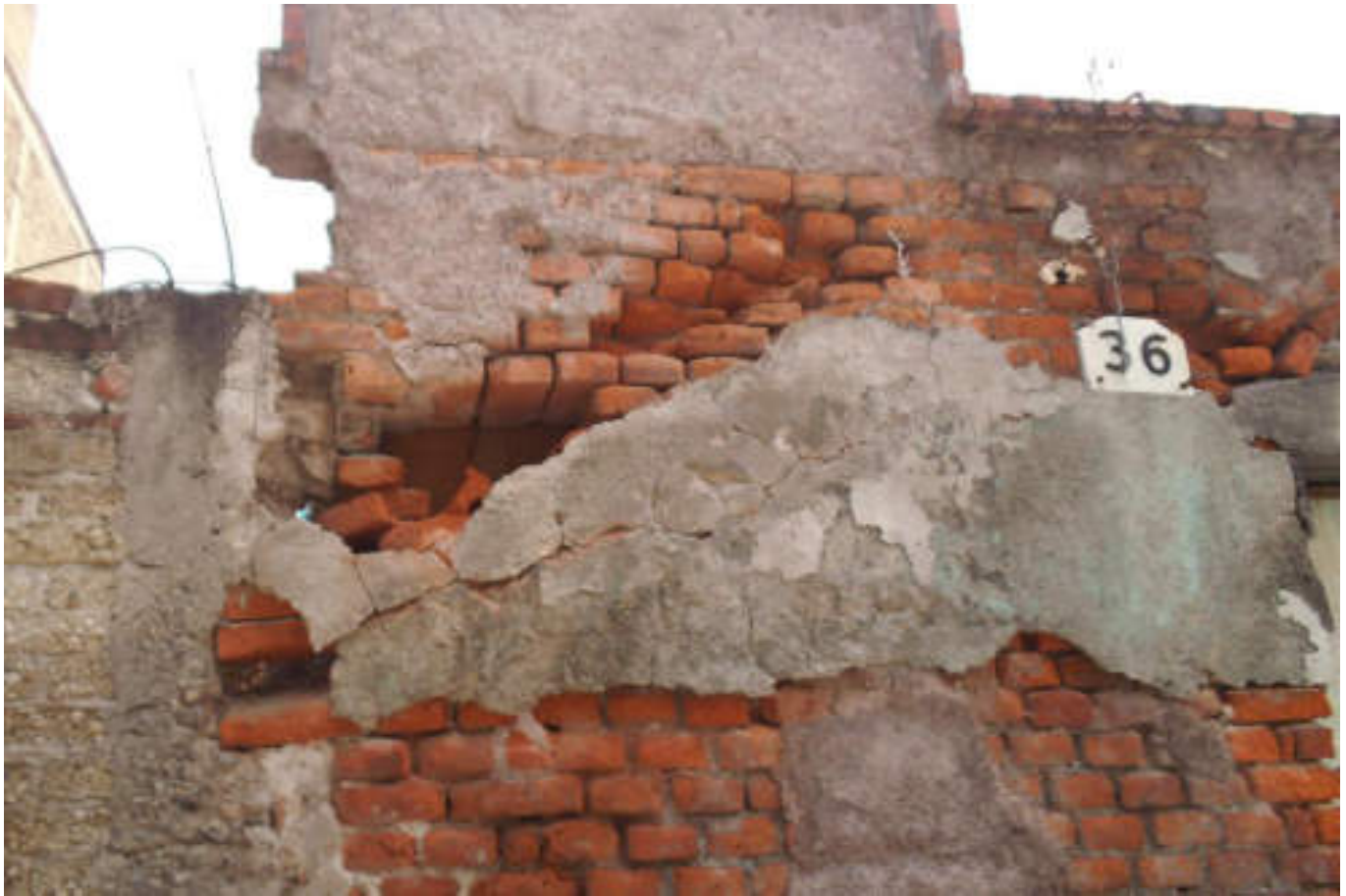
Figura 5.363. Fotografía D (Imagen 63), se aprecia una barda de mampostería no confinada que presenta dos tipos de procesos constructivos. En la parte izquierda se presenta un muro de tabique de concreto y a la derecha el muro ha sido construido con tabique rojo recocido, el cual se encuentra en mala condición ya que se observa desprendimiento (19.4667° N, 99.1579° W. Calle: Segunda Jardín).
