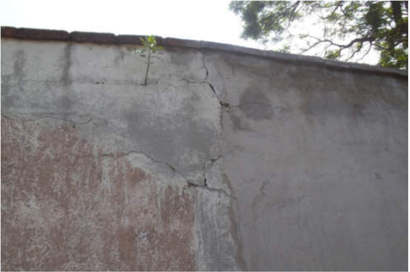
Figura 5.50. Fotografía D (Imagen 7a), se observa un fracturamiento en el muro perimetral de una vivienda, el cual parte de la zona superior del muro hasta la zona media del mismo; la fractura vertical se divide en la zona media expandiéndose diagonalmente hacia la izquierda (19.4997° N; 99.1925° W. Calle: Callejón Zacatlán).
