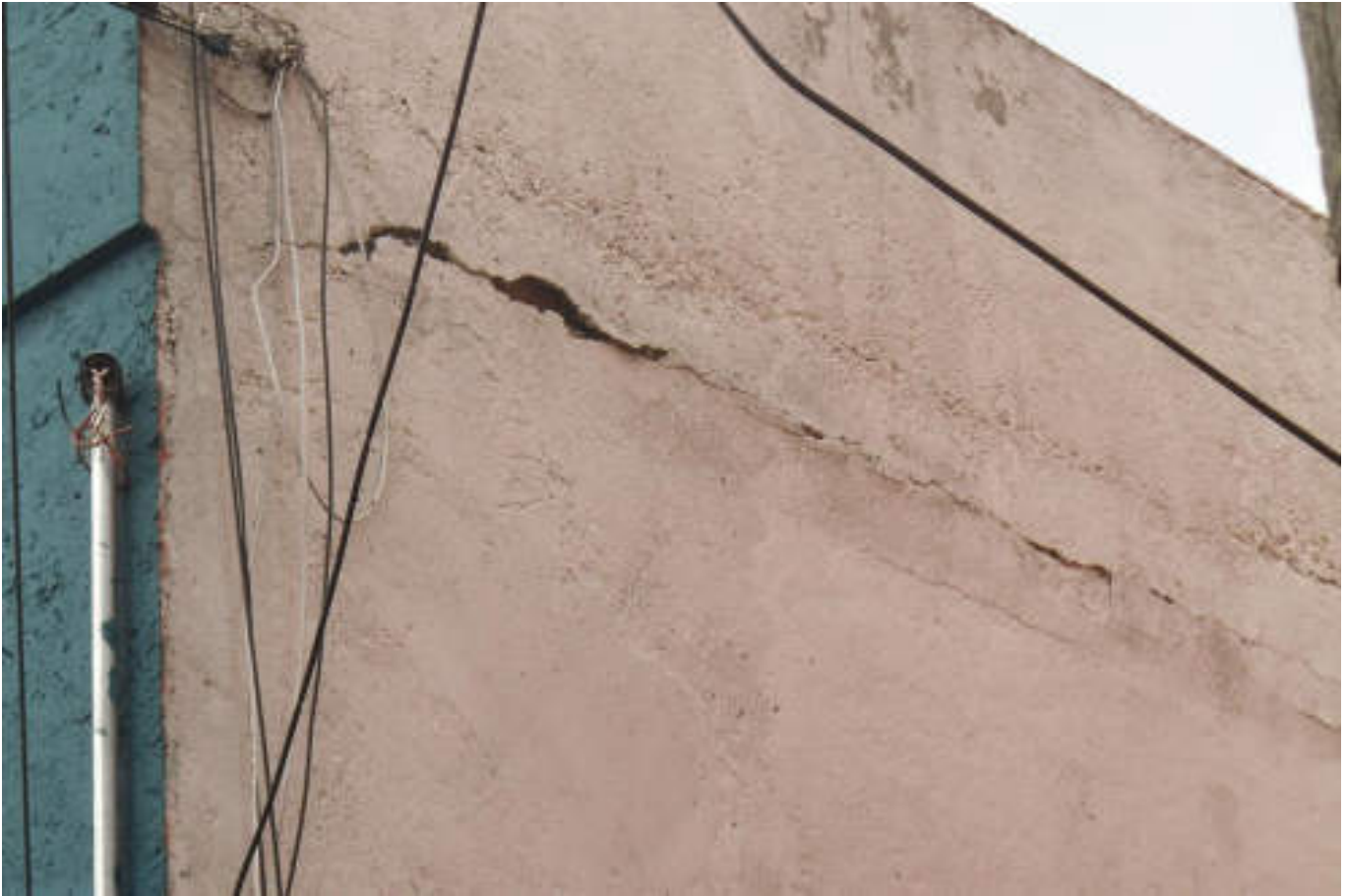
Figura 5.223. Fotografía D (Imagen 36), fracturamiento en la parte lateral de una vivienda, debilitando el concreto del aplanado y ocasionando desprendiendo de gran parte del mismo (19.4743° N, 99.1771° W. Calle: Norte 81)
