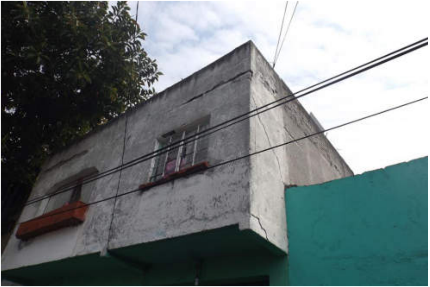
Figura 5.297. Fotografía D (Imagen 51), vivienda de mampostería semiconfinada con fracturas horizontales y diagonales, se muestra construcción sobre voladizo sin columnas de apoyo ni medidas de reforzamiento (19.4706° N, 99.1452° W. Calle: 7).
