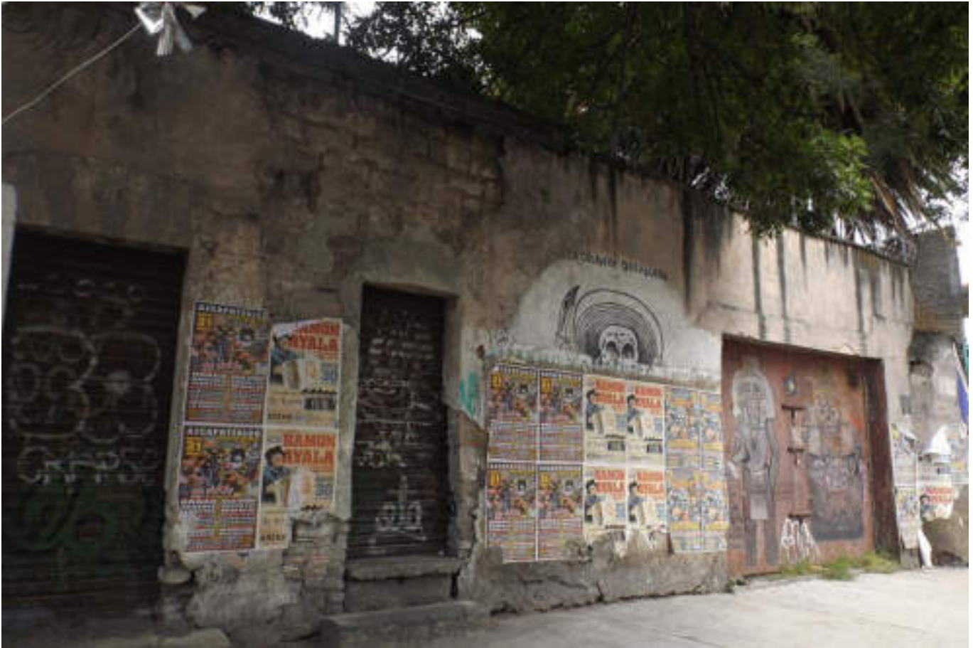
Figura 5.147. Fotografía D (Imagen 23), se muestra un muro de mampostería que presenta el fenómeno de corrosión, ocasionando que éste pierda sus propiedades de resistencia, de igual manera hace que el aplanado se debilite, desprendiéndose algunas partes del muro (19.4872º N, 99.1854º W. Calle: Coachilco).
