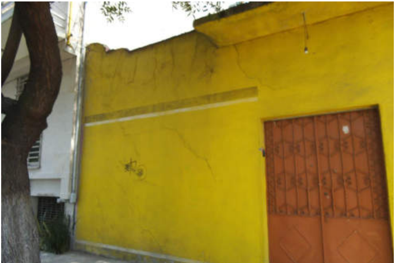
Figura 5.236. Fotografía A (Imagen 39), podemos observar fracturas en forma diagonal y vertical en gran parte del muro, así como daños en acabados (19.4797° N, 99.1538° W. Calle: Laminadores).
