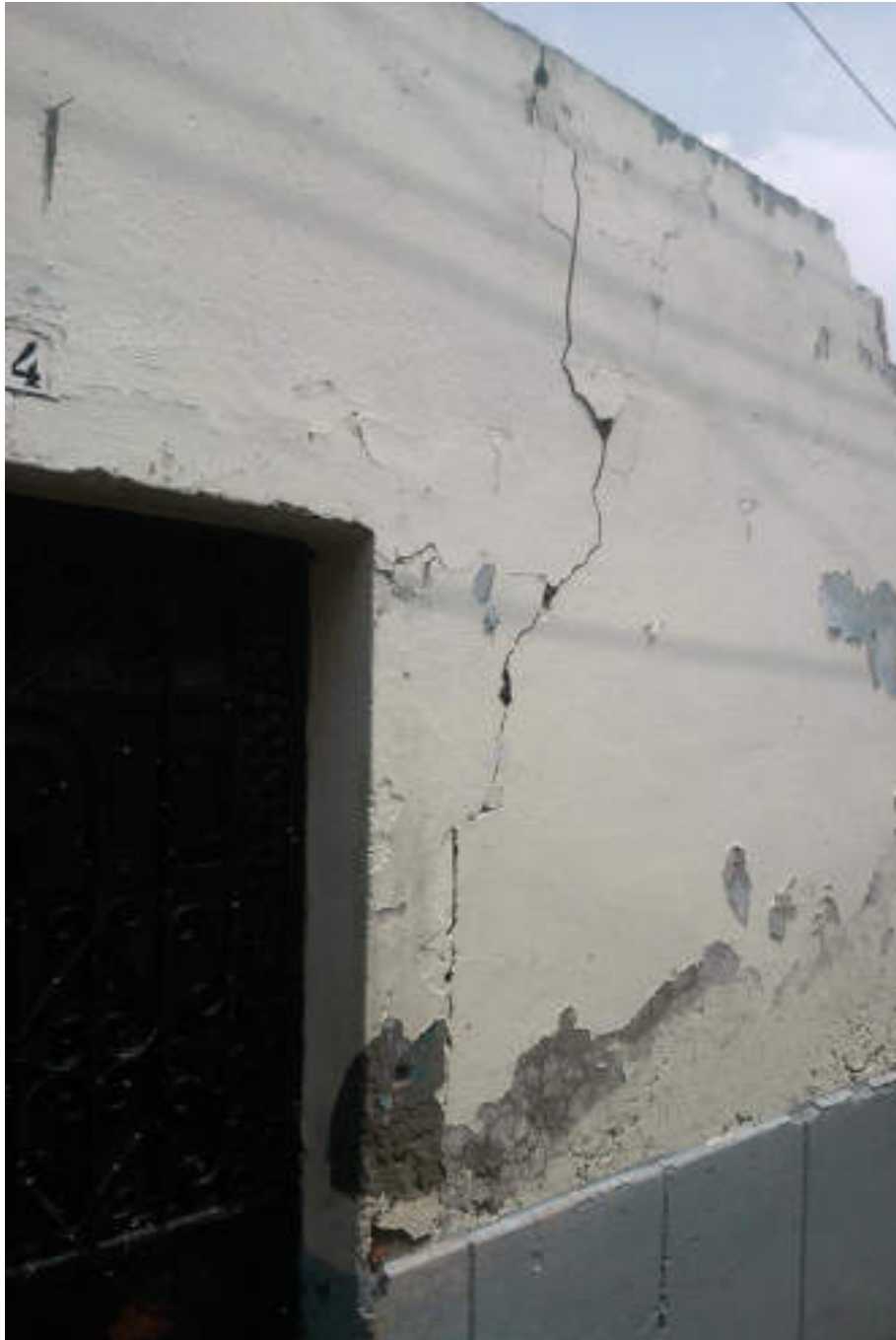
Figura 5.115. Fotografía E (Imagen 17), se muestra la fachada de una vivienda que presenta una fractura vertical que inicia entre la columna y el muro, extendiéndose hasta la parte superior del mismo, también se aprecia desprendimiento de material (19.491829959° N, 99.1760250551° W. Calle: Tlatenco).
