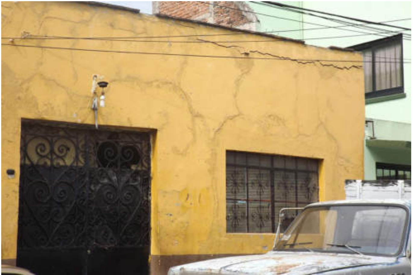
Figura 5.295. Fotografía B (Imagen 51), vivienda de mampostería semiconfinada con múltiples fracturas, una fractura horizontal en la parte superior presenta una separación de 5 cm aproximadamente (19.47105° N, 99.1469° W. Calle: 9).
