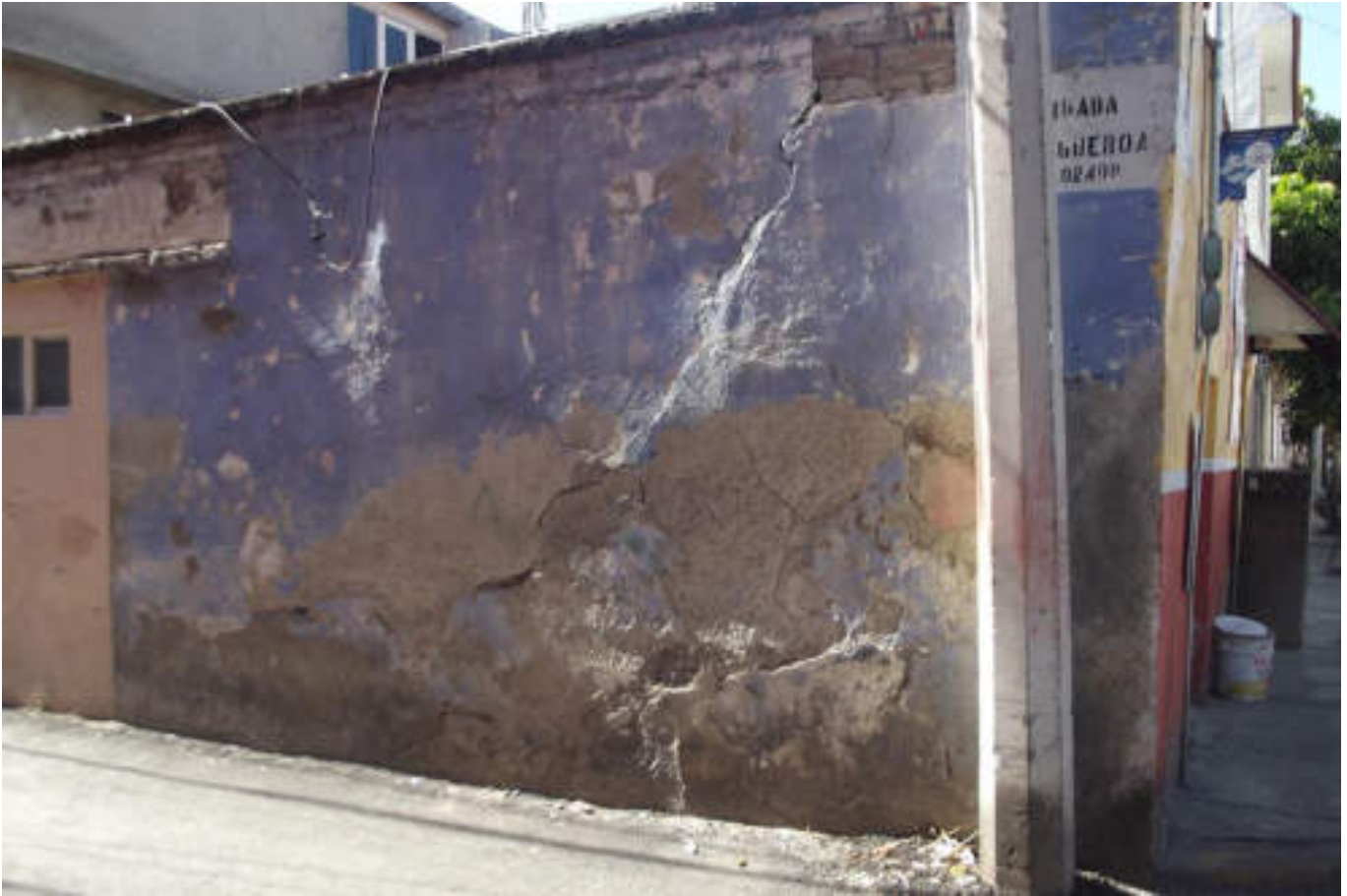
Figura 5.130. Fotografía E (Imagen 20), en esta fotografía podemos apreciar múltiples fracturas en forma diagonal en la vivienda debido a la ausencia de refuerzos verticales y horizontales (castillos y cadena de cerramiento respectivamente) provocando desprendimientos parciales en su acabado (19.4889° N, 99.2058° W. Calle: Federico Gamboa).
