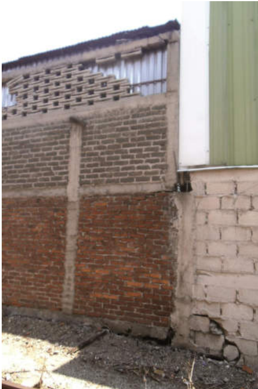
Figura 5.42. Fotografía D (Imagen 6), se muestra una estructura de mampostería semiconfinada con fractura en dala de cerramiento y viga, asimismo presenta desprendimiento de block decorativo en donde se coloca lamina metálica. En barda adjunta se presenta fractura diagonal en tabiques semiconfinados (19.5005221251° N, 99.1657563215° W. Calle: Poniente 146).
