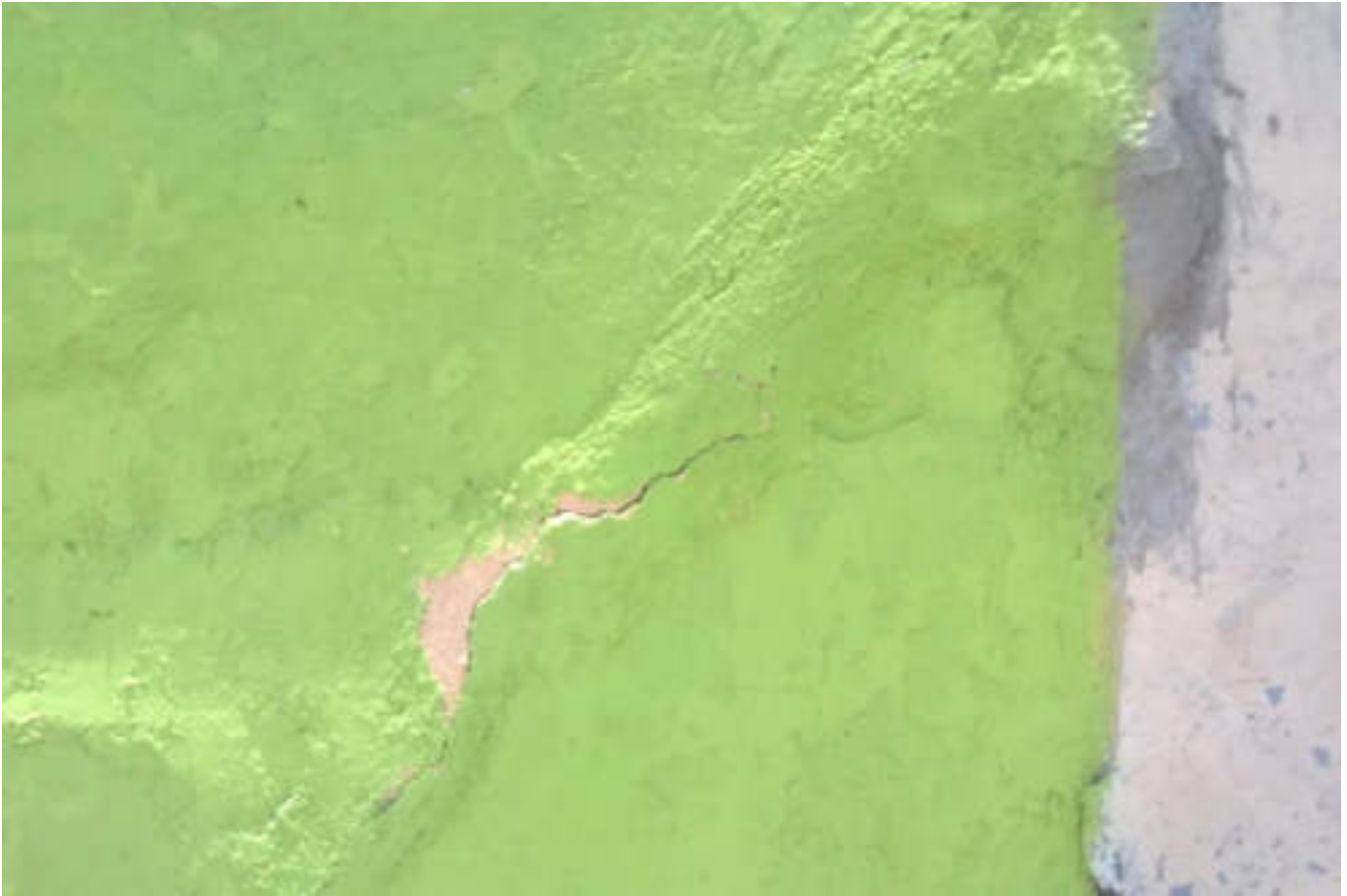
Figura 5.213. Fotografía E (Imagen 34), se muestra el agrietamiento en un muro donde se observa un abultamiento del aplanado a causa de la humedad (19.4803° N, 99.1776° W. Calle: San Sebastián).
