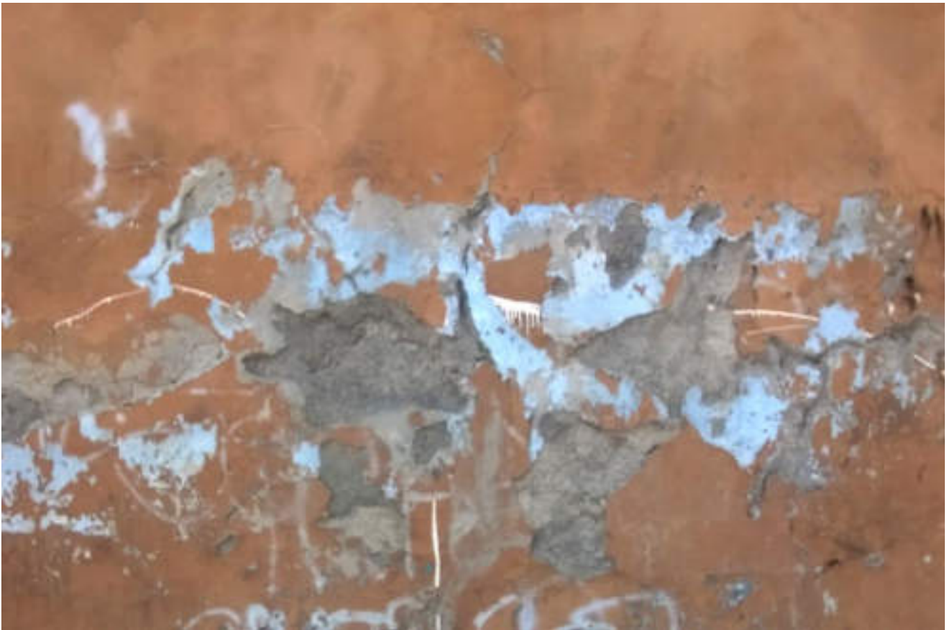
Figura 5.216. Fotografía A (Imagen 35), se muestra un muro con alta densidad de fracturas y desprendimiento del material que conforma el aplanado (19.3793° N, 99.1230° W. Calle: Playa Codesa).
