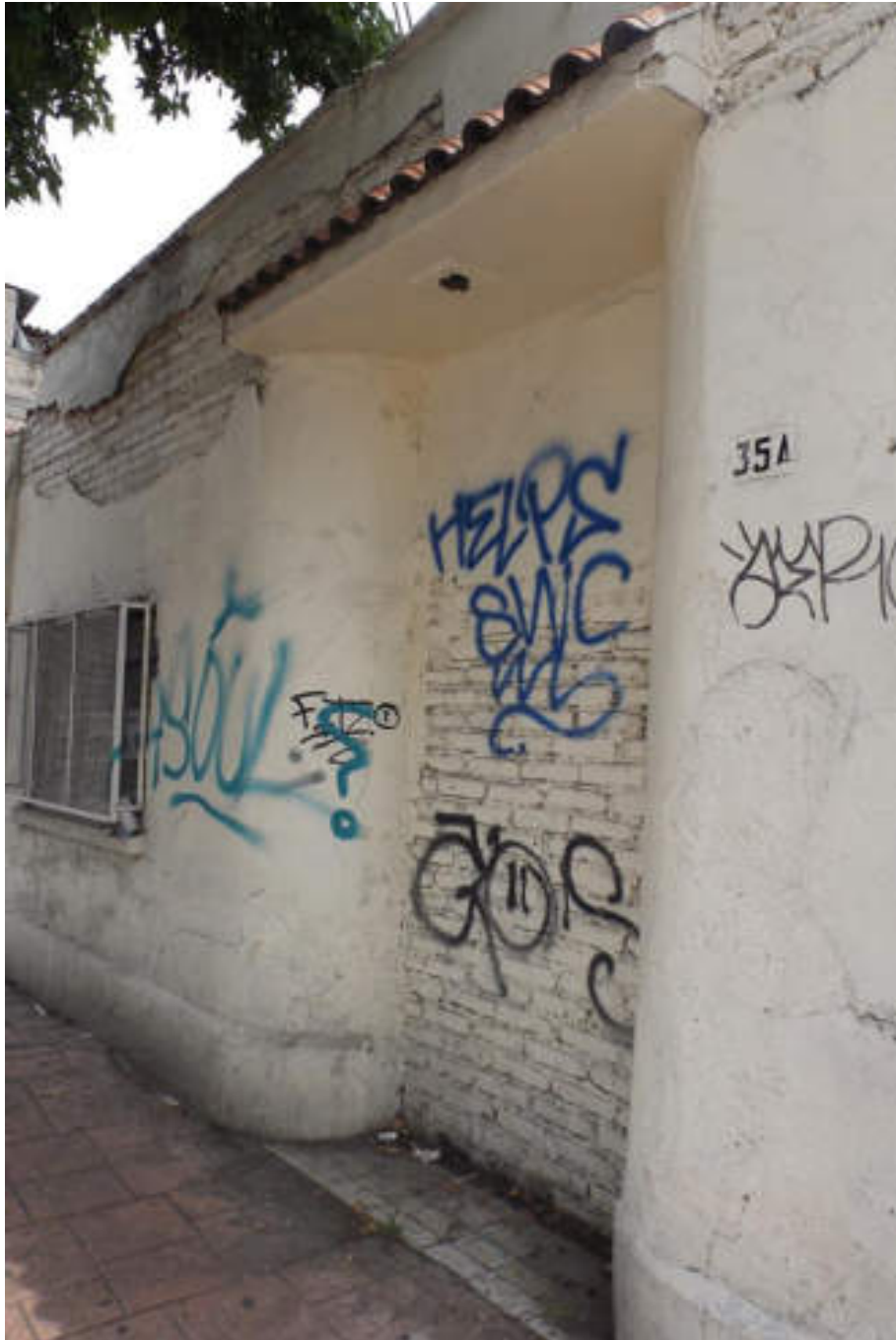
Figura 5.199. Fotografía A (Imagen 33), se muestra una vivienda con presencia de fracturas en forma vertical y horizontal en toda su superficie (19.4834° N, 99.1871° W. Calle: Zaragoza).
