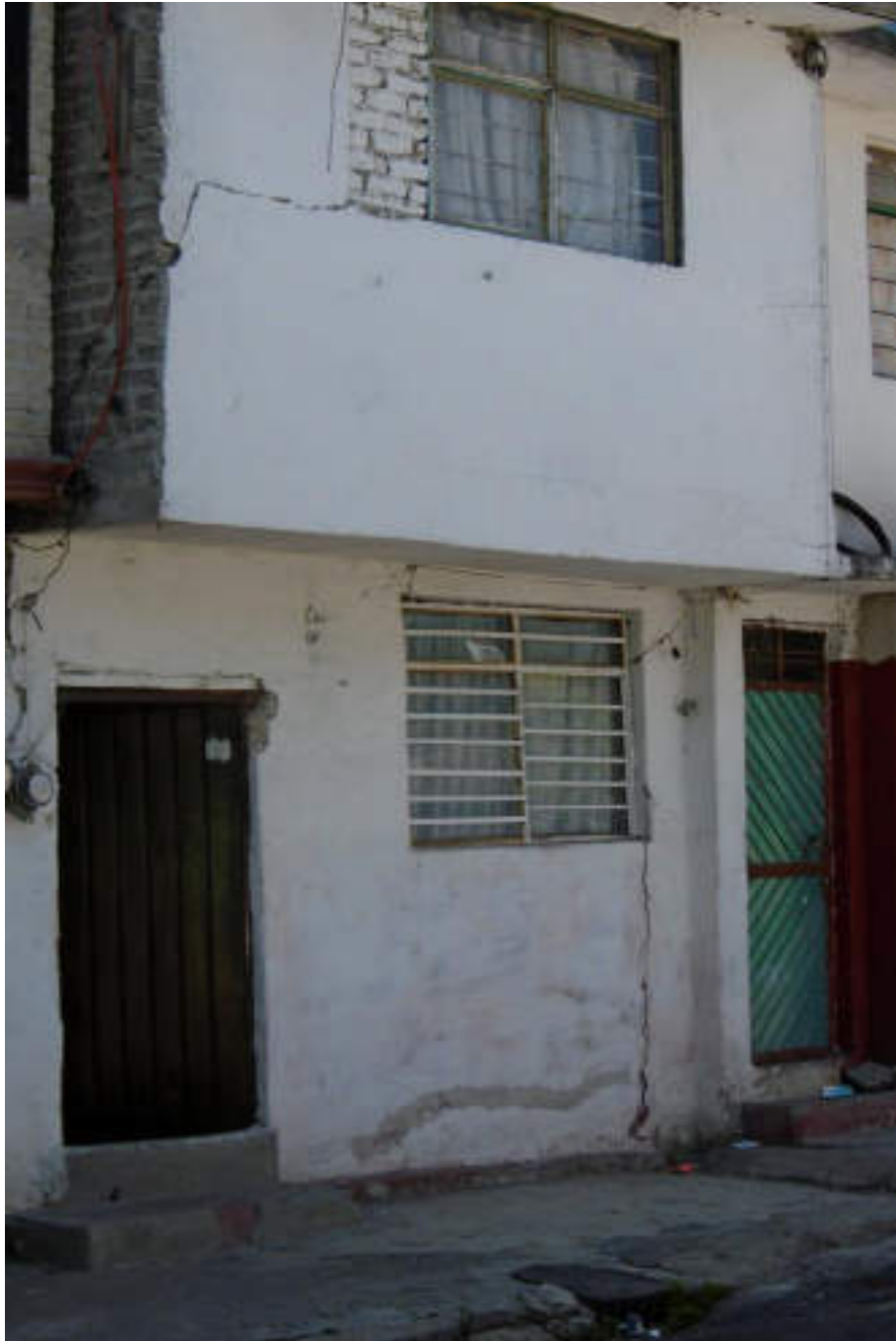
Figura 5.302. Fotografía B (Imagen 52), se muestra una vivienda que presenta una fractura vertical localizada en la parte inferior de la ventana separando el muro y el castillo. También se observa una fractura en el segundo nivel de la vivienda a un costado de la ventana, esta fractura continúa en el costado de la casa dañando así al muro de mampostería (19.4764° N, 99.2198° W. Calle: Francisco Villa).
