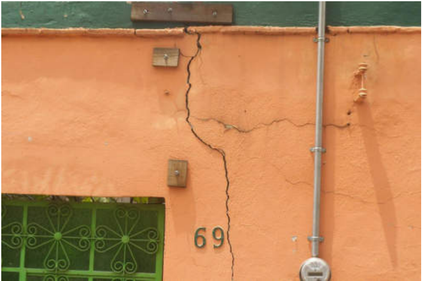
Figura 5.263. Fotografía C (Imagen 44), se observa la fachada de una vivienda afectada por una fractura vertical, la fractura presenta una separación aproximada de 2 cm (19.4763° N, 99.1847° W. Calle: Primera Privada Recreo).
