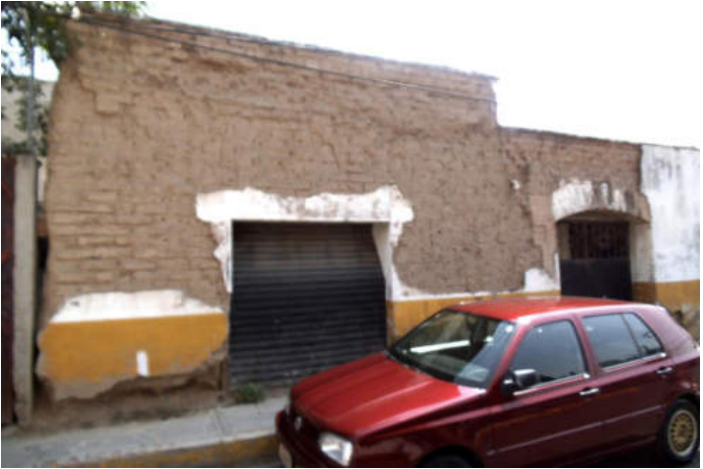
Figura 5.51. Fotografía E (Imagen 7a), muro exterior de un inmueble construido a base de piezas de adobe, el cual presenta pérdida casi total de aplanado por lo que el adobe se observa deteriorado (19.4989° N; 99.1916° W. Calle: Real de San Martín).
