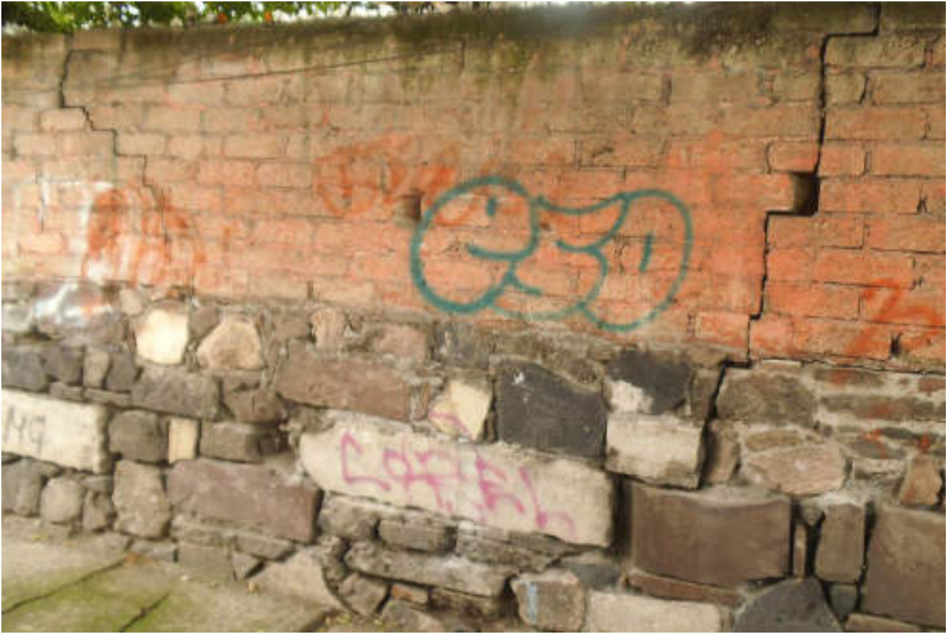
Figura 5.264. Fotografía D (Imagen 44), muro perimetral compuesto por dos materiales, en la zona superior ladrillo rojo recocido y en la inferior piedra braza; se observan 2 fracturas las cuales parten de la zona superior y confluyen en la zona inferior a nivel de piso (19.4743° N, 99.1824° W. Calle: Privada Nopatitla).
