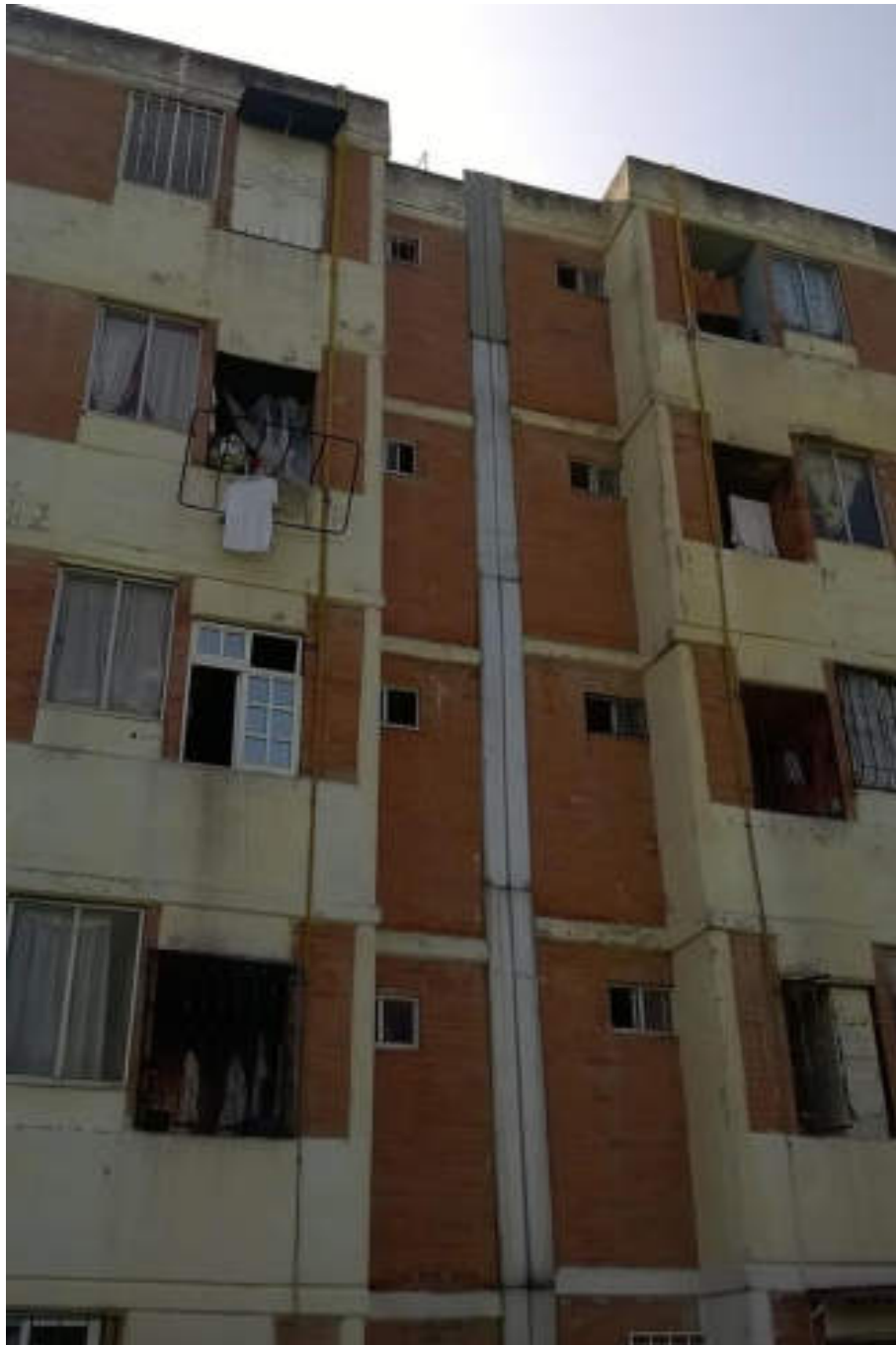
Figura 5.20 Fotografía A (Imagen 3), se observa que después de la primer placa metálica o de la planta baja las posteriores conservan desplazamiento vertical con respecto a la segunda placa ubicada en las colindancias de los edificios, todo ello asociado a los movimientos diferenciales del terreno (19.5054° N, 99.1893° W. Calle: 5 Norte (Deportivo Reynosa)).
