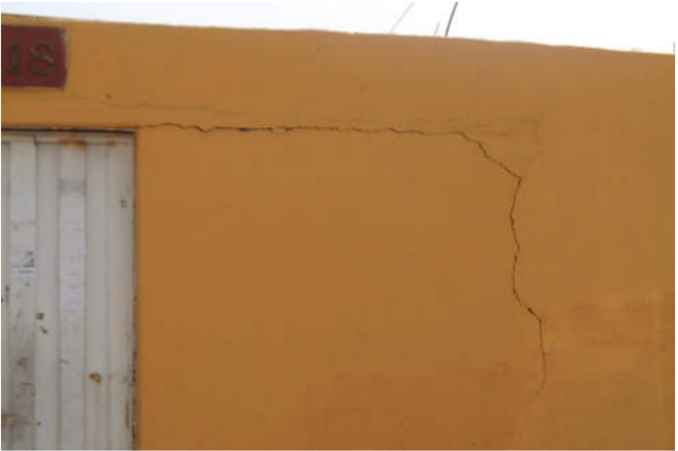
Figura 5.48. Fotografía B (Imagen 7a) donde se observa una fractura en el muro exterior de una vivienda, que parte del marco de la puerta en la esquina superior derecha continuando horizontalmente hasta girar de manera vertical llegando a la zona media del muro (19.5009° N; 99.1968° W. Calle: San José).
