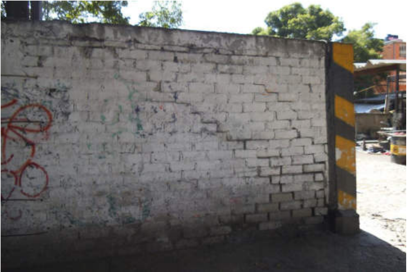
Figura 5.127. Fotografía B (Imagen 20), se observa una muro exterior, el cual presenta fracturas en forma diagonal escalonada debido a que la calidad del mortero no es la adecuada y no está trabajando adecuadamente, sujetando la mampostería también debido a la falta de refuerzo vertical (castillo) en la esquina del muro que de mayor rigidez a éste (19.4909° N, 99.2011° W. Calle: Alducín).
