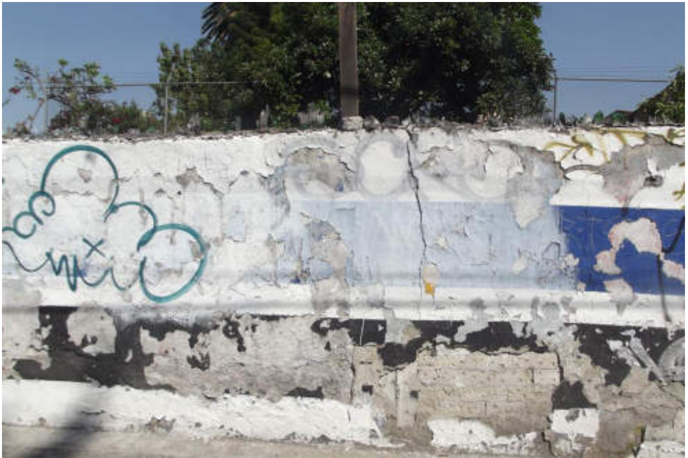
Figura 5.190. Fotografía B (Imagen 31), barda de mampostería con desprendimiento parcial de aplanado de concreto, fractura vertical en el aplanado al borde de la columna hacia muro izquierdo y una fractura horizontal en aplanado de concreto parte inferior derecha (19.4834º N, 99.1974º W. Calle: Tezozómoc).
