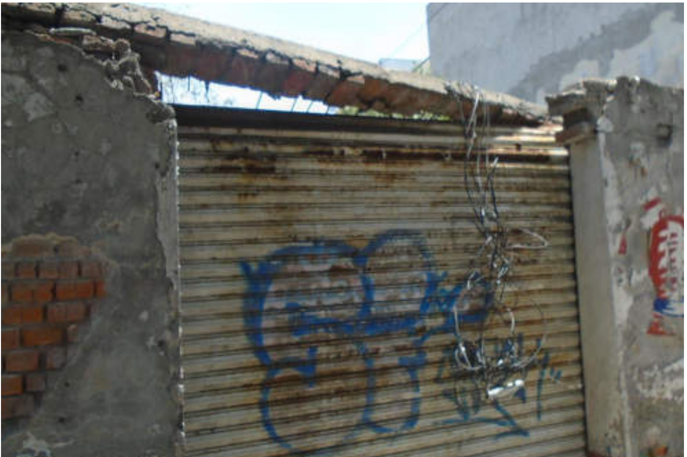
Figura 5.32. Fotografía A (Imagen 5), que muestra la ruptura de una viga de mampostería, que enmarca a una cortina en el muro, se observa daño en aplanado de concreto y en material constructivo, dicha estructura no presenta confinamiento (19.5060° N, 99.1759° W. Calle: Lázaro Cárdenas).
