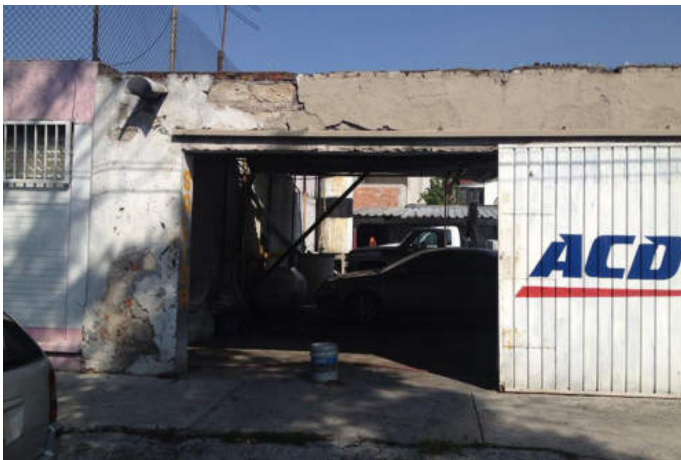
Figura 5.136. Fotografía A (Imagen 22), donde se observa fracturas en la parte superior del inmueble y el desprendimiento de aplanado en muro perimetral de un predio destinado a taller mecánico (19.4885° N; 99.1939° W. Calle: Cipactli).
