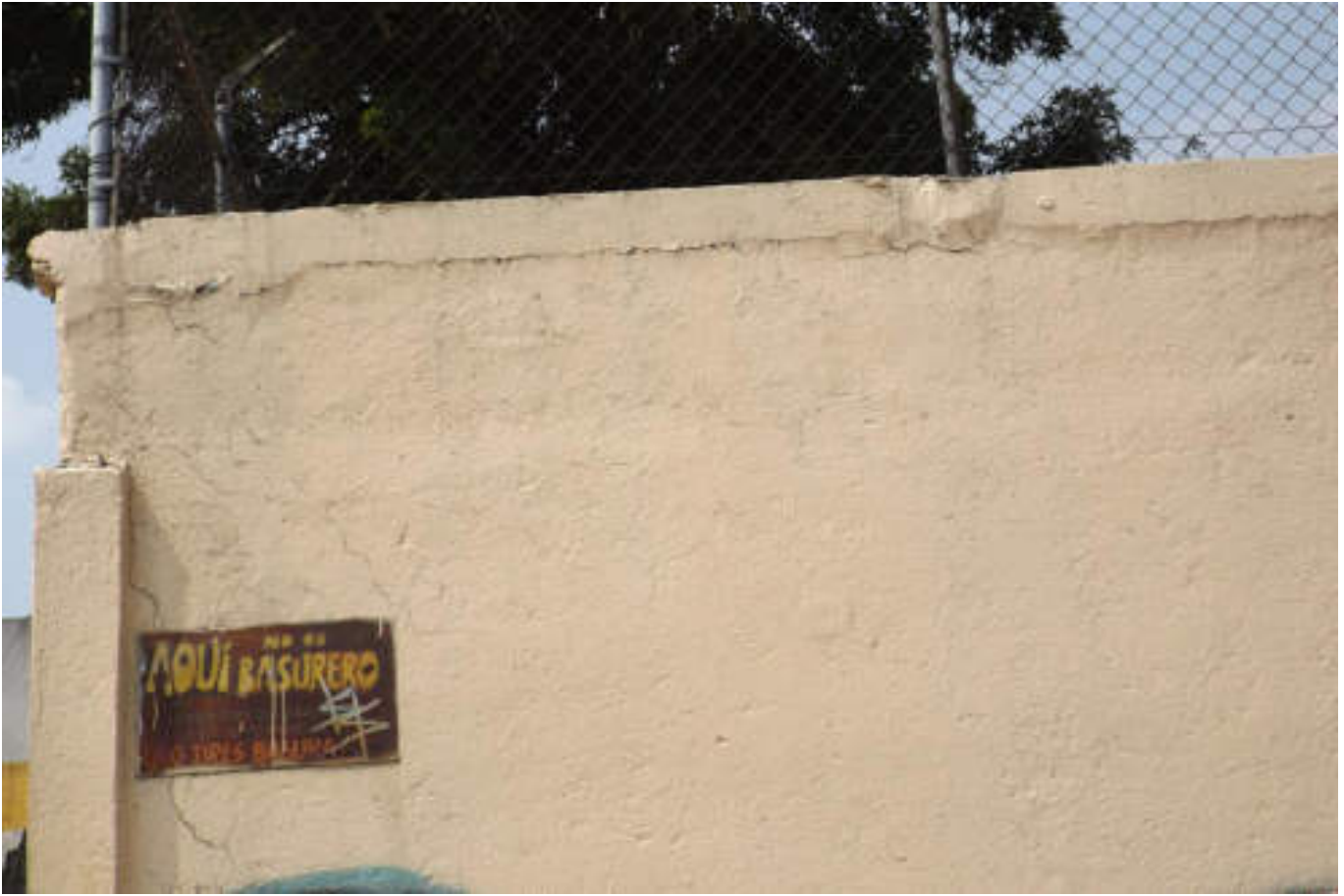
Figura 5.288. Fotografía B (Imagen 50), barda perimetral que presenta fracturas diagonales que inician en la conexión del muro y la columna. También se observa una fractura horizontal en la parte superior del muro (19.4707223175° N, 99.1490638347° W. Calle: 26).
