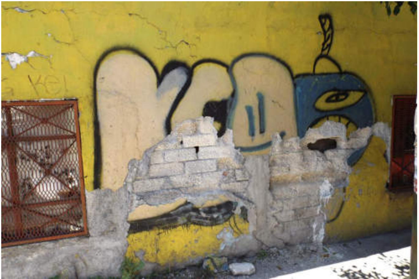
Figura 5.66. Fotografía C (Imagen 10), muro exterior de un inmueble fracturado, el aplanado con el cual se protegía a los tabiques se desprendió permitiendo que el intemperismo los deteriora (19.4997° N, 99.1982° W. Calle: Calzada Puente de Guerra).
