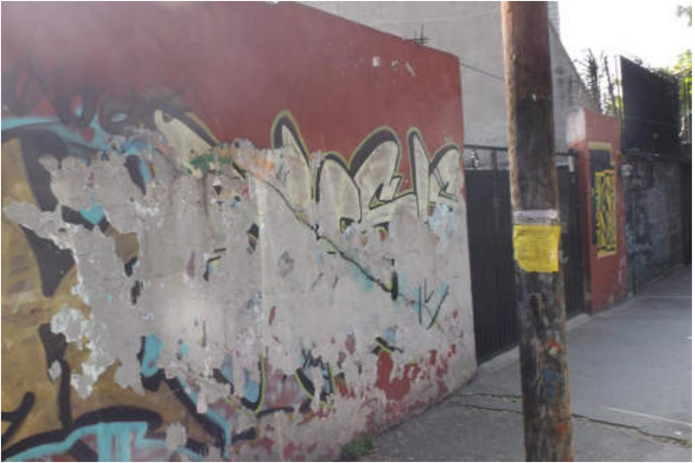
Figura 5.74. Fotografía C (Imagen 11), podemos observar un muro que presenta una fractura en forma diagonal en un extremo del claro, afectando su estabilidad (19.4965° N, 99.1987° W. Calle: Calzada Puente de Guerra).
