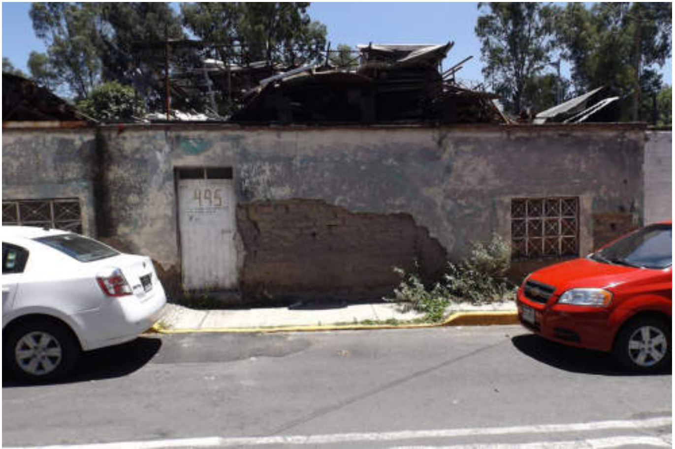
Figura 5.67. Fotografía D (Imagen 10), en la que se observa el muro exterior de una vivienda afectado por desprendimiento del aplanado y de las piezas de adobe de las que está conformado (19.4967° N, 99.1992° W. Calle: Tierra Fría).
