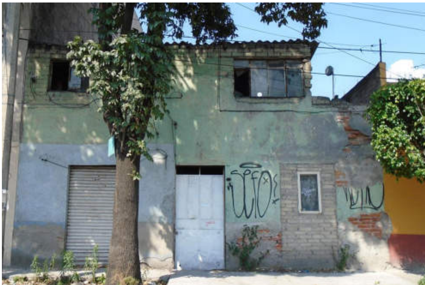
Figura 5.277. Fotografía A (Imagen 48), vivienda de mampostería no confinada que presenta una fractura diagonal en la esquina inferior derecha de la ventana de la parte superior y desprendimiento parcial de aplanado de concreto en la porción derecha de la vivienda (19.4715° N, 99.1628° W. Calle: Cerdeña).
