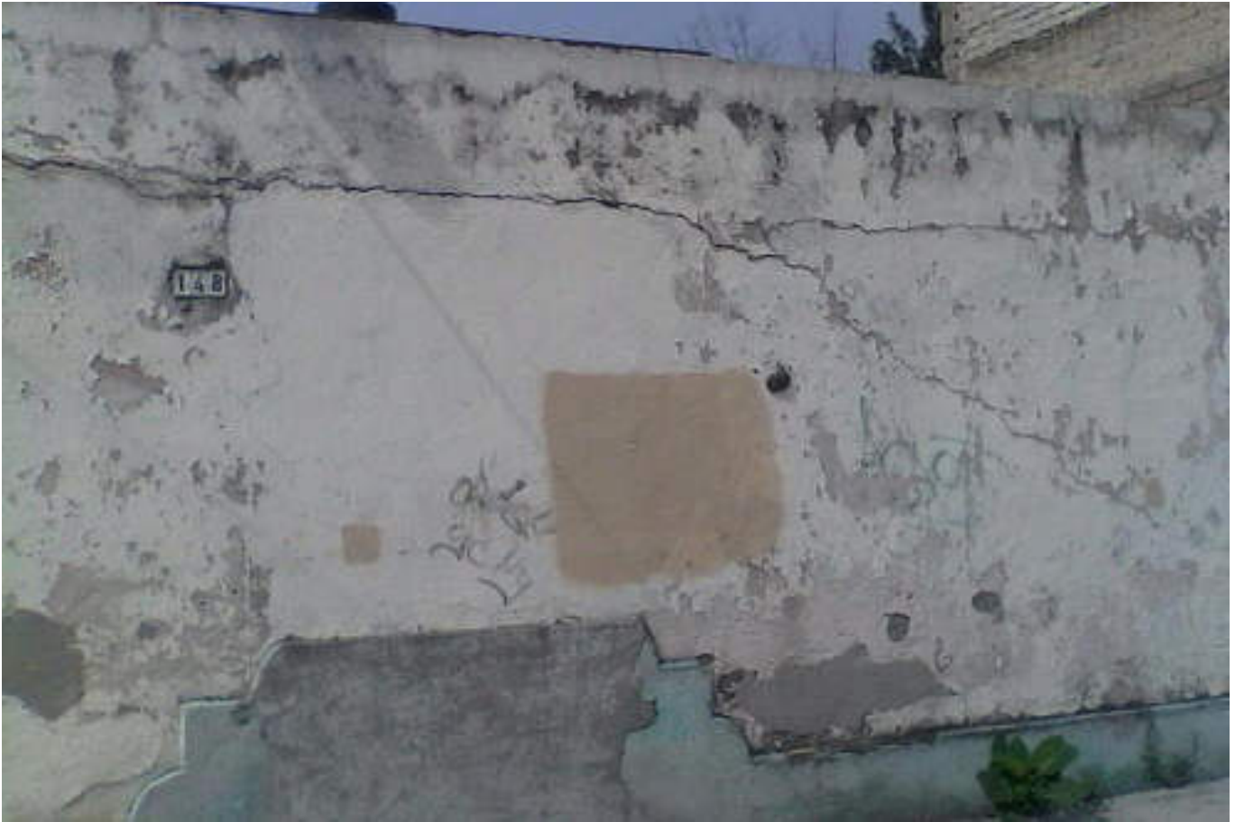
Figura 5.240. Fotografía D (Imagen 39), fractura horizontal presente en fachada exterior de una vivienda, la cual recorre el muro de un extremo a otro al ras de la trabe superior (19.4768° N, 99.1512° W. Calle: 25).
