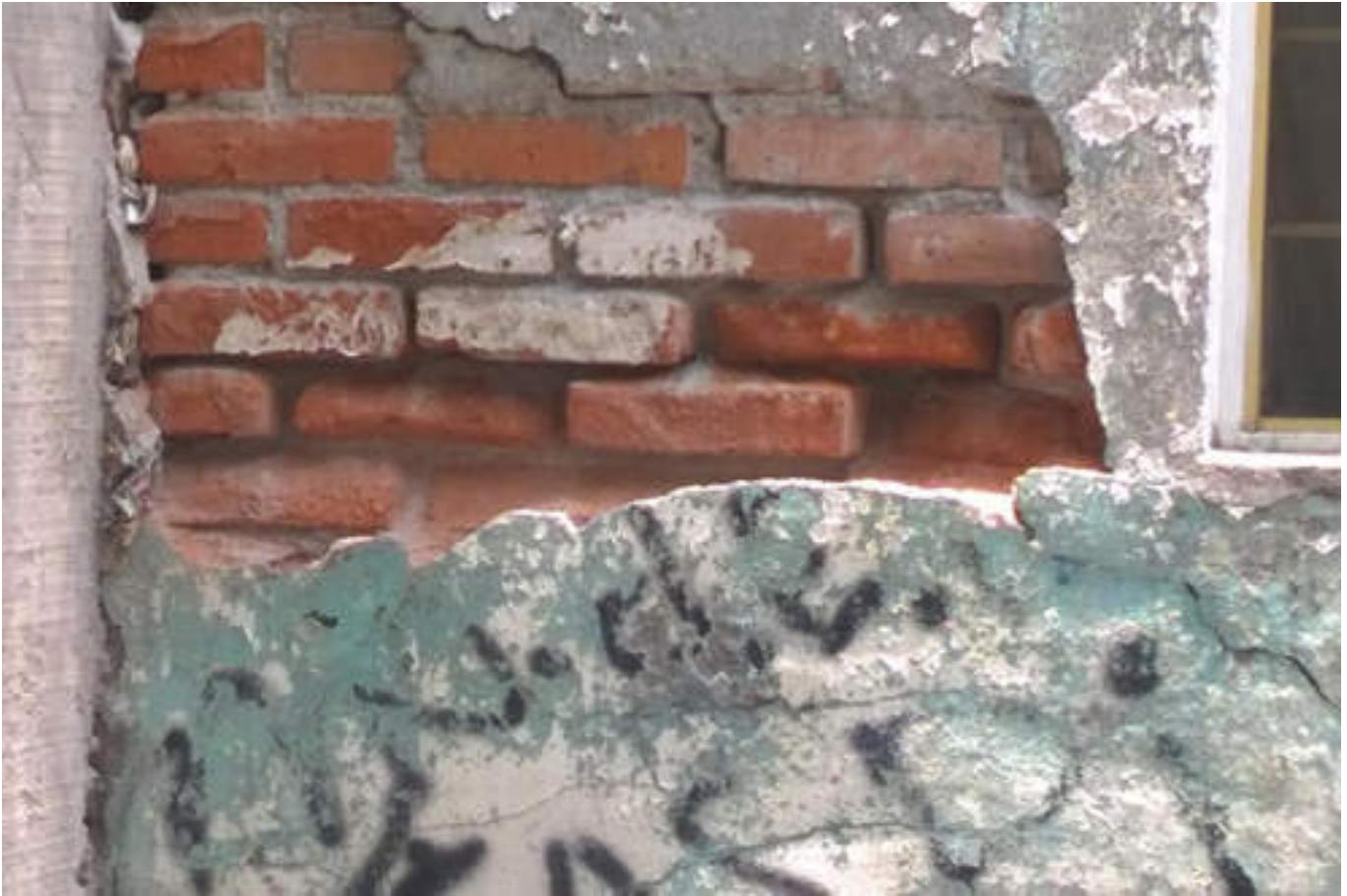
Figura 5.220. Fotografía A (Imagen 36), se muestra una fractura en el muro, provocando el desprendimiento de aplanado y por ende el deterioro de los ladrillos que lo componen (19.4798° N, 99.1767° W. Calle: San Sebastián).
