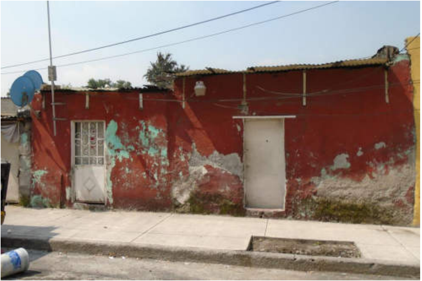
Figura 5.366. Fotografía A (Imagen 64), se muestra una edificación de mampostería sin confinar que presenta desprendimientos parciales de acabados y pérdida del material que conforma los cimientos bajo la puerta, además de un mal proceso constructivo (19.4670° N, 99.1479° W. Calle: 12).
