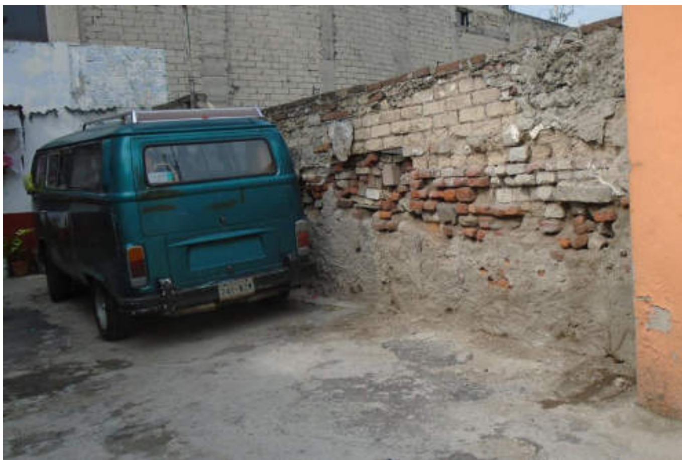
Figura 5.294. Fotografía A (Imagen 51), en la que podemos observar fracturas horizontales y daño en acabados por deterioro y paso del tiempo sobre la construcción, así como la falta de mantenimiento (19.468761615° N, 99.1486469145° W. Calle: 1).
