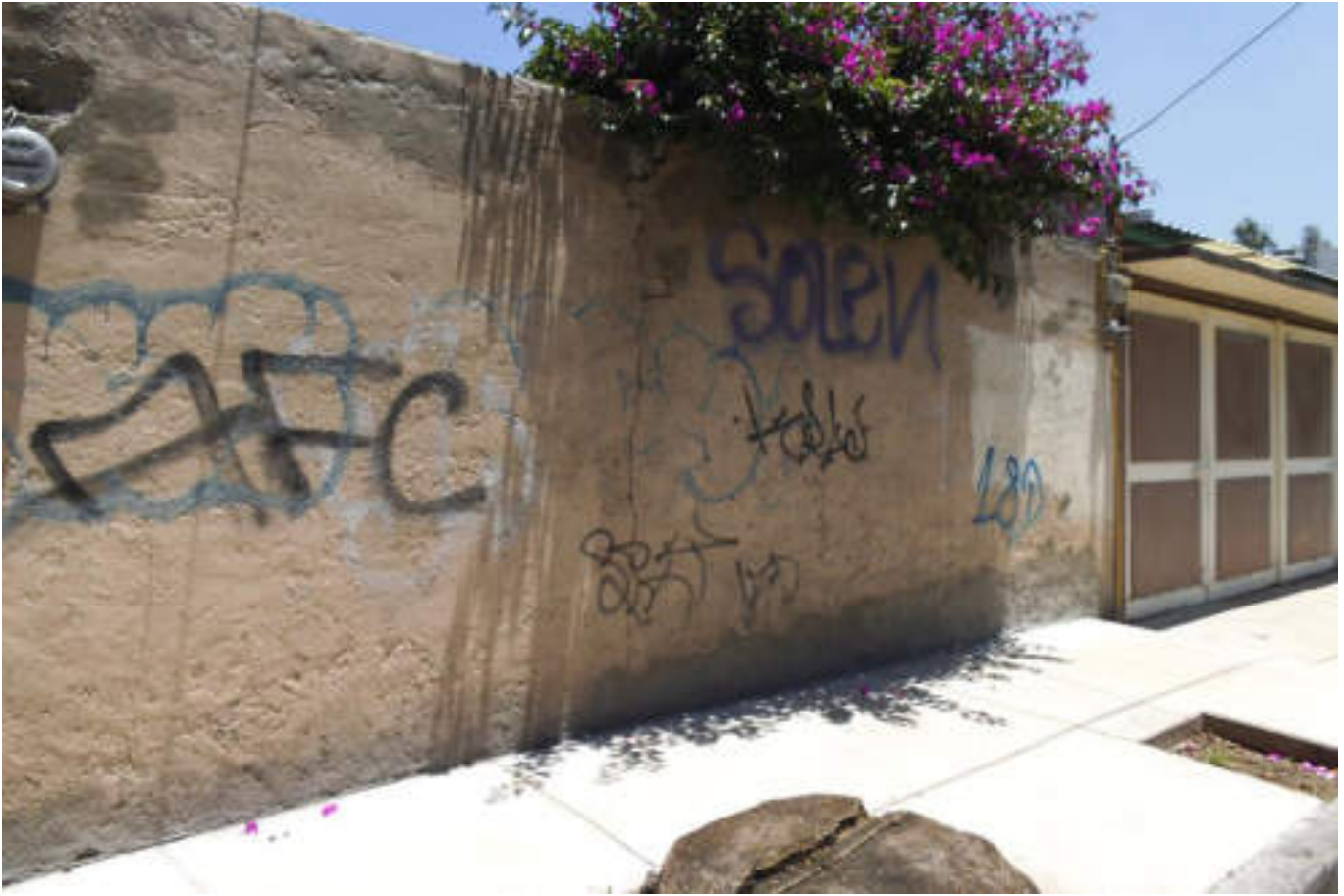
Figura 5.247. Fotografía A (Imagen 41), fractura en el muro perimetral de una vivienda que lo cruza verticalmente, ésta parte de la zona superior del muro hasta el nivel de piso (19.4794° N; 99.2039° W. Calle: Viento Suave).
