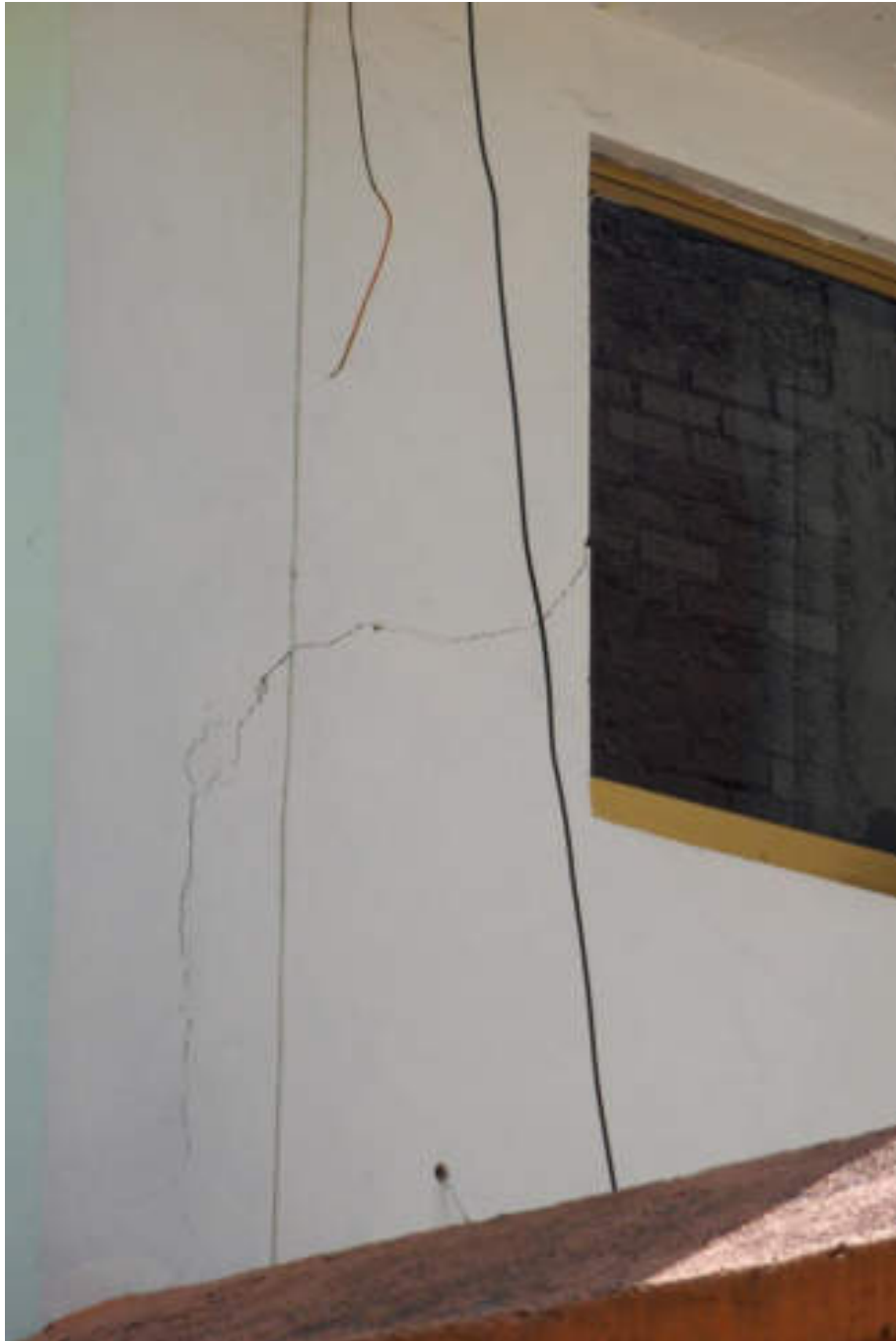
Figura 5.134. Fotografía B (Imagen 21), se observa una fractura en el muro lateral de la vivienda a la altura de ventana en el primer piso, la fractura parte del lado izquierdo del marco de la ventana hacia la zona media del muro (19.4893° N, 99.1976° W. Calle: Tlahuicas).
