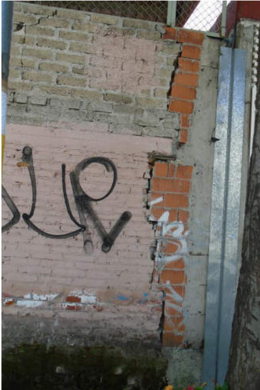
Figura 5.331. Fotografía B (Imagen 58), que muestra una construcción con muros de mampostería, en su extremo derecho presenta una fractura vertical la cual corta los elementos estructurales de confinamiento, la fractura se presenta precisamente en el sitio donde existen diferentes materiales de construcción (19.4756° N, 99.1914° W. Calle: Octano).
