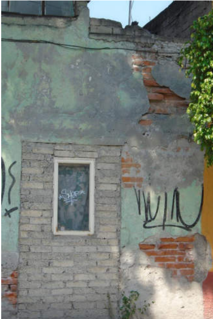
Figura 5.278. Fotografía B (Imagen 48), se muestra una vivienda de mampostería con una sección reconstruida para instalación de ventana en muro de fachada, asimismo se observa desprendimiento parcial de aplanado de concreto y daño en material constructivo (19.4715° N, 99.1628° W. Calle: Cerdeña).
