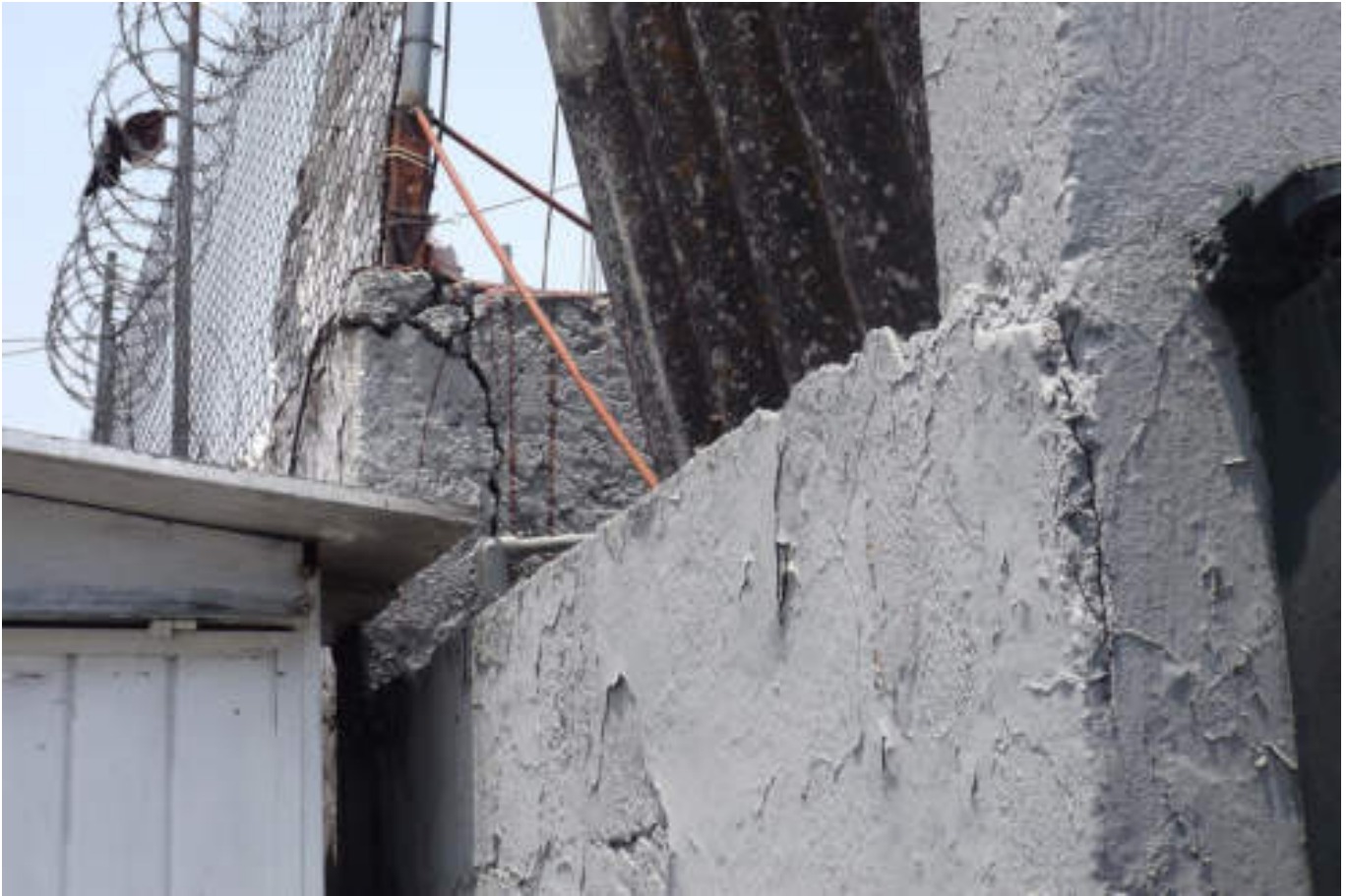
Figura 5.57. Fotografía C (Imagen 8), fracturamiento de castillo en la zona superior, donde el muro perimetral pierde continuidad se presenta el comienzo de desprendimiento de aplanado (19.4991° N, 99.1854° W. Calle: San pablo Xalpa).
