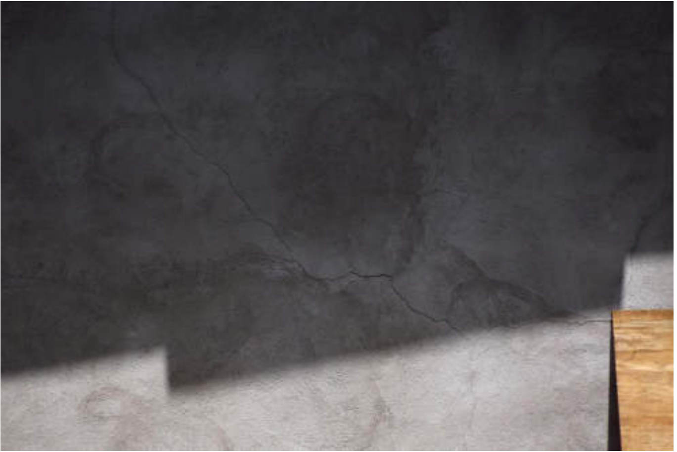
Figura 5.64. Fotografía A (Imagen 10), fractura diagonal en muro exterior de vivienda que parte de la zona superior hasta la parte media del muro (19.4984° N, 99.2059° W. Calle: Batalla de Tierra Blanca).
