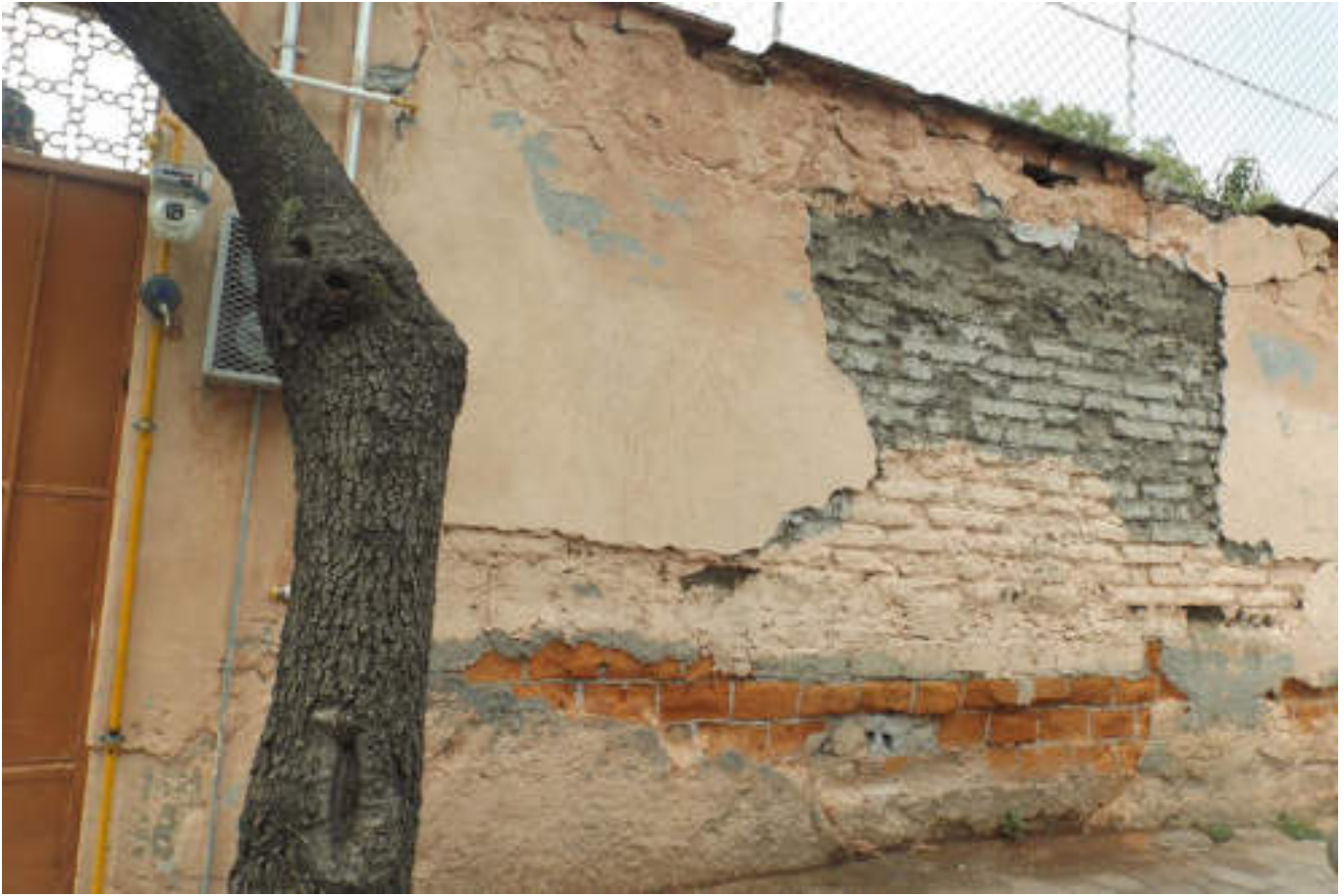
Figura 5.148. Fotografía E (Imagen 23), en la que se observa un muro de mampostería que presenta múltiples daños, debido a la falta de confinamiento y a la corrosión, ocasionando un desgaste y la presencia de algunos agujeros en la parte inferior del muro, además de que existen colapsos del aplanado (19.4852º N, 99.1870º W. Calle: Santander).
