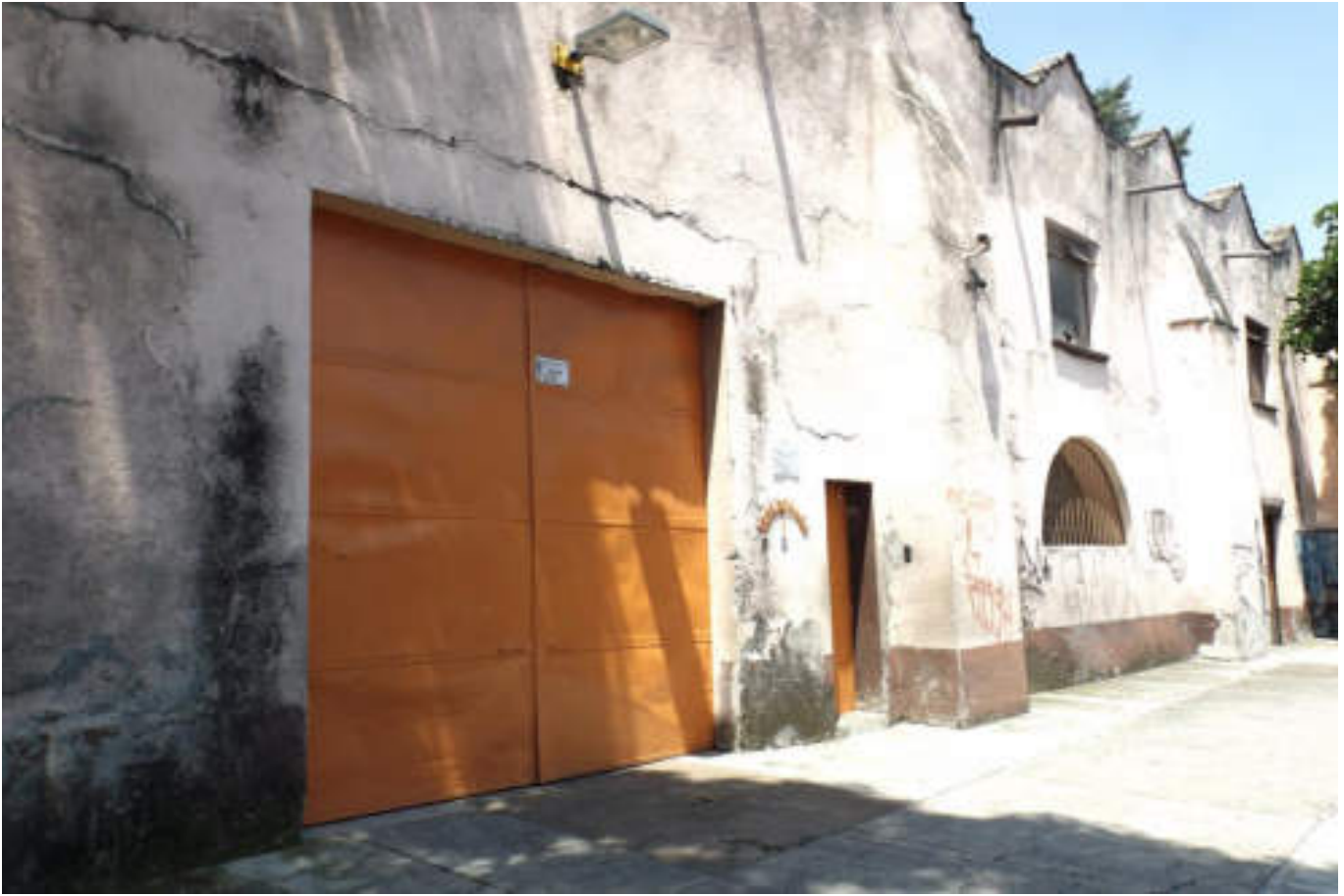
Figura 5.211. Fotografía C (Imagen 34), se muestra una estructura de mampostería confinada, la cual presenta una fractura horizontal en la parte superior de la puerta, por consecuencia provoca la separación del elemento estructural (19.4812º N, 99.1812º W. Calle: San Sebastián).
