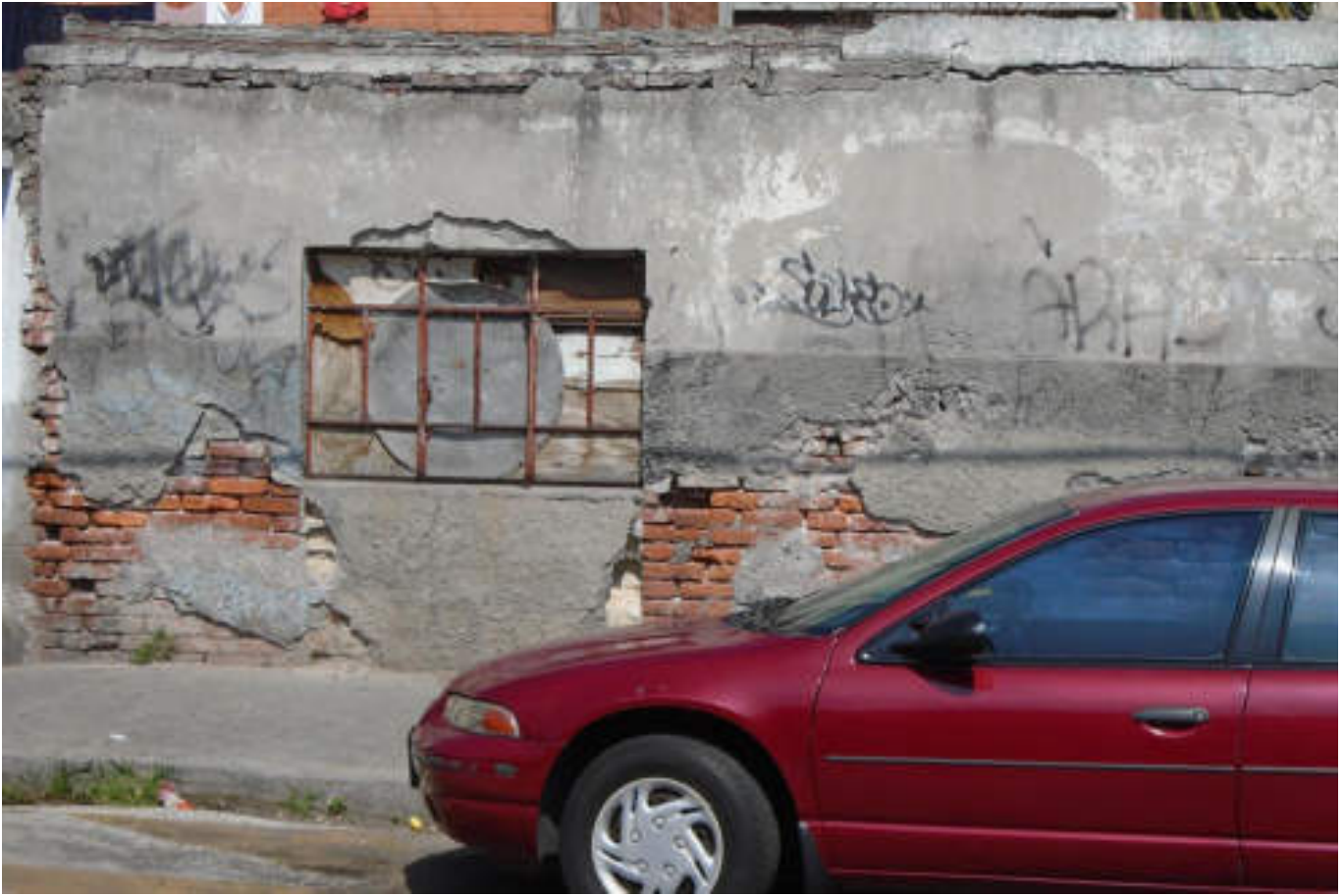
Figura 5.332. Fotografía C (Imagen 58), se muestra una vivienda de mampostería sin confinamiento que presenta fracturas horizontales, verticales y en diagonal, además del desprendimiento de acabados y de los materiales que conforman al muro (19.4759° N, 99.191° W. Calle: Durango).
