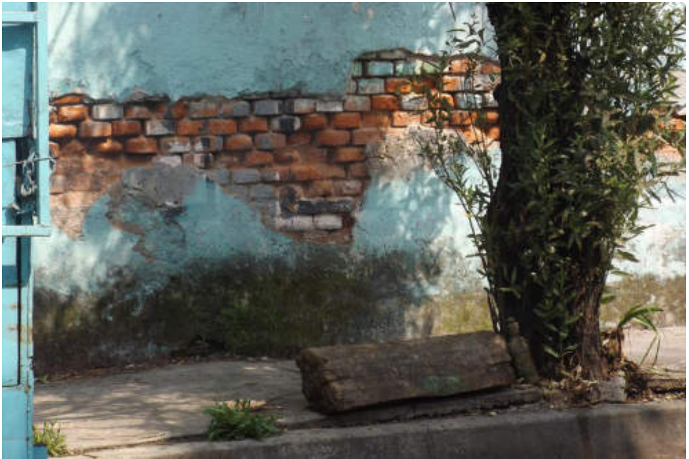
Figura 5.291. Fotografía E (Imagen 50), se aprecia el desgaste del ladrillo rojo y mortero debido al uso de materiales de poca calidad o falta de un buen sistema constructivo. En la sección donde se encuentra el deterioro se observa que el acabado se ha desprendido completamente (19.4696689272° N, 99.1481635753° W. Calle: 28).
