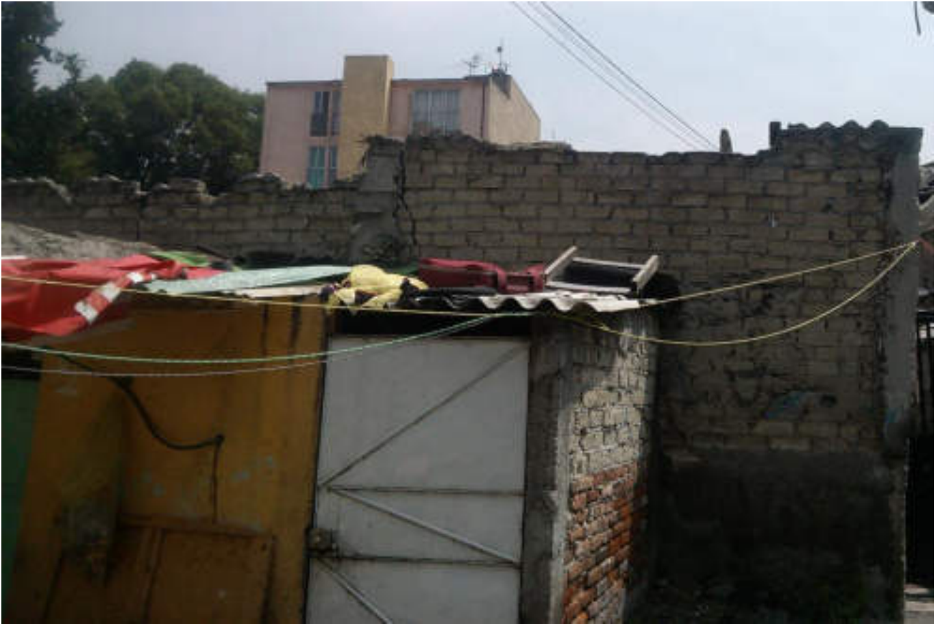
Figura 5.112. Fotografía B (Imagen 17), en la parte posterior de la fotografía se observa el muro de una vivienda, que presenta un fracturamiento vertical y diagonal entre la conexión del castillo y el muro, esto contribuye a la inestabilidad de la estructura ya que no cuenta con confinamiento (19.4932933057° N, 99.1773599432° W. Calle: Papantla).
