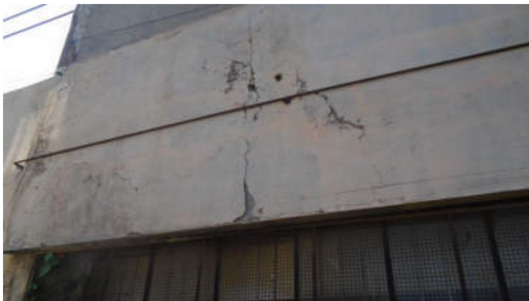
Figura 5.1780. Fotografía G (Imagen 28b) que muestra la fachada de una construcción con presencia de fracturas en su parte media, así como desprendimiento de aplanado (19.4894° N, 99.1549° W. Calle: Privada Teresa Bustos).
