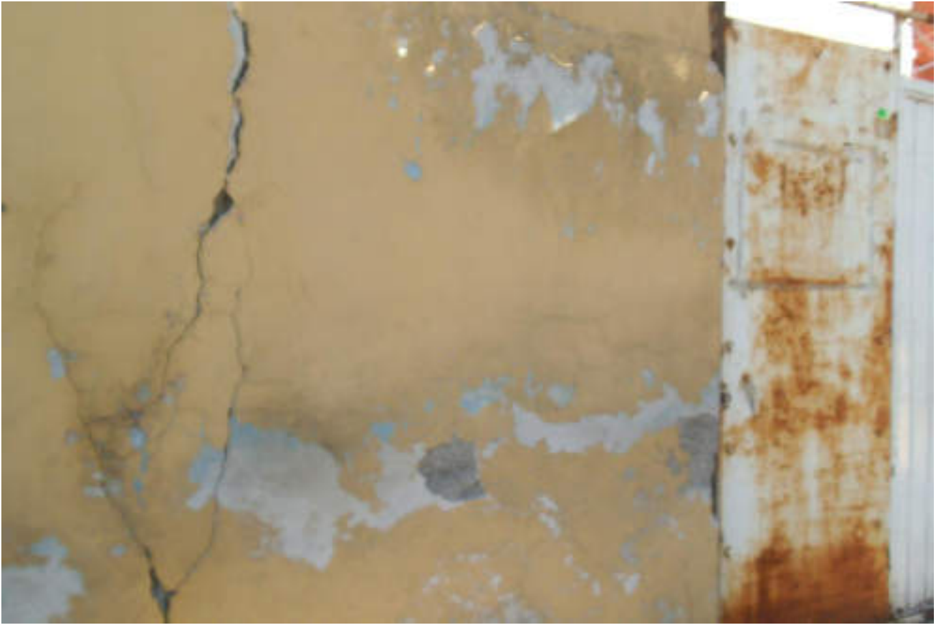
Figura 5.123. Fotografía D (Imagen 19), se observa fracturamiento en el muro perimetral de una vivienda, esta parte de la zona superior del muro hasta la parte baja de éste (19.4911° N; 99.2133° W. Calle: Francisco Sarabia).
