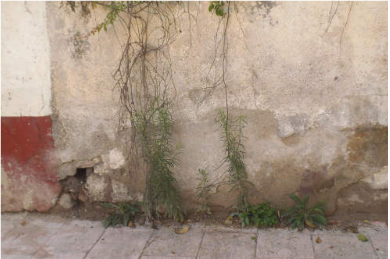
Figura 5.258. Fotografía C (Imagen 43), muro exterior de una vivienda que presenta desprendimiento del aplanado en la parte inferior a nivel de piso donde se observa deterioro y humedad (19.4726° N, 99.1878° W. Calle: Camino a Nextengo).
