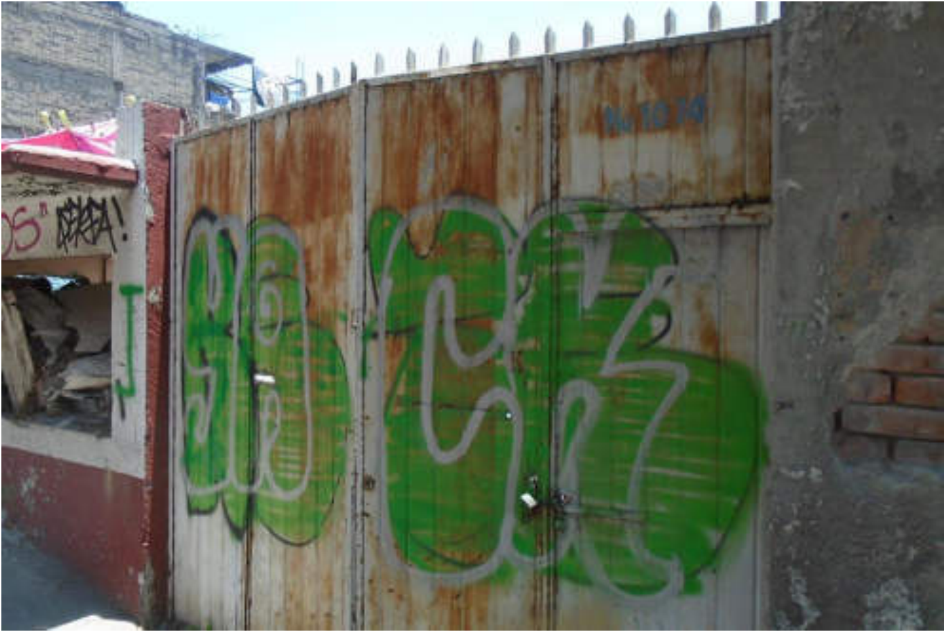
Figura 5.34. Fotografía C (Imagen 5), barda de mampostería sin confinamiento que presenta deterioro en aplanado de concreto y abertura en la junta de los ladrillos (19.5060° N, 99.1759° W. Calle: Lázaro Cárdenas).
