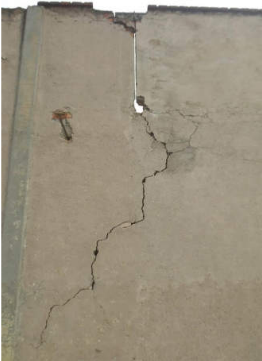
Figura 5.371. Fotografía F (Imagen 64), se observa una ruptura totalmente vertical en muro perimetral provocada por acción humana, la cual continúa con una fractura concentrada en la zona media del muro continuando en dirección diagonal a la zona baja (19.3948° N, 99.1130° W. Calle: Chinampas).
