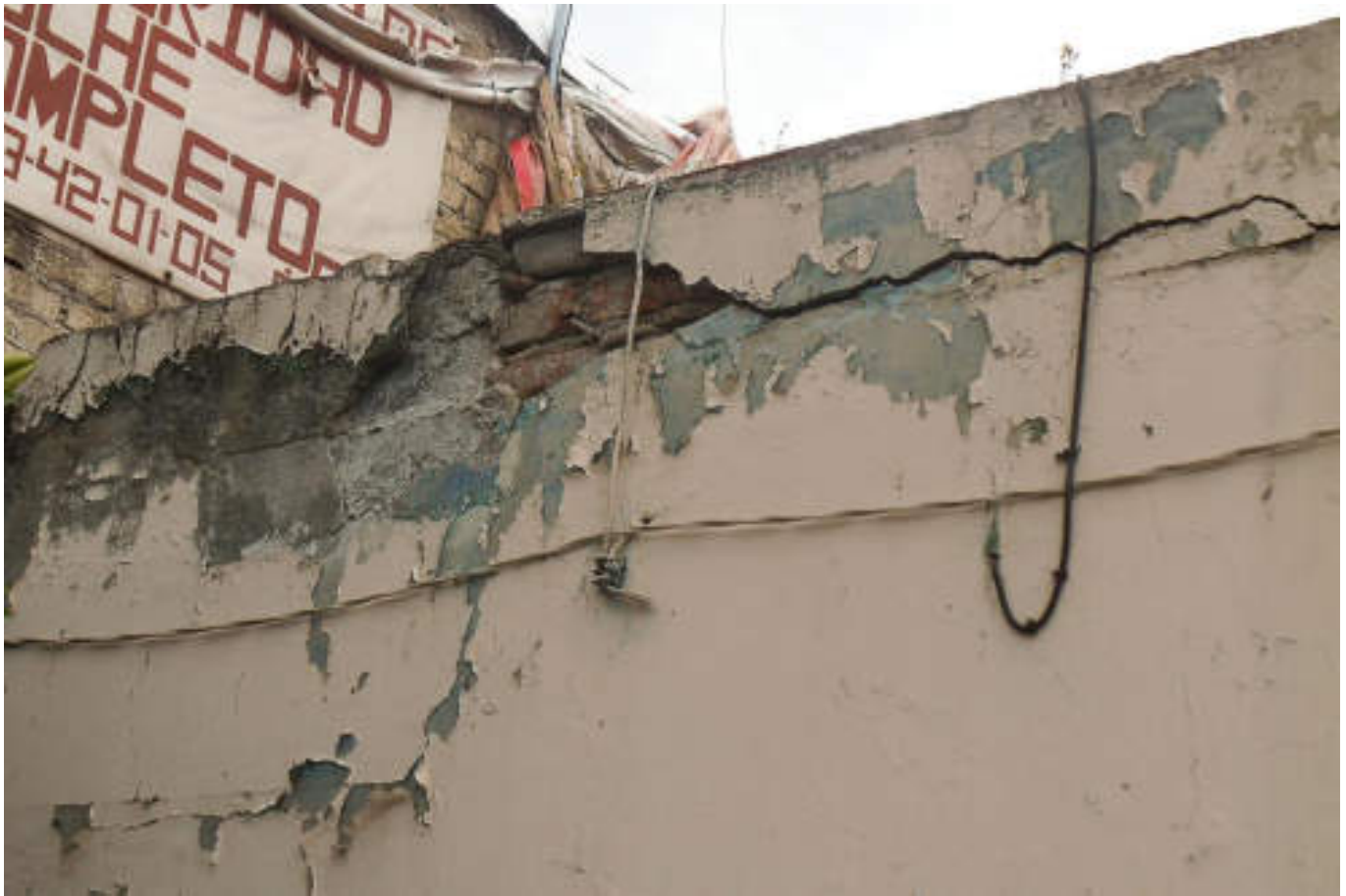
Figura 5.268. Fotografía B (Imagen 45 se observa a mayor detalle las fracturas en forma horizontal a lo largo del muro con daños en acabado, el material de mampostería ha comenzado a desgastarse (19.4713° N, 99.1781° W. Calle: Norte 81-A).
