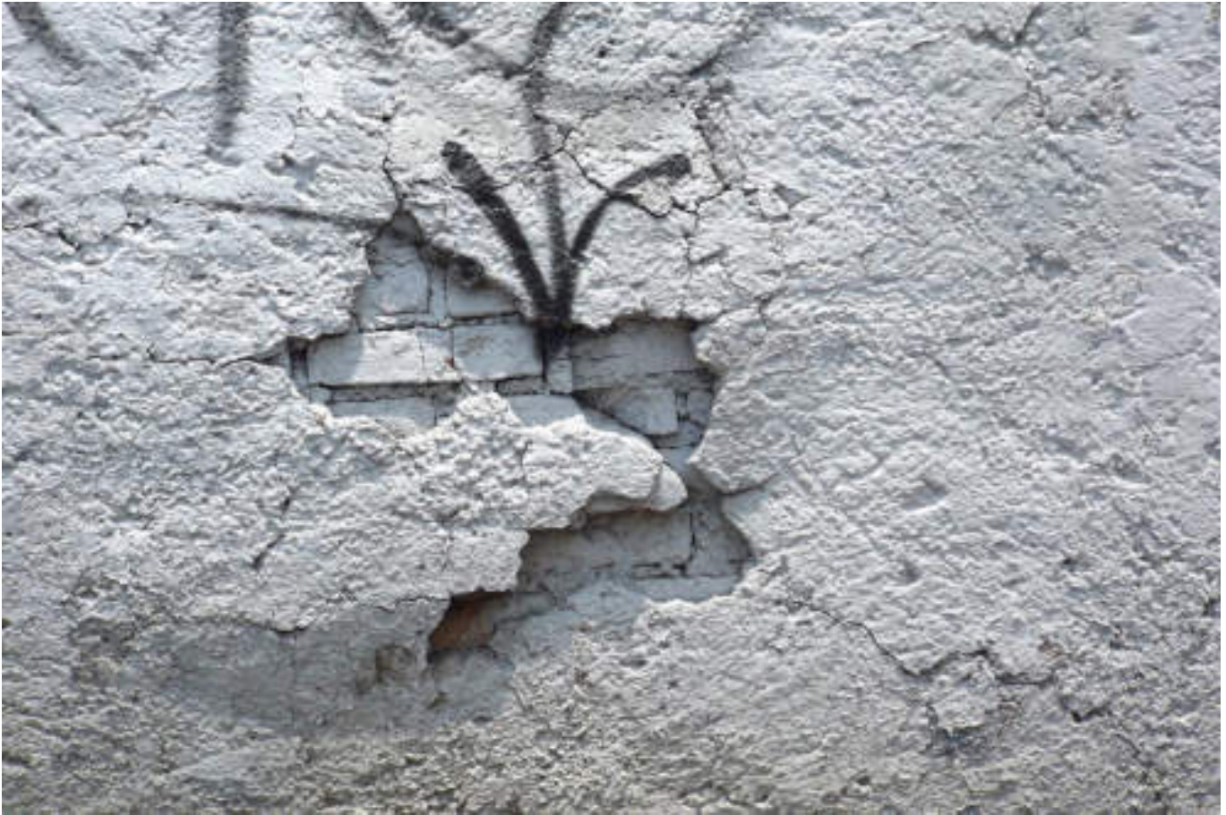
Figura 5.59. Fotografía E (Imagen 8), se observa el fracturamiento del muro, donde el aplanado se ha desprendido, pudiendo distinguir las fracturas en el material de mampostería (19.4991° N, 99.1854° W. Calle: San Pablo Xalpa).
