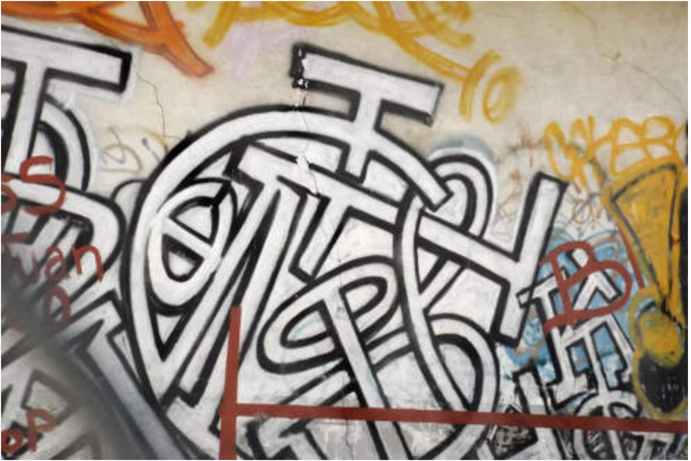
Figura 5.17. Fotografía B (Imagen 2), se muestra un acercamiento de la Figura 3, apreciándose más claramente las fracturas de esta construcción (19.5049° N, 99.1920° W. Calle: Akan).
