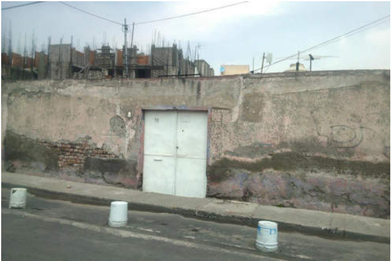
Figura 5.114. Fotografía D (Imagen 17), se muestra la fachada de un inmueble de mampostería, sin confinamiento, en la que se aprecia deterioro en su acabado, así como diversas fracturas a lo largo del muro (19.4922642645° N, 99.1766516789° W. Calle: Santa Catarina (Central)).
