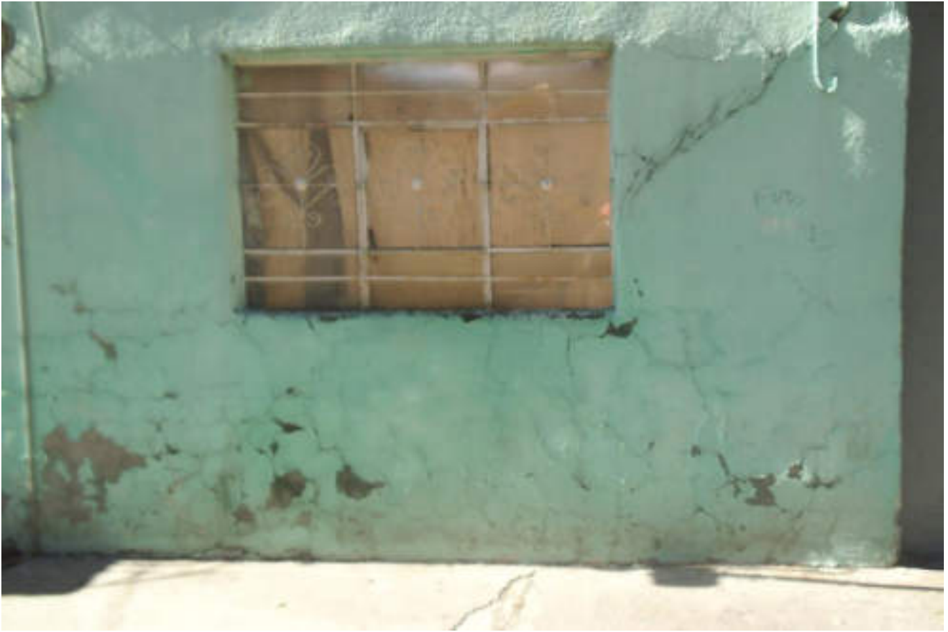
Figura 5.122. Fotografía C (Imagen 19), donde se observa un abundamiento en el aplanado, así como fracturamiento tanto en el muro de vivienda como en la banqueta (19.4900° N; 99.2089° W. Calle: Francisco Sarabia).
