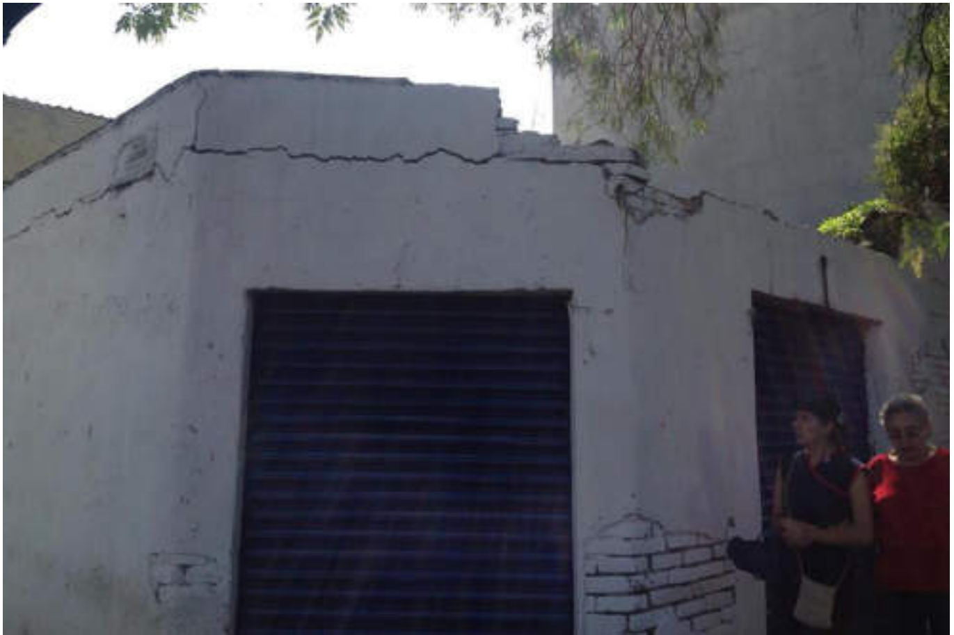
Figura 5.140. Fotografía B (Imagen 22), que muestra el muro de un inmueble afectado por fracturas en su parte superior, se observa el desprendimiento de ladrillos y aplanado, por lo que el muro pierde protección viéndose afectadas las juntas entre ladrillos (19.4869° N; 99.1929° W. Calle: Axolohua).
