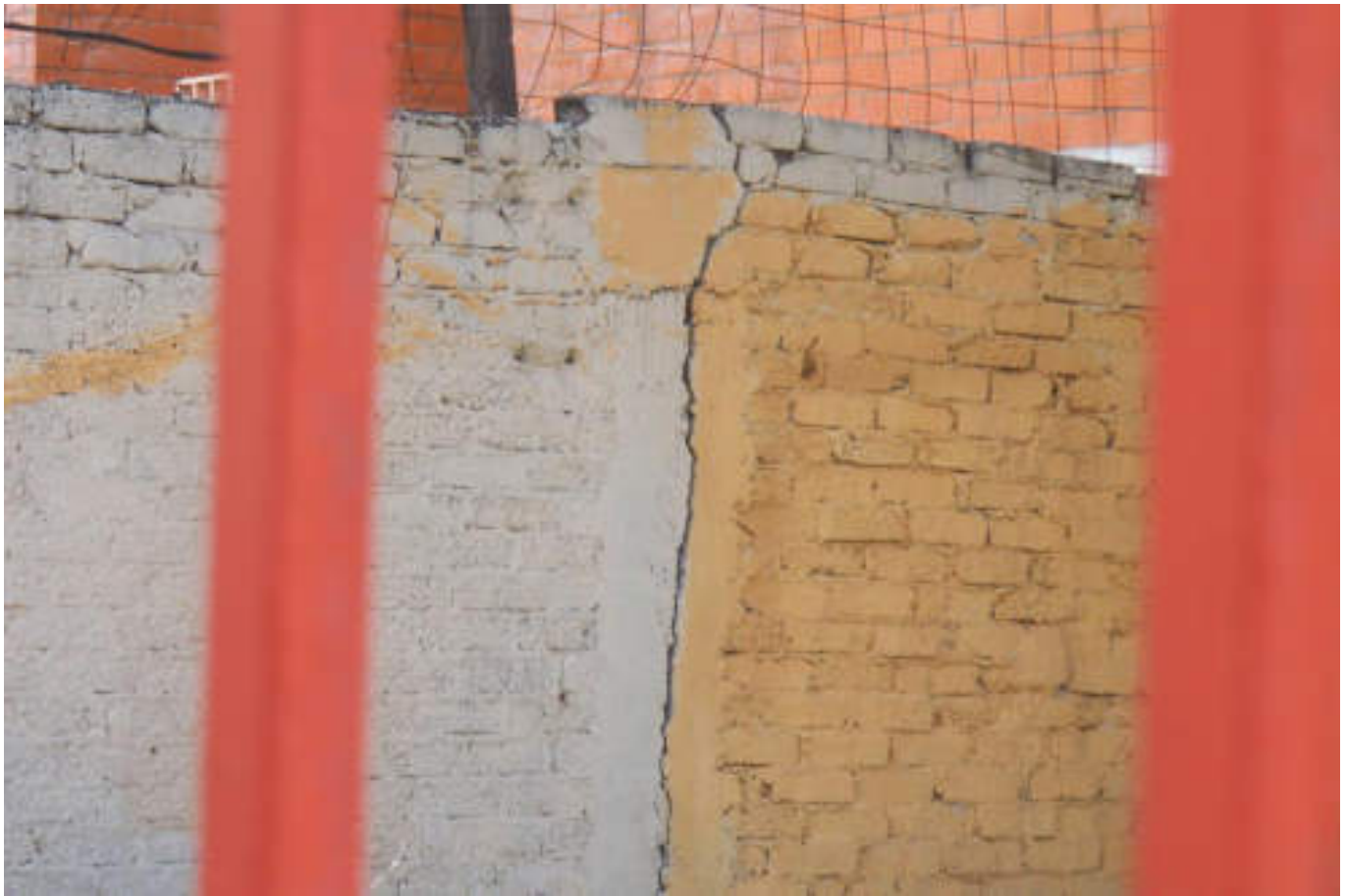
Figura 5.106. Fotografía C (Imagen 16), en ella se muestra un muro de mampostería sin confinar que presenta una fractura vertical que corta axialmente dicho elemento, a su vez se observa un mal sistema y criterio constructivo como la falta de castillos para confinar al elemento. Cabe mencionar que ésta es una de las viviendas reconstruidas después del sismo de 1985 (19.49287° N, 99.182° W. Calle: José María Morelos).
