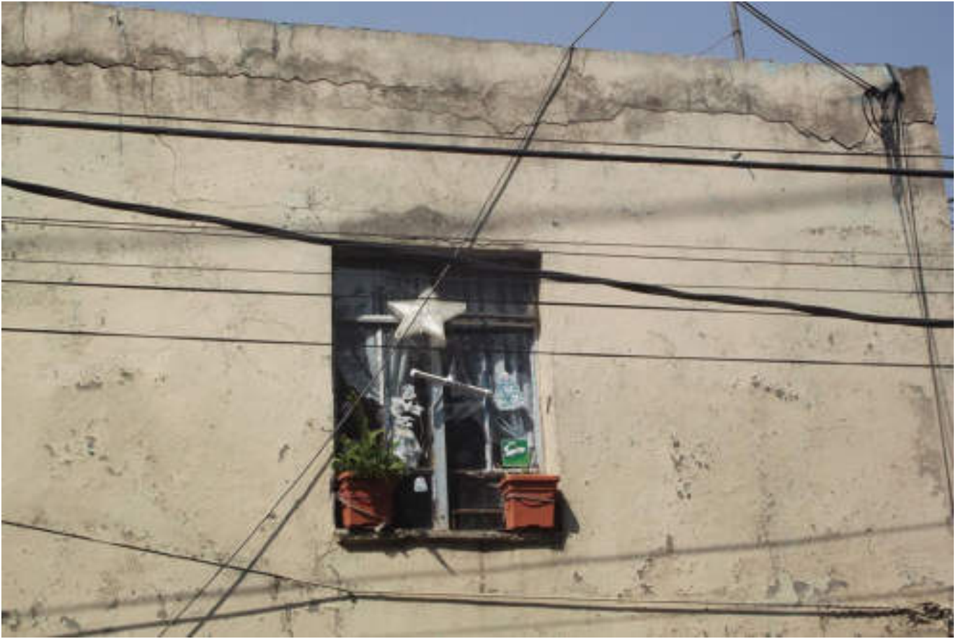
Figura 5.384. Fotografía B (Imagen 67), que muestra una fractura horizontal en la parte superior del inmueble, la fractura genera una separación aproximada de 2 cm, en la parte izquierda de la ventana se pueden distinguir fracturas tenues sobre el aplanado (19.4640° N, 99.1617° W. Calle: Unión).
