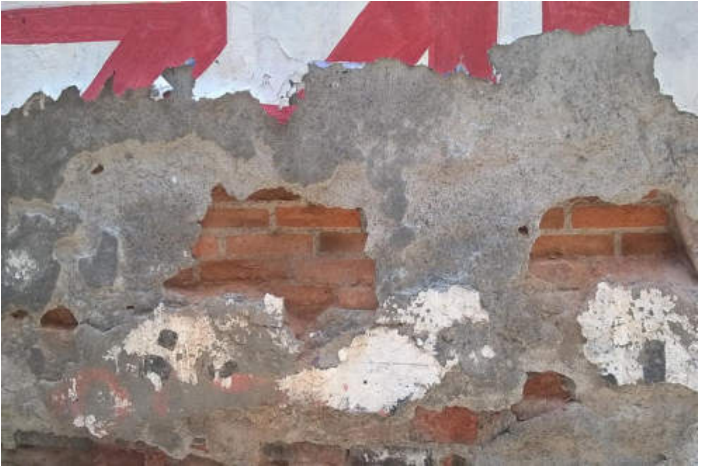
Figura 5.212. Fotografía D (Imagen 34), muro con presencia de desprendimiento de aplanado, se distingue el desgaste de los elementos que conforman la mampostería (19.4834° N, 99.1787° W. Calle: San Esteban).
