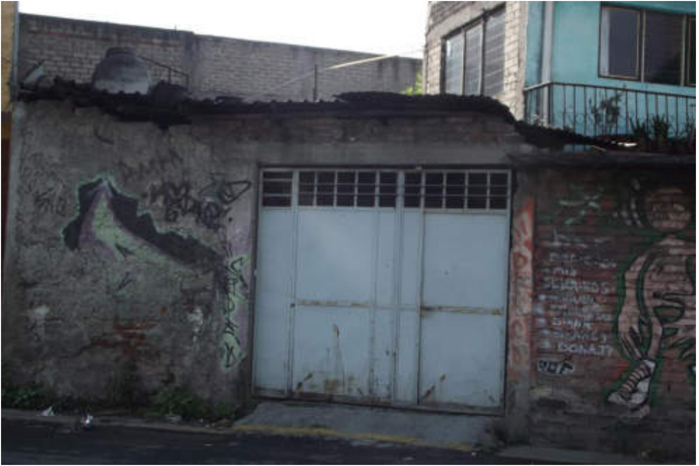
Figura 5.94. Fotografía E (Imagen 14), en la que se observa el muro exterior de un inmueble afectado por fracturas y desprendimiento de aplanado, asimismo se distingue que el material con que fue cubierta la vivienda se encuentra inestable (19.4946° N, 99.1890° W. Calle: Antiguo Camino Real).
