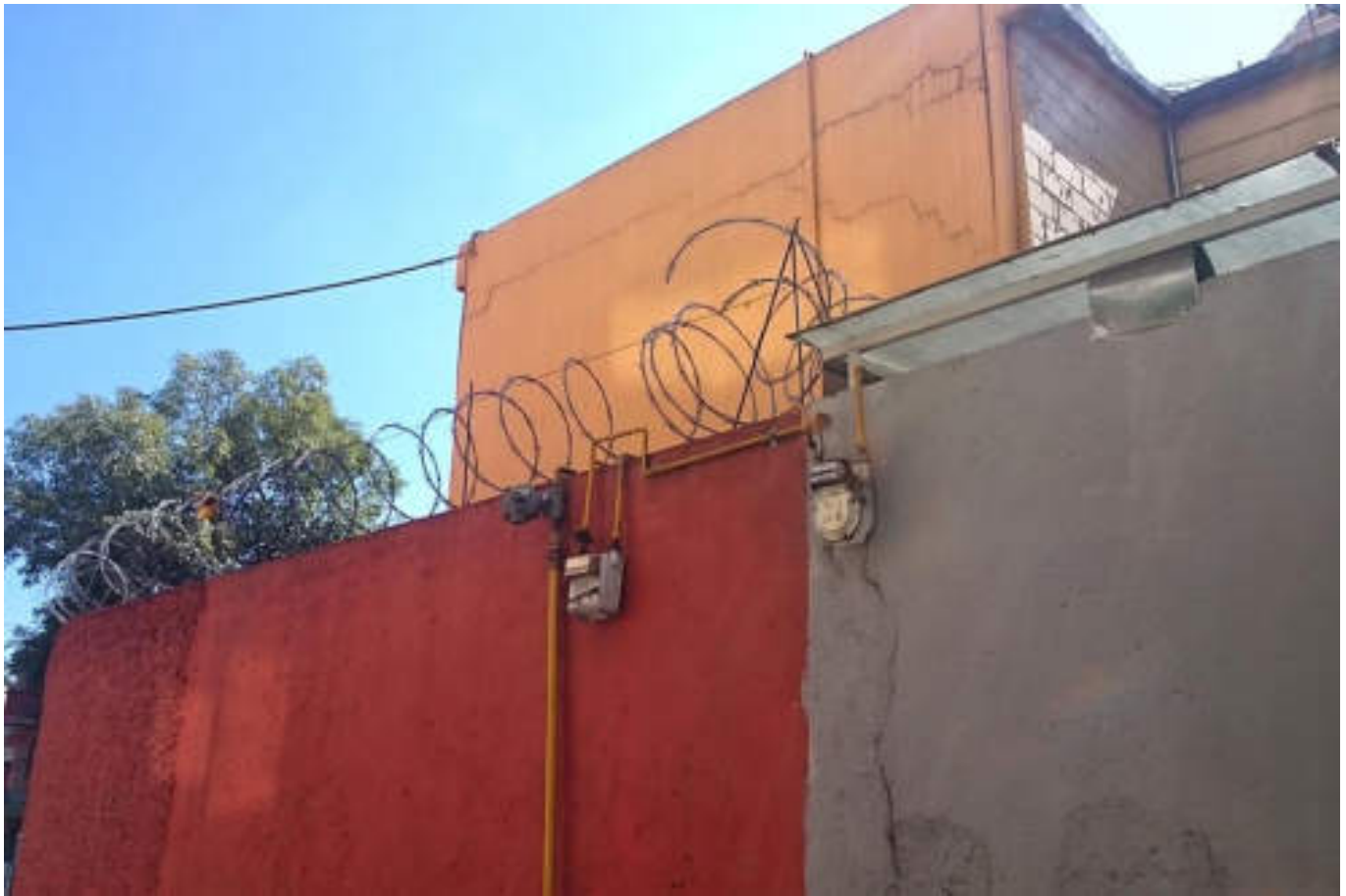
Figura 5.69. Fotografía F (Imagen 10), se muestra una vivienda de mampostería, la cual presenta múltiples fracturas en la parte superior en forma horizontal y diagonal que recorren todo el largo de la edificación y una fractura vertical en la parte inferior, que parten desde los agujeros que se le hicieron al muro y que ahora se ven cubiertos con mortero (19.4938º N, 99.2015º W. Calle: Federico Dávalos).
