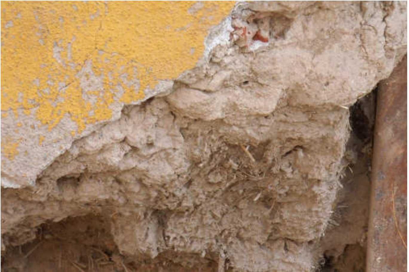
Figura 5.52. Fotografía F (Imagen 7a), se muestra la parte inferior de un muro de adobe, el cual ha perdido el aplanado que lo cubría, razón por la cual ha sufrido un desgaste (19.4989° N; 99.1916° W. Calle: Real de San Martín).
