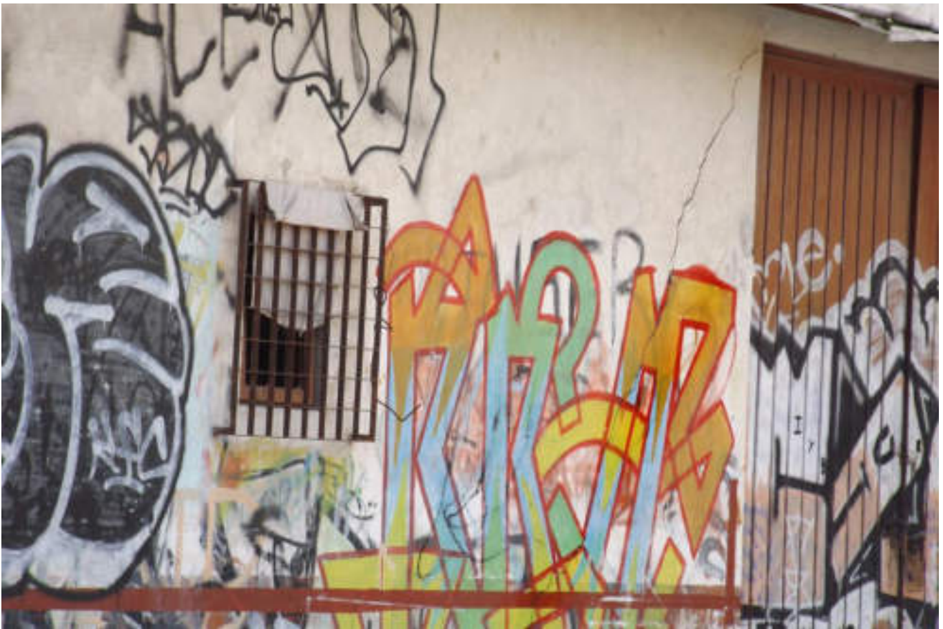
Figura 5.16. Fotografía A (Imagen 2), en ella se muestra una estructura de mampostería confinada, que en la parte superior izquierda de la puerta presenta una fractura en diagonal, que provoca la separación del elemento estructural (19.5049° N, 99.1920° W. Calle: Akan).
