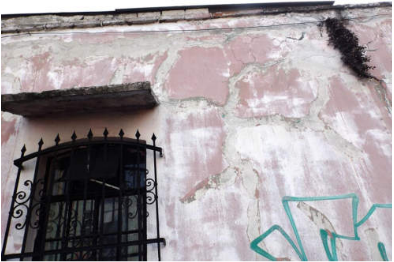
Figura 5.252. Fotografía C (Imagen 42), se muestra la fachada de una vivienda con múltiples fracturas diagonales y horizontales en el aplanado de concreto, se distingue como estas fracturas han sido reparadas con anterioridad (19.4797° N, 99.1904° W. Calle: Manuel Acuña).
