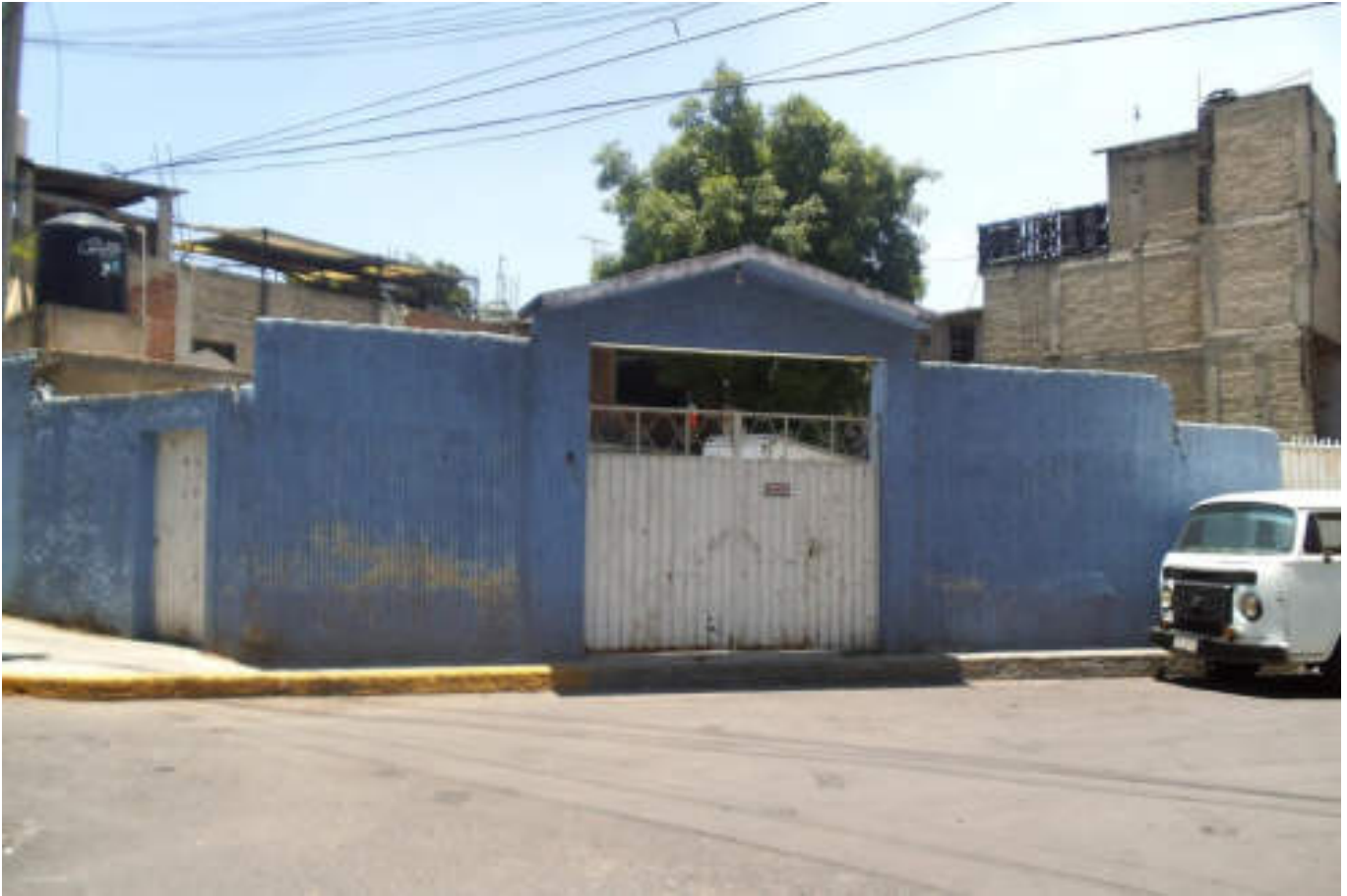
Figura 5.36. Fotografía E (Imagen 5), barda de mampostería no confinada con una fractura diagonal en el cambio de nivel del muro (19.5046° N, 99.1757° W. Calle: Emiliano Zapata).
