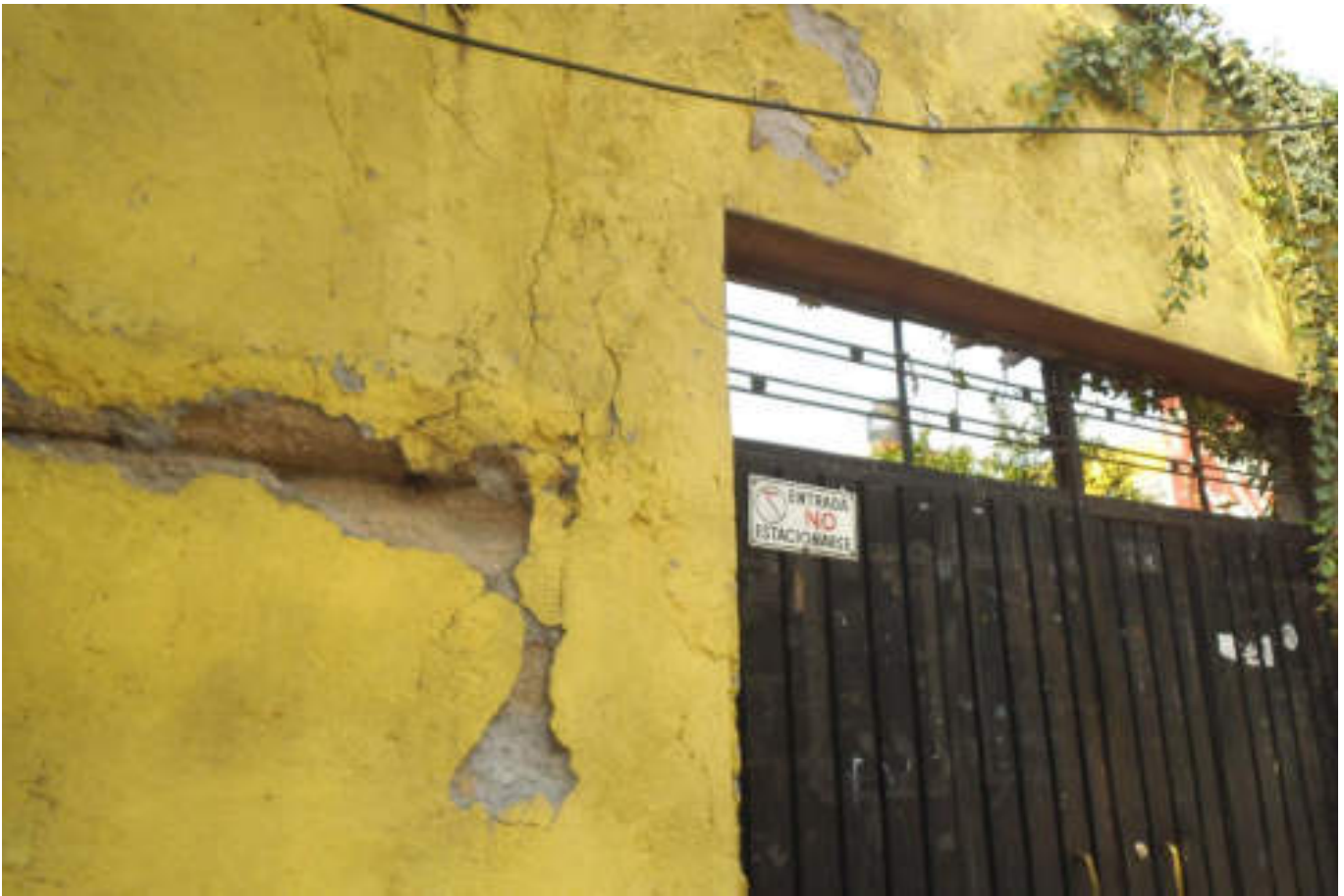
Figura 5.370. Fotografía E (Imagen 64), se aprecia el desprendimiento del material constructivo en muro perimetral, se observa el deterioro de los tabicones, en la parte superior existe una fractura vertical que llega hasta la parte media del muro (19.4653° N, 99.1498° W. Calle: 4).
