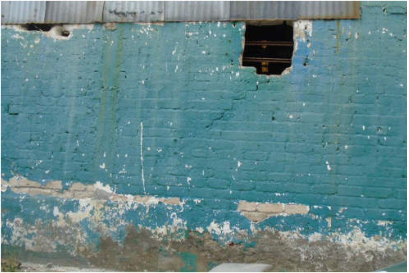
Figura 5.169. Fotografía B (Imagen 27), se muestra un muro de mampostería no confinado que presenta orificios, de los cuales se observa uno de mayor tamaño que presenta en la parte inferior una fractura escalonada (19.4763184602° N, 99.184706822° W. Calle: Primera Privada Recreo).
