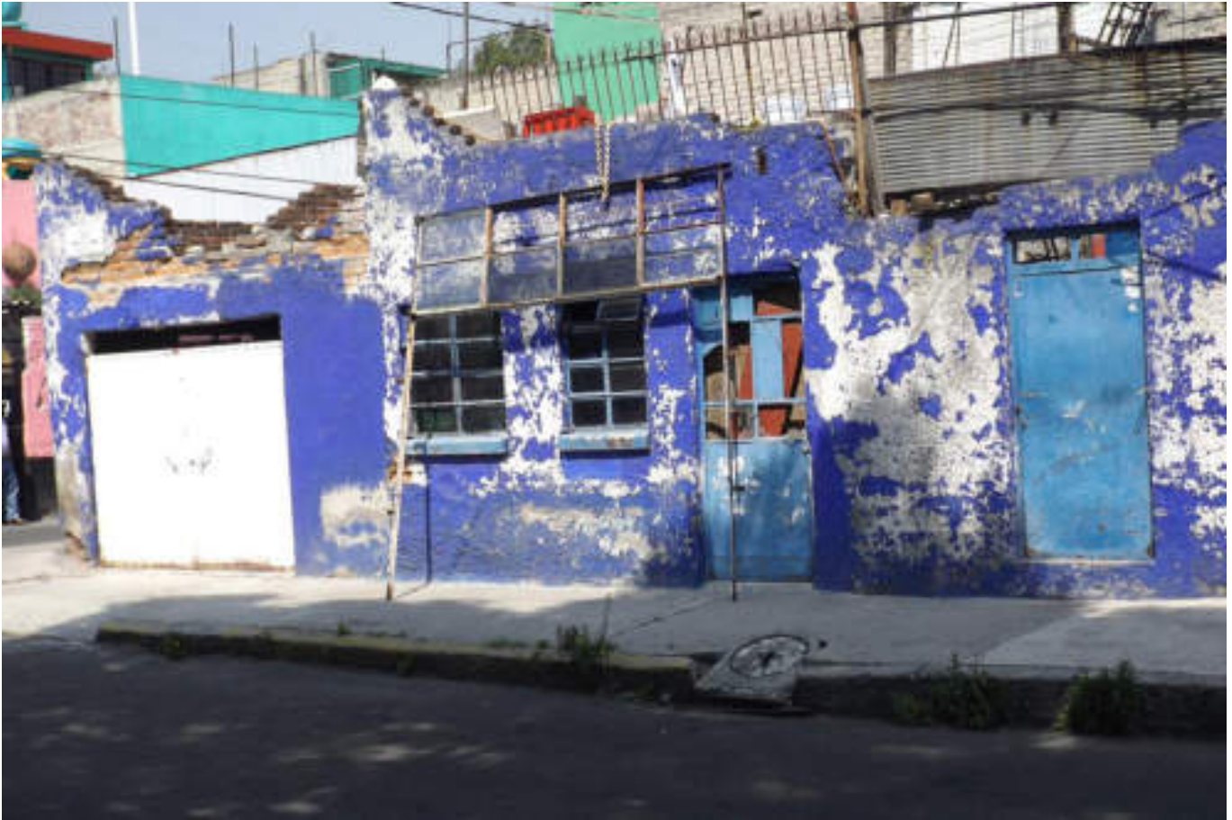
Figura 5.100. Fotografía D (Imagen 15), vivienda de mampostería sin confinamiento, presenta desprendimiento de material constructivo y de aplanado de concreto, así como daño en acabado de fachada (19.4913° N, 99.1855° W. Calle: Reynosa Tamaulipas).
