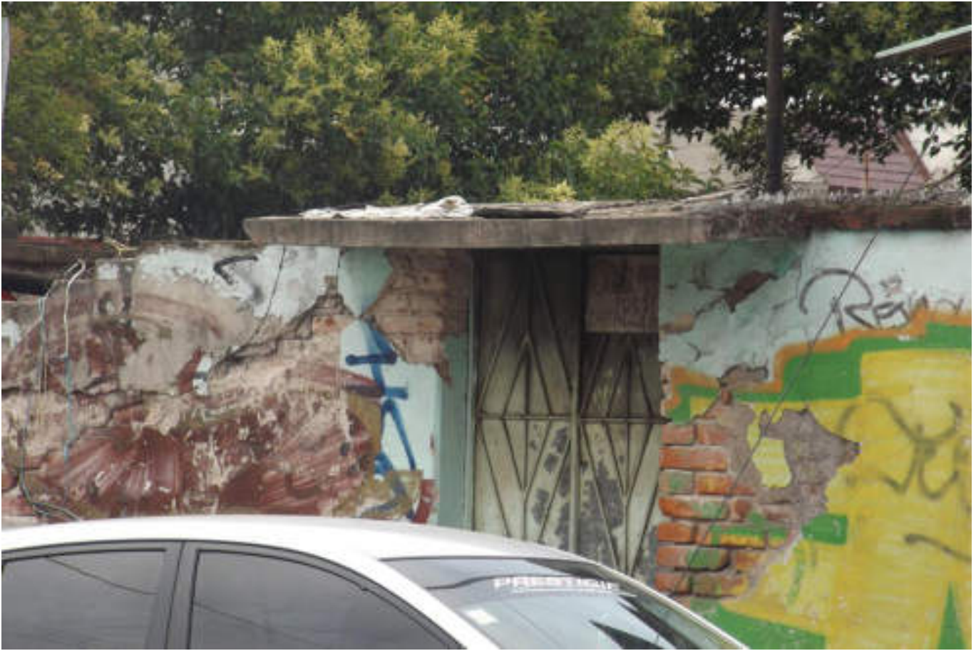
Figura 5.201. Fotografía C (Imagen 33), se observa una construcción de mampostería no confinada que presenta desprendimiento de los materiales del acabado, en la parte izquierda se presenta pérdida de los materiales de la barda provocada por una fractura diagonal (19.4843 N, 99.1868° W. Calle: Zaragoza).
