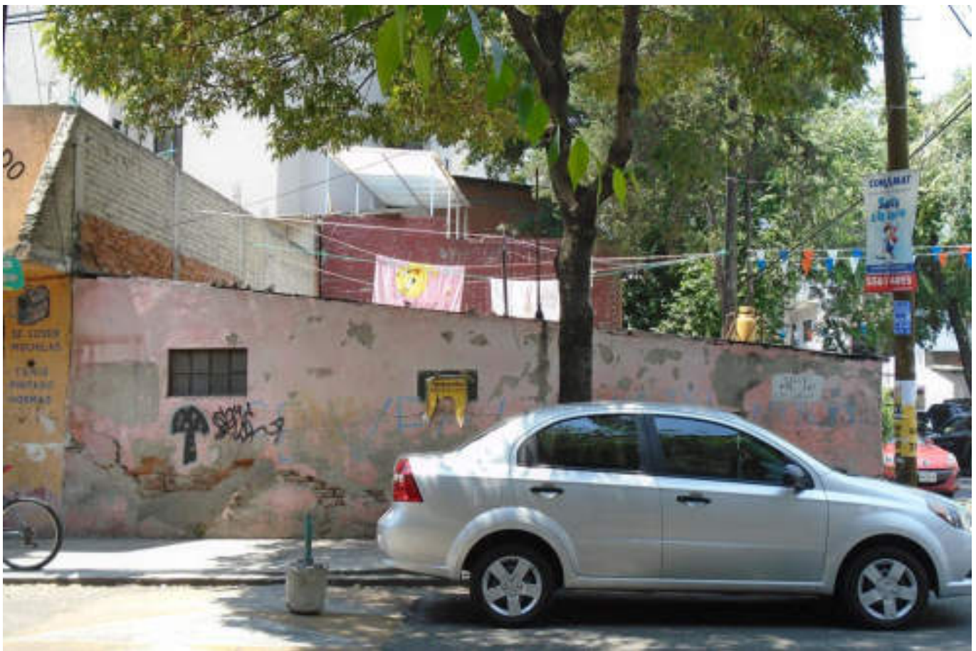
Figura 5.351. Fotografía A (Imagen 60), en ella se muestra una vivienda de mampostería sin confinar, que presenta desprendimientos parciales de acabado por la erosión y falta de mantenimiento, a su vez presenta una fractura ondulada en dirección horizontal que provoca la separación del elemento estructural (19.4666° N, 99.1759° W. Calle: Norte 75).
