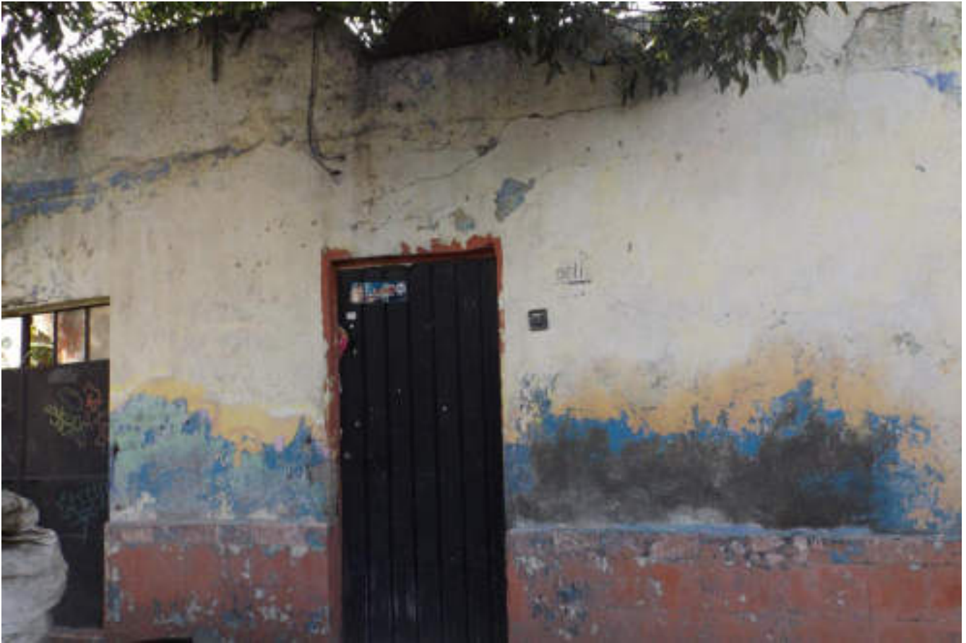
Figura 5.99. Fotografía C (Imagen 15), en la que se observa una vivienda de mampostería sin confinamiento, afectada por una fractura horizontal en aplanado de concreto de la fachada principal y fracturas diagonales en parte superior del puerta. Asimismo se observa desprendimiento parcial de aplanado en la esquina superior izquierda de la vivienda (19.4912° N, 99.1843° W. Calle: Campo lomas).
