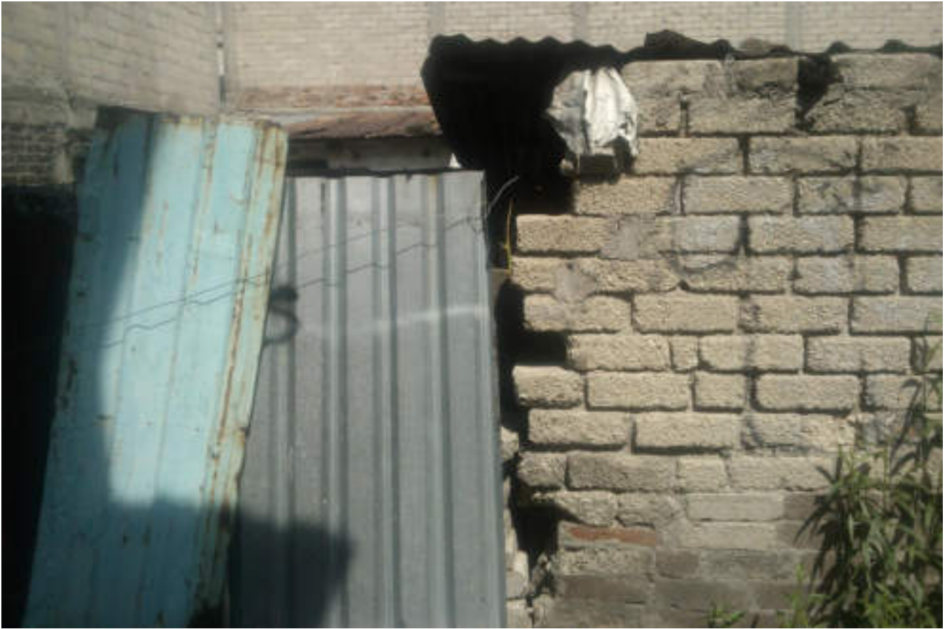
Figura 5. 28. Fotografía D (Imagen 4a), en la que se observa una vivienda de mampostería no confinada, la cual utiliza laminas como muro, sin embargo entre estas laminas y el muro no existe unión. También se aprecia desprendimiento en los tabiques que se encuentran en la parte izquierda del muro así mismo 2/3 de los tabiques presentan corrosión y mala adherencia de la junta de mortero. El muro sufre un pandeo en su parte superior derecha (19.497701233° N, 99.1839048541° W. Calle: Primera Ángeles).
