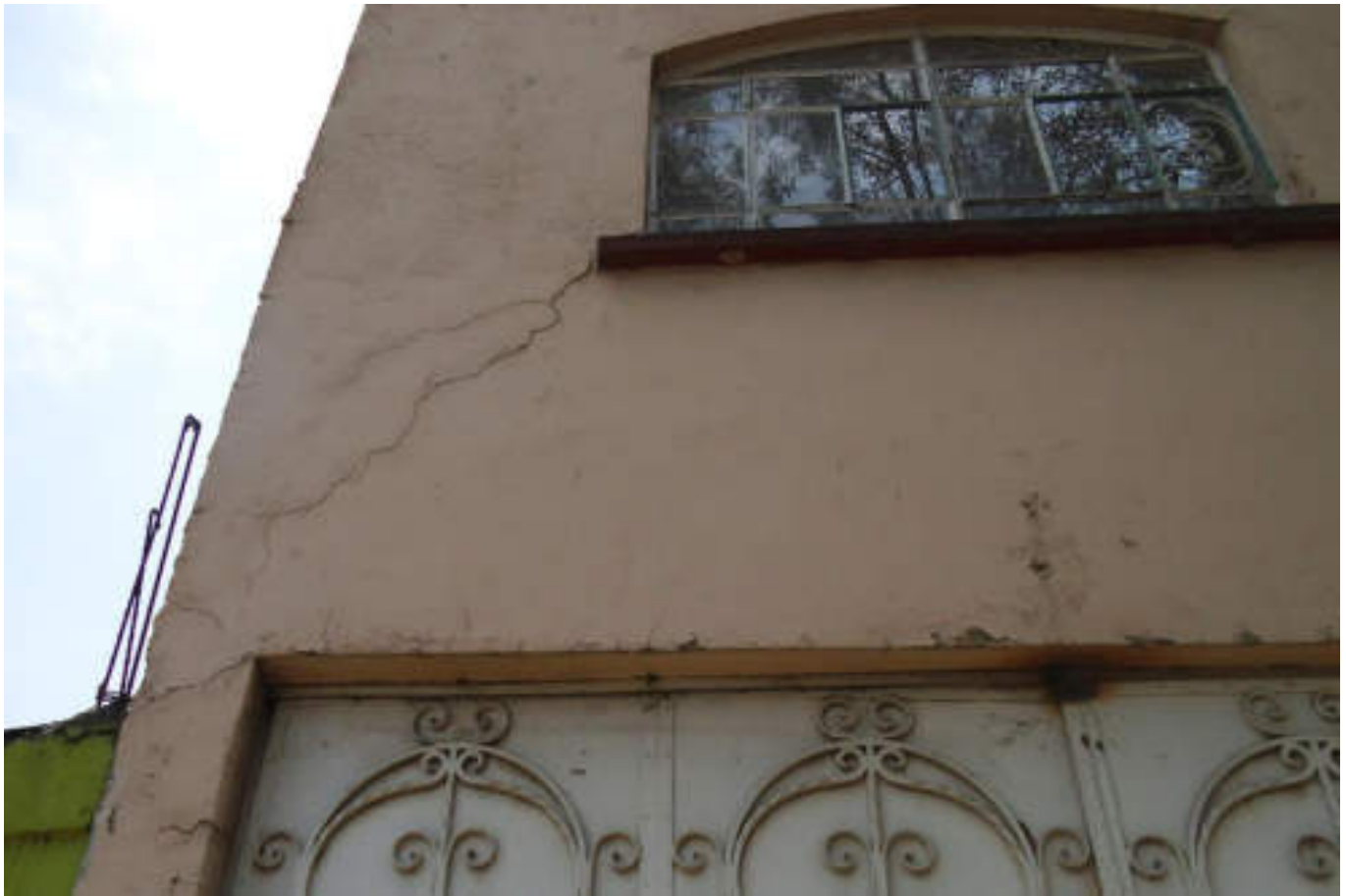
Figura 5.238. Fotografía C (Imagen 39) se observa la parte superior de una vivienda afectada por una fractura que va de la parte inferior de la ventana al límite del muro (19.4775° N, 99.1503° W. Calle: Fundidores).
