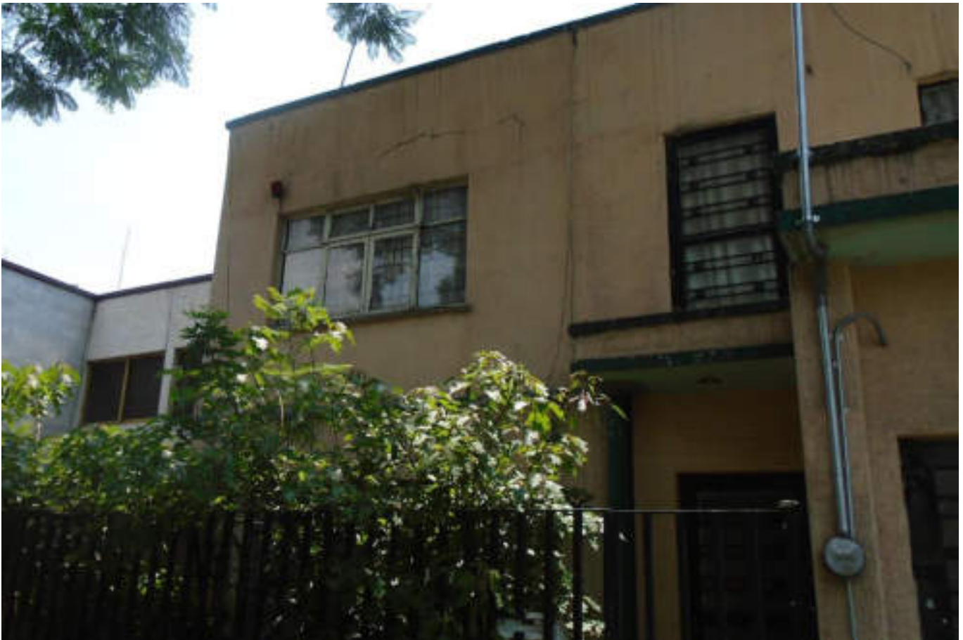
Figura 5.274. Fotografía A (Imagen 47), se observa una vivienda de mampostería que presenta una fractura horizontal en la parte superior de la estructura (19.4763184602° N, 99.184706822° W. Calle: Primera Privada Recreo).
