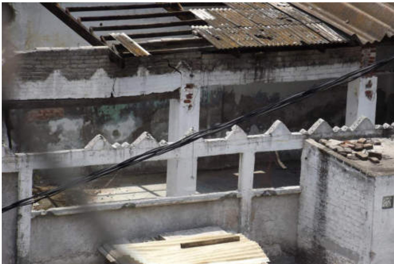
Figura 5.360. Fotografía A (Imagen 63), barda constituida de columnas cortas de concreto, muros de mampostería con partes recubiertas por cemento en donde presenta fracturas. Se aprecian marcos de mampostería con fractura diagonal y vertical, los cuales reciben la carga de la instalación del techado (19.4653° N, 99.1600° W. Calle: Privada de FF. CC. Central).
