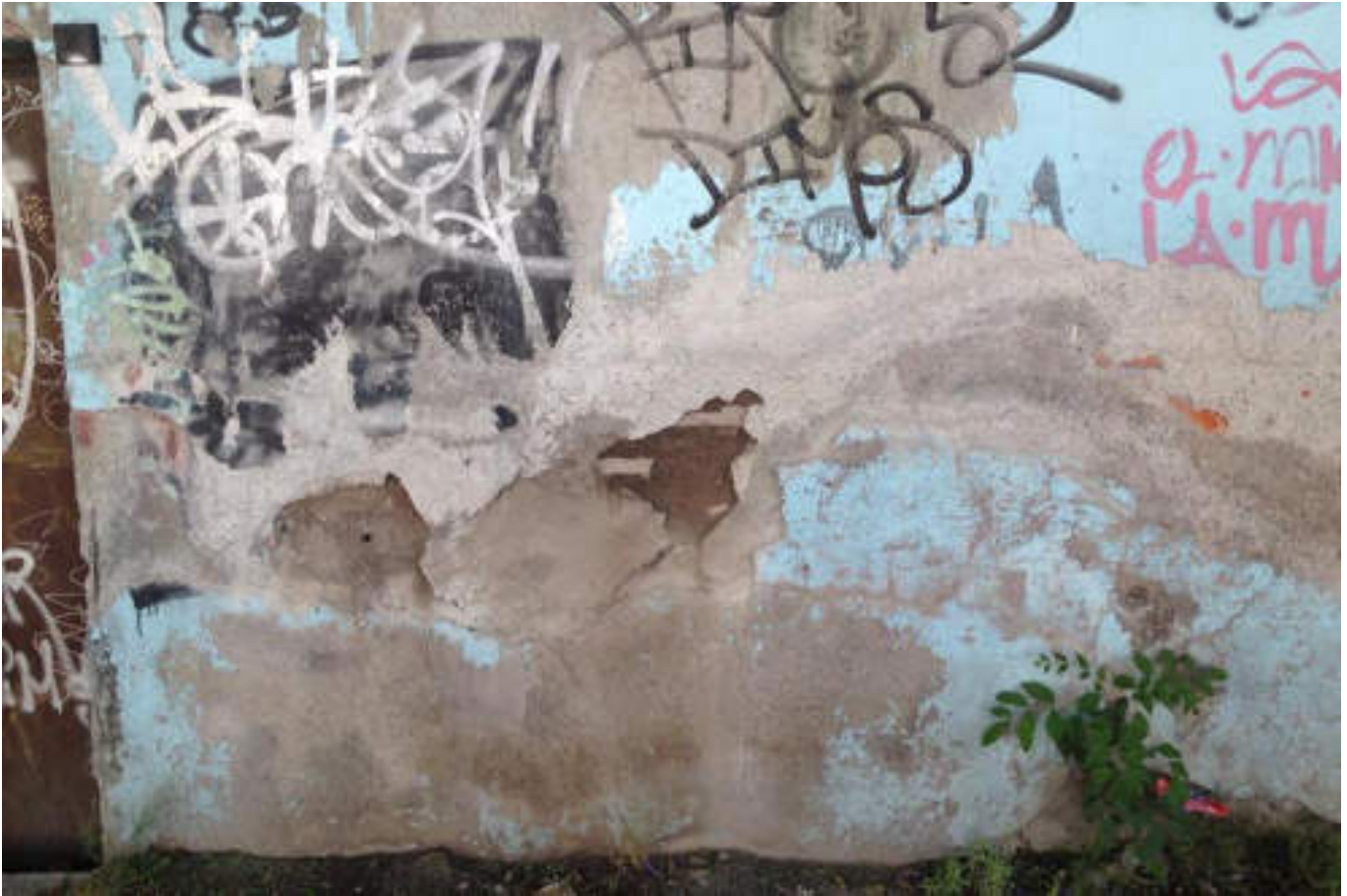
Figura 5.195. Fotografía C (Imagen 32), se observa un muro de mampostería con problemas de corrosión, ocasionando que en algunas partes el aplanado se desprenda (19.4836° N, 99.1931° W. Calle: Miguel Lerdo de Tejada).
