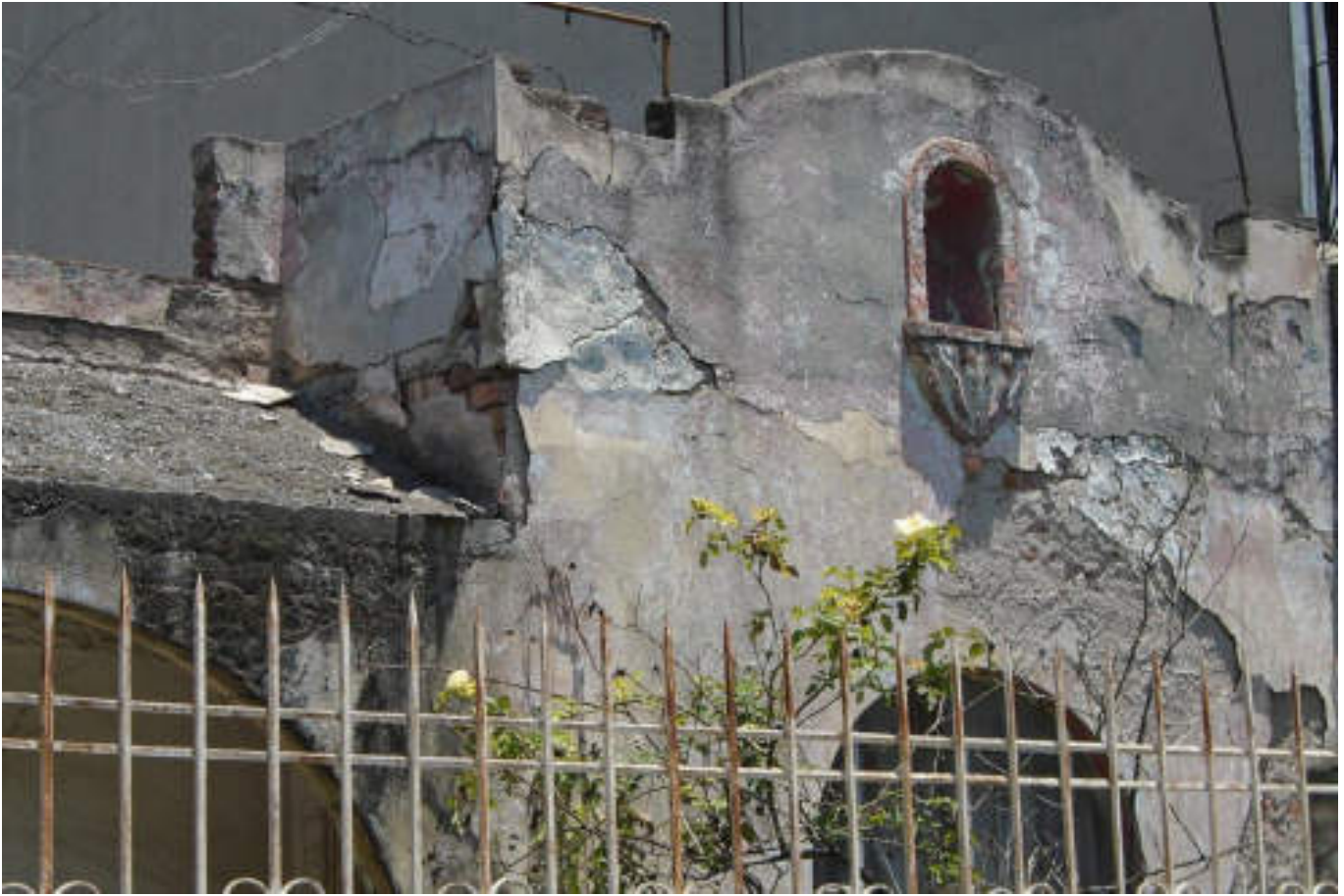
Figura 5.356. Fotografía B (Imagen 62), se muestra una estructura de mampostería sin confinar que presenta desprendimiento parcial de acabados y de elementos de mampostería (19.4610° N, 99.1684° W. Calle: Juan Sarabia).
