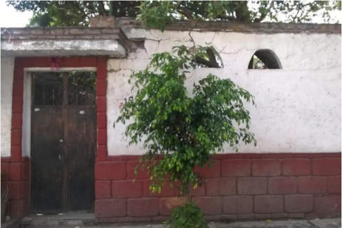
Figura 5.217. Fotografía B (Imagen 35), estructura de mampostería semiconfinada, con fracturamiento en la parte superior y desprendimiento del aplanado, se encuentran dos orificios en el muro en forma de semicírculo a poca distancia uno del otro, presentando una fractura a lo largo de la separación de éstos (19.4812° N, 99.1825° W. Calle: San Sebastián).
