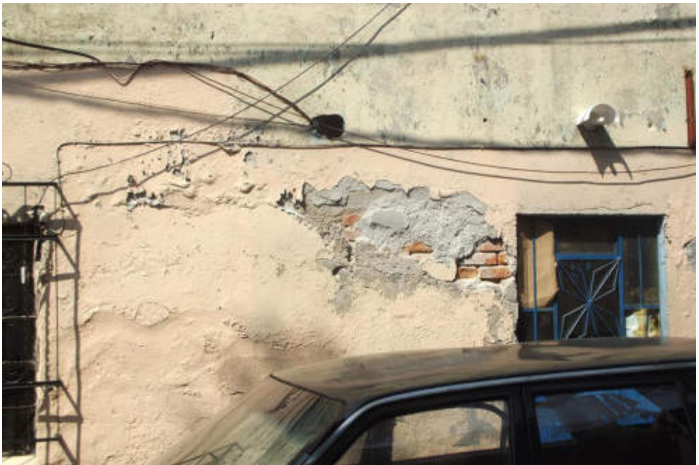
Figura 5.383. Fotografía A (Imagen 67), en la que se observa abundante desprendimiento del aplanado dejando al descubierto el material de construcción (19.4640° N, 99.1617° W. Calle: Unión).
