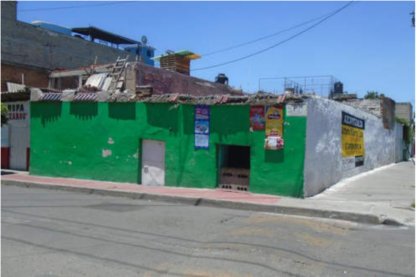
Figura 5.321. Fotografía E (Imagen 55), donde se muestra el fenómeno del hundimiento, al observarse el cambio de nivel que hay en la vivienda con respecto al nivel de calle, además de que en el muro de la esquina de dicho inmueble se observa el desnivel que hay con respecto a otras partes de él (19.4735° N, 99.2102° W. Calle: Calzada Ahuizotla).
