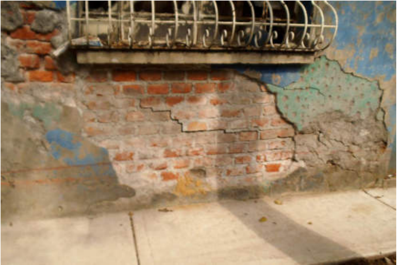
Figura 5.369. Fotografía D (Imagen 64), podemos observar una fractura en forma diagonal escalonado provocando la separación entre las piezas de mampostería, es visible el desprendimiento en el aplanado, además se aprecia corrosión en los elementos de mampostería, también se aprecia una fractura que recorre las juntas de los elementos de mampostería debajo de la ventana (19.4642657924° N, 99.1479344525° W. Calle: Cholultecas).
