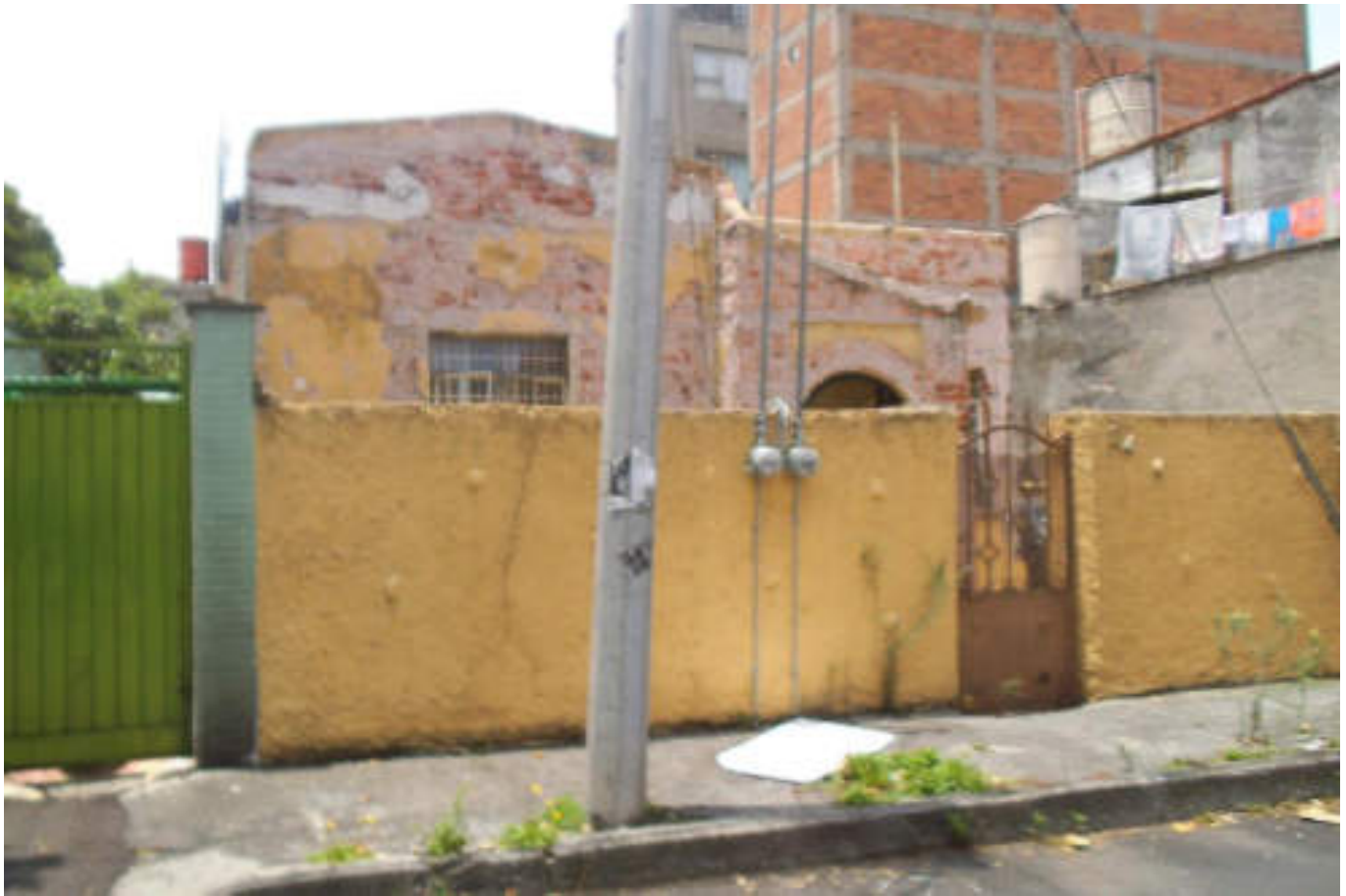
Figura 5.346. Fotografía C (Imagen 60), barda perimetral que presenta una fractura vertical a la mitad del muro izquierdo. El interior de la vivienda ha perdido en la mayor parte de su superficie los acabados (19.467° N, 99.1844° W. Calle: Pirámides).
