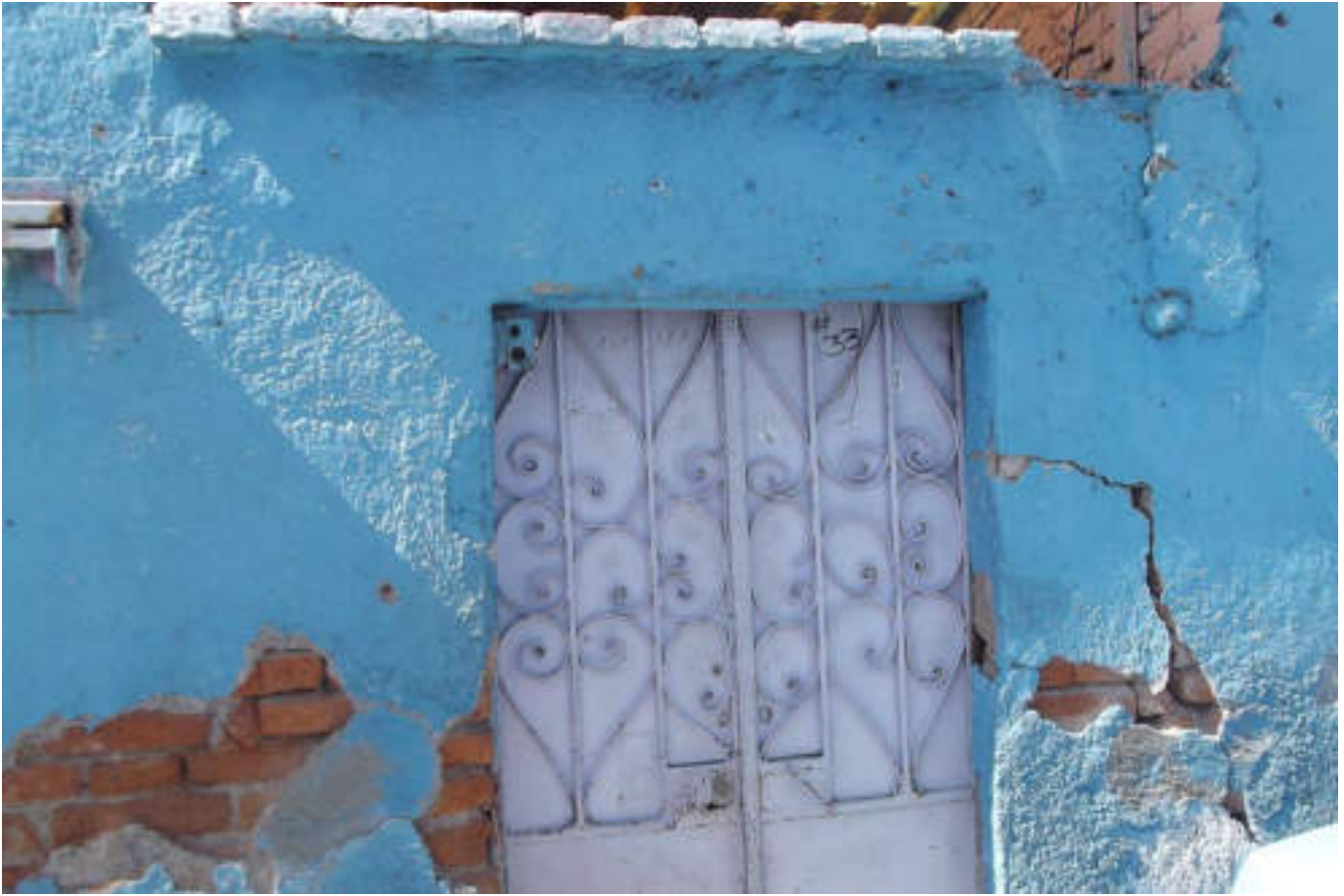
Figura 5.129. Fotografía D (Imagen 20), en esta imagen podemos apreciar una vivienda de mampostería, la cual presenta una fractura en forma diagonal que provoca que parte del muro tenga una separación causando que no trabaje como un mismo elemento, siendo vulnerable a colapsar debido a la falta de refuerzos tanto verticales (castillos) como horizontales (cadena de cerramiento) que le den rigidez y confinamiento (19.4896° N, 99.2052° W. Calle: General Maclovio Herrera).
