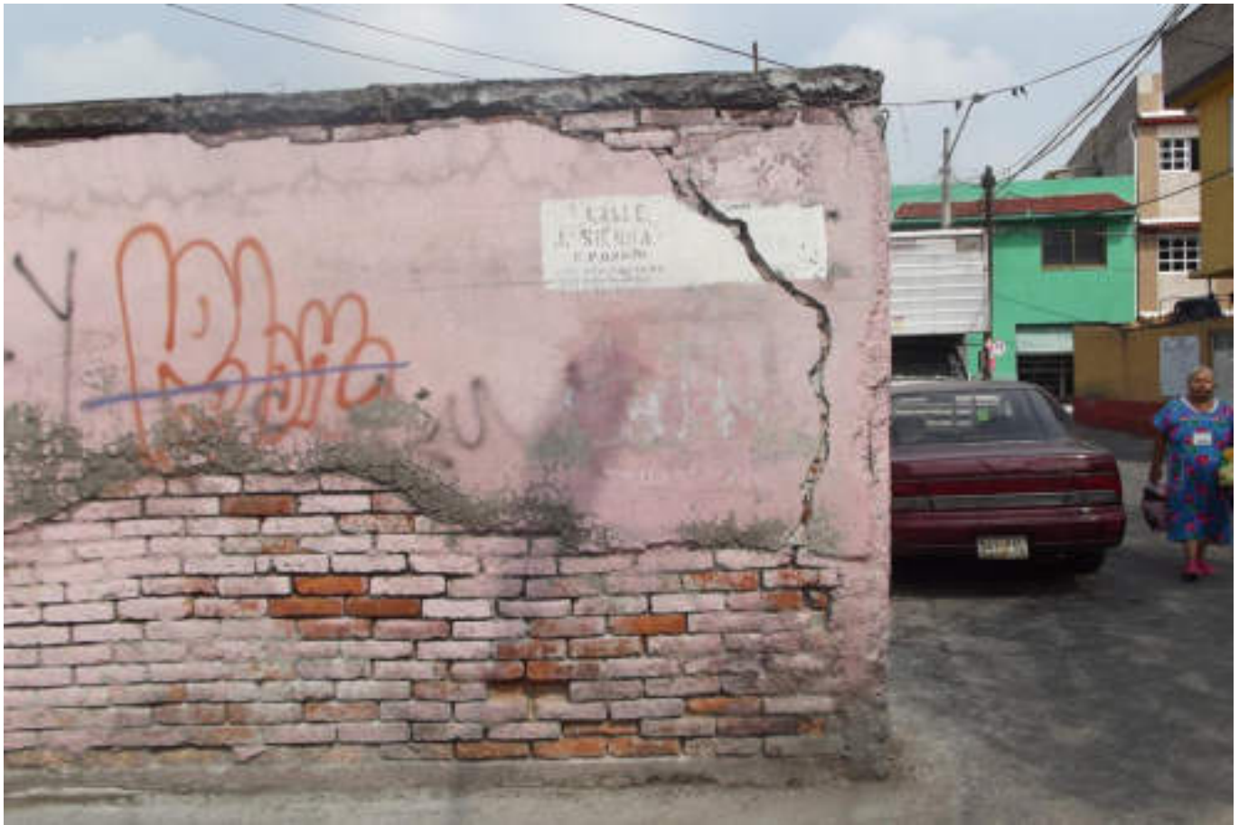
Figura 5. 26. Fotografía B (Imagen 4a), barda perimetral de mampostería no confinada que cuenta con una fractura diagonal y vertical en el acabado. La junta de mortero presenta erosión, la losa se observa deteriorada y con desprendimiento del concreto dejando al descubierto el acero utilizado para el refuerzo (19.495811994° N, 99.1807540541° W. Calle: Justo Sierra).
