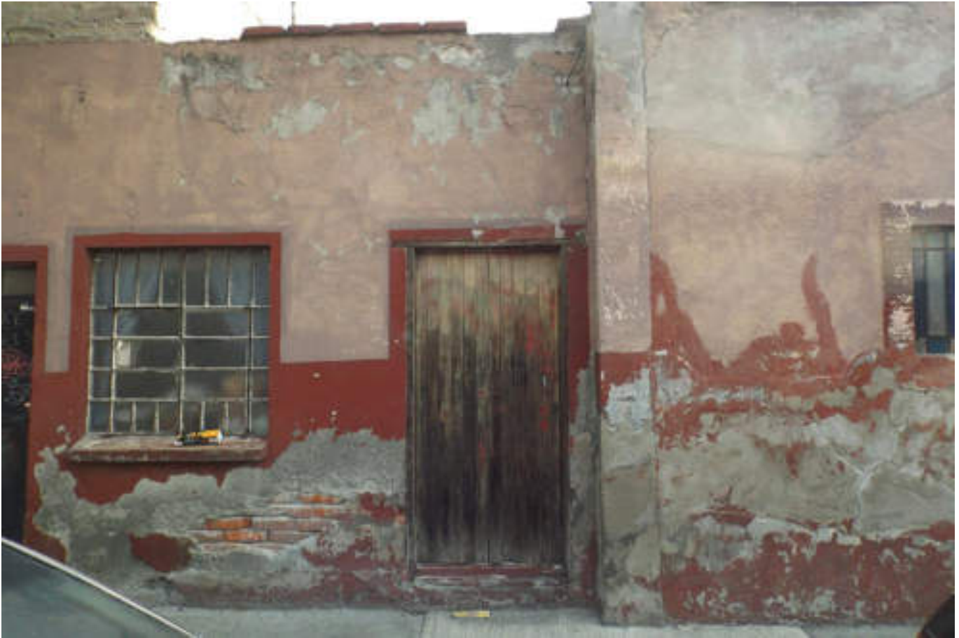
Figura 5.253. Fotografía D (Imagen 42), vivienda de mampostería sin confinamiento con fracturas diagonales en aplanado de concreto, el muro presenta desprendimiento parcial de aplanado al costado izquierdo de la puerta, esta última enmarcada por tablas de madera, existe recubrimiento con concreto en algunas de las zonas afectadas (19.4791º N, 99.1910º W. Calle: Amado Nervo).
