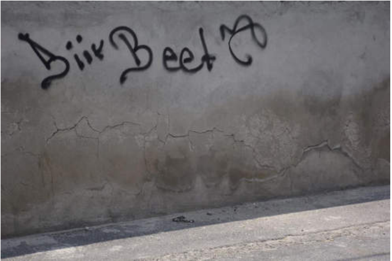
Figura 5.84. Fotografía B (Imagen 13), se observa un muro de mampostería que presenta una alta densidad de fracturas a lo largo de toda su área, se puede distinguir una franja de una coloración más obscura indicando humedad (19.4990° N, 99.1891° W. Calle: Privada FF.CC. Nacionales).
