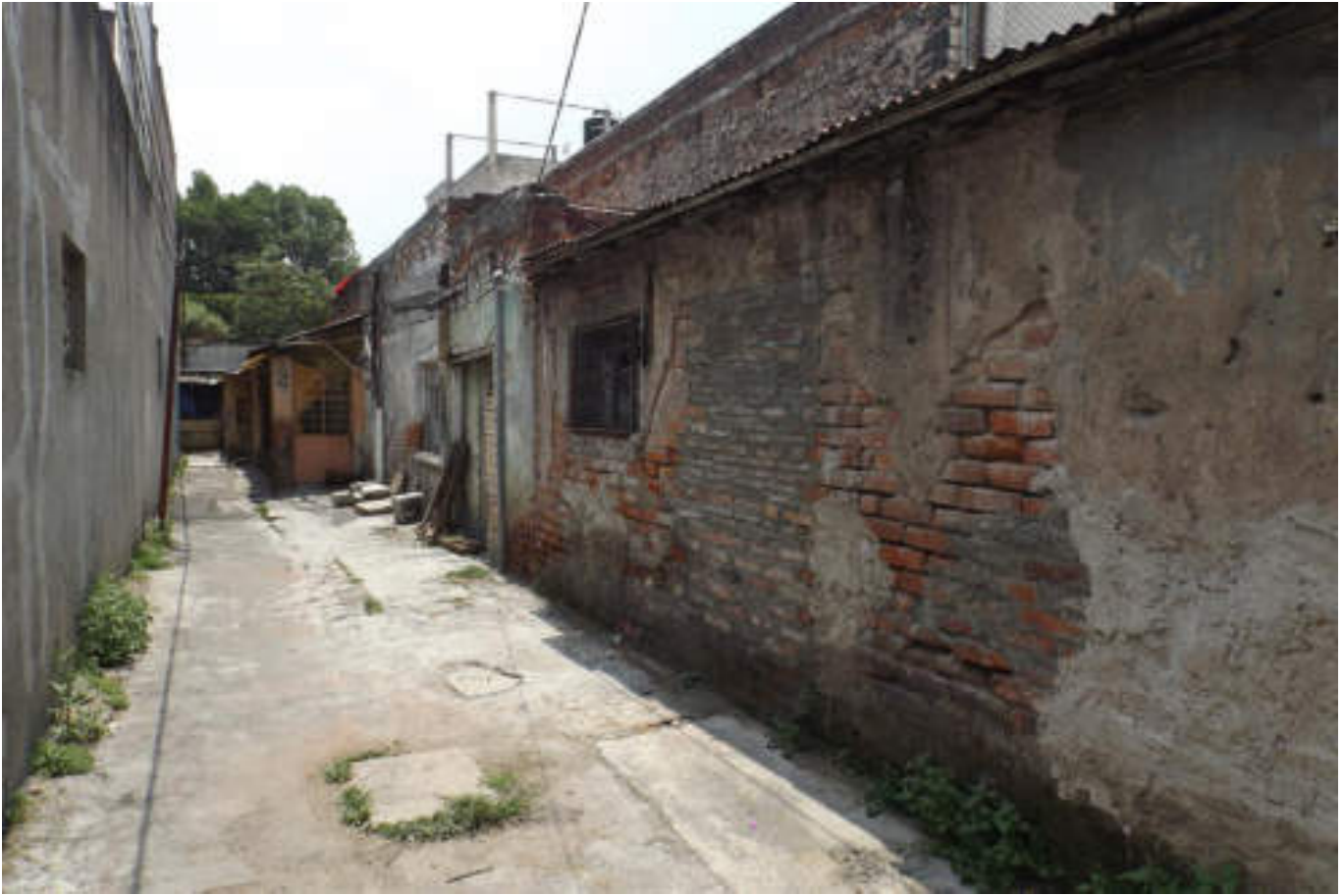
Figura 5.341. Fotografía F (Imagen 59), vivienda con daño en su acabado y desintegración de material de construcción, se distingue que la vivienda ha sido construida con diferentes materiales, lo que reduce su estabilidad (19.4617° N, 99.1870° W. Calle: Mar del Norte).
