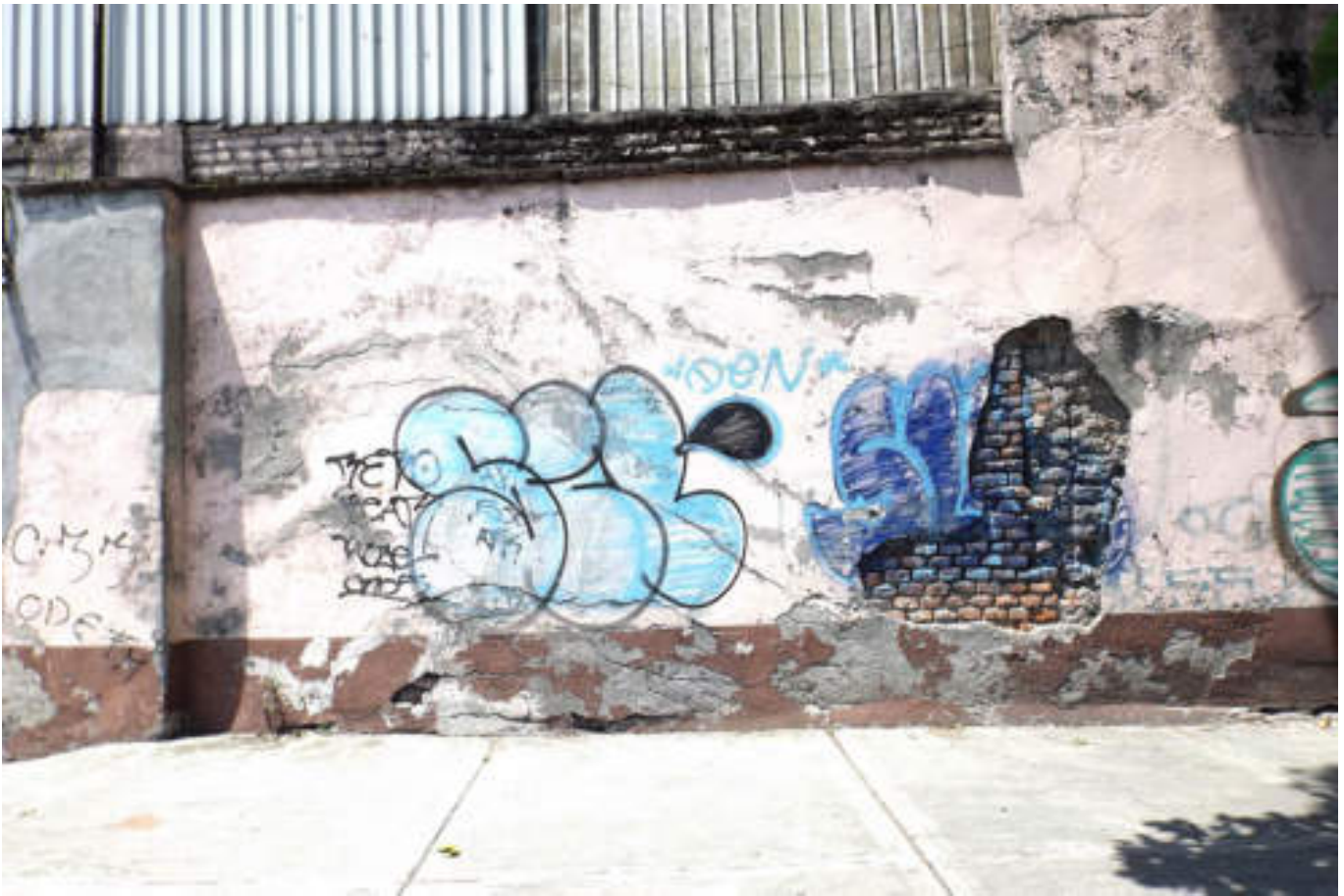
Figura 5.210. Fotografía B (Imagen 34), en donde se observa el desprendimiento de material de un muro, a casusa de fracturas en la parte inferior del mismo, de igual manera en la parte central se observa el material con que fue construido debido a la ausencia del aplanado que recubra dicha zona (19.4812° N, 99.1812° W. Calle: San Sebastián).
