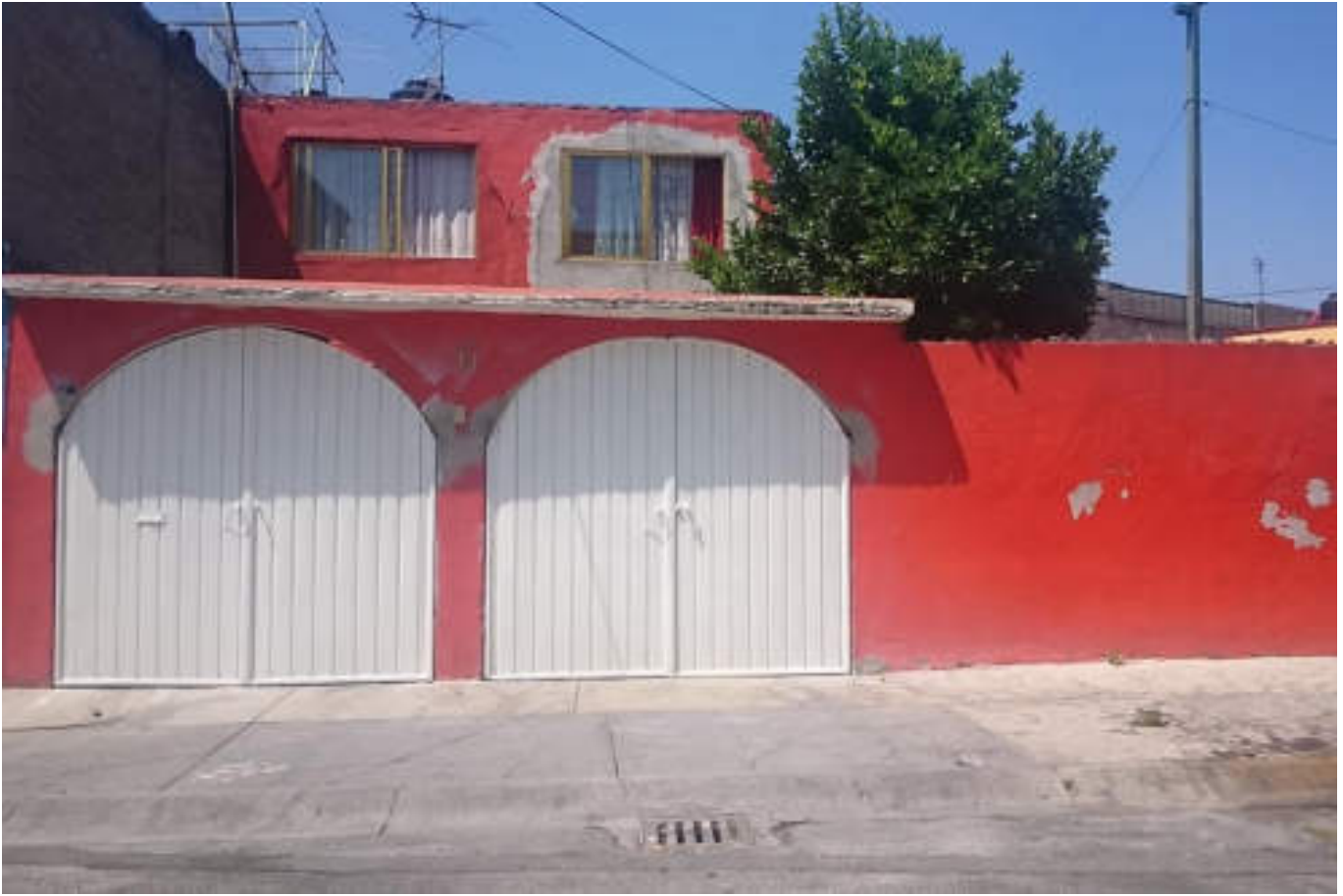
Figura 5.11. Fotografía C (Imagen 1a), en ella se muestra una vivienda de mampostería sin confinar que presenta desprendimientos parciales de acabados, a su vez presenta una remodelación en la ventana derecha de la construcción, en la que no se realizó un apropiado proceso constructivo para su debida ejecución (19.5131º N, 99.2040º W. Calle: Casiopea).
