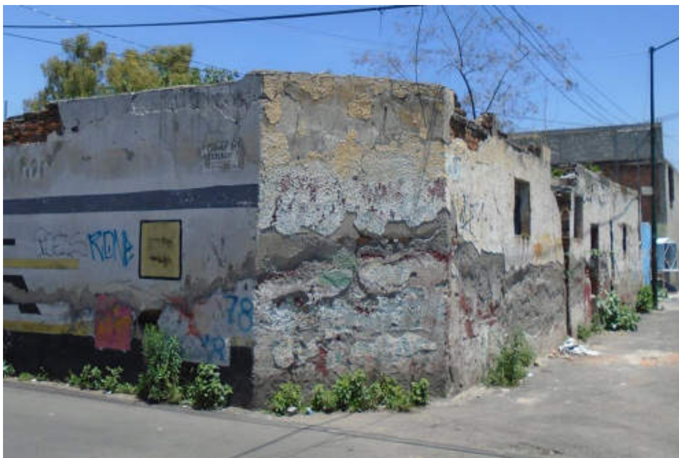
Figura 5.317. Fotografía A (Imagen 55), que muestra el muro exterior de un inmueble afectado por fracturas y desprendimiento de material en la parte superior del pretil (19.4782° N, 99.2103° W. Calle: La Piedra).
