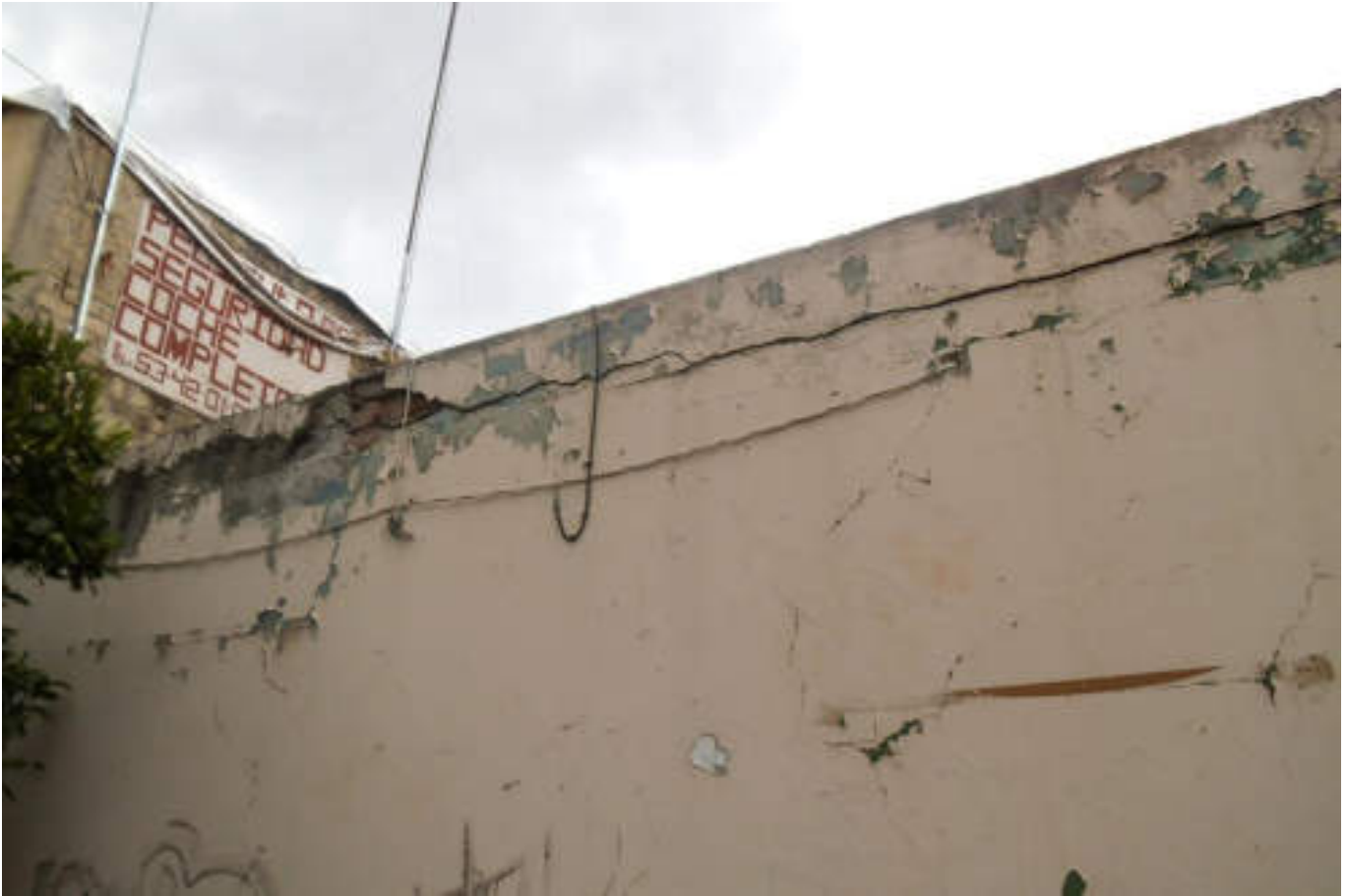
Figura 5.267. Fotografía A (Imagen 45), que muestra el muro externo de una vivienda afectado por fracturas horizontales propiciando el desprendimiento de material (19.4713° N, 99.1781° W. Calle: Norte 81-A).
