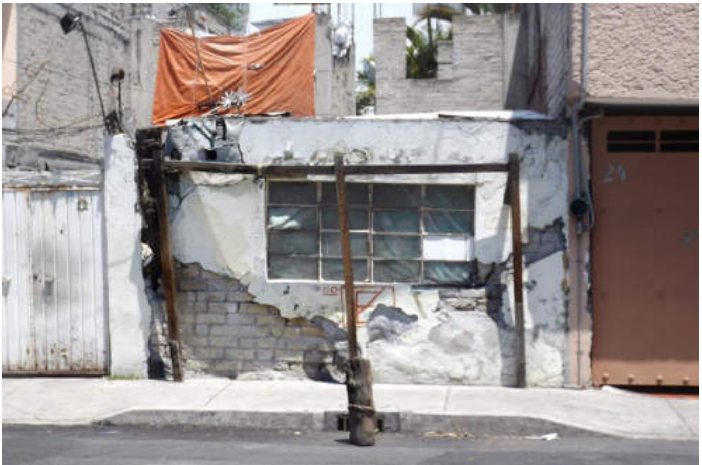
Figura 5.209. Fotografía A (Imagen 34), en ella se muestra una estructura de mampostería sin confinar, que presenta desprendimientos parciales acabados y colapsos parciales del muro, a su vez sufre una fractura vertical que separa los elementos estructurales: columna, muro (19.4821° N, 99.1817° W. Calle: Calzada Azcapotzalco La Villa).
