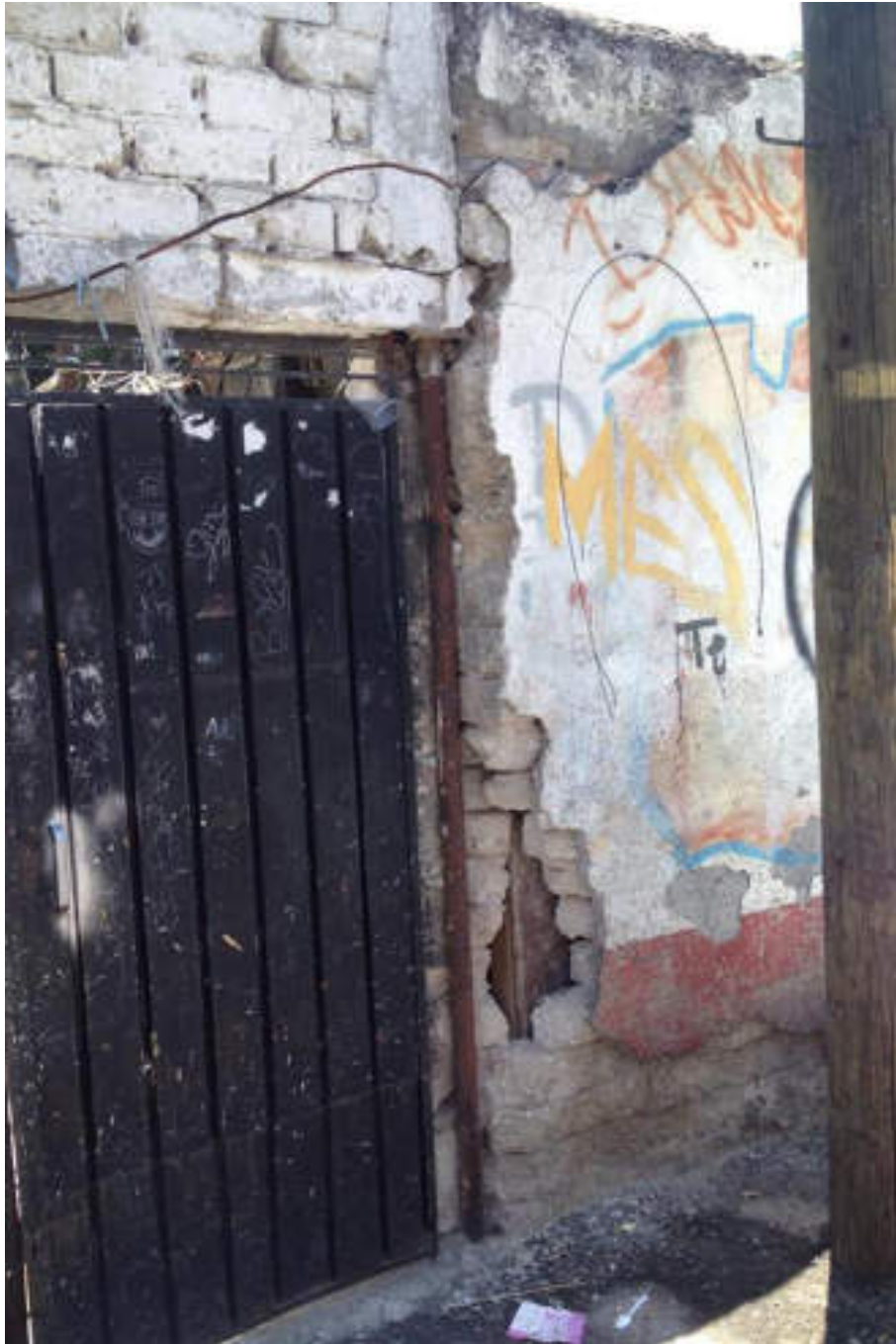
Figura 5.314. Fotografía A (Imagen 54), se muestra una barda de mampostería no confinada con desprendimiento parcial de aplanado de concreto a causa de fracturas, no tiene adherencia entre las juntas de los tabiques, ocasionando la pérdida del mismo (19.4827° N, 99.2085° W. Calle: Privada Morelos).
