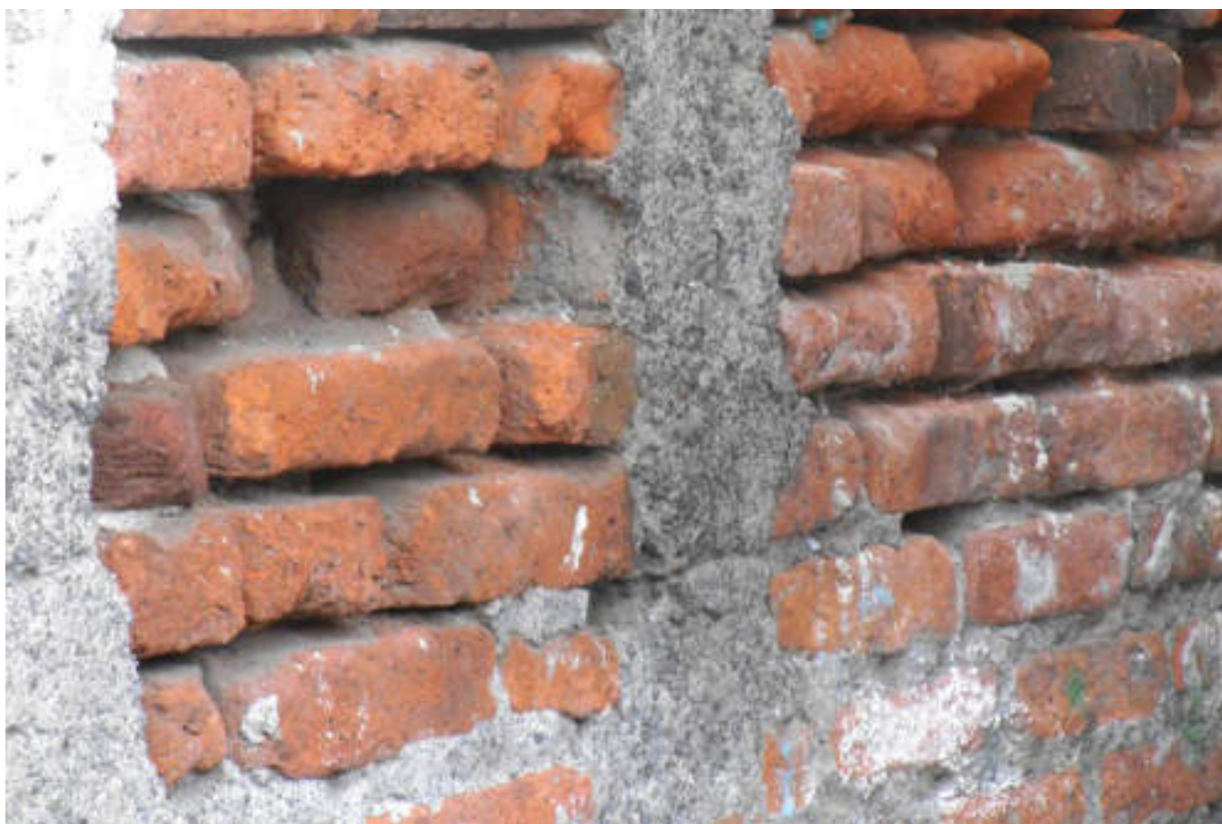
Figura 5.47. Fotografía A (Imagen7a ), que muestra el desgaste en ladrillos del muro de un inmueble a causa del intemperismo y la inexistencia de alguna protección como un aplanado de concreto; este deterioro ha afectado de igual manera a la junta entre ladrillos provocando que se desprenda (19.4994º N,99.1972º W. Calle: Hutzilin).
