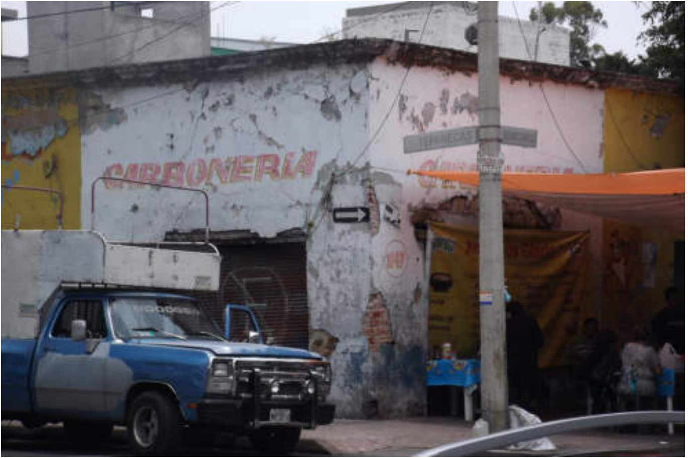
Figura 5.202. Fotografía D (Imagen 33), muro exterior que presenta fracturas en el aplanado, desprendimiento del mismo y por ende el deterioro de las pizas que componen sus muros, la lona amarilla cubre casi en su totalidad una demolición realizada a la estructura (19.4813° N, 99.1845° W. Calle: Tepanecos).
