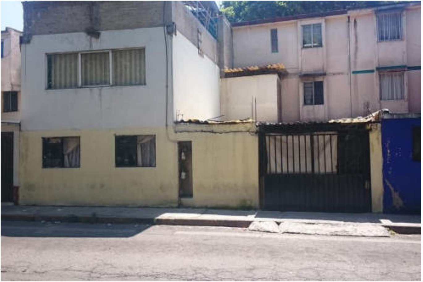
Figura 5.10. Fotografía B (Imagen 1a), se observa una estructura de mampostería sin confinar, que presenta una fractura horizontal en la parte superior de la entrada de estacionamiento, provocando separación de sus elementos (19.5129° N, 99.2049° W. Calle: Matemáticas).
