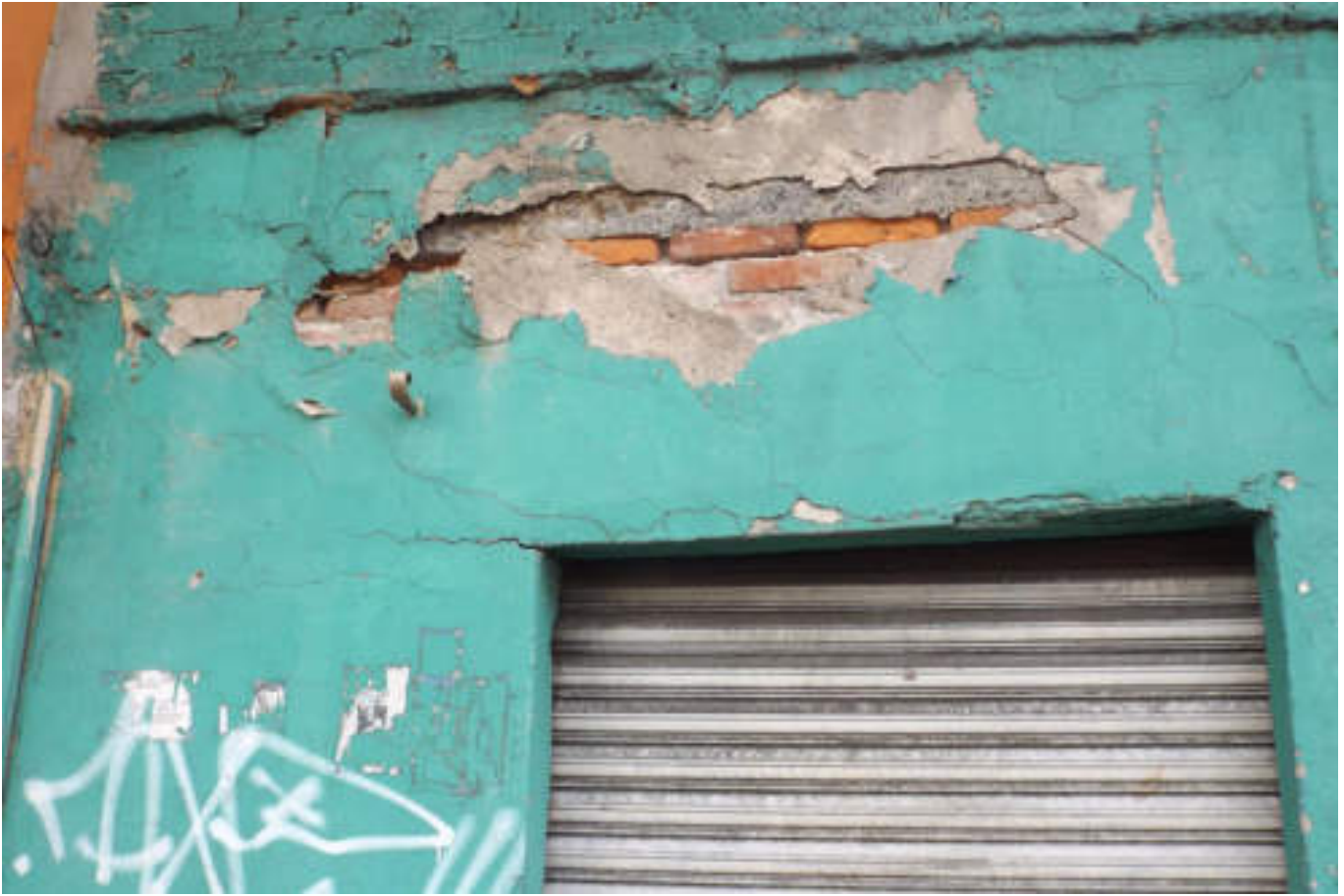
Figura 5.229 Fotografía D (Imagen 37), donde se observan fracturas en forma horizontal, que parten desde la esquina de la entrada señalándonos la falta de refuerzo vertical y ocasionando desprendimiento del aplanado (19.4738° N, 99.1592° W. Calle: A).
