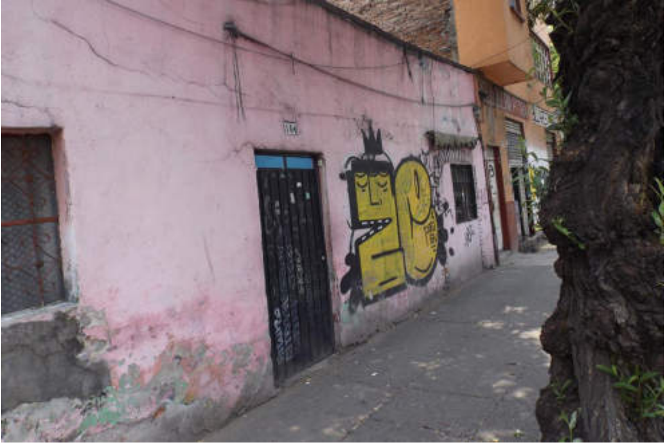
Figura 5.337. Fotografía B (Imagen 59), se observan una vivienda con fracturas horizontales, en la parte inferior izquierda se aprecia una reparación en el aplanado de la fachada (19.4653º N, 99.1902º W. Calle: Aquiles Serdán).
