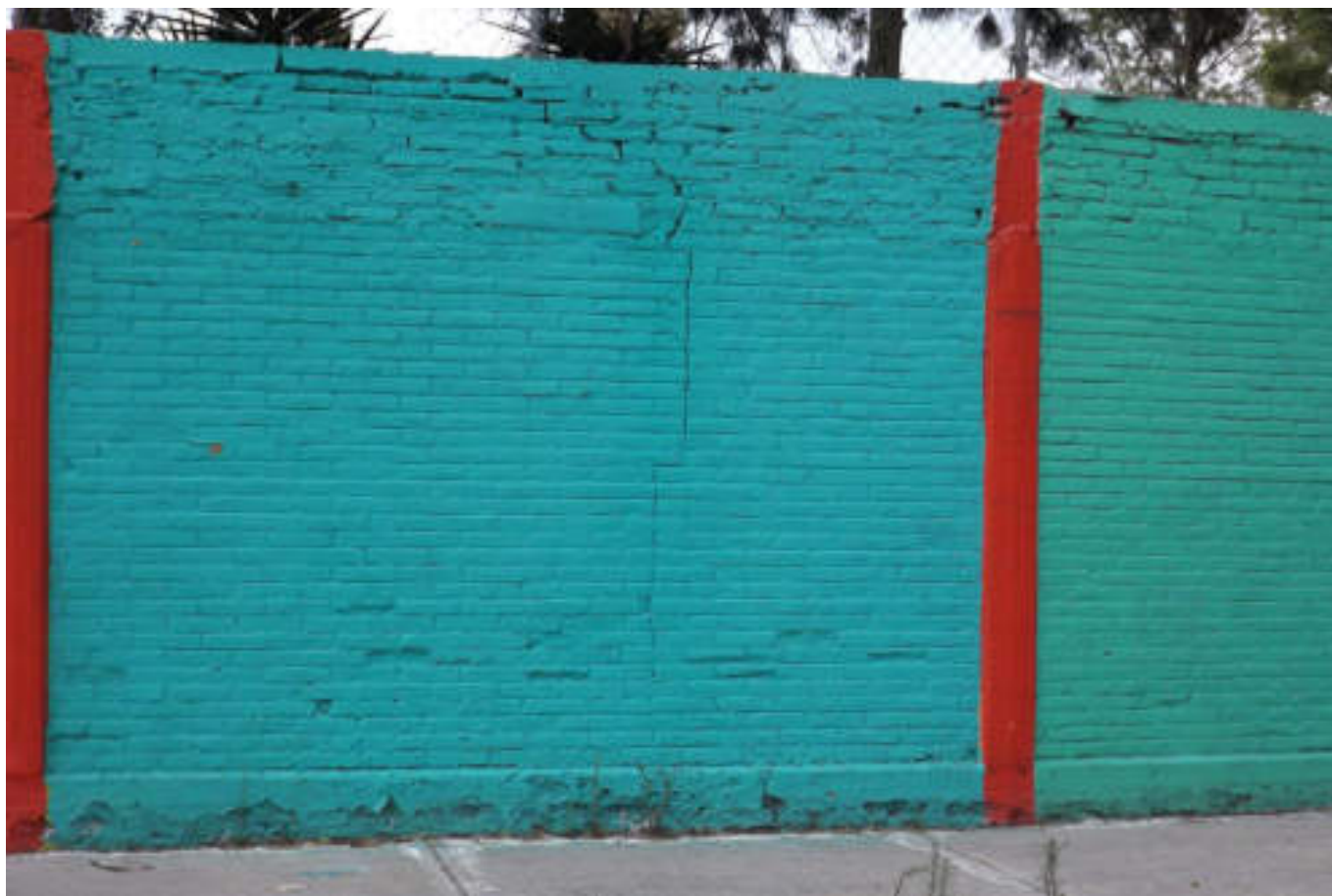
Figura 5.226. Fotografía A (Imagen 37), donde se observa el muro exterior de una escuela afectado por una fractura vertical en su parte central (19.4768° N, 99.1597° W. Calle: Central).
