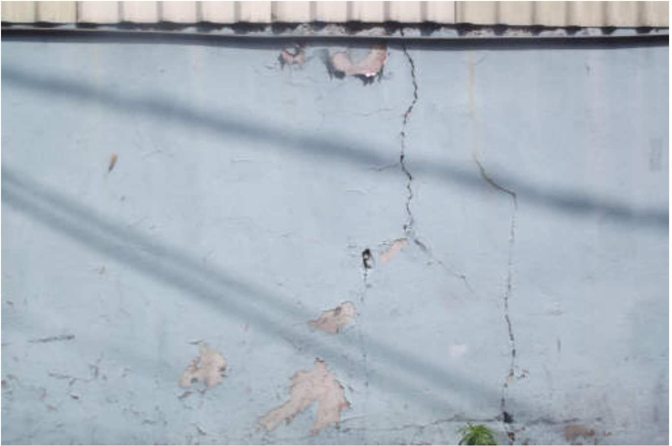
Figura 5. 29. Fotografía E (Imagen 4a), muro de edificación el cual presenta fracturas verticales. También se observa desprendimiento y deterioro en el acabado (19.4965209596° N, 99.1797950696° W. Calle: Tercer prolongación Manuel Contreras).
