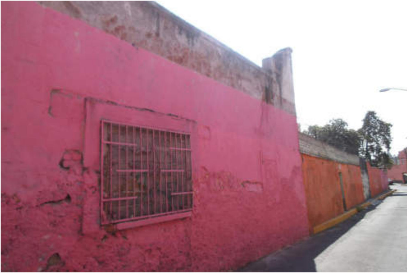
Figura 5.152. Fotografía B (Imagen 24), en donde se observa una vivienda con desprendimiento de material, es visible la aplicación de un mal proceso para constructivo (19.4882° N, 99.1839° W. Calle: San Marcos).
