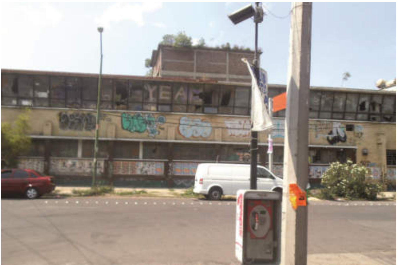
Figura 5.39. Fotografía A (Imagen 6), estructura con columnas cortas y esbeltas en la base, con colapso en ventanal por el peso de la losa, cristales rotos y marcos de aluminio de ventanas flexionados (19.4928099649° N, 99.1688263508° W. Calle: Poniente 128).
