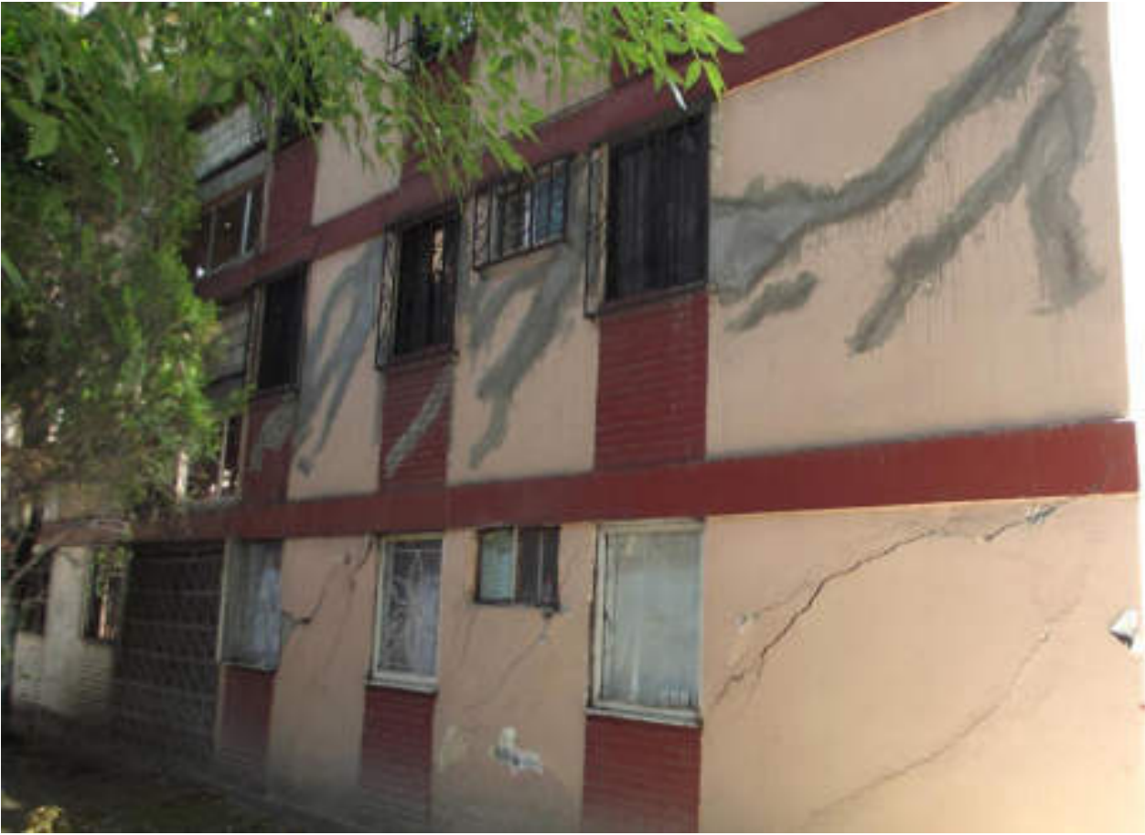
Figura 5.162. Fotografía C (Imagen 26), que muestra una edificación de mampostería, semiconfinada, de tres niveles afectada por fracturas diagonales sobre el mismo eje a lo largo de la construcción (19.4865° N; 99.1726° W. Calle: Sin nombre oficial).
