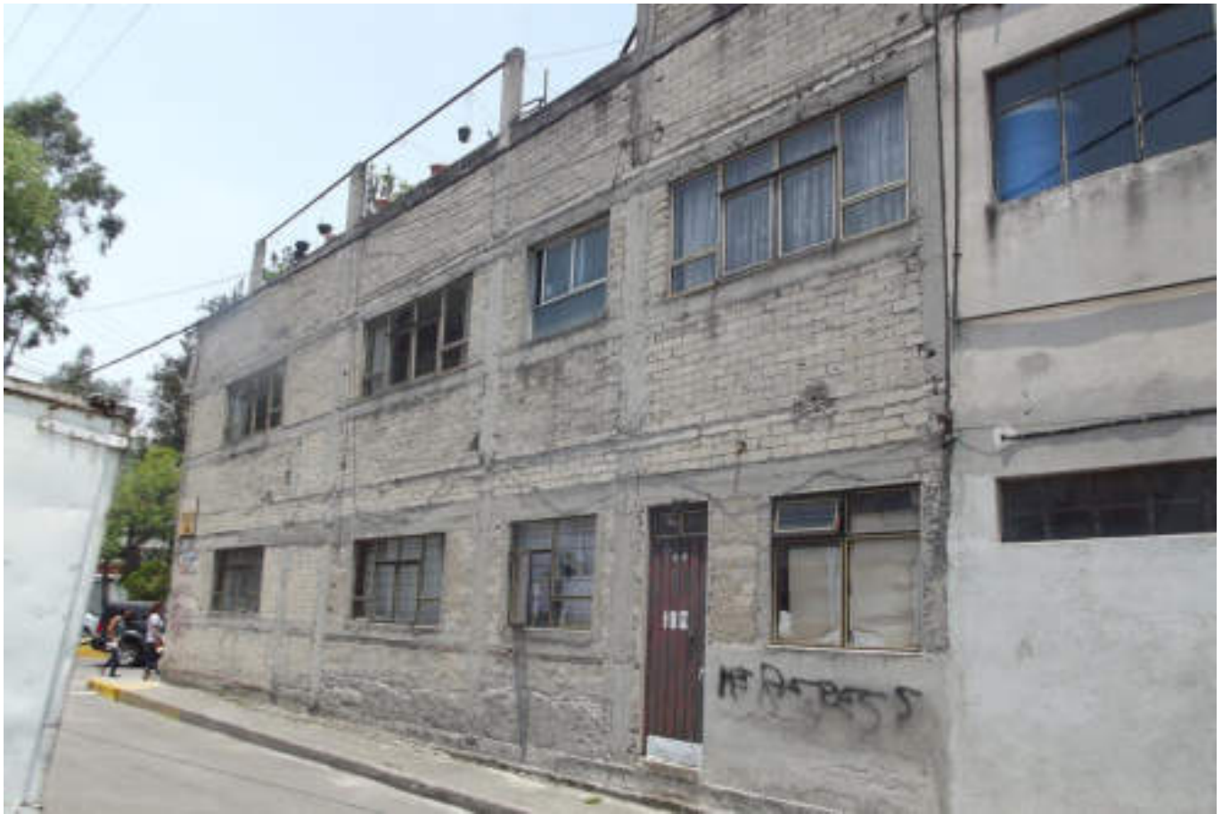
Figura 5.361. Fotografía B (Imagen 63), estructura de mampostería semiconfinada sin aplanado ni recubrimiento de protección, la parte baja del primer nivel presenta desgaste del material que lo constituye (19.4675° N, 99.1596° W. Calle: Tercera Jardín).
