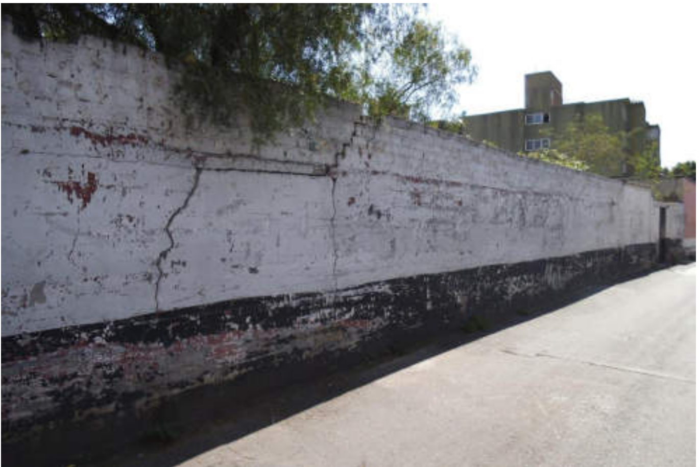
Figura 5.126. Fotografía A (Imagen 20), muro exterior de mampostería, presenta fractura diagonal escalonada, fractura horizontal y fractura vertical, esto debido a una proporción inadecuada al colocar el mortero; lo que ocasiona que no trabaje adecuadamente, el muro no presenta confinamiento y se aprecian efectos del intemperismo (19.4945° N, 99.2058° W. Calle: Federico Dávalos).
