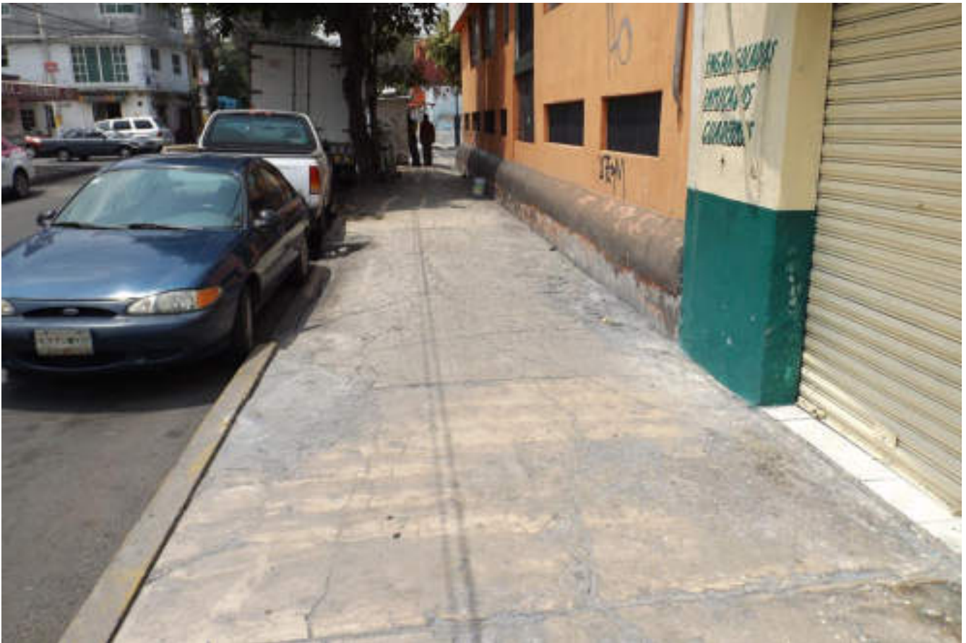
Figura 5.287. Fotografía A (Imagen 50), se observa una edificación que presenta hundimiento debido a su peso, se aprecia en la inclinación de la banqueta tipo bombeo, así como el fracturamiento en la parte central de la banqueta. La escoba y el bote que se encuentran en el fondo sirven como indicativo de se aprecian con cierta inclinación hacia la edificación (19.470149° N, 99.151506° W. Calle: Central Sur).
