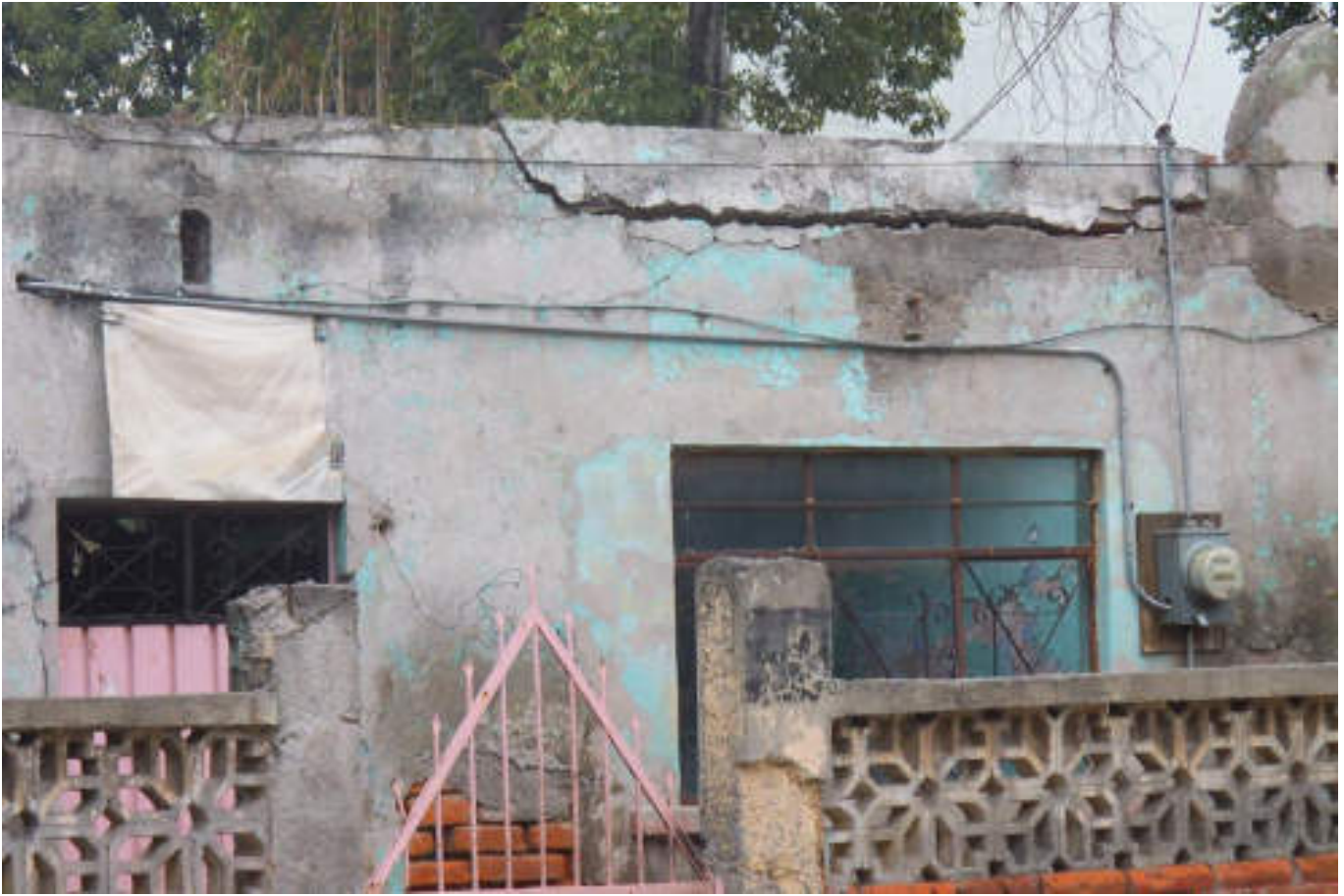
Figura 5.348. Fotografía E (Imagen 60), construcción de mampostería no confinada en la cual se presenta una mala adherencia en el tabique rojo utilizado, asimismo se observa el desprendimiento de una porción importante de la parte superior del muro. En la parte inferior de la vivienda el mortero utilizado para las juntas de los ladrillos ha sido removido (19.4611° N, 99.1791° W. Calle: Norte 81).
