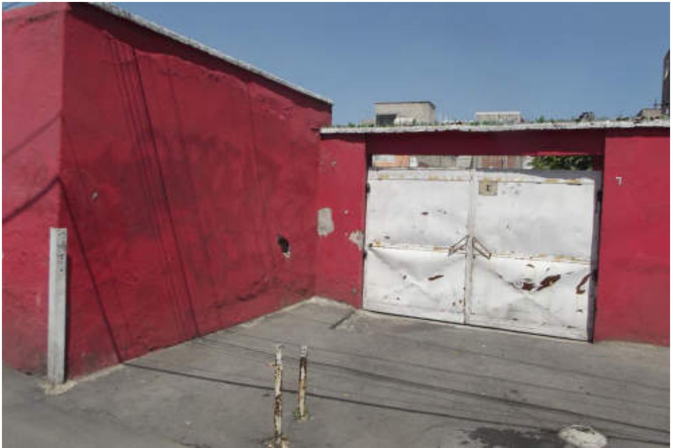
Figura 5.244. Fotografía B (Imagen 40), vivienda semiconfinada de mampostería con deterioro en acabado de la fachada, se observa, fracturamiento horizontal en parte superior del muro (19.4826° N, 99.2042° W. Calle: Miguel Hidalgo).
