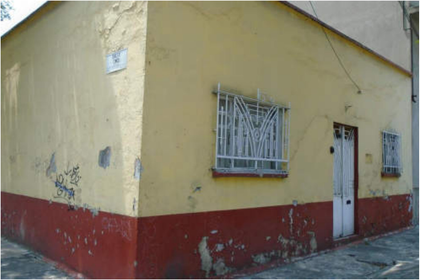
Figura 5.284. Fotografía D (Imagen 49), se muestra un inmueble de mampostería sin reforzar con desprendimientos parciales de acabados, en la parte derecha de la estructura se aprecian fracturas diagonales que parten desde las ventanas (19.4710418922° N, 99.1540704392° W. Calle: 5).
