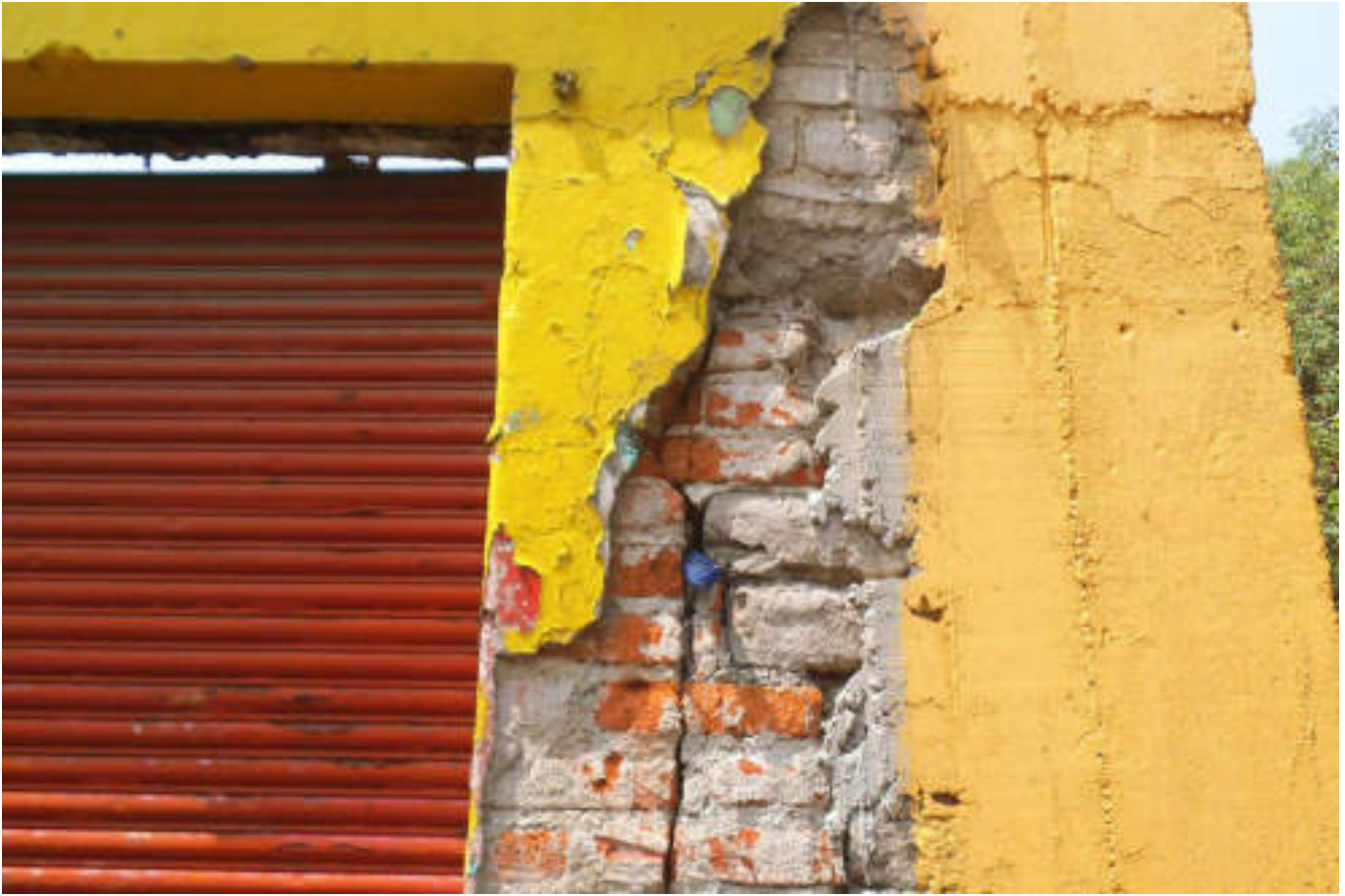
Figura 5.107. Fotografía D (Imagen 16), en la que se observa una edificación de mampostería semiconfinada que muestra una fractura vertical que corta axialmente el muro y provoca la separación de los elementos estructurales, asimismo se observan desprendimientos parciales de sus acabados (19.4946° N, 99.1806° W. Calle: Miguel Hidalgo).
