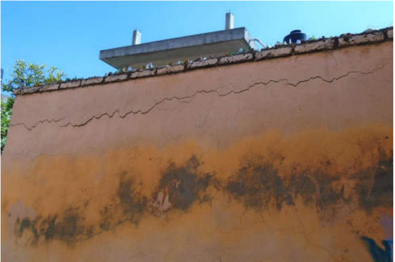
Figura 5.333. Fotografía D (Imagen 58), en ella se muestra muro de mampostería con fractura horizontal que corta los elementos que conforman al muro, además se observa deterioro en el acabado provocado por humedad (19.474° N, 99.1916° W. Calle: Amilpa).
