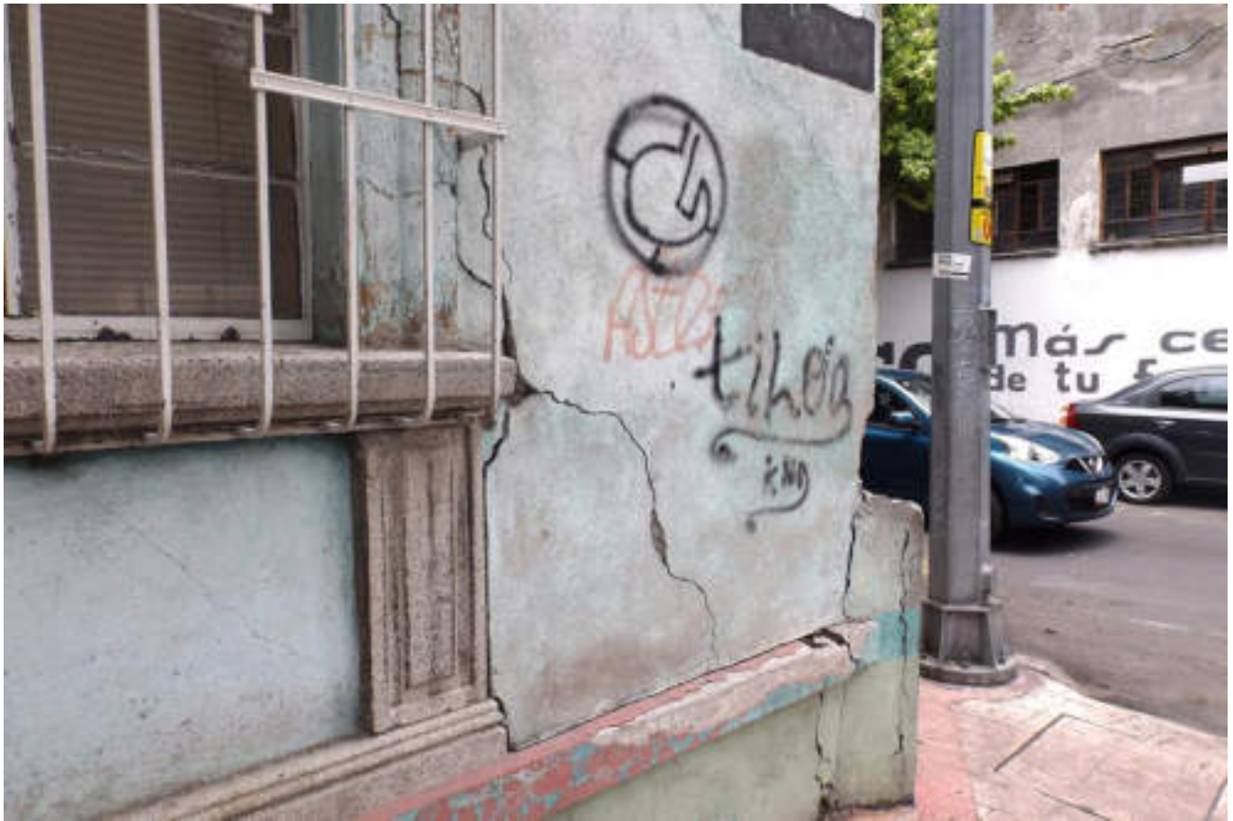
Figura 5.203. Fotografía E (Imagen 33), fracturamiento en muro exterior de vivienda, el cual parte de la esquina inferior derecha del marco de la ventana en dirección diagonal hasta el nivel de piso (19.4800° N, 99.1843° W. Calle: Belisario Domínguez).
