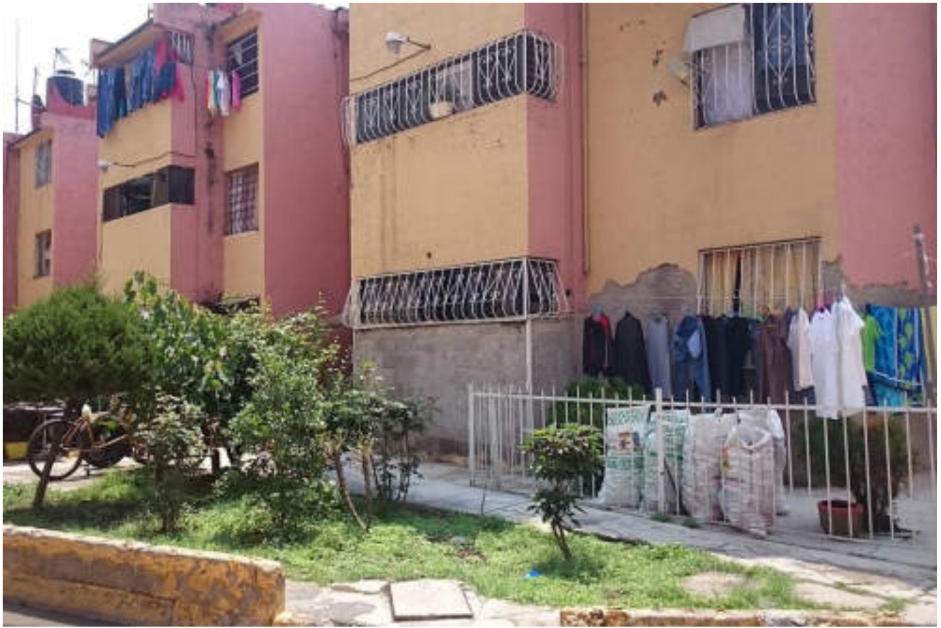
Figura 5.56. Fotografía B (Imagen 8), debido a la modificación que se realizó en las ventanas de la planta baja, el aplanado del muro en ese nivel de piso se desprendió dejando a la intemperie los blocks de los cuales está compuesto (19.5001° N, 99.1852° W. Calle: San Pablo Xalpa).
