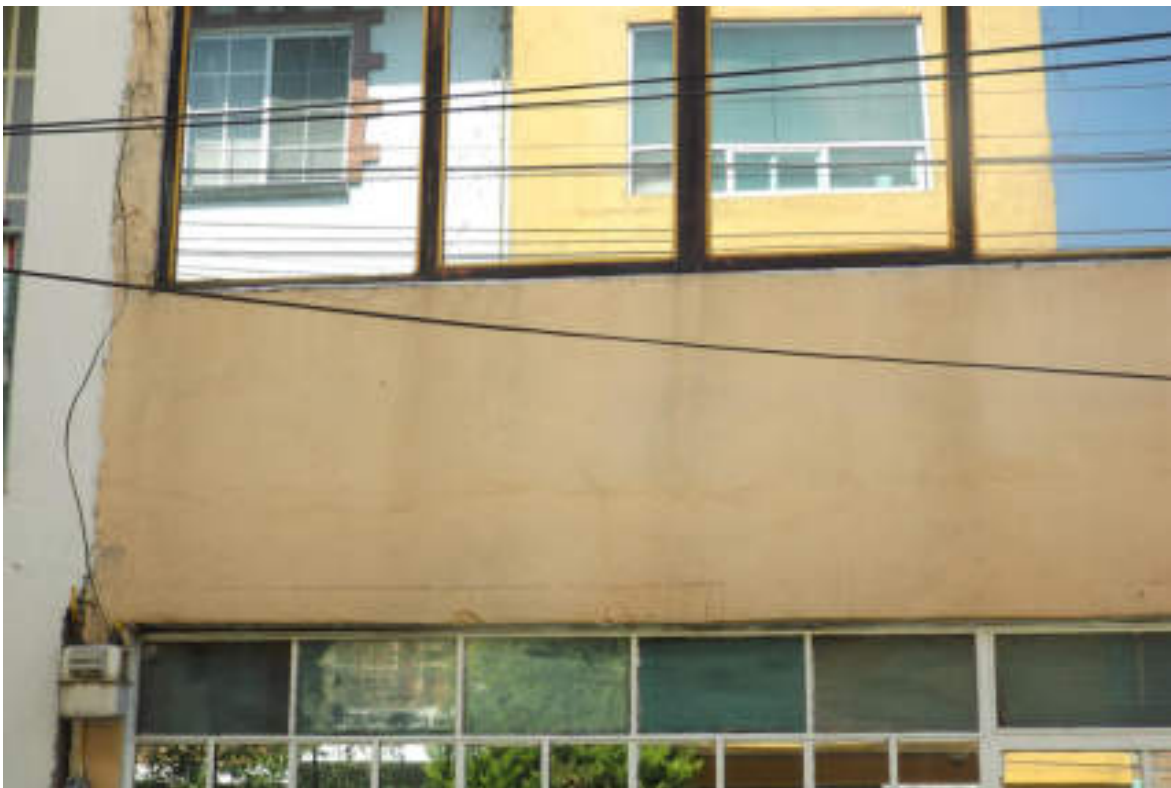
Figura 5.72. Fotografía A (Imagen 11), estructura de mampostería semiconfinada en la que se observa fracturas verticales en aplanado, así como un abultamiento horizontal y desprendimiento parcial de acabado en la parte superior del ventanal situado en planta baja (19.4931° N, 99.1992° W. Calle: Sin nombre oficial).
