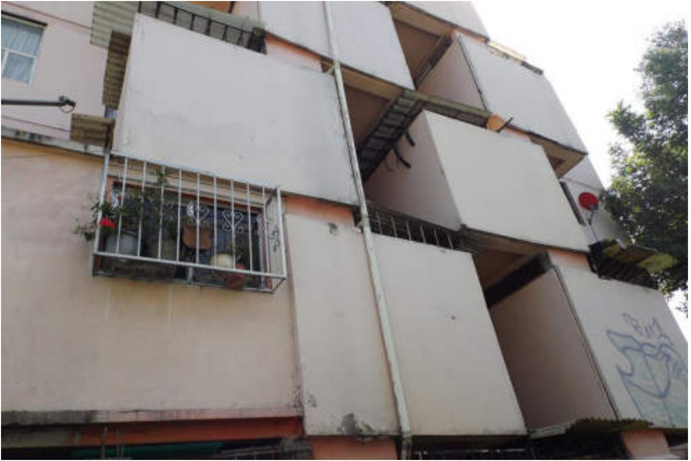
Figura 5.12. Fotografía D (Imagen 1a), en la que se observa una construcción afectada por fracturas verticales en los muros de la parte superior e inferior. Asimismo se aprecia la falta de estabilidad en la edificación (19.5134° N, 99.1995° W. Calle: Herreros).
