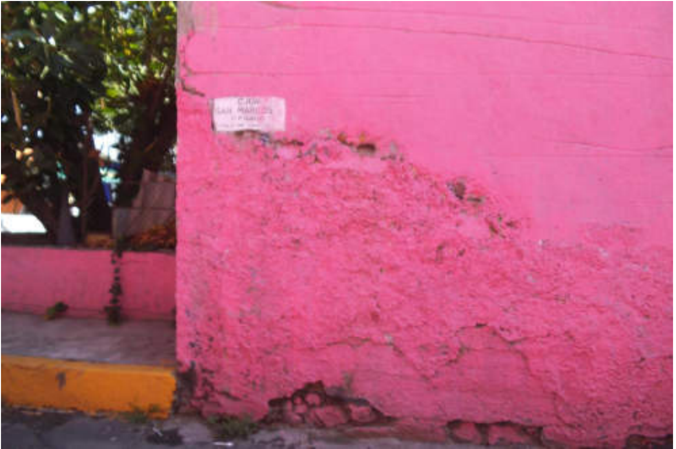
Figura 5.153. Fotografía C (Imagen 24), se observa un desprendimiento de aplanado en muro de fachada, el desprendimiento se intentó mitigar con una nueva capa de concreto, por lo cual el muro perdió su homogeneidad de espesor y rugosidad (19.4882° N, 99.1839° W. Calle: San Marcos).
