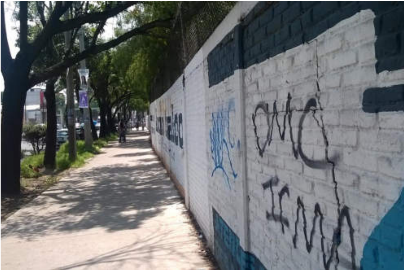
Figura 5.156. Fotografía A (Imagen 25), fracturamiento en muro perimetral, se observa una fractura vertical y otra transversal a esta (19.4890° N, 99.1780° W. Calzada: Azcapotzalco La Villa).
