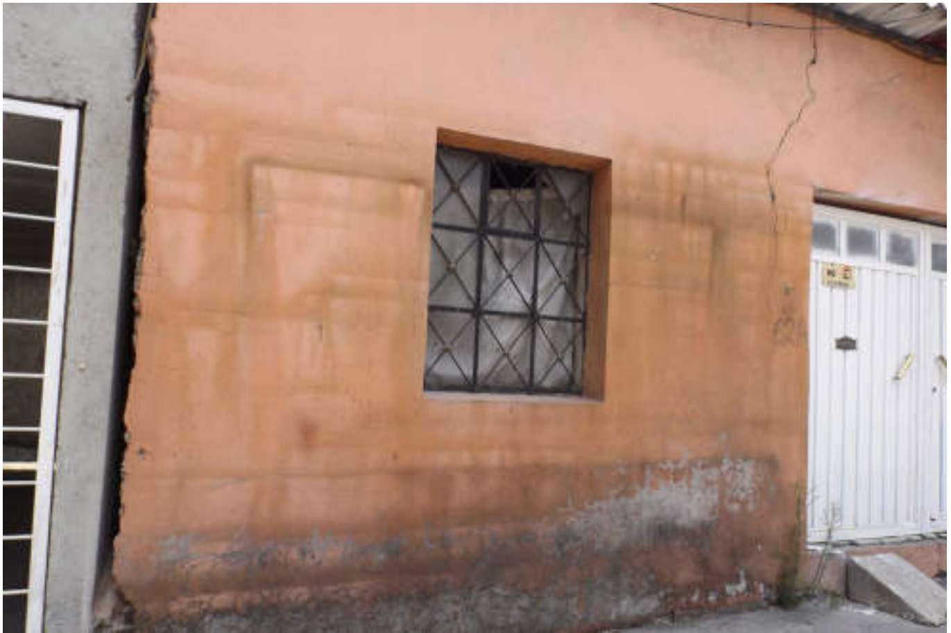
Figura 5.340. Fotografía E (Imagen 59), fachada que presenta deterioro en el acabado, así como una fractura vertical a un costado de la puerta. La junta constructiva ha sufrido desprendimiento en el acabado en la parte inferior (19.4621° N, 99.187° W. Calle: Mar del Norte).
