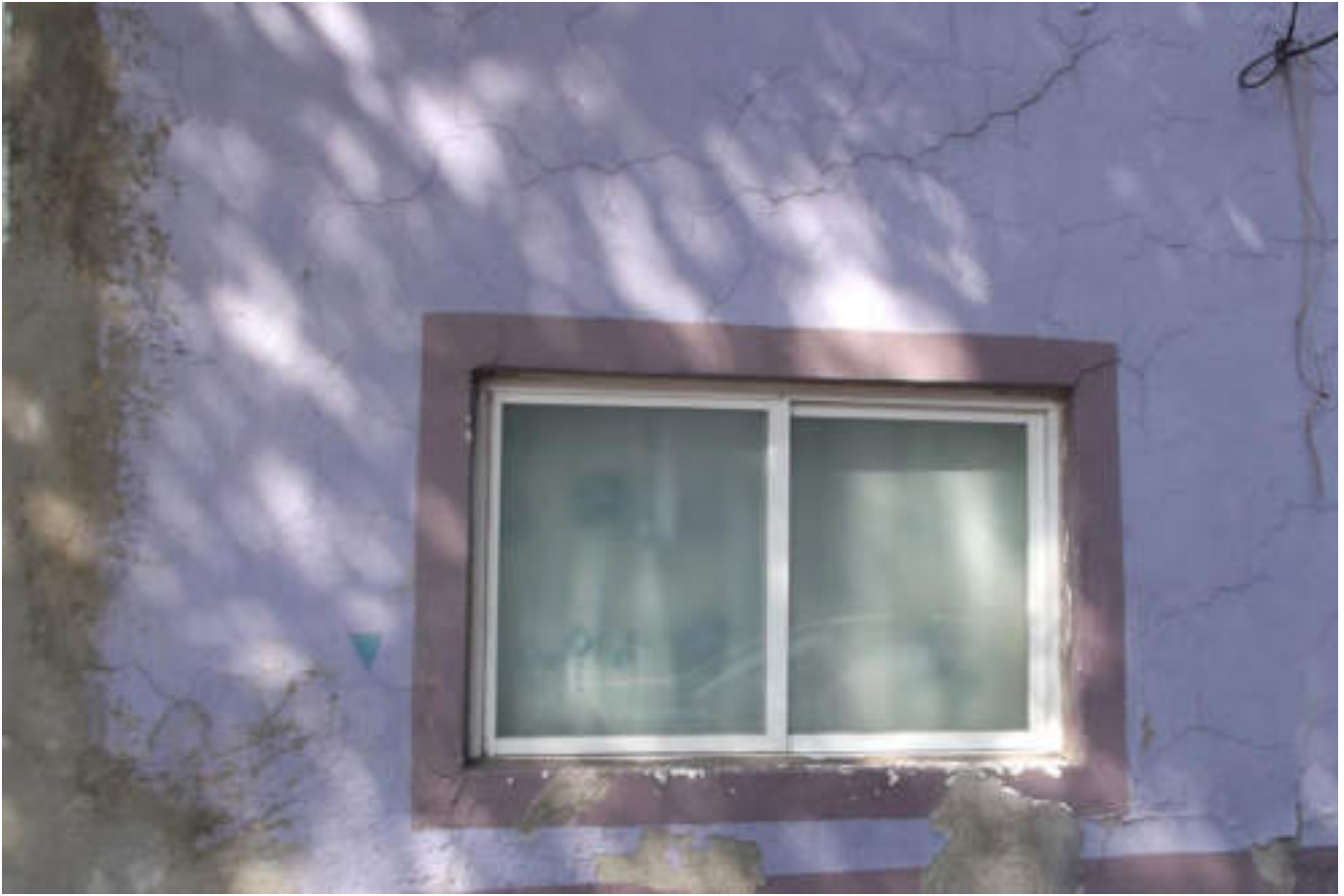
Figura 5.385. Fotografía C (Imagen 67), se observa una alta densidad de fracturas alrededor de la ventana, se distingue como el lado izquierdo de la construcción ya ha sido reparado (19.4614° N, 99.1621° W. Calle: Orquídea).
