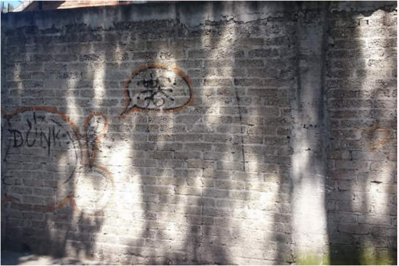
Figura 5.73. Fotografía B (Imagen 11), muro de mampostería semiconfinada en el cual se observan una serie de fracturas verticales y diagonales, asimismo se distingue una separación entre las juntas de los tabiques y daño del material constructivo (19.4947° N, 99.1991° W. Calle: Sin nombre oficial).
