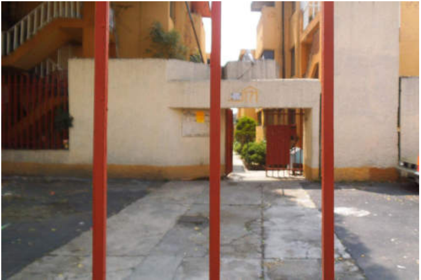
Figura 5.105. Fotografía B (Imagen 16), en ella se muestra una estructura de mampostería que sufrió daños a causa del sismo de 1985 y fue reconstruida posteriormente, una de sus características es que presenta una placa en la fachada que cita lo antes mencionado ( 19.49287^{\circ} N, 99.182^{\circ} W. Calle: José María Morelos).
