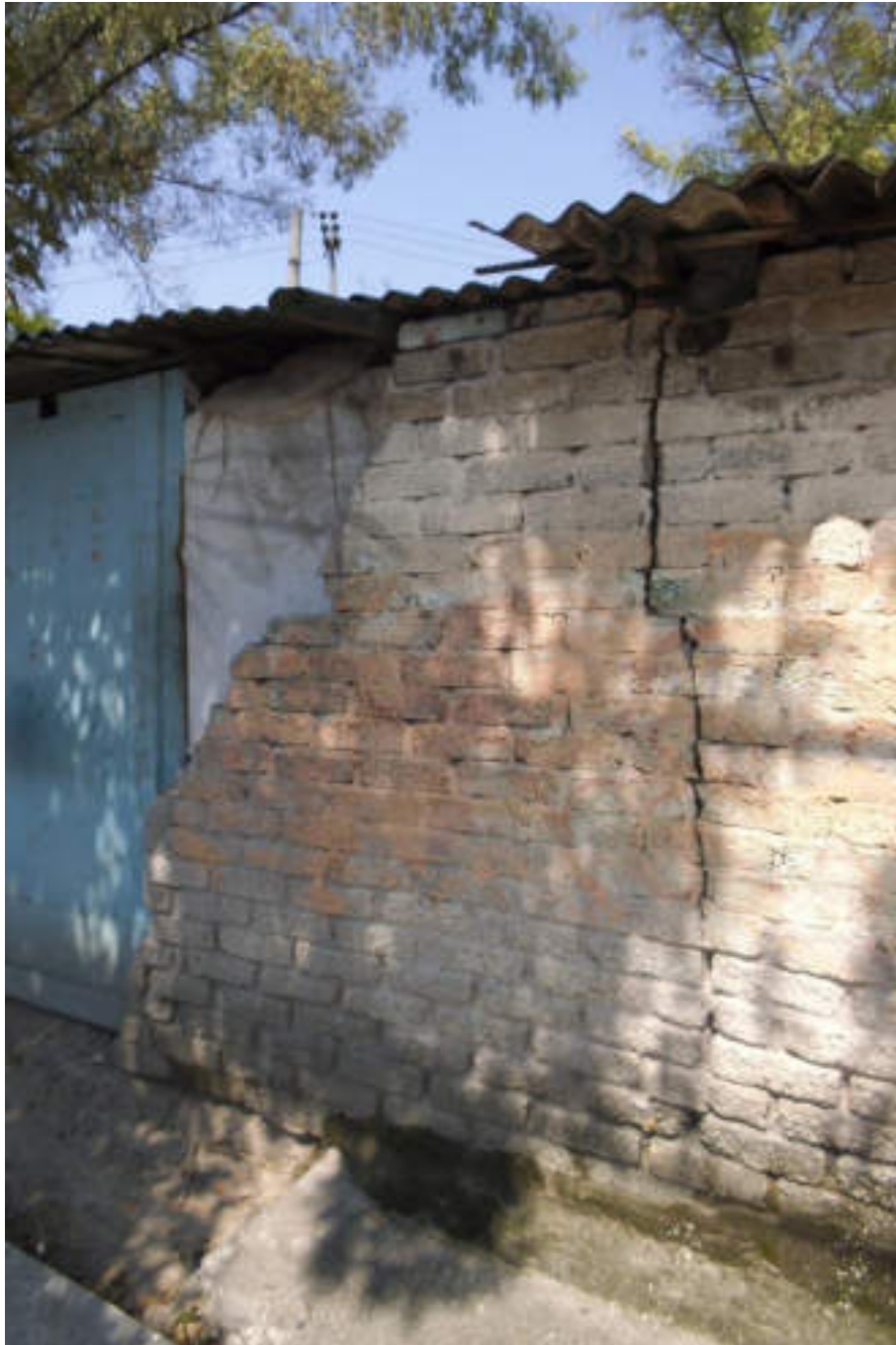
Figura 5.185. Fotografía B (Imagen 29), se muestra un acercamiento de la imagen anterior, que muestra una fractura vertical atravesando el muro exterior de un inmueble, también es posible apreciar el desgaste de los tabiques y del material cementante entre ellos (19.4826° N, 99.154° W. Calzada: Coltongo).
