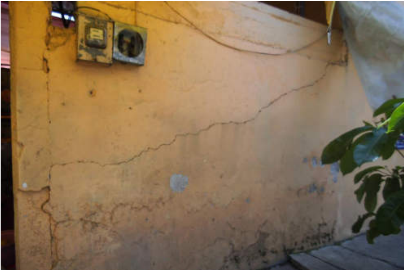
Figura 5.133. Fotografía A (Imagen 21), en la que se observa una fractura en el muro exterior de una vivienda, la cual lo cruza en dirección diagonal que parte de un castillo a otro (19.4914º N, 99.2003º W. Calle: Totonacas).
