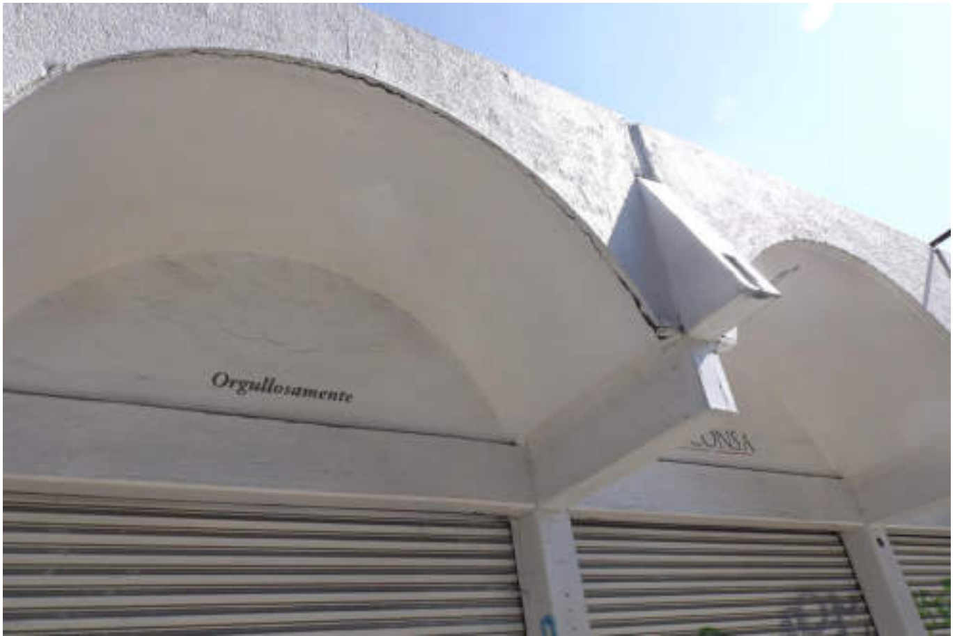
Figura 5.68. Fotografía E (Imagen 10), en ella podemos apreciar fracturas en el borde de la losa semicircular que provoca la separación entre ésta y el pretil (19.4975° N, 99.2010° W. Calle: Aquiles Serdán).
