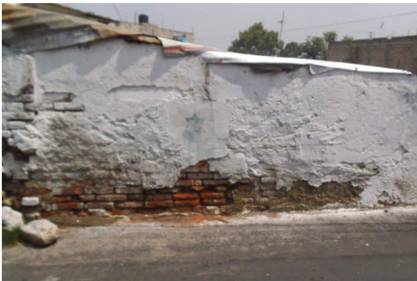
Figura 5.104. Fotografía A (Imagen 16), en ella se muestra una estructura de mampostería sin confinar que presenta desprendimiento parcial de acabados y un evidente deterioro del muro, en sus componentes se observa que no hubo un proceso constructivo apropiado, un ejemplo de esto son las dimensiones de la vivienda, debido a que no son simétricas (19.4927° N, 99.1816° W. Calle: Potrero).
