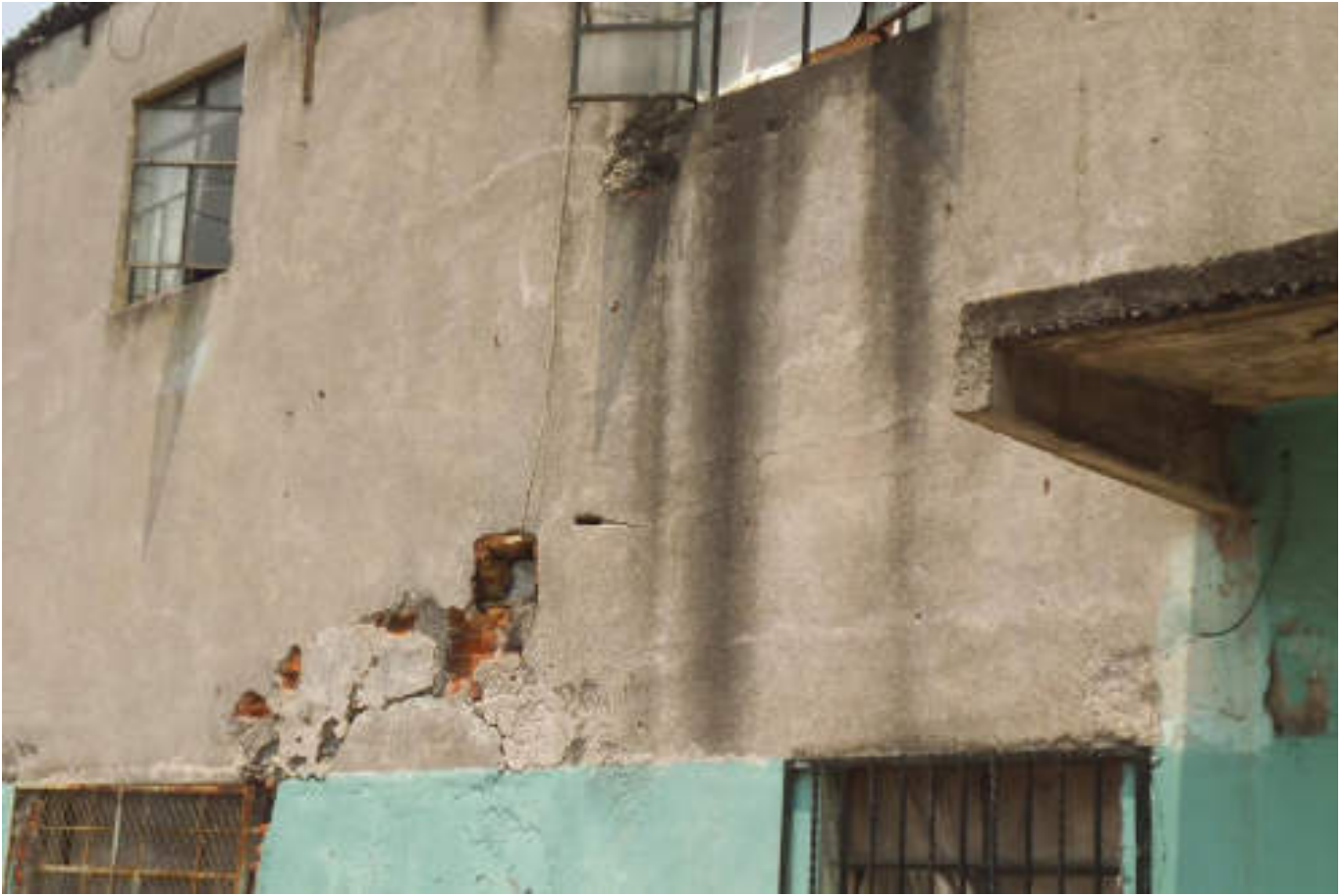
Figura 5.362. Fotografía C (Imagen 63), se muestra la fachada de una vivienda de mampostería no confinada que presenta fracturas en la esquina de la parte superior sobre la ventana central, asimismo se observa desprendimiento del acabado, como del ladrillo rojo utilizado para la construcción del muro (19.4685° N, 99.1581° W. Calle: Patamban).
