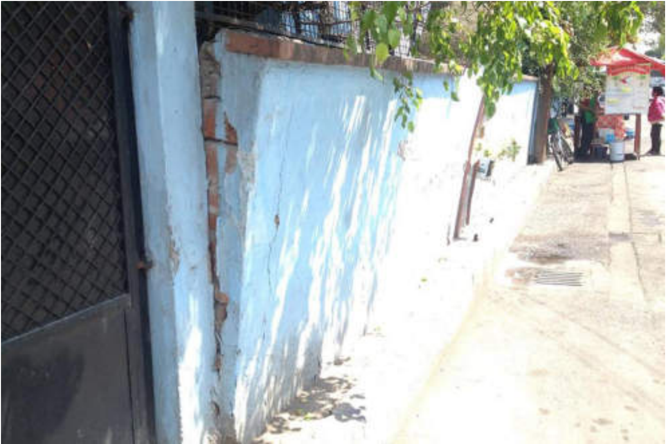
Figura 5.196. Fotografía D (Imagen 32), se muestra un muro perimetral que tiene una inclinación con dirección al exterior, lo cual provoca la separación del elemento en la parte donde está colocada la herrería (19.483° N, 99.1928° W. Calle: Santo Domingo).
