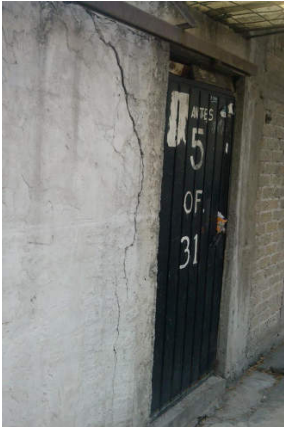
Figura 5.111. Fotografía A (Imagen 17), fachada de mampostería confinada que presenta una fractura diagonal en la parte izquierda de la edificación. Ésta inicia entre la conexión de la trabe y el muro, extendiéndose hacia la parte inferior del muro aproximándose a la puerta (19.4910053345° N, 99.1778452345° W. Calle: Papantla).
