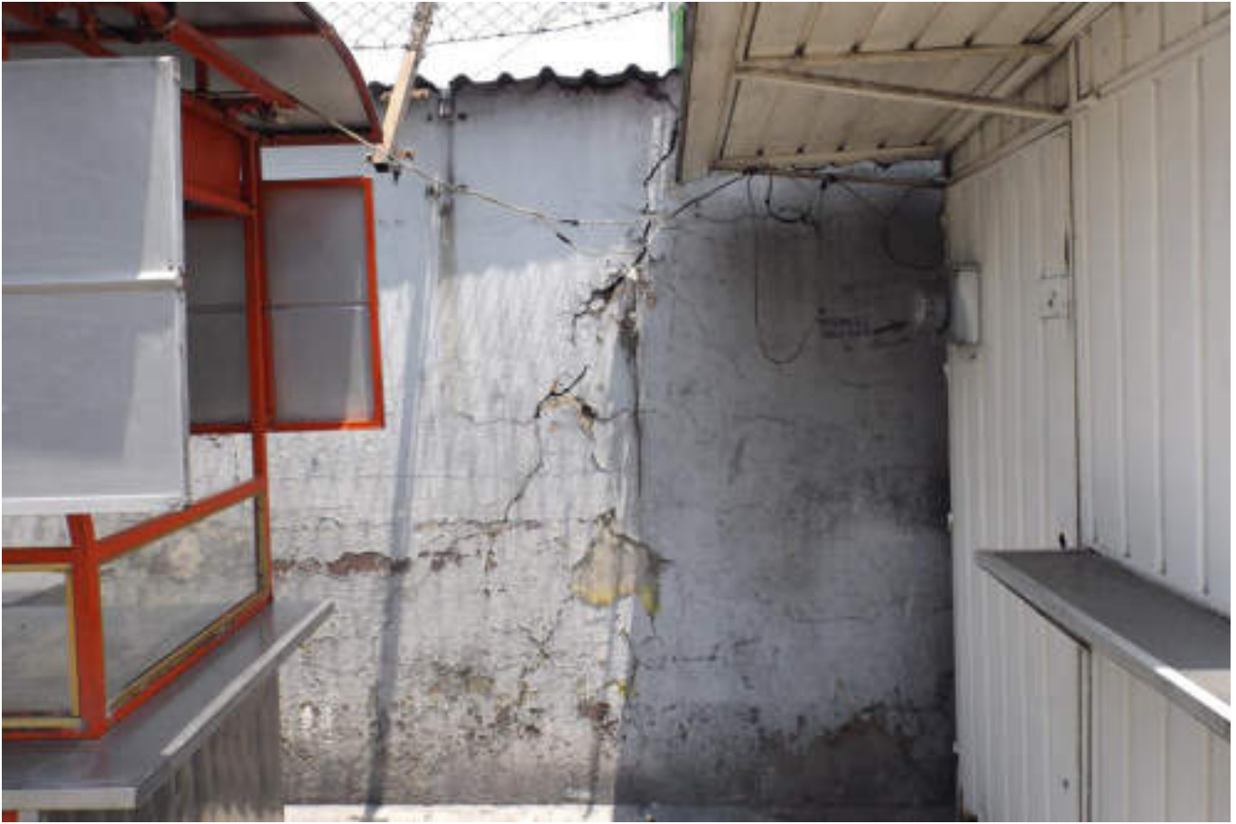
Figura 5.58. Fotografía D (Imagen 8), fracturas de muro exterior de vivienda la cual deriva desde la zona superior, en dirección vertical hasta el nivel de piso, se observan algunas otras fracturas que parten del fracturamiento principal (19.4991° N, 99.1854° W. Calle: San Pablo Xalpa).
