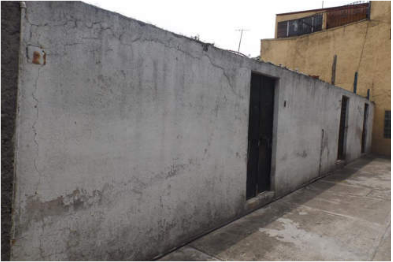
Figura 5.200. Fotografía B (Imagen 33), se muestra una vivienda que presenta deterioro en acabado, fracturas verticales y horizontales, además se observa inclinación de la misma (19.4828° N, 99.1874° W. Calle: Esperanza).
