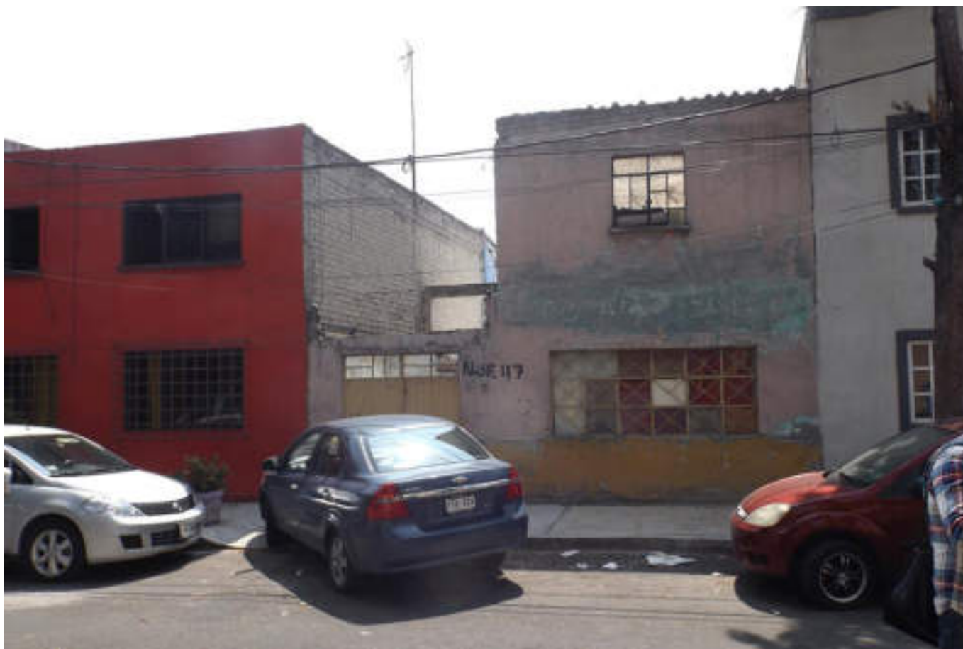
Figura 5.55. Fotografía A (Imagen8), en ella se muestra una edificación de mampostería sin confinar que presenta desprendimiento parcial de la trabe que pasa sobre el acceso principal, provocando que el elemento no trabaje adecuadamente (19.5026° N; 99.1896° W. Calle: Central Rosario).
