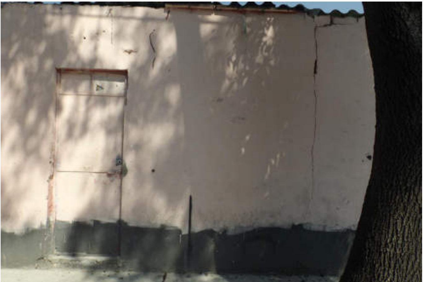
Figura 5.90. Fotografía A (Imagen 14), se observa la parte exterior de una vivienda la cual presenta una fractura vertical que va desde la parte superior de la vivienda hacia la parte media (19.4927° N, 99.1890° W. Calle: Campo Horcón).
