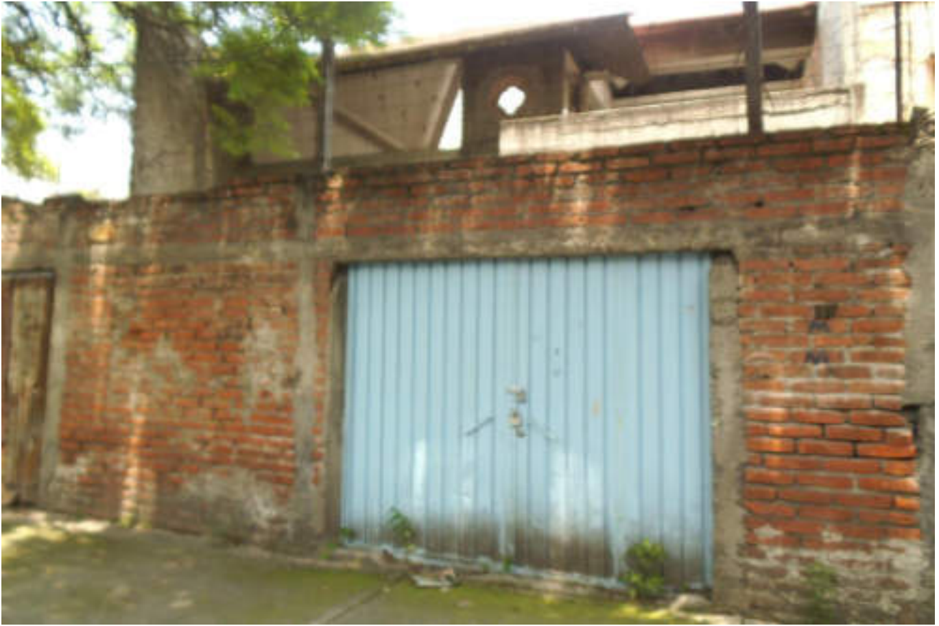
Figura 5.282. Fotografía B (Imagen 49), en ella se muestra un inmueble de mampostería confinado con un deterioro de juntas, en la parte derecha de la construcción se aprecia un desprendimiento parcial de los elementos estructurales (19.4706653951° N, 99.1585994586° W. Calle: 8).
