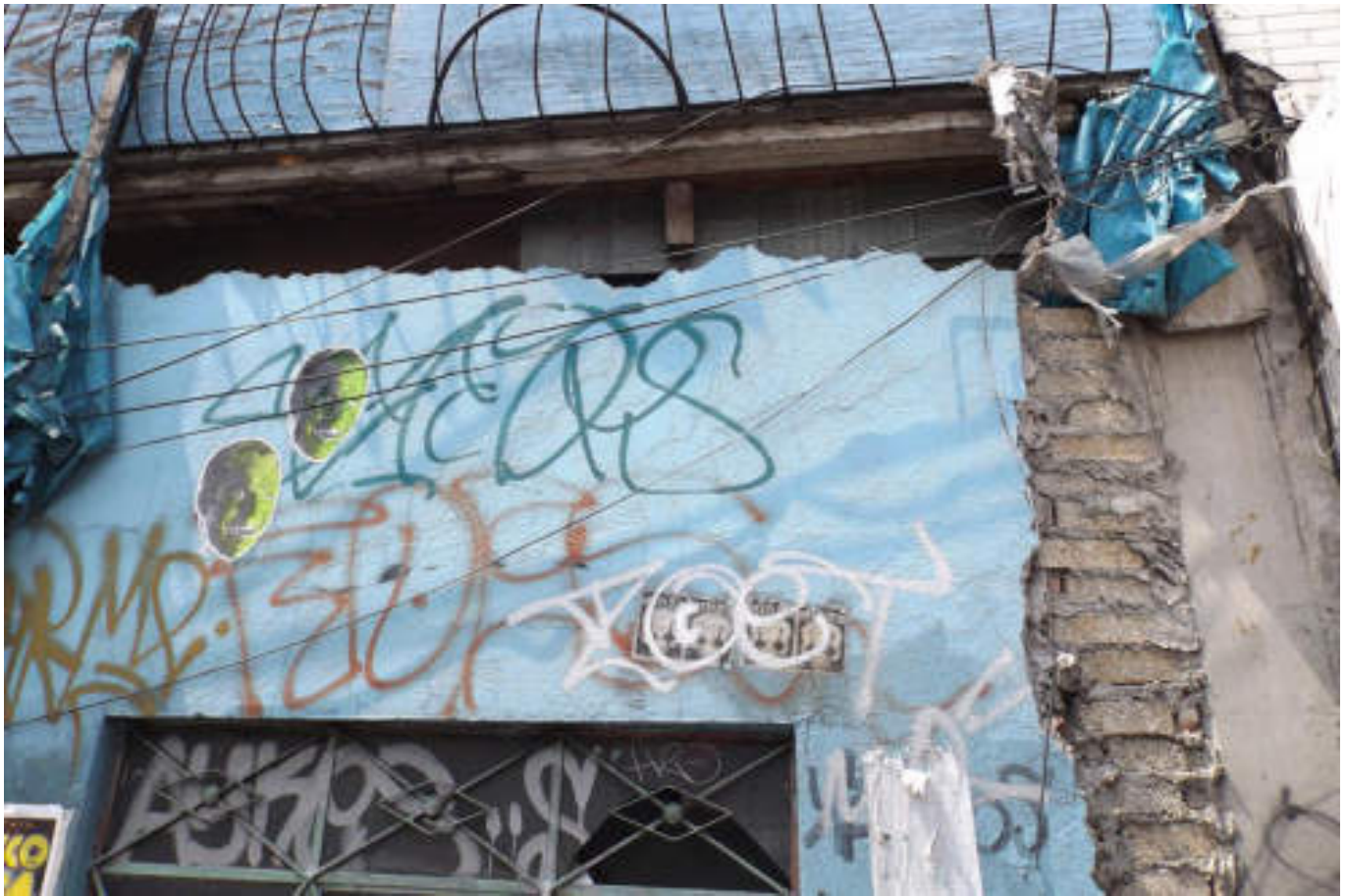
Figura 5.290. Fotografía D (Imagen 50), edificación de mampostería no confinada que presenta una apertura en la parte superior del muro de carga, ocasionando debilitamiento, lo cual se aprecia en el desprendimiento del acabado en la parte derecha (19.4729465696° N, 99.1476164421° W. Calle: 13).
