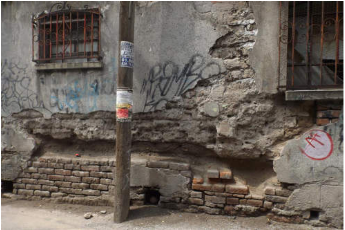
Figura 5.146. Fotografía C (Imagen 23), que muestra el muro exterior de una edificación, el cual presenta abundante desprendimiento de material así como el fenómeno de corrosión, principalmente en la parte inferior de la vivienda causando socavación en el muro, también debido a la antigüedad de la edificación los muros de adobe están desgastados (19.4875º N, 99.1854º W. Calle: Coachilco).
