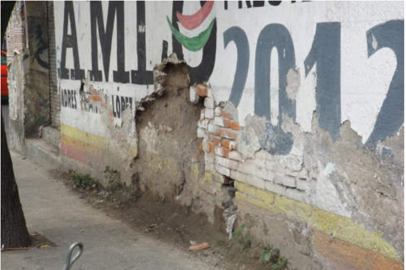
Figura 5. 206. Fotografía H (Imagen 33), muro exterior de vivienda compuesto por ladrillos y piezas de adobe el cual ha sufrido daños a causa de la pérdida de protección que le brindaba el aplanado de concreto que se ha desprendido con el paso del tiempo (19.4800° N, 99.1889° W. Calle: Aztecas).
