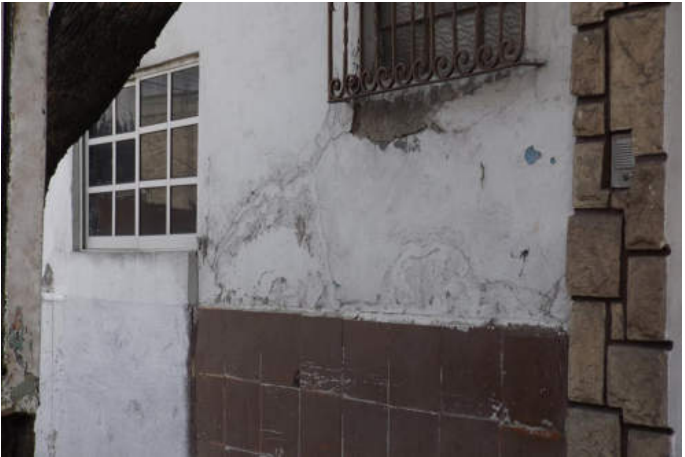
Figura 5.289. Fotografía C (Imagen 50), se muestra una fachada que presenta una fractura diagonal en la parte inferior de la ventana, se aprecia desprendimiento del acabado (19.4708823458° N, 99.1484330071° W. Calle: 7).
