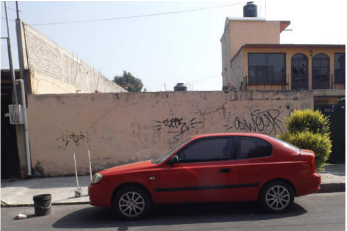
Figura 5.75. Fotografía D (Imagen 11), se aprecian múltiples fracturas en forma diagonal, horizontal y vertical, que recorren gran parte del muro, afectando su estabilidad, lo que provoca una separación entre el muro y la cadena de cerramiento y entre las piezas de mampostería (19.4966° N, 99.1947° W. Calle: Fresnos).
