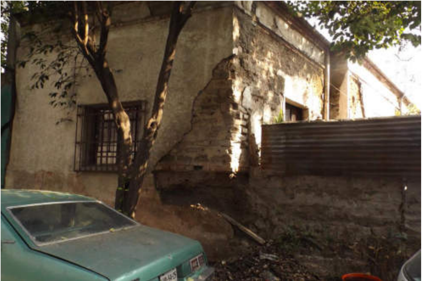
Figura 5.250. Fotografía A (Imagen 42), se muestra una vivienda de mampostería no confinada, que presenta desprendimiento parcial de aplanado de concreto así como del material constructivo en ambos muros de la esquina inferior derecha de la estructura (19.4804° N, 99.1926° W. Calle: San Francisco).
