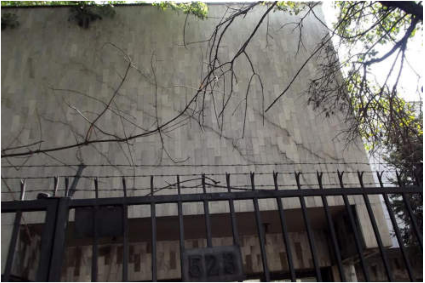
Figura 5.163. Fotografía D (Imagen 26), estructura semiconfinada que presenta fracturas diagonales en su fachada y desprendimiento parcial del material del acabado (19.4862° N; 99.1735° W. Calle: De las granjas).
