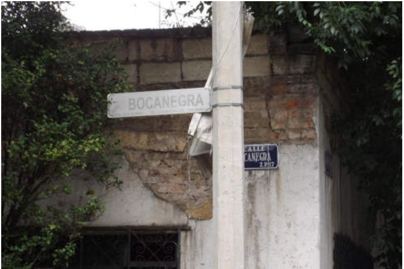
Figura 5.376. Fotografía C (Imagen 64), en ella se observa una vivienda de mampostería sin confinamiento. Se observan colapsos parciales en la esquina superior, los cuales fueron rellenados con mampostería sin el debido proceso constructivo lo que lo vuelve inestable y poco resistente a movimientos y esfuerzos, encontrando incluso fracturado (19.4602° N, 99.1837° W. Calle: Boca Negra).
