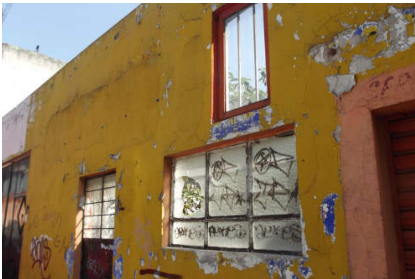
Figura 5.189. Fotografía A (Imagen 31), vivienda de mampostería semiconfinada, con un abultamiento horizontal en la parte superior a la puerta, es visible una serie de fracturas horizontales y diagonales en el aplanado, el aplanado en la parte inferior derecha de la puerta presenta desprendimiento (19.4841° N, 99.1972° W. Calle: Faja de Oro).
