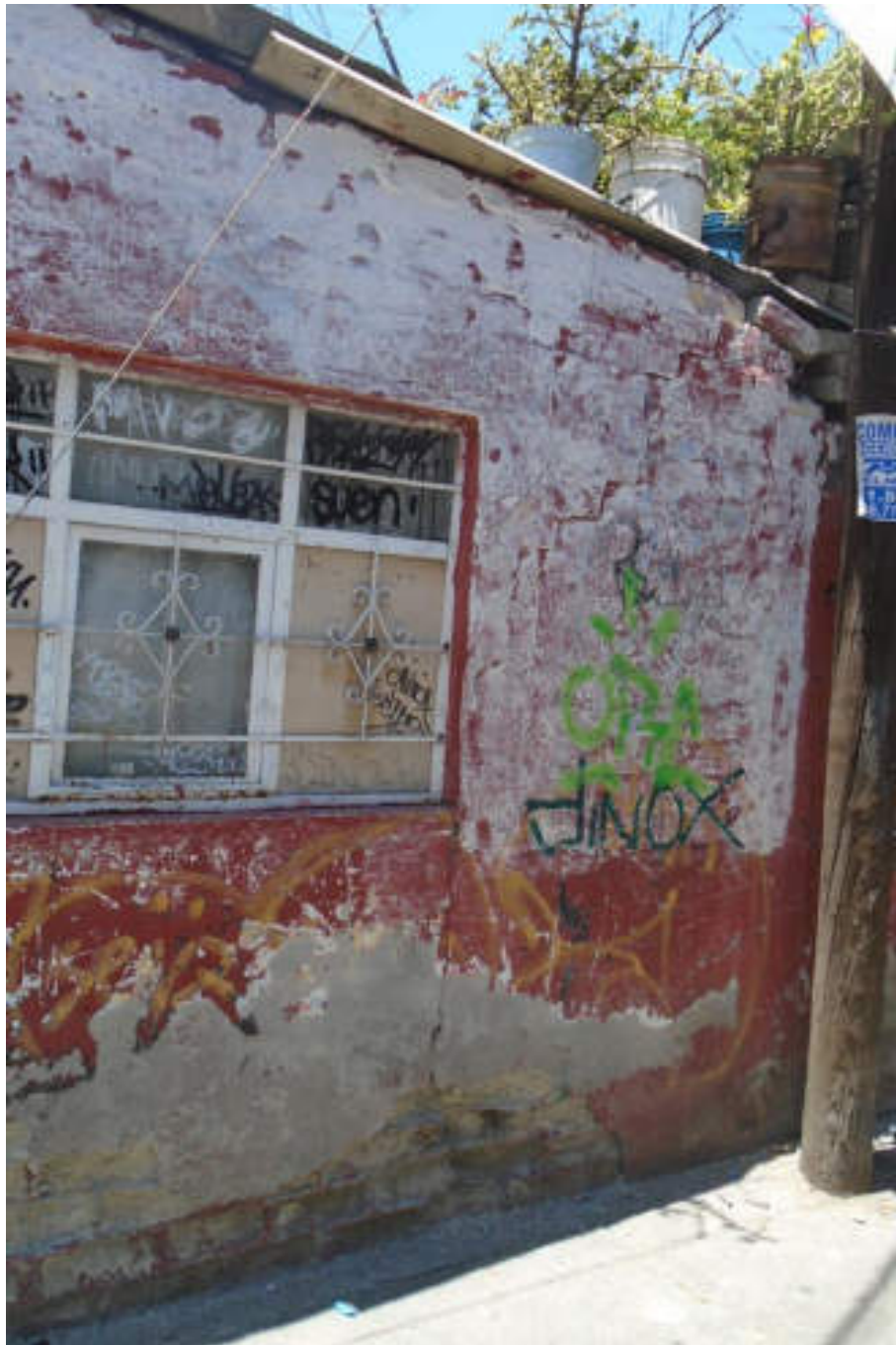
Figura 5.320. Fotografía D (Imagen 55), en la que se observan fracturas verticales en el aplanado y desprendimiento de material en la parte inferior de la construcción (19.4749° N, 99.2090° W. Calle: Soyacal).
