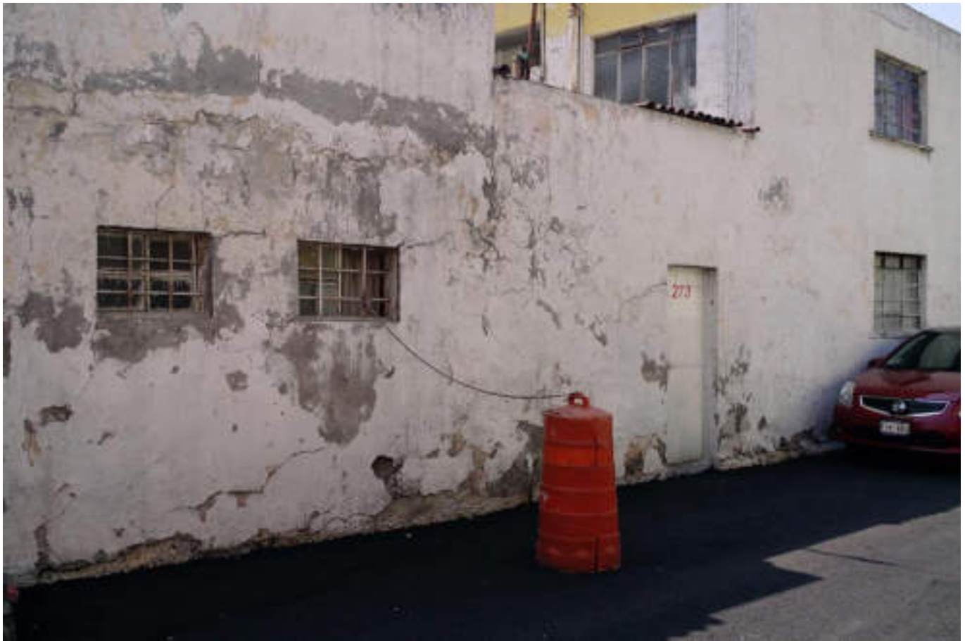
Figura 5.271. Fotografía A (Imagen 46), se muestra una vivienda que presenta múltiples fracturas en forma diagonal en la mayor parte del muro principalmente en la zona de las ventanas indicando la falta de refuerzos en estos elementos (19.4691° N, 99.1718° W. Calle: Toronja).
