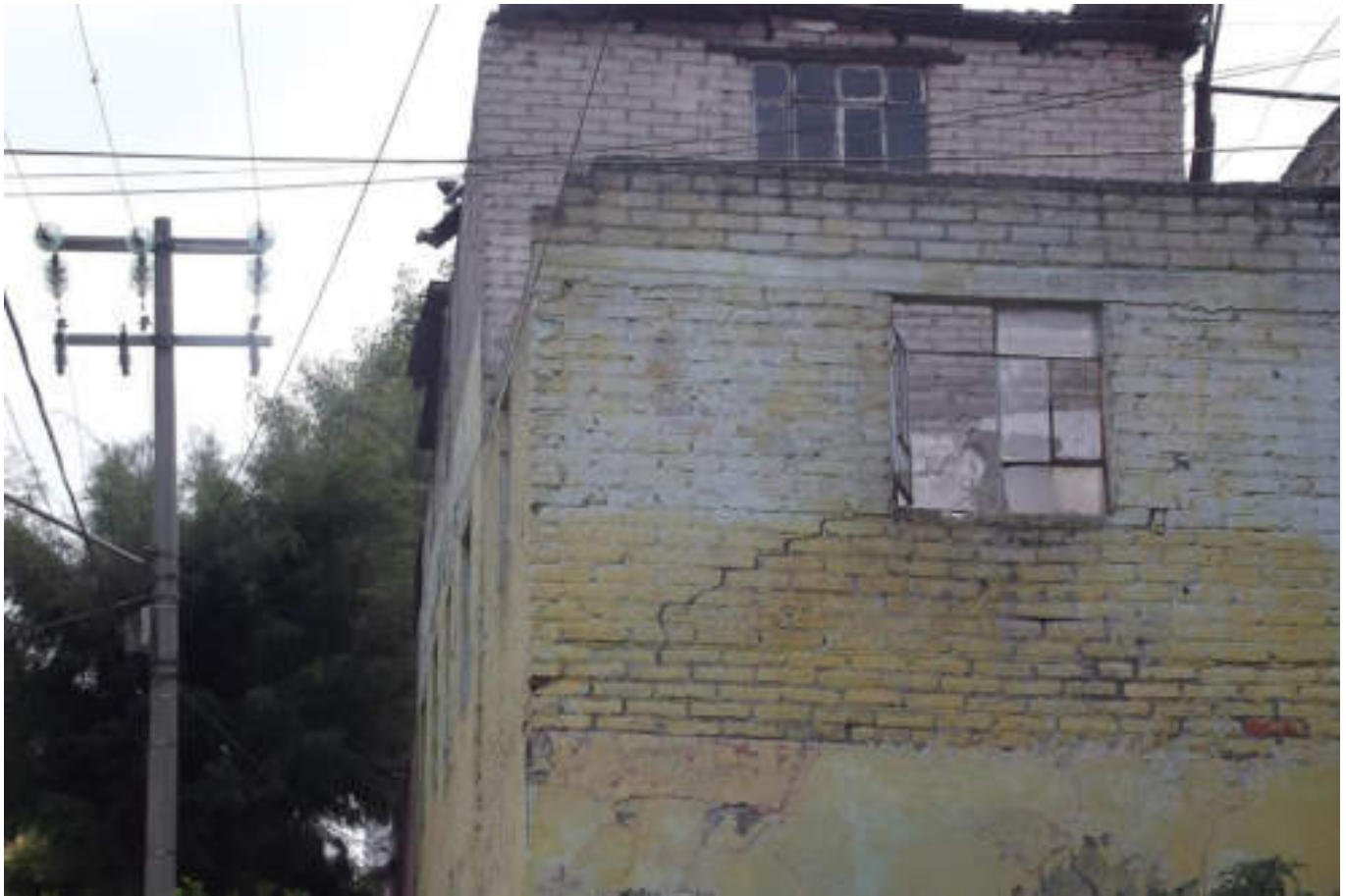
Figura 5.230 Fotografía E (Imagen 37), que muestra una vivienda afectada por una fractura diagonal que parte de la zona inferior de la ventana hacia el límite del muro. La parte baja de la construcción también presenta fracturamiento (19.4736° N, 99.1626° W. Calle: Ibiza).
