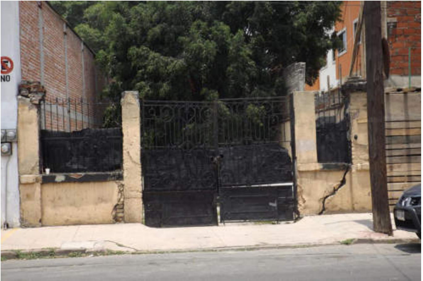
Figura 5.339. Fotografía D (Imagen 59), vivienda de mampostería no confinada que presenta una fractura diagonal en la parte derecha, ésta inicia entre la conexión de la esquina de la ventana y el muro. Dicha fractura ha dividido en dos al muro. En la parte superior de la columna se observan ladrillos que se han colocado con mala adherencia (19.463° N, 99.1876° W. Calle: Benito Juárez).
