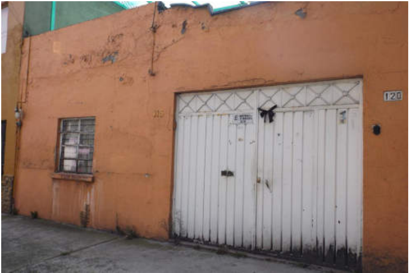
Figura 5.98. Fotografía B (Imagen 15), que muestra daño en acabado de muro de la fachada principal de una vivienda, se distinguen fracturas horizontales en aplanado de concreto y en el aplanado de la trabe del zaguán, así como también desprendimiento parcial de aplanado de concreto en la esquina superior izquierda del muro (19.4913° N, 99.1843° W. Calle: Campo lomas).
