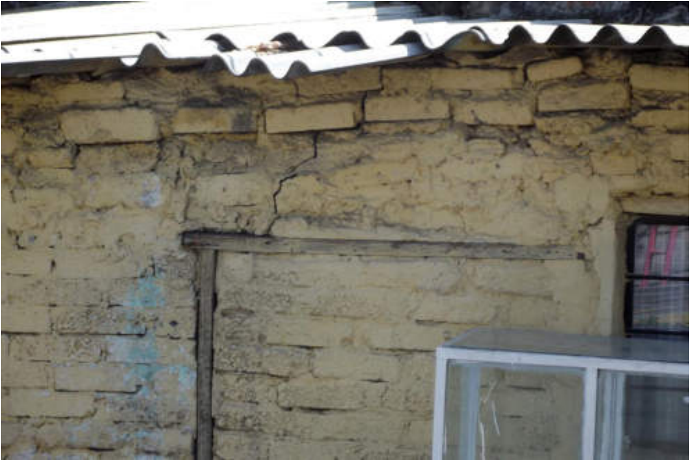
Figura 5.91. Fotografía B (Imagen 14), construcción precaria; la falta de confinamiento suscita la formación de fracturas, una de ellas parte de la zona superior hasta el marco de madera (19.4943° N, 99.1890° W. Calle: Antiguo Camino Real de San Martín).
