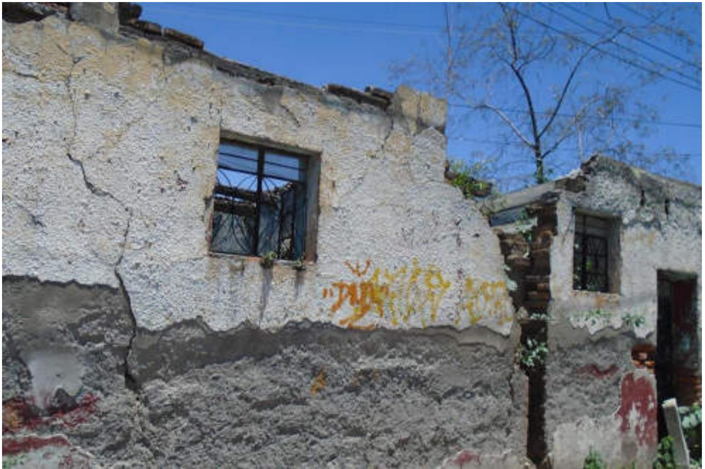
Figura 5.318. Fotografía B (Imagen 55), se observa una edificación la cual ha presentado colapsos en algunas partes de su interior, tales como la losa y el deterioro de las traves, en la parte exterior de esta vivienda se observa el colapso parcial del muro, así como la presencia de fracturas en el aplanado afectando también a la mampostería (19.4782º N, 99.2103º W. Calle: La Piedra).
