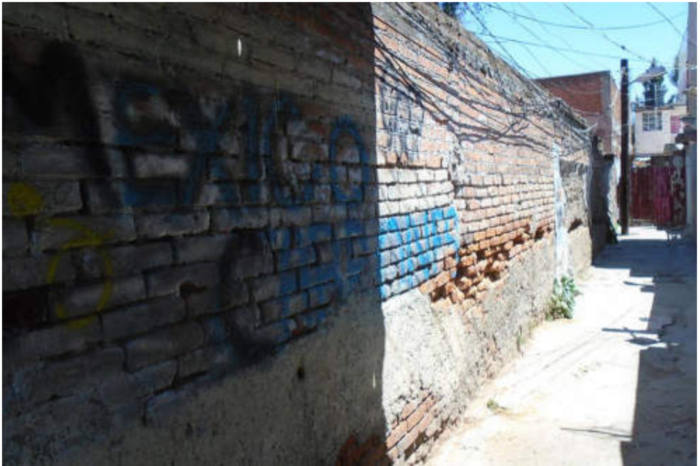
Figura 5.309. Fotografía B (Imagen 53), se muestra una estructura de mampostería en la que se visualiza el desgaste de material con el que fue construido (19.4737° N, 99.2106° W. Calle: Calzada Ahuizotla).
