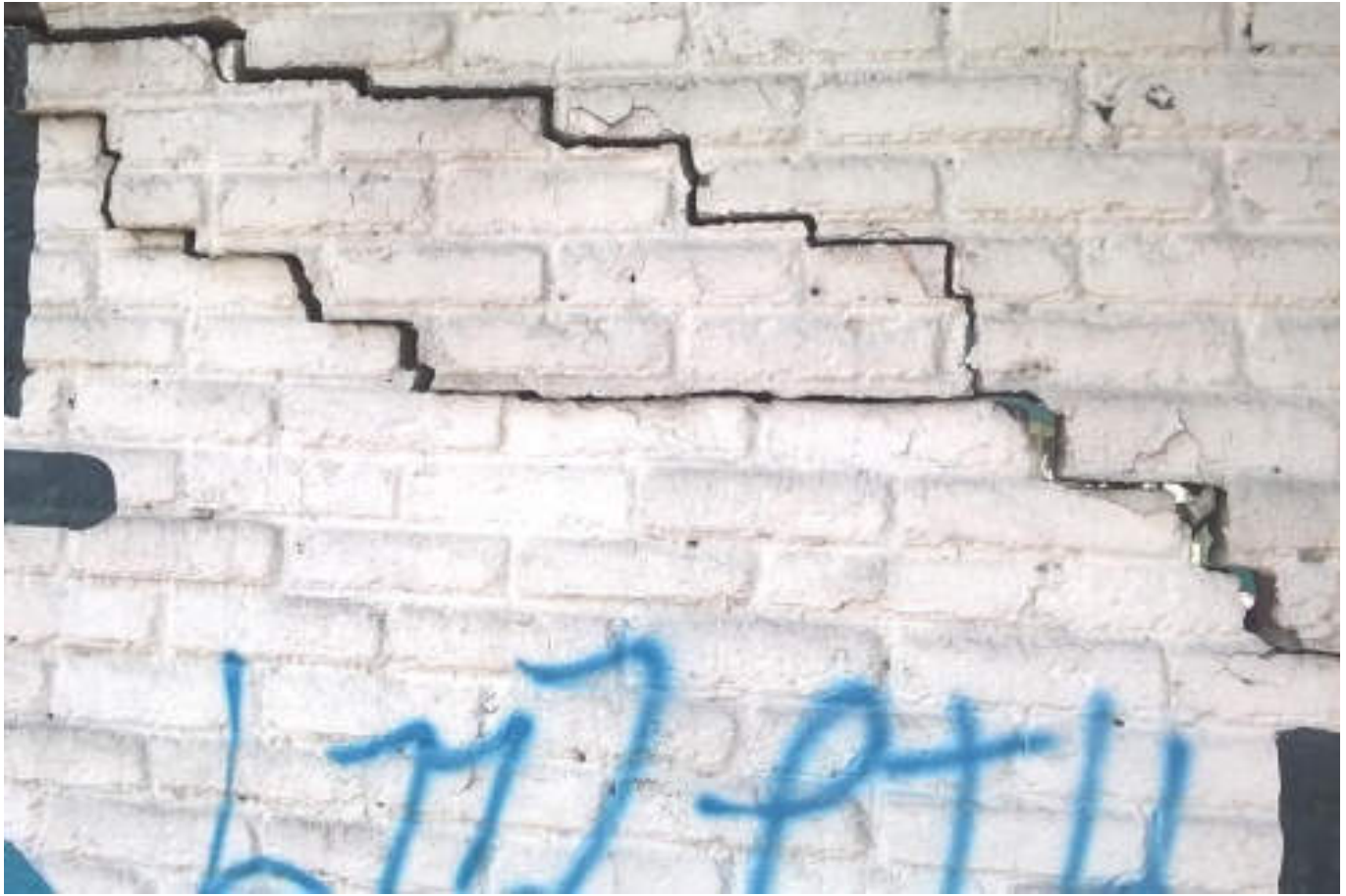
Figura 5.157. Fotografía B (Imagen 25), Se muestra un muro de mampostería que presenta dos fracturas diagonales que se unen en un punto, dichas fracturas forman un bloque de tabiques que se encuentra desplazado hacia la parte frontal del muro (19.4890° N, 99.1780° W. Calzada: Azcapotzalco La Villa).
