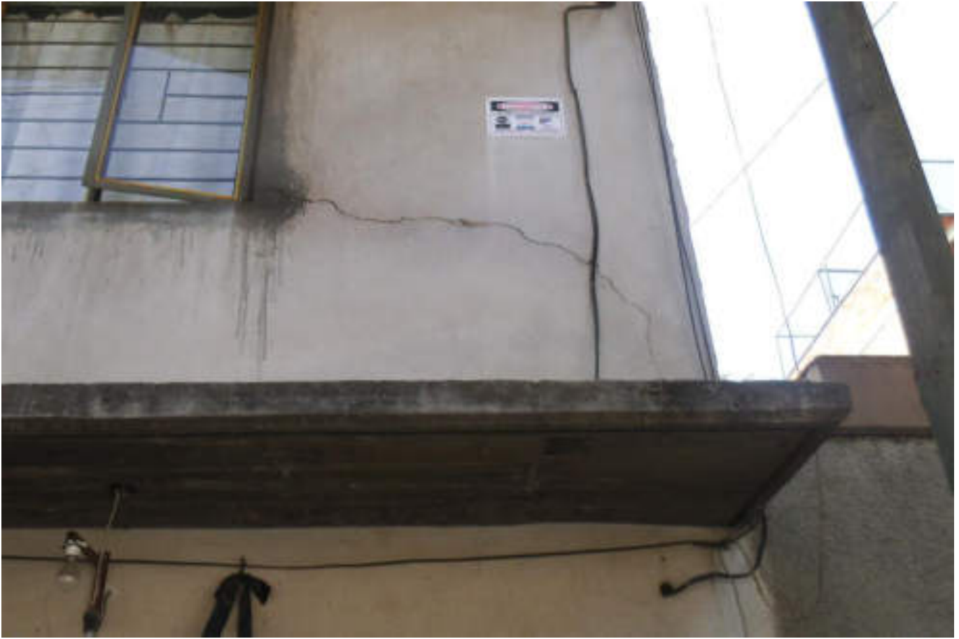
Figura 5.136. Fotografía D (Imagen 21), fractura en el muro exterior del primer piso en una vivienda, que parte de la esquina inferior derecha del marco de la ventana hasta la zona de castillo en la esquina de la construcción; el recorrido de la fractura es en dirección diagonal (19.4858° N, 99.1970° W. Calle: Xanambres).
