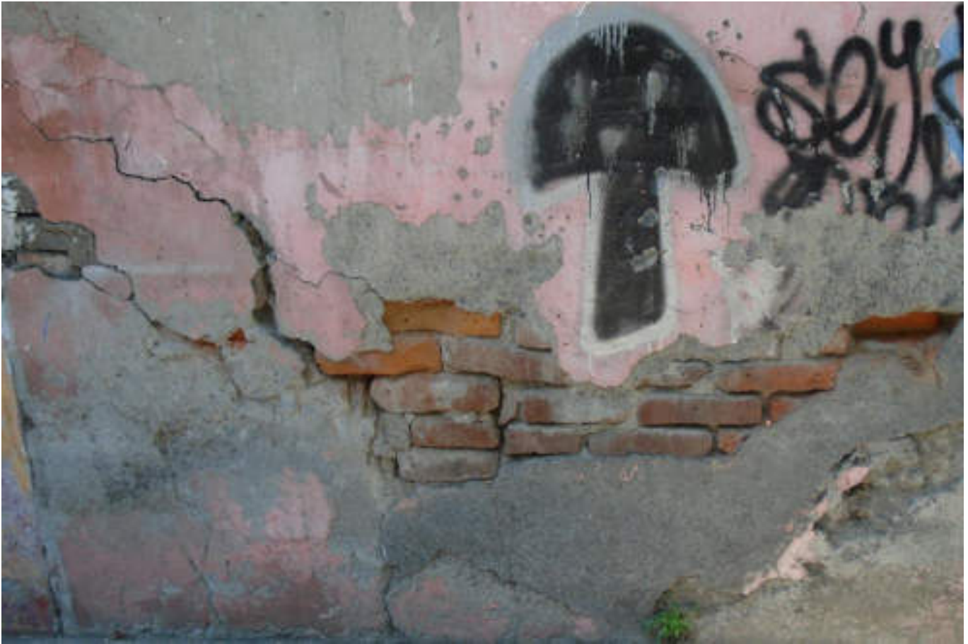
Figura 5.352. Fotografía B (Imagen 60), que muestra el desprendimiento de material del muro exterior de una vivienda, en la que se distingue el mal proceso constructivo para su elaboración (19.4666° N, 99.1759° W. Calle: Norte 75).
