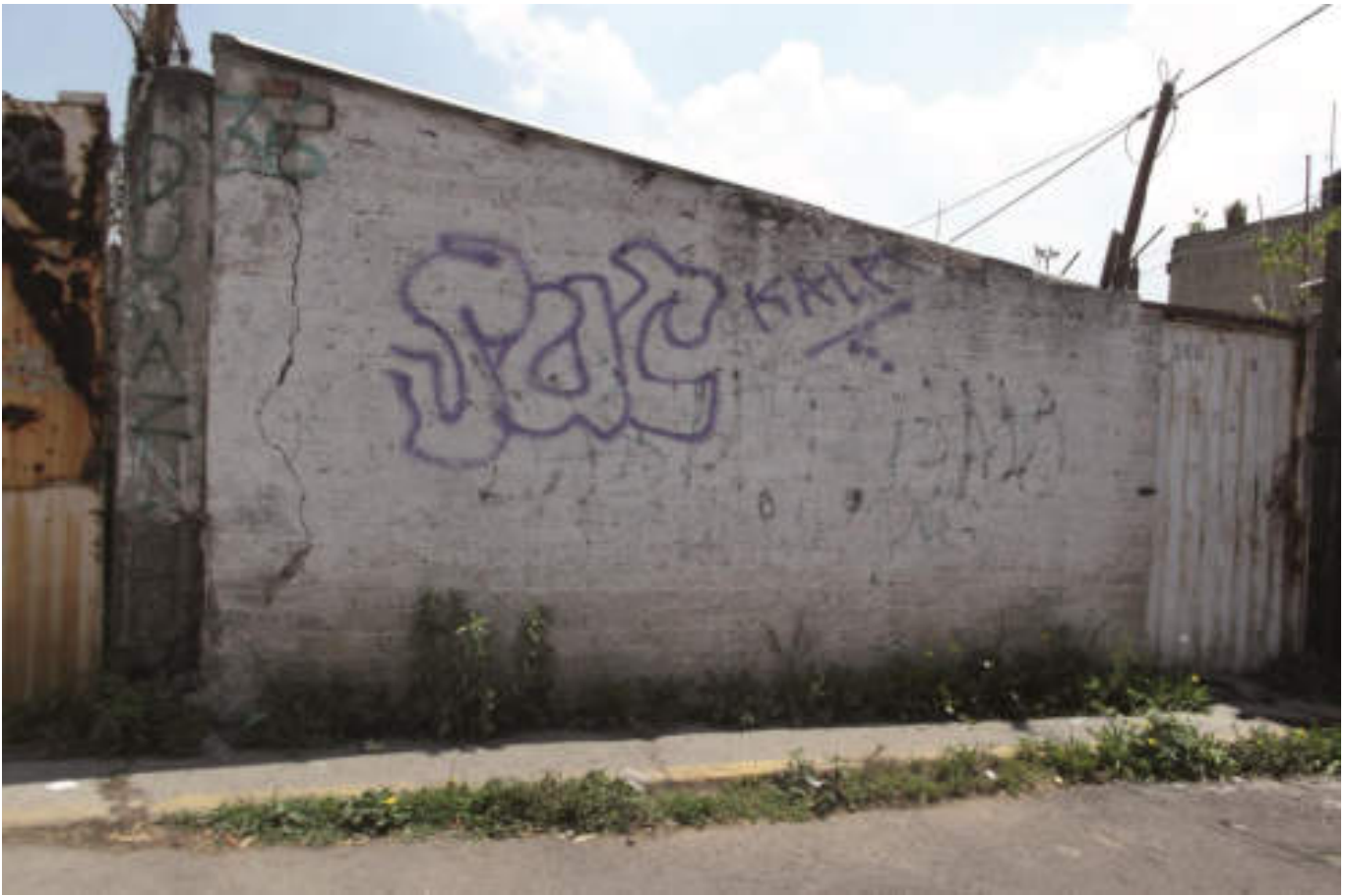
Figura 5.79. Fotografía B (Imagen 12), que muestra el muro externo de un inmueble el cual se encuentra afectado por una fractura vertical que va de la parte superior izquierda del muro hacia la parte inferior del mismo (19.4942° N, 99.1900° W. Calle: FF. CC. Nacionales de México).
