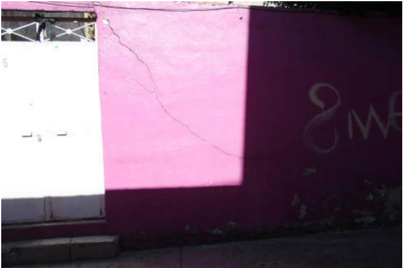
Figura 5.301. Fotografía A (Imagen 52), en esta imagen se muestra una vivienda que presenta una fractura en forma diagonal comenzando de la parte superior de la puerta hacia la parte baja del muro (19.4813° N, 99.2185° W. Calle: Ignacio Comonfort).
