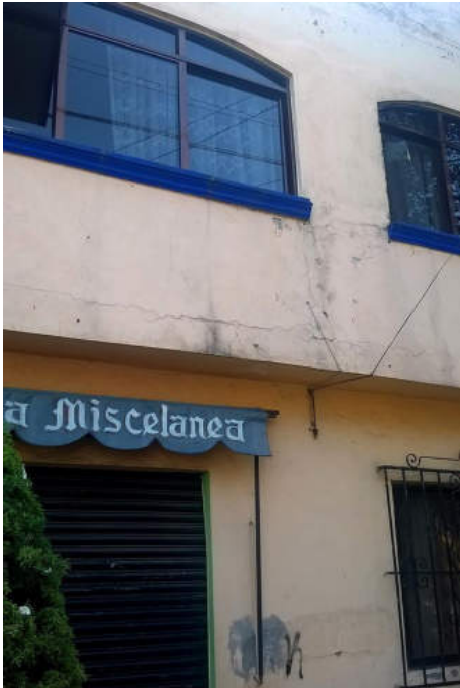
Figura 5.228. Fotografía C (Imagen 37), en ella se puede apreciar múltiples fracturas en forma horizontal entre el muro y la losa y en el pretil debido a la falta de refuerzos verticales (19.4751° N, 99.1615° W. Calle: E).
