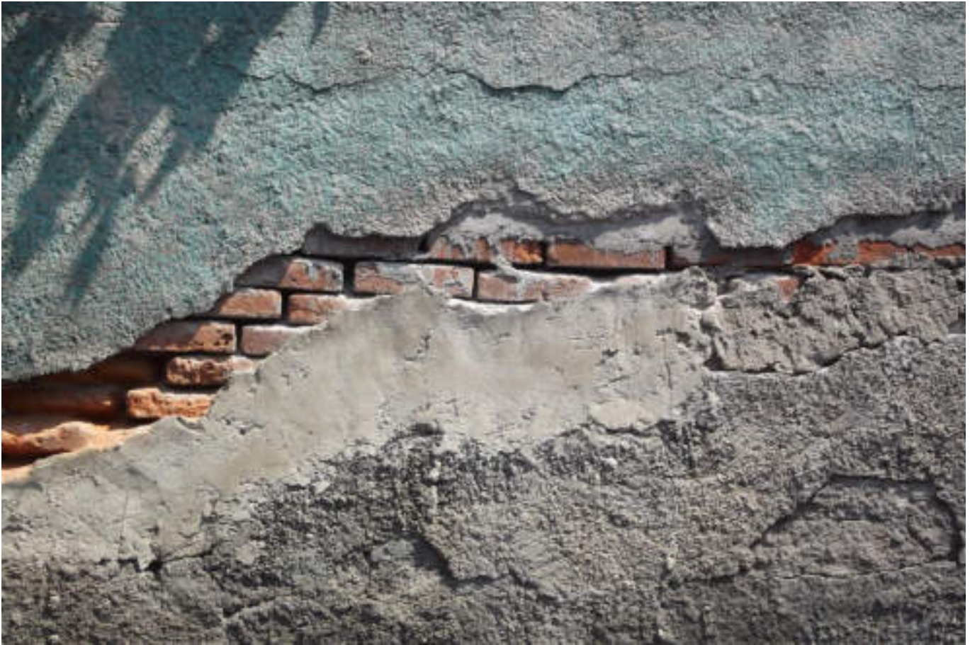
Figura 5.93. Fotografía D (Imagen 14), muro perimetral que presenta desprendimiento tanto de aplanado como del junteo entre ladrillos; además la falta de aplanado como protección provocó el deterioro de los ladrillos expuestos a la intemperie (19.4950° N, 99.1873° W. Calle: Gasoducto).
