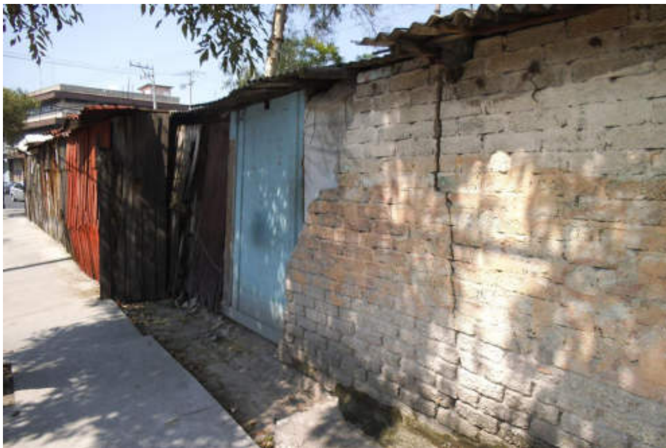
Figura 5.184. Fotografía A (Imagen 29), muestra una vivienda con fractura en forma descendiente en su muro de mampostería, así como la unión de múltiples materiales con procedimientos constructivos no adecuados (19.4826° N, 99.154° W. Calzada: Coltongo).
