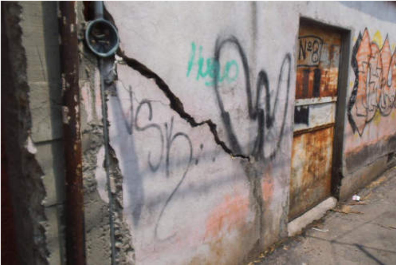
Figura 5.108. Fotografía E (Imagen 16), se muestra una edificación de mampostería confinada que presenta desprendimiento parcial de acabados así como un orificio en la parte inferior derecha de la Figura 5.107 que separa los elementos estructurales tales como son muro y cimentación impidiendo que trabajen apropiadamente (19.4923° N, 99.1782° W. Calle: Sexto).
