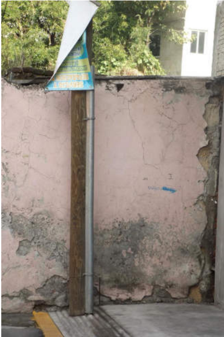
Figura 5.141. Fotografía C (Imagen 22), muro de mampostería sin confinamiento que muestra desprendimiento parcial de aplanado de concreto a causa del fracturamiento (19.4842° N, 99.1916° W. Calle: Reina Xóchitl).
