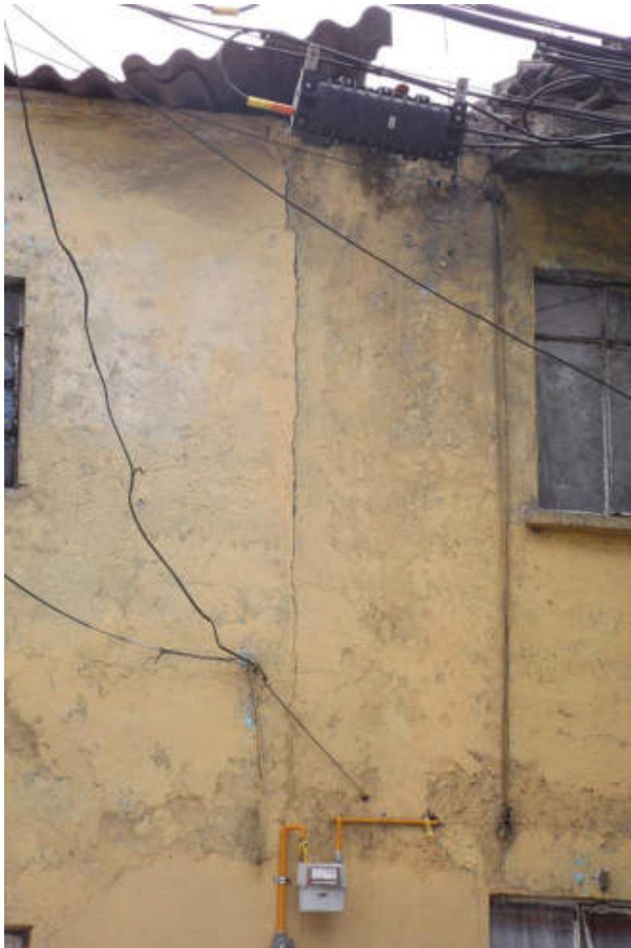
Figura 5.145. Fotografía B (Imagen 23), se muestra una edificación en donde existe una fractura vertical de aproximadamente dos metros, ubicada en el nivel superior y en la junta de entre el castillo y el muro, así como fracturas en el aplanado (19.4877° N, 99.1863° W. Calle: Prolongación San Simón).
