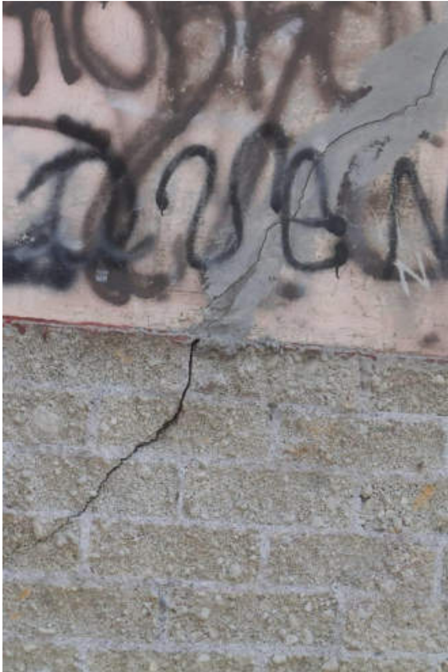
Figura 5.87. Fotografía E (Imagen 13), ella se muestra un muro de mampostería que presenta una fractura diagonal que separa el elemento estructural, es posible distinguir que la fractura ha sido reparada y ha vuelto a aparecer (19.4977º N, 99.1847º W. Calle: Segunda Ángeles).
