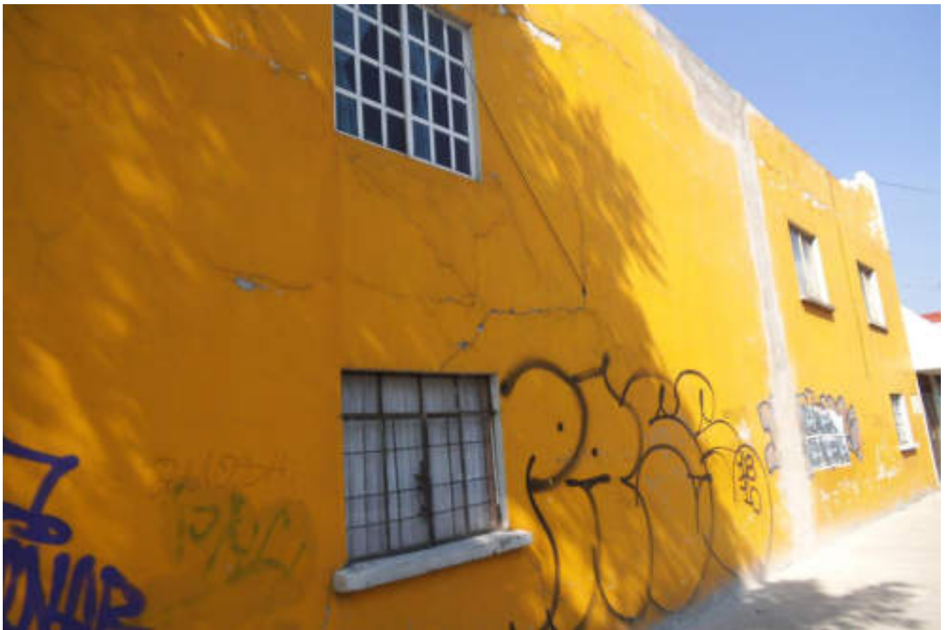
Figura 5.151. Fotografía A (Imagen 24), se muestra el fracturamiento en una fachada. Las fracturas más representativas son las que parten del marco de la ventana ubicada en la planta baja, se observa un resanamiento vertical que cruza toda la fachada, desde la zona superior hasta el nivel de piso (19.4895° N, 99.1822° W. Calle: 4 Norte (Refinería Azcapotzalco)).
