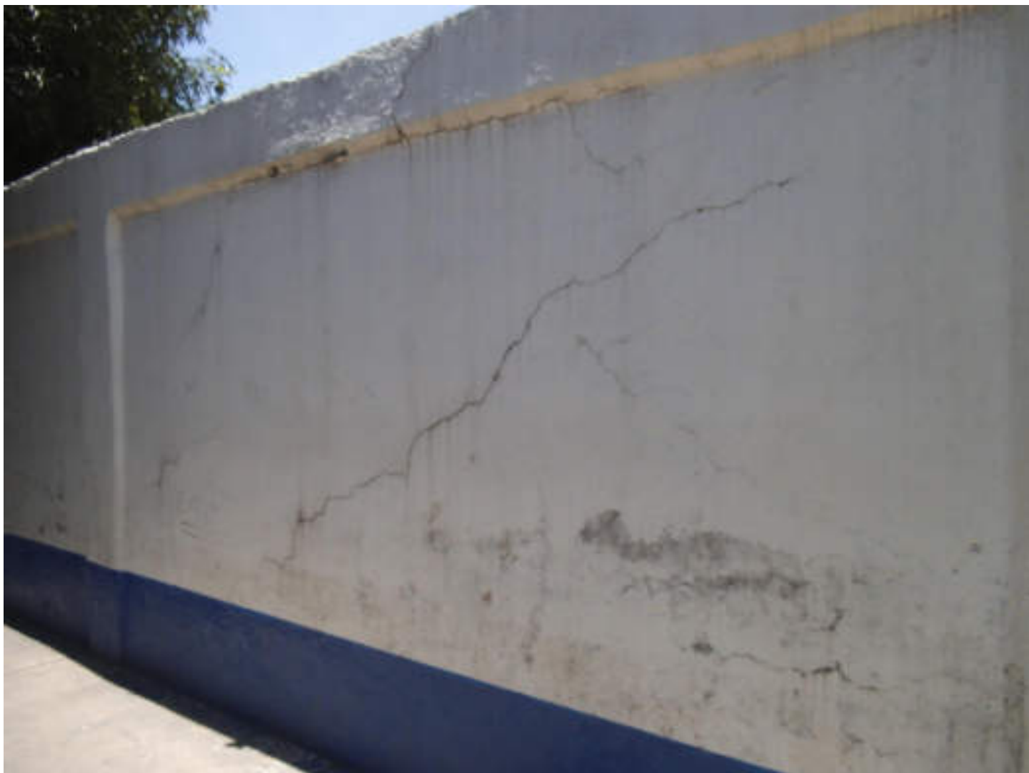
Figura 5.175. Fotografía B (Imagen 28), en la que se observa un muro afectado por una fractura diagonal, también es posible identificar una separación de la parte superior del muro con respecto a la trabe (19.4840° N, 99.1612° W. Calle: Norte 41).
