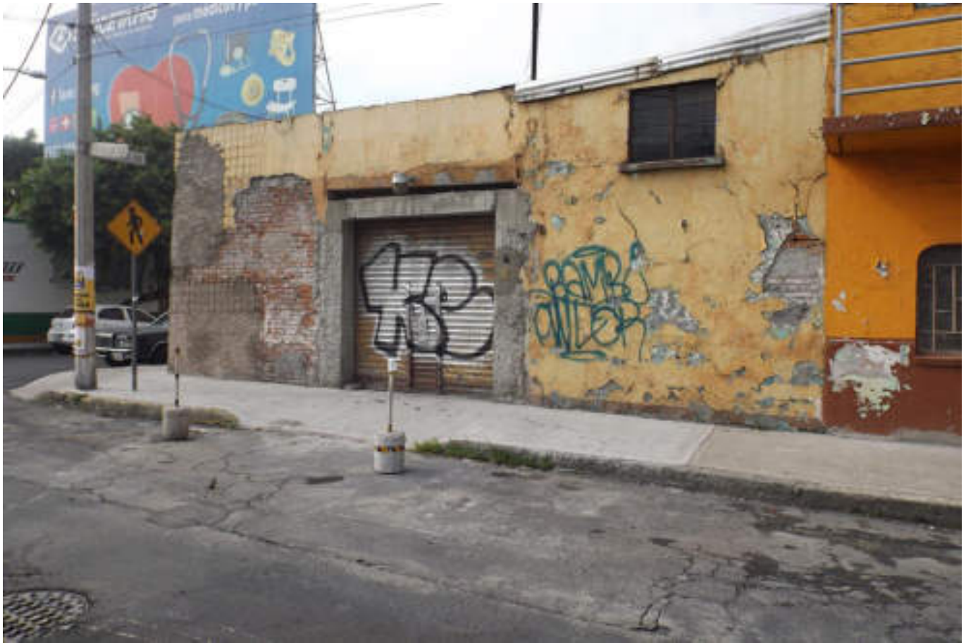
Figura 5.296. Fotografía C (Imagen 51), se muestra una estructura de mampostería semiconfinada con una separación en el marco de concreto de la cortina de acceso y el muro. Existe deterioro en el acabado de fachada, así como desprendimiento de material a ambos lados de la cortina (19.4724 ° N, 99.1461 ° W. Calle: 30).
