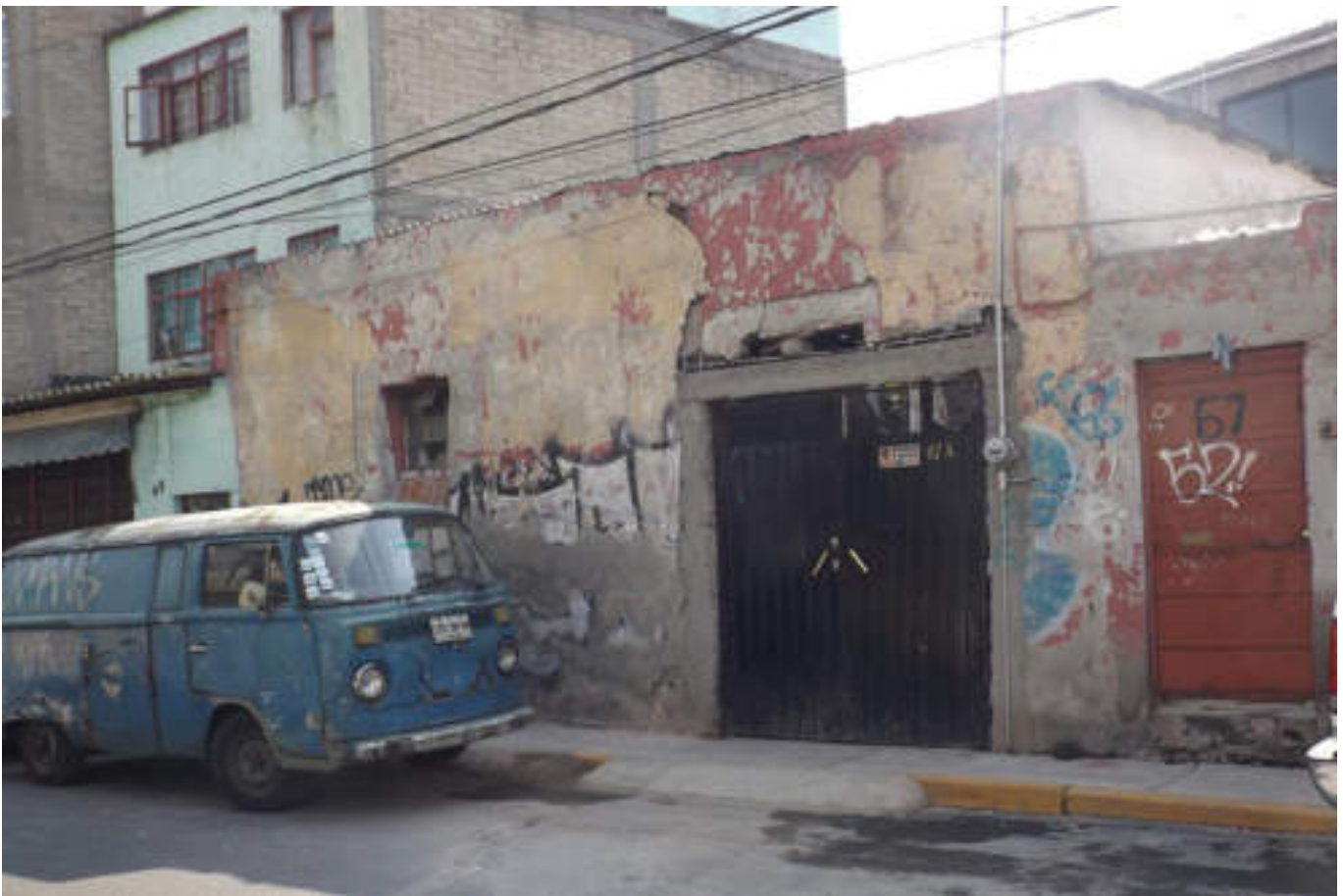
Figura 5.144. Fotografía A (Imagen 23), que muestra una vivienda de mampostería semiconfinada con desprendimiento parcial de aplanado de concreto y daños en acabado a causa de intemperismo, se observa una discontinuidad entre la trabe de concreto respecto al muro de fachada (19.4880° N, 99.1863° W. Calle: Prolongación San Simón).
