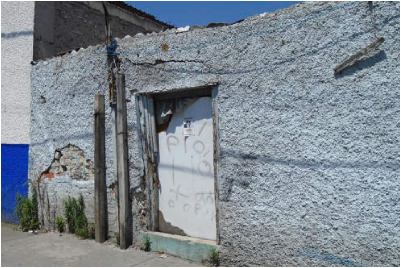
Figura 5.304. Fotografía D (Imagen 52), se muestra una vivienda que presenta una fractura horizontal en la parte superior del acceso, debilitando así al muro. En el costado izquierdo de la puerta se disgregación de la mampostería (19.4752° N, 99.2177° W. Calle: José Cardel).
