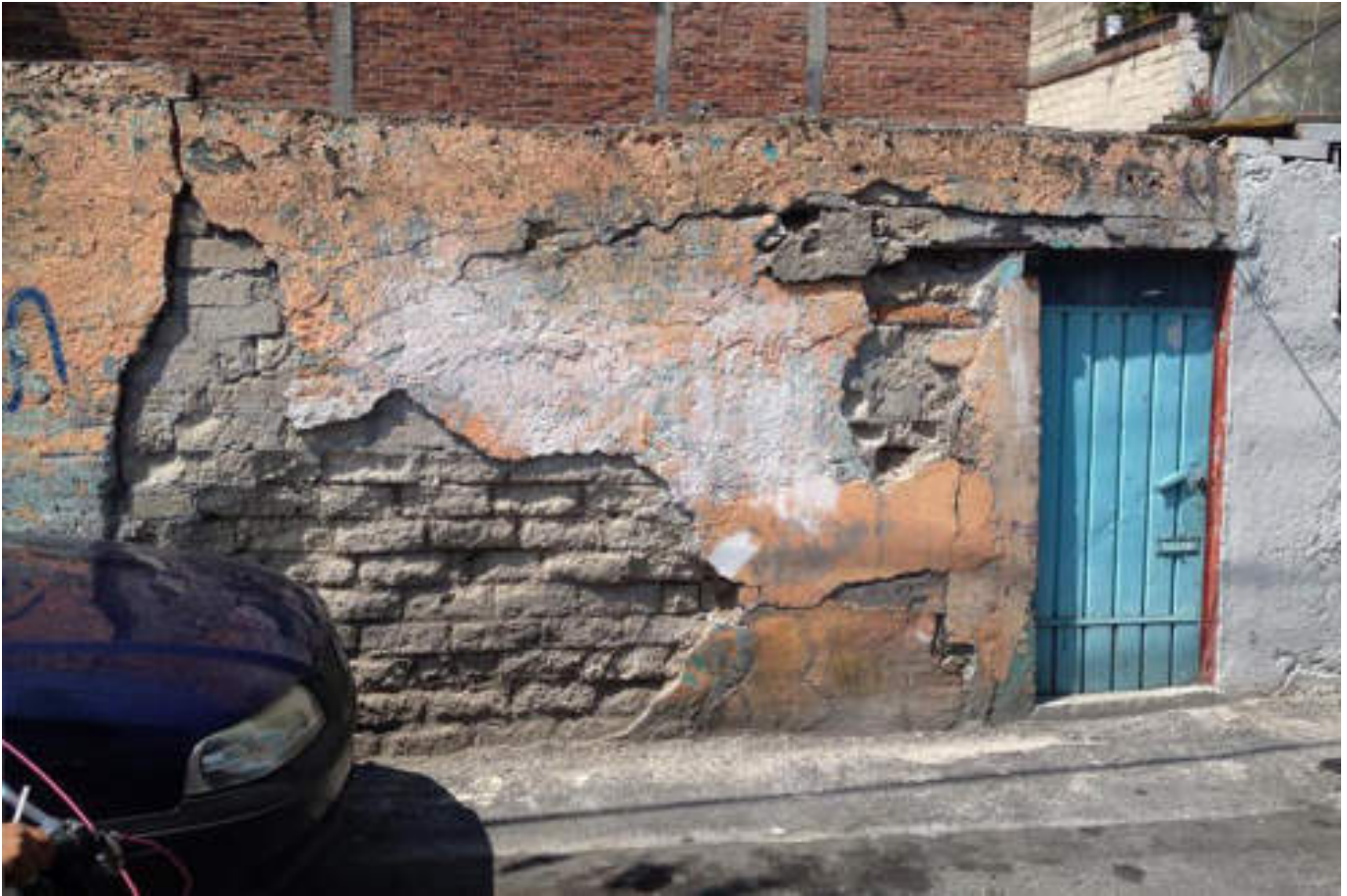
Figura 5.194. Fotografía B (Imagen 32), se observa un muro de mampostería que presenta una fractura vertical del lado izquierdo y una horizontal en la parte superior de la puerta, estas fracturas hacen que el aplanado se debilite y se desprenda en una gran parte del muro, haciendo que la mampostería quede a la intemperie y se disgregue (19.4848° N, 99.1953° W. Calle: San Mateo).
