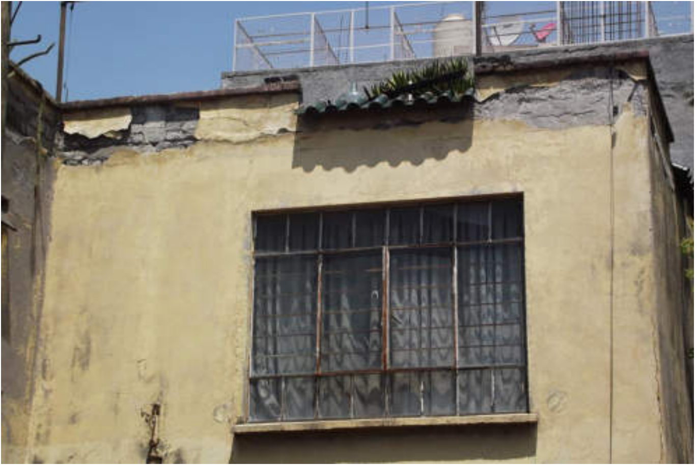
Figura 5.357. Fotografía C (Imagen 62), muestra una edificación de mampostería confinada con desprendimientos parciales de acabados, asimismo se muestra un corte en la parte central del pretil lo que debilita la estructura (19.4588° N, 99.1687° W. Calle: Juan Sarabia).
