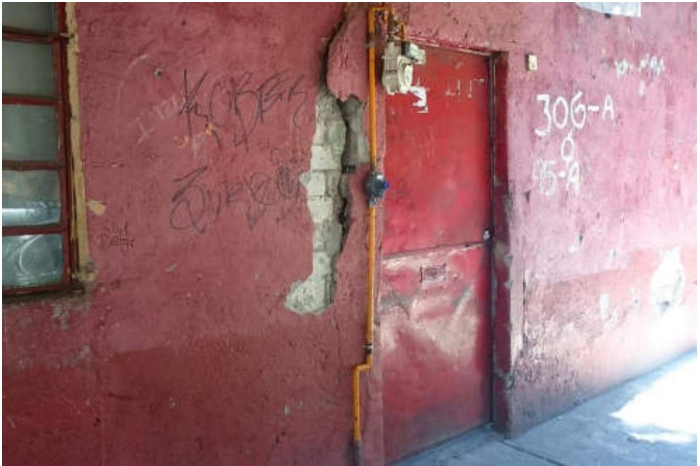
Figura 5.65. Fotografía B (Imagen 10), se muestra el muro exterior de una vivienda , el cual se desplazó hacia dentro del predio, por lo que perdió continuidad con el castillo provocando una brecha entre este último y el muro, además del desprendimiento del aplanado en esa zona (19.4999º N, 99.1988º W. Calle: Tierra Negra).
