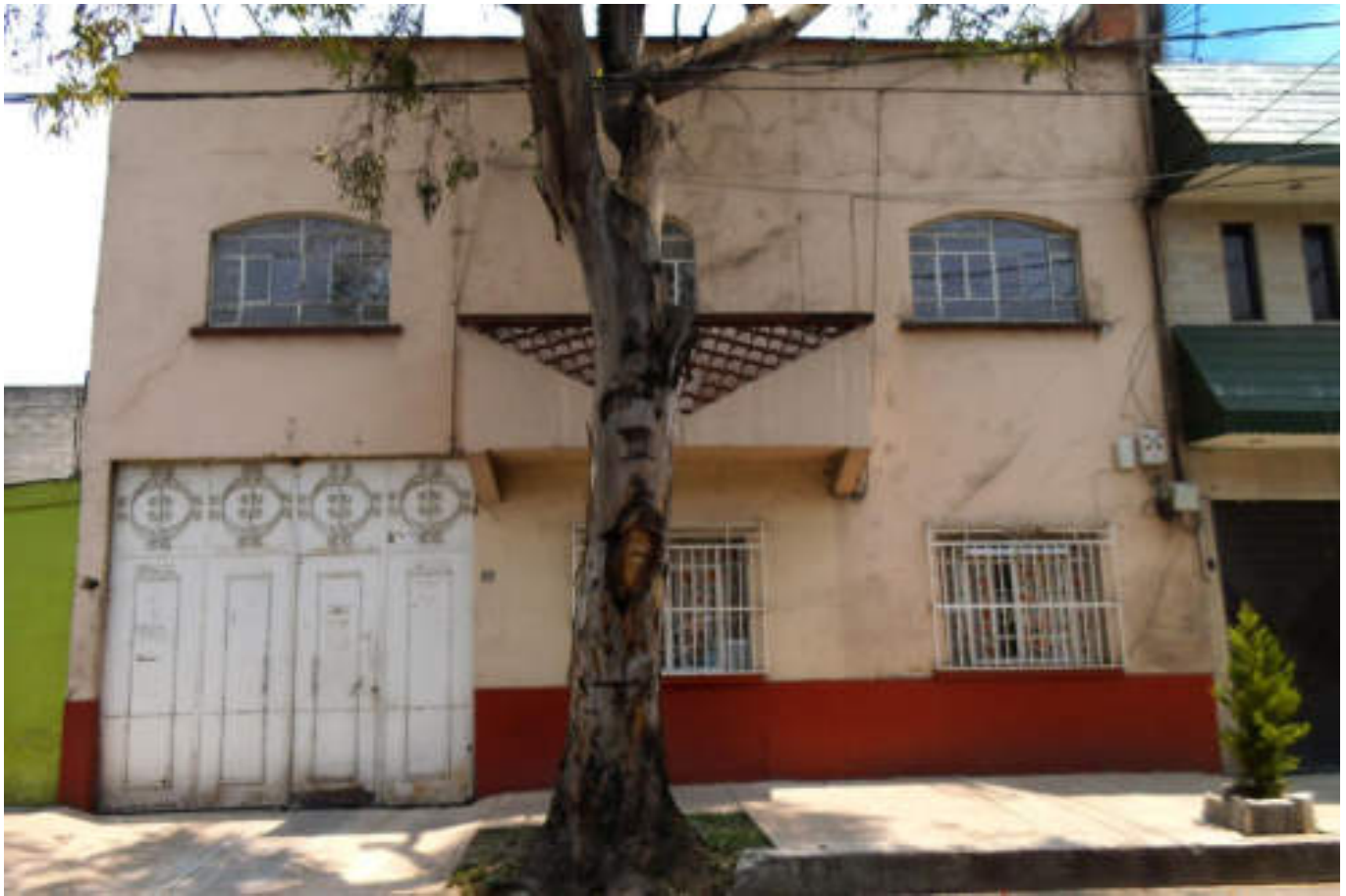
Figura 5.239. Fotografía D (Imagen 39) en el inmueble se observan fracturas en forma diagonal y horizontal en la mayor parte de la fachada, así como daños en los acabados (19.4775° N, 99.1503° W. Calle: Fundidores).
