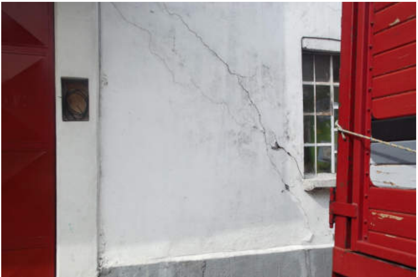
Figura 5. 25. Fotografía A (Imagen 4a), muro de edificación que presenta una fractura diagonal la cual incide en la esquina de la ventana denotando que la estructura no cuenta con confinamiento. El acabado también presenta fracturas diagonales y horizontales (19.4950978225° N, 99.180667833° W. Calle: Miguel Hidalgo).
