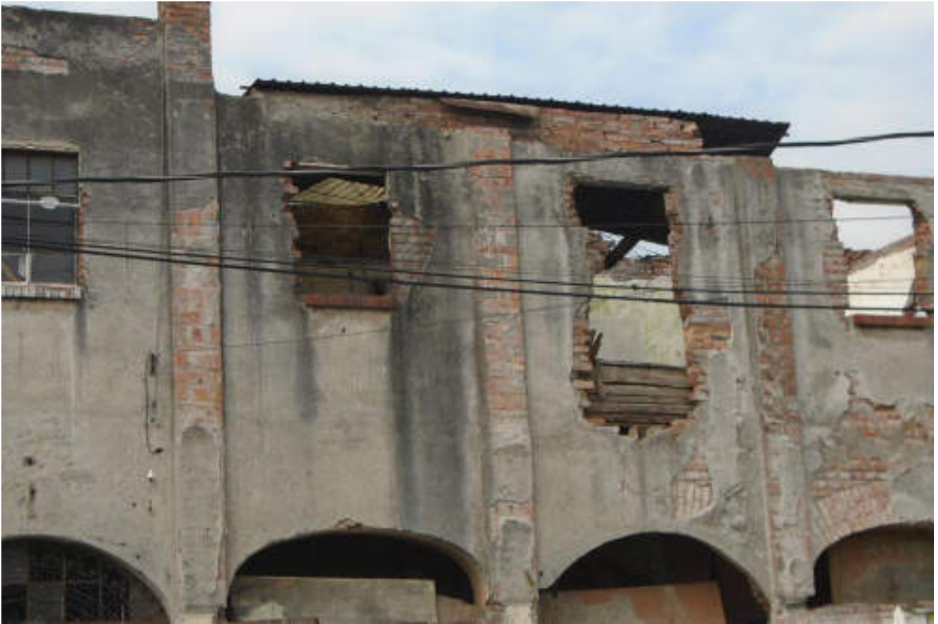
Figura 5.298. Fotografía D (Imagen 51), se muestra una edificación que presenta daño en acabados y fracturas así como algunas modificaciones que no presentan confinamiento, lo que desestabiliza la estructura (19.4690765325° N, 99.146839013° W. Calle: Segunda Cerrada Cuauhtémoc)
