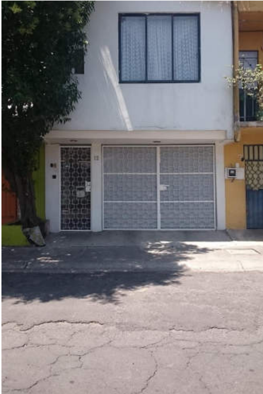
Figura 5.9. Fotografía A (Imagen 1a), en ella se muestra una estructura de mampostería que presenta una fractura horizontal en la planta alta de la vivienda, la cual rompe el muro en el espacio correspondiente al confinamiento (19.5129° N, 99.2057° W. Calle: Física).
