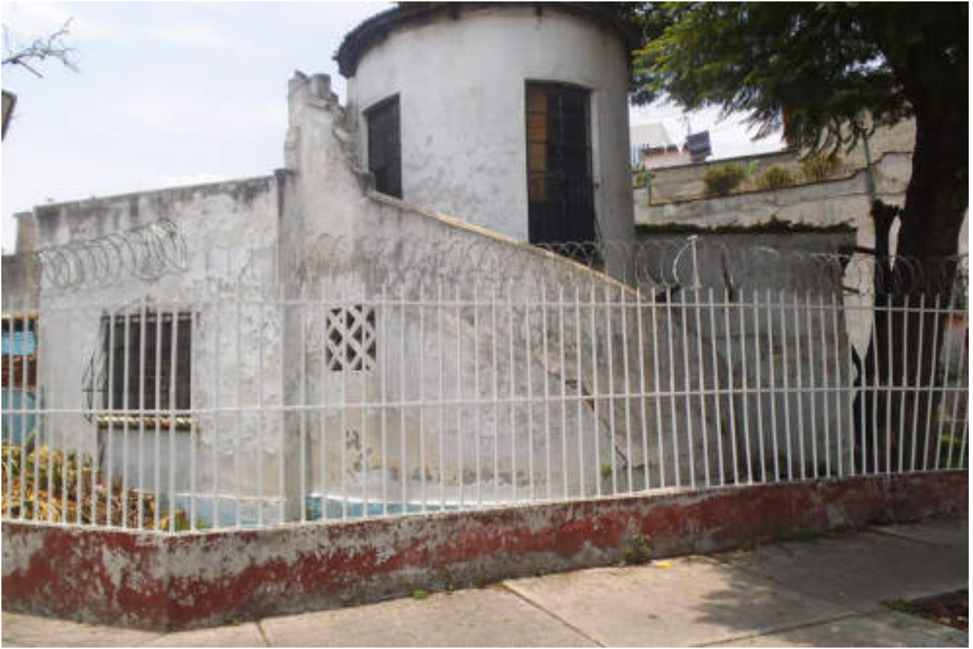
Figura 5.347. Fotografía D (Imagen 60), vivienda de mampostería que presenta una fractura diagonal en el muro que recubre las escaleras, esta fractura sigue la dirección de inclinación en caracol de las escaleras (19.4656° N, 99.1841° W. Calle: Tebas).
