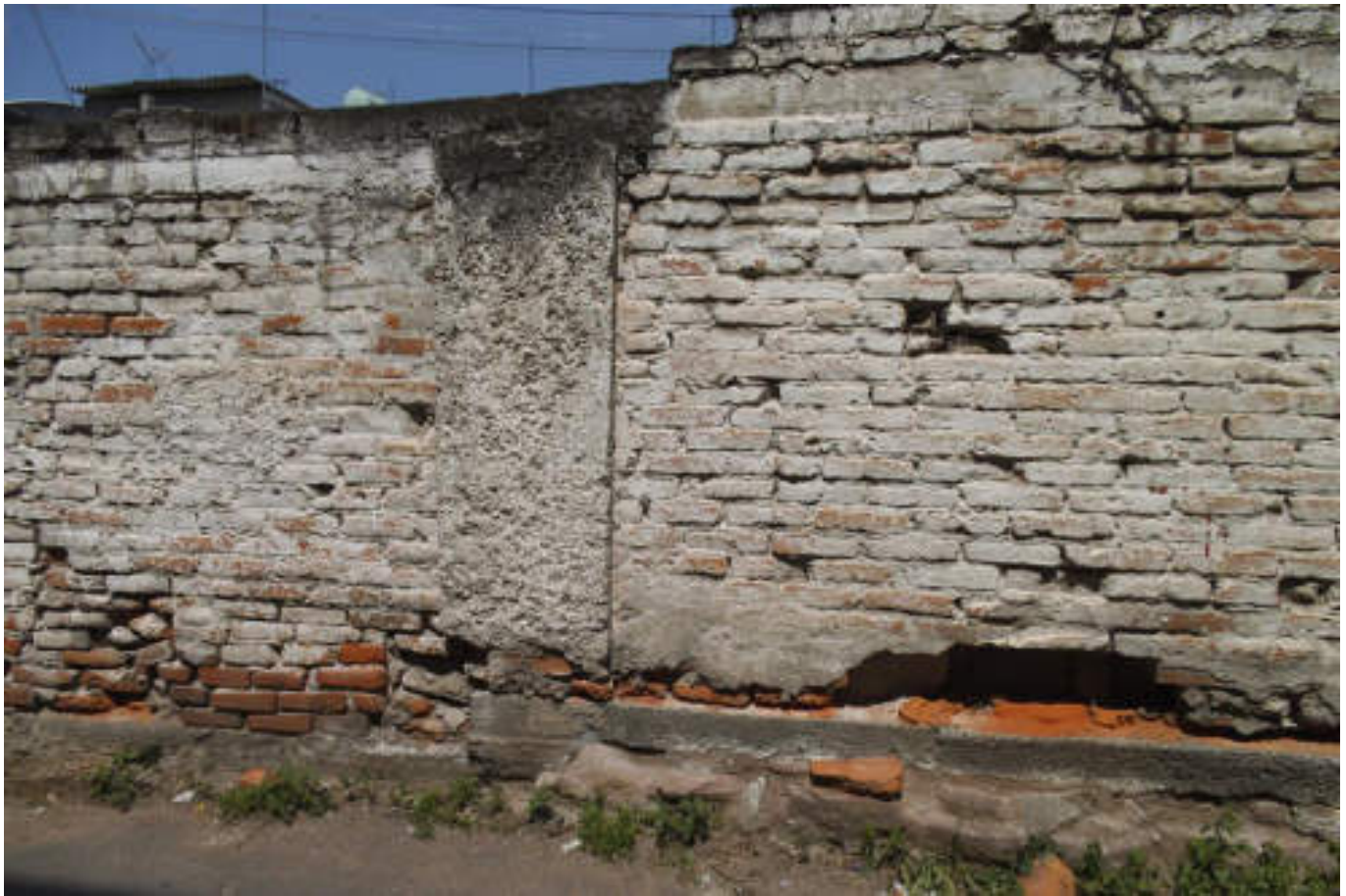
Figura 5.237. Fotografía B (Imagen 39), se muestra una barda de mampostería no confinada que presenta desgaste en el material con el que fue construida, tiene desprendimientos parciales de los mismos. Del lado inferior izquierdo se observa como los ladrillos han sido reacomodados en dos orificios (19.4806° N, 99.1530° W. Calle: Sin nombre oficial).
