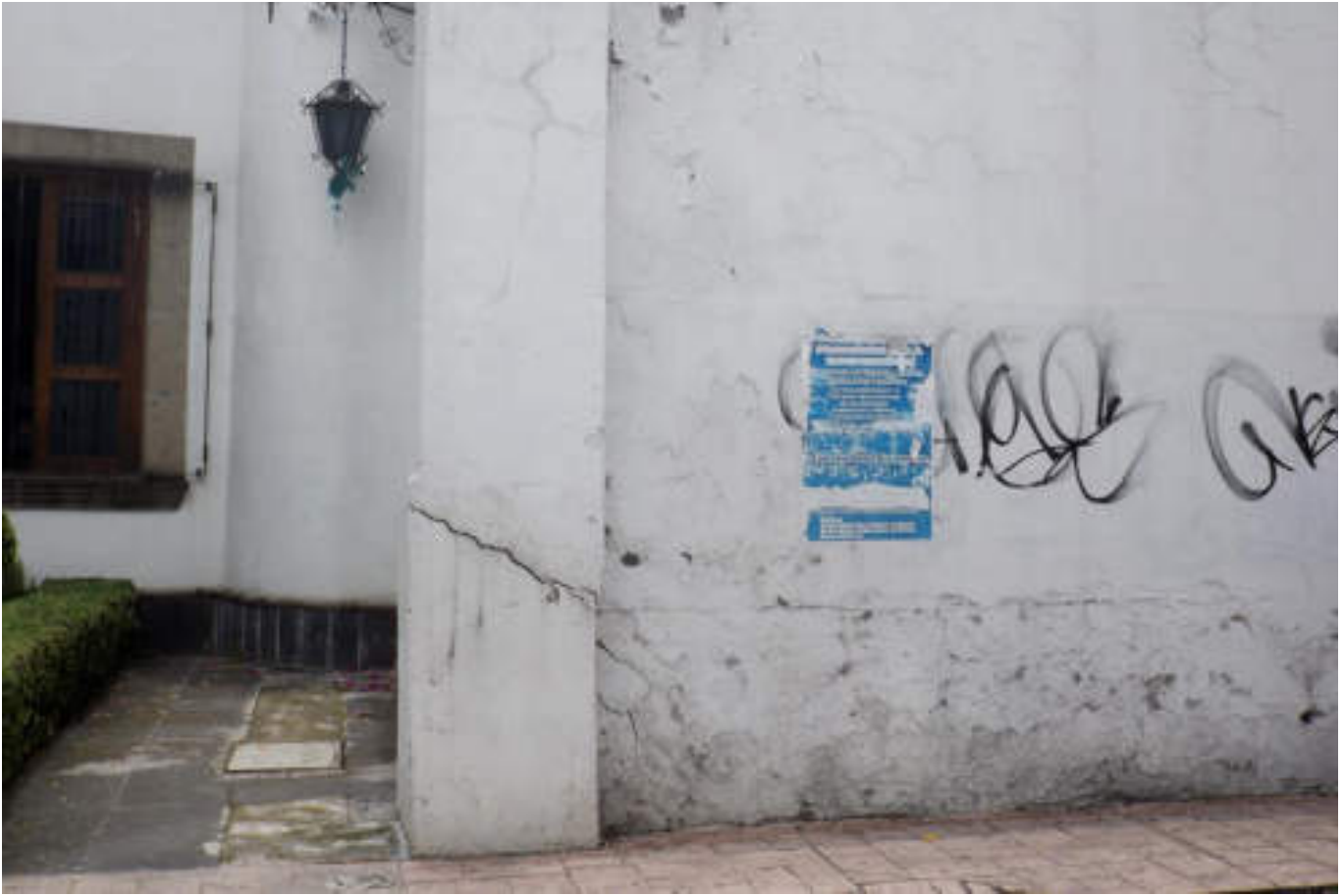
Figura 5.205. Fotografía G (Imagen 33), se muestra el desplazamiento en un castillo de una vivienda, lo que provocó una fractura a lo ancho en dirección diagonal (19.4803° N, 99.1856° W. Calle: Morelos y Pavón).
