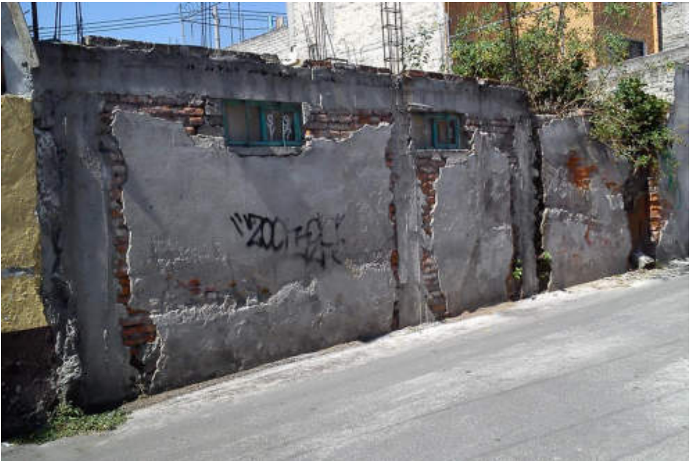
Figura 5.308. Fotografía A (Imagen 53), podemos observar daños en acabados por deterioro y paso del tiempo se aprecian algunos desprendimientos de los mismos y fracturas en forma horizontal y vertical (19.4773° N, 99.2100° W. Calle: Calzada Ahuizotla).
