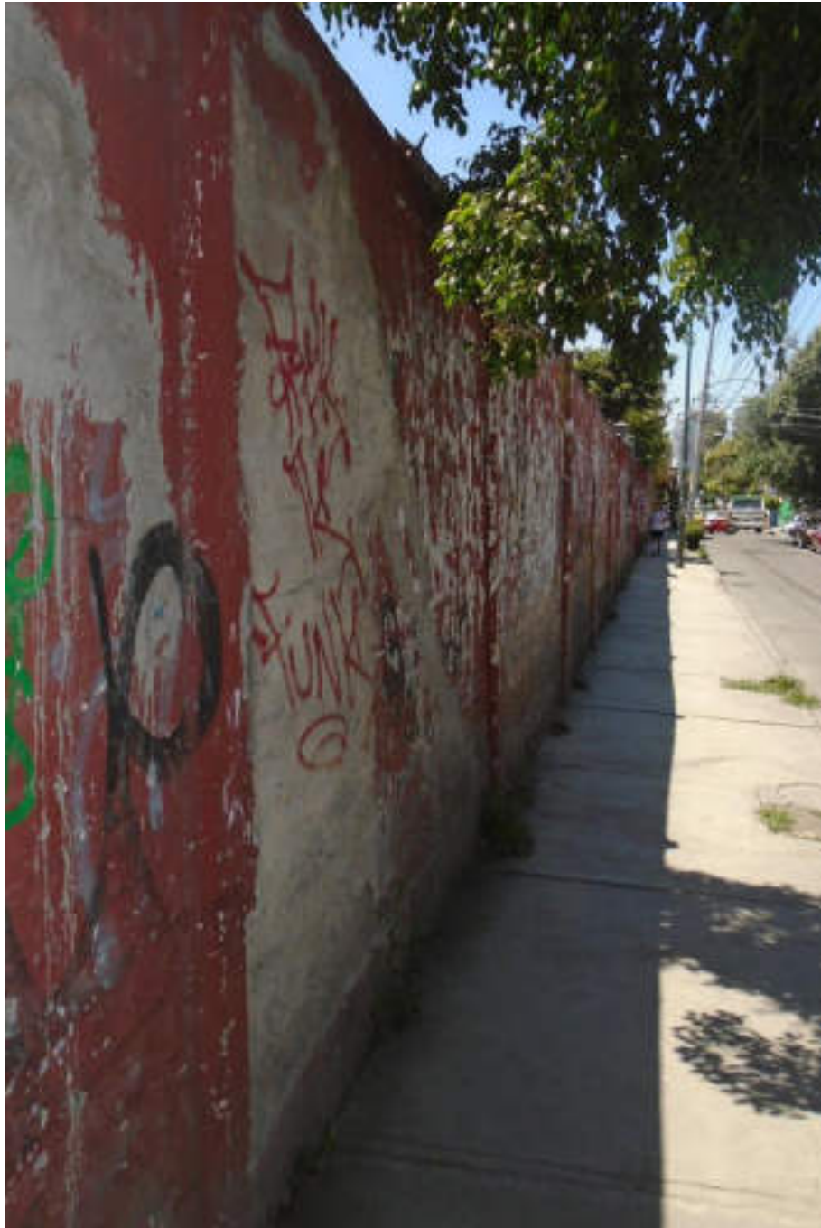
Figura 5.310. Fotografía C (Imagen 53), se observan desprendimientos parciales en los acabados, se distingue una inclinación en la construcción en dirección contraria a la calle (19.4731° N, 99.2108° W. Calle: Ahuizotla).
