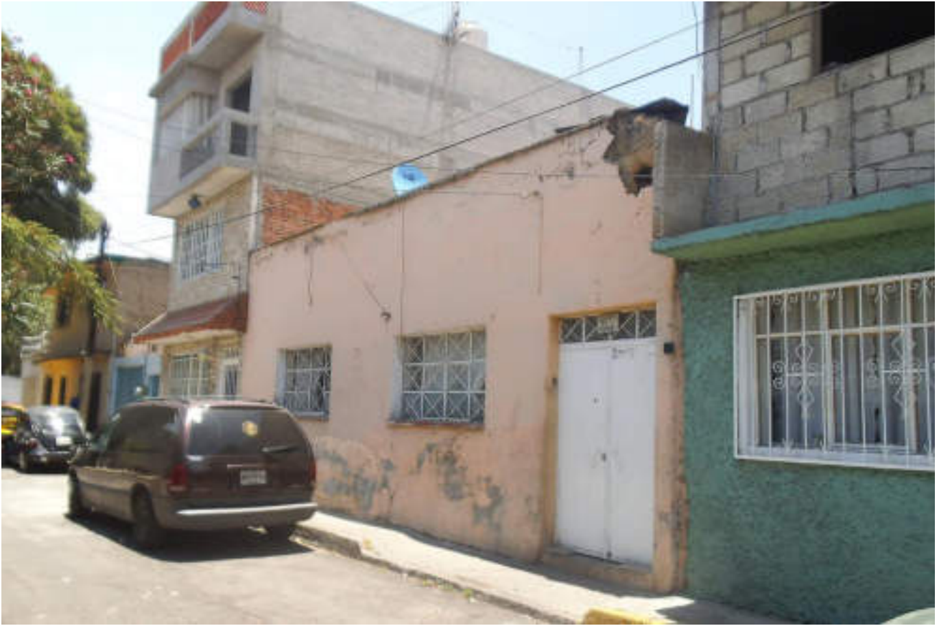
Figura 5.35. Fotografía D (Imagen 5), vivienda de mampostería no confinada con deterioro en acabado, se presenta fractura horizontal del aplastado de concreto en la base de la vivienda, así como también desprendimiento del mismo en la esquina superior izquierda ocasionando un orificio en esta parte del muro. (19.5045° N, 99.1754° W. Calle: Colombo).
