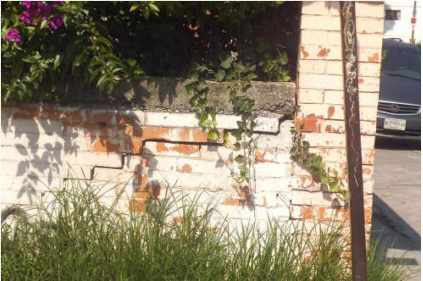
Figura 5.13 Fotografía E (Imagen 1a), en la que se observa un muro perimetral afectado por una fractura diagonal, que sigue la junta de los ladrillos (19.5092° N, 99.2029° W. Calle: Vanadio).
