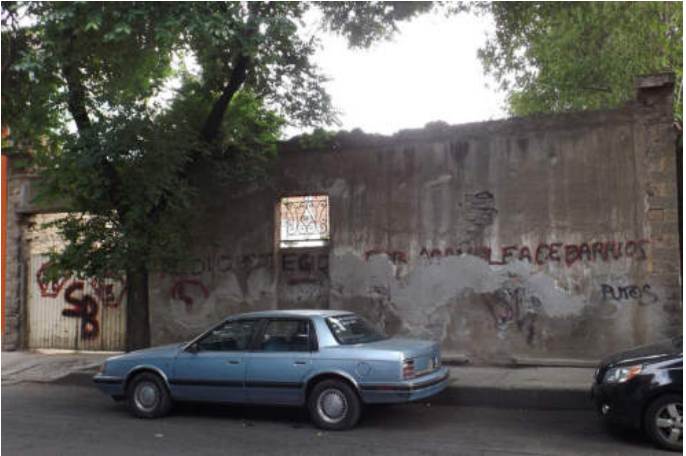
Figura 5.377. Fotografía D (Imagen 65), podemos observar un muro exterior de mampostería sin confinamiento por la ausencia de refuerzos verticales como horizontales debido a que las fracturas de forma diagonal que presenta recorren todo el claro del muro y causando colapsos parciales en su aplanado, además de tener colapsos en la losa (19.4602° N, 99.1845° W. Calle: Independencia).
