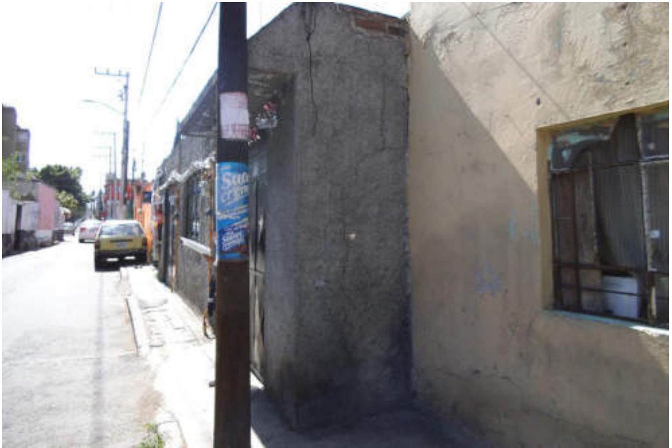
Figura 5.128. Fotografía C (Imagen 20), vivienda de mampostería con fracturas en aplanado del muro exterior lateral y sin recubrimiento parcial de concreto en la esquina superior izquierda. La vivienda a la izquierda de la fotografía no está confinada (por elementos como castillos, cadena de cerramiento) presenta una familia de fracturas horizontales y verticales en la parte inferior del muro (19.4910° N, 99.2030° W. Calle: Cándido Navarro).
