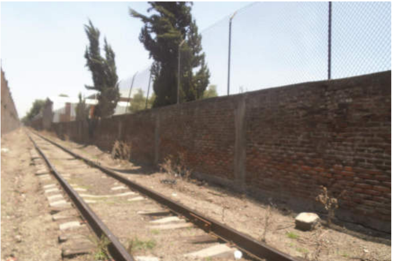
Figura 5.41. Fotografía C (Imagen 6), se muestra una barda de ladrillo con fracturas horizontales en cadena de cerramiento y desprendimiento de elementos. Es apreciable la ondulación de la barda en toda su longitud (19.5006306328° N, 99.1669816533° W. Calle: Poniente 146).
