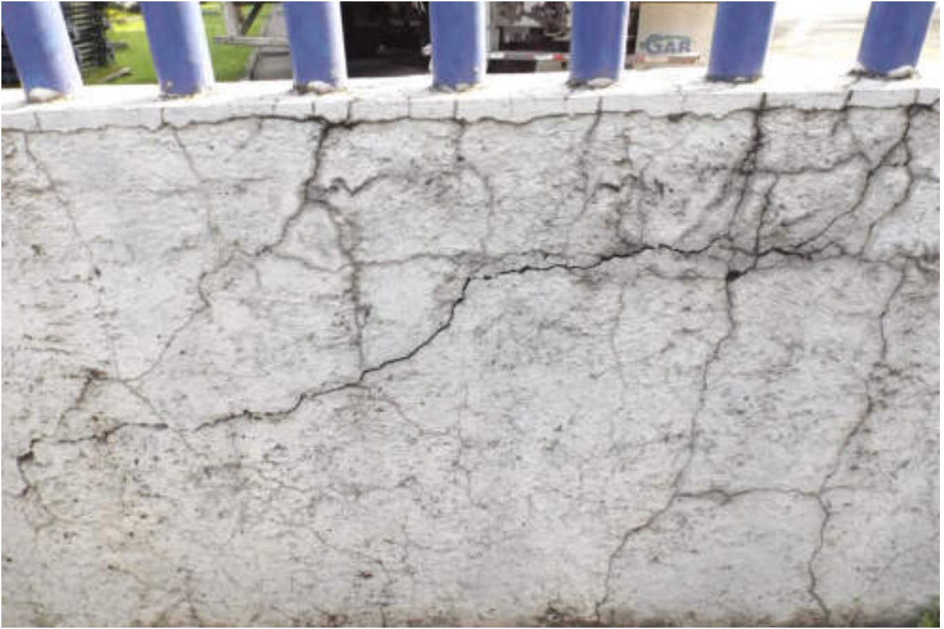
Figura 5.49. Fotografía C (Imagen 7a), se muestra una serie de fracturas en el muro exterior de un inmueble (19.5021° N, 99.1919° W. Calle: De los Ángeles).
