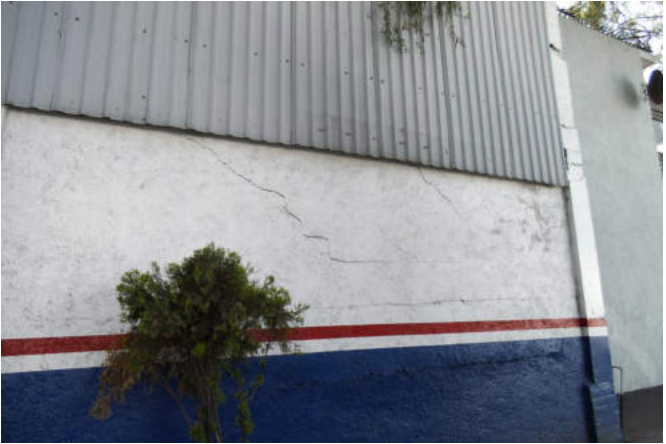
Figura 5.176. Fotografía C (Imagen 28), que muestra el muro exterior de un inmueble con fracturas tanto diagonales como horizontales que afectan su composición y por ende la estabilidad del mismo (19.4840° N, 99.1612° W. Calle: Norte 45).
