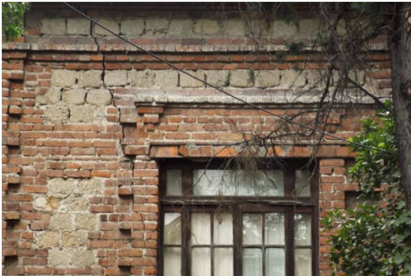
Figura 5.375. Fotografía B (Imagen 64), se aprecia una vivienda de mampostería no confinada debido a la falta de refuerzos, tanto verticales como horizontales, asimismo presenta una fractura en forma diagonal causando rupturas en las piezas de mampostería, se observa que se rellenaron espacios en el muro con otro tipo de material provocando que no trabaje como un mismo elemento (19.4602° N, 99.1837° W. Calle: Independencia).
