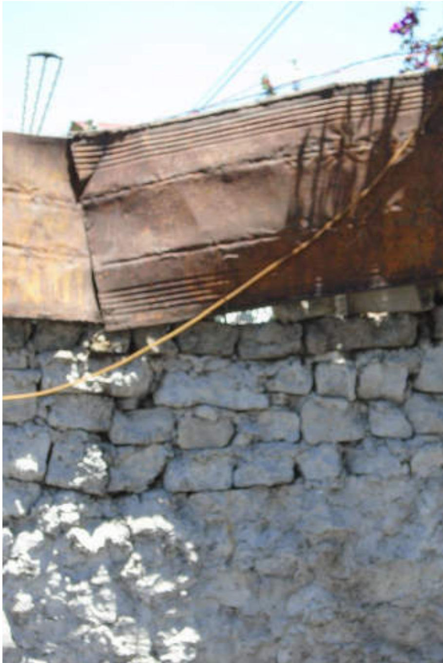
Figura 5.319. Fotografía C (Imagen 55), que muestra la barda perimetral de una vivienda con rocas y láminas sobrepuestas lo que hace inestable la construcción (19.4775° N, 99.2084° W. Calle: Hormiguero).
