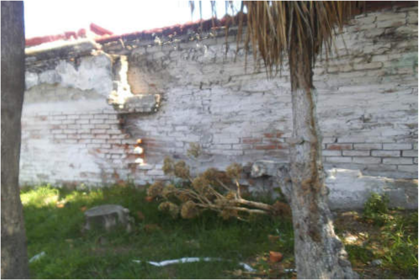
Figura 5.121. Fotografía B (Imagen 19), se muestra el muro perimetral de una vivienda, el cual presenta demolición en la mayor parte de su superficie, asimismo se distingue que se le aplicó un mal proceso constructivo (19.4926° N; 99.2072° W. Calle: Manuel Salazar).
