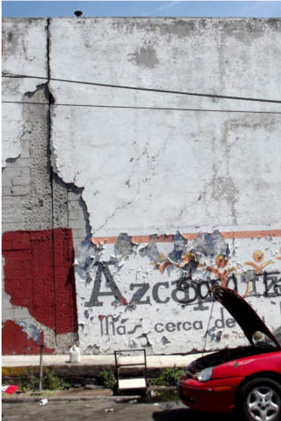
Figura 5.164. Fotografía E (Imagen 26), barda de mampostería semicofinada con desprendimiento parcial en aplanado de concreto y deterioro en acabado por intemperismo, fractura diagonal en muro derecho en la parte superior de trabe de concreto (19.4843° N, 99.1737° W. Calle: Santo Tomás).
