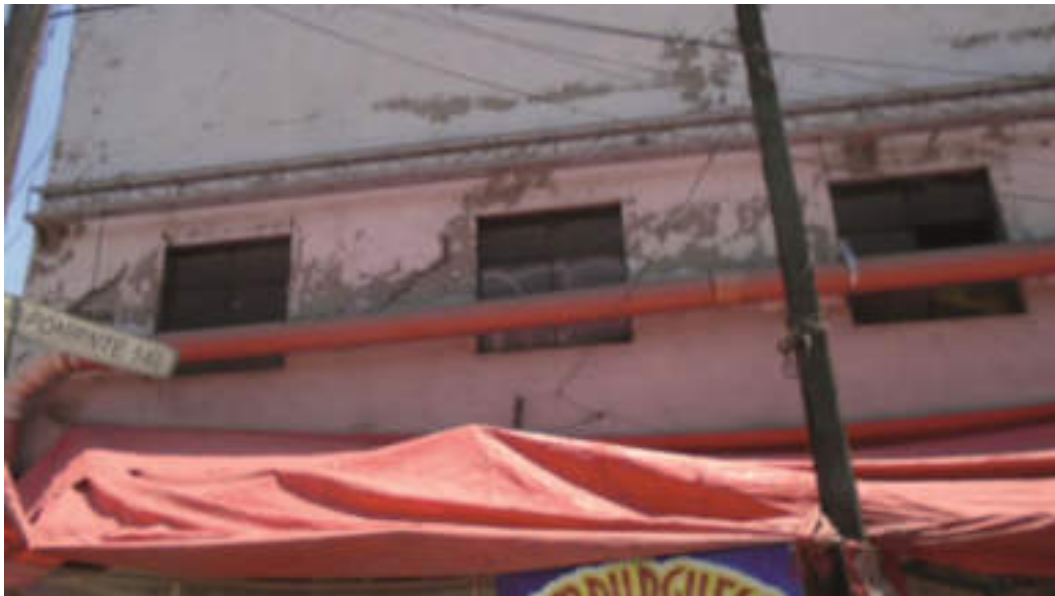
Figura 5.40. Fotografía B (Imagen 6), se muestra un edificio de mampostería semiconfinada con fracturas diagonales a un costado de las ventanas (19.4996483657° N, 99.1701519453° W. Calle: 5 Norte (Poniente 140)).
