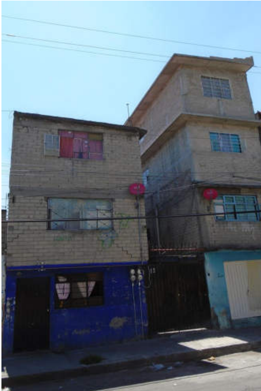
Figura 5.305. Fotografía E (Imagen 52), vivienda sin confinar en la que se observan fracturas que van siguiendo la junta de la mampostería en el segundo nivel (19.4746° N, 99.2153° W. Calle: Gustavo Bazán).
