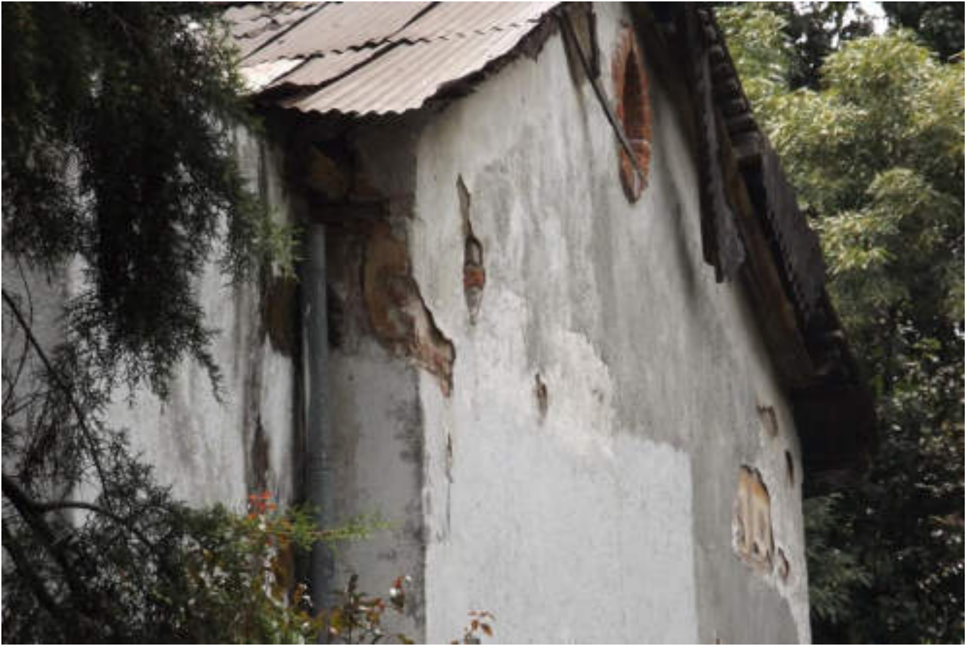
Figura 5.338. Fotografía C (Imagen 59), que muestra la fachada de una vivienda que presenta desprendimientos de acabado dejando al descubierto el material de construcción (19.4650° N, 99.1882° W. Calle: Azcapotzalco).
