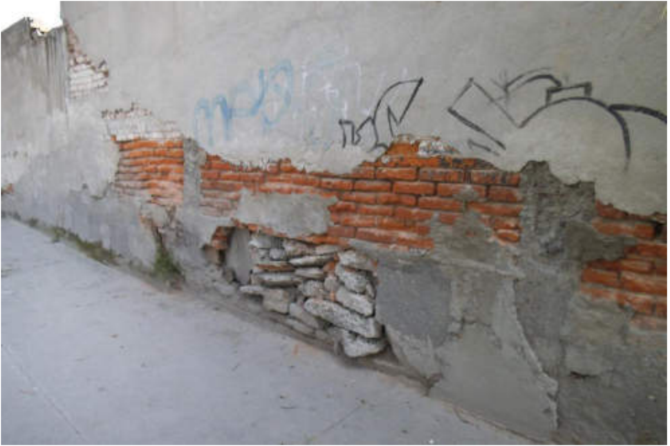
Figura 5.177. Fotografía D (Imagen 28), muro perimetral que presenta una demolición, tanto en la zona superior como en la inferior del mismo; la demolición en la zona inferior intentó taparse con rocas acomodadas, los ladrillo del muro no cuentan con la nivelación pertinente (19.4864° N, 99.1538° W. Calle: Poniente 122).
