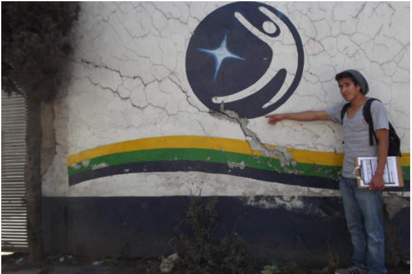
Figura 5.160. Fotografía A (Imagen 26), en ella se muestra una estructura de mampostería sin confinar, que presenta múltiples fracturas en diagonal que provocan desprendimiento parcial del acabado (19.4903° N, 991724° W. Calle: De las Granjas).
