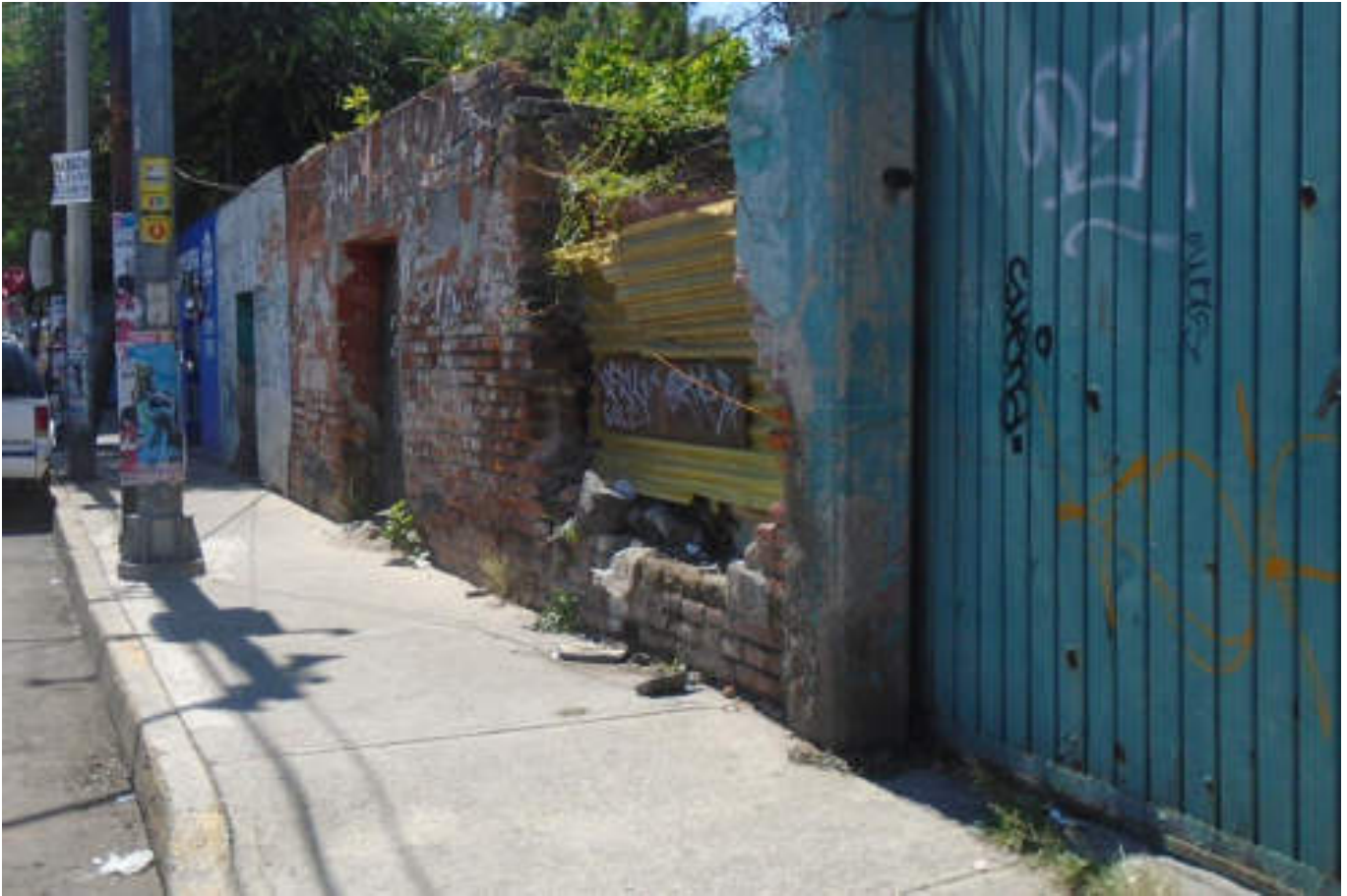
Figura 5.311. Fotografía D (Imagen 53), se observa una estructura de mampostería que presenta desprendimientos parciales de sus materiales, además de un colapso de gran parte del muro (19.4728° N, 99.2119° W. Calle: Rubén Bouchez).
