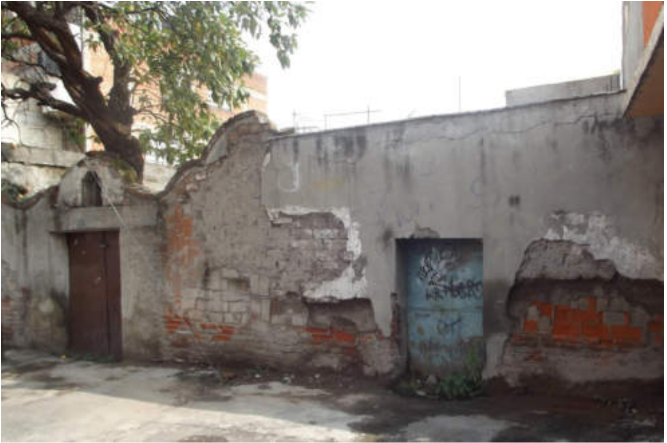
Figura 5. 27. Fotografía C (Imagen 4a), fachada de inmueble que presenta un mal procedimiento constructivo en el muro de mampostería, debido al excesivo peso que se le aplica a la parte inferior ocasionando que los tabiques rojos se presenten en compresión. En la parte superior se observa que el muro ha sido reconstruido y se ha colocado un aplanado, pero este se ha desprendido en la parte superior derecha se encuentra una fractura horizontal que afecta al acabado (19.4960819558° N, 99.1805485062° W. Calle: Justo Sierra).
