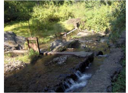
Estructura hidráulica ubicada en primer dinamo.
